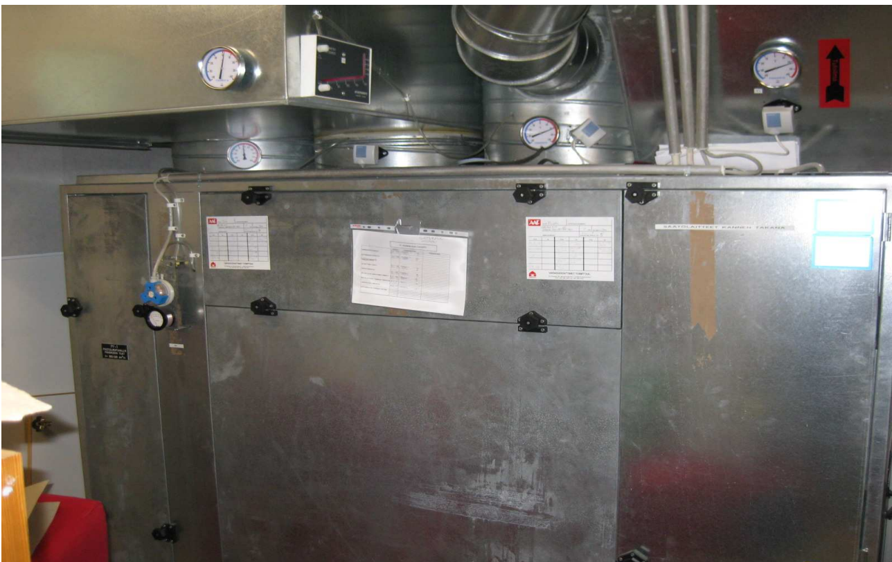
LVI-kuva 11. Yleiskuva lisärakennuksen IV- koneesta.
