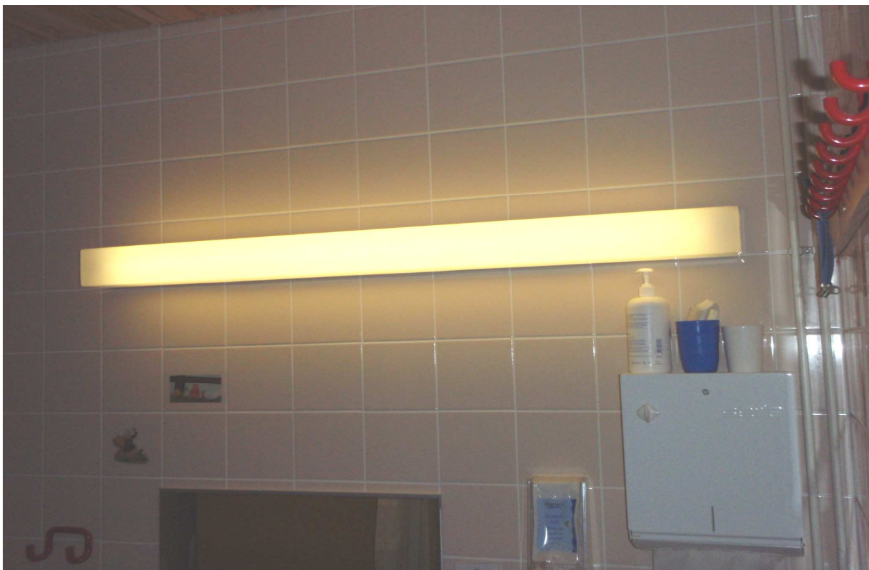
S-KUVA 10. WC- tilojen valaistus.
