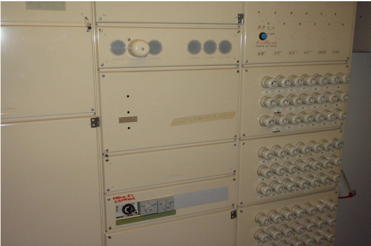
S-KUVA 3. Yleiskuva sähköpääkeskuksesta.
