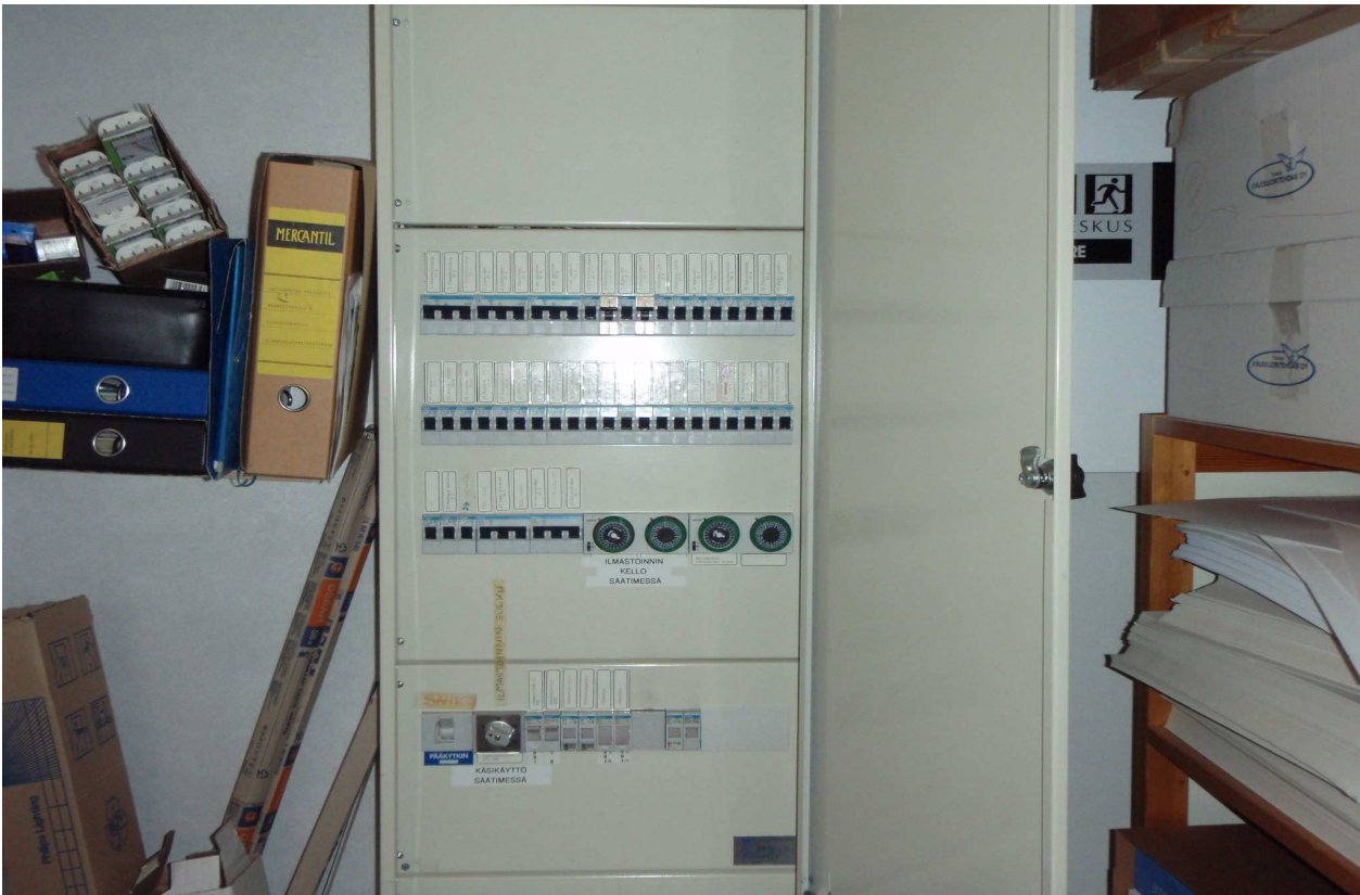
S-KUVA 5. Yleiskuva lisärakennuksen keskuksesta JK1.
