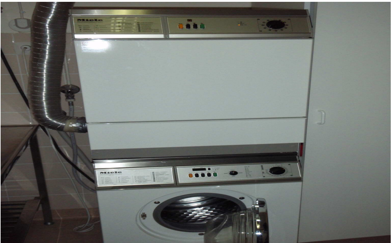
S-KUVA 14. Pesukone ja kuivausrumpu.
