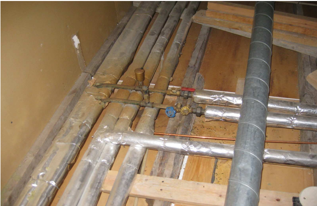
LVI-kuva 2. Yleiskuva lämpöjohtoverkoston venttiileistä.
