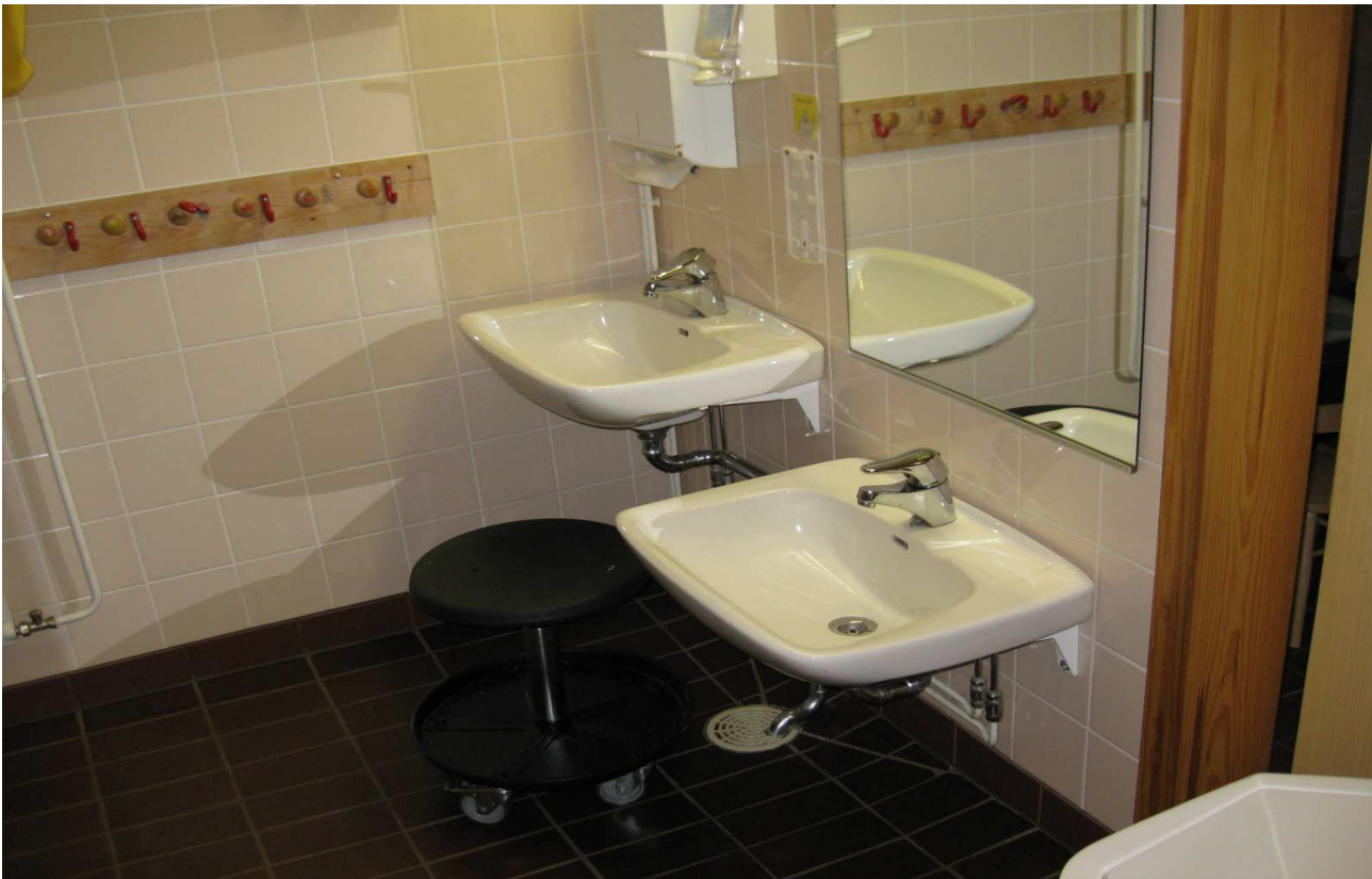
LVI-kuva 8. Yleiskuva vesikalusteista.
