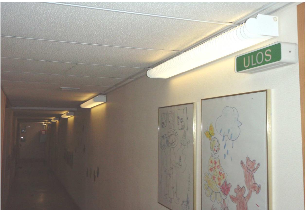
S-KUVA 8. Käytävän valaistus.
