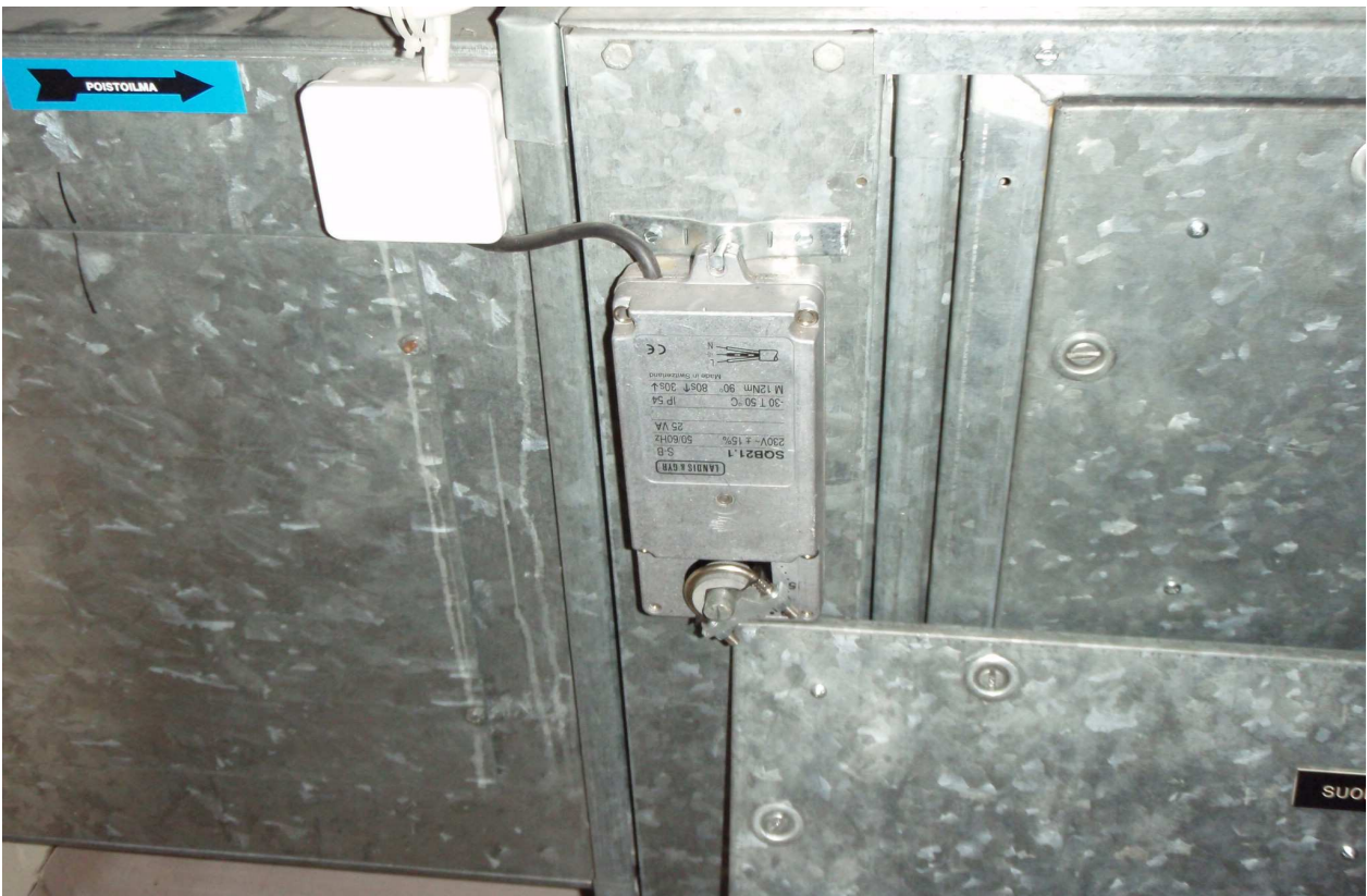
S-KUVA 18. Yleiskuva peltimoottorista.
