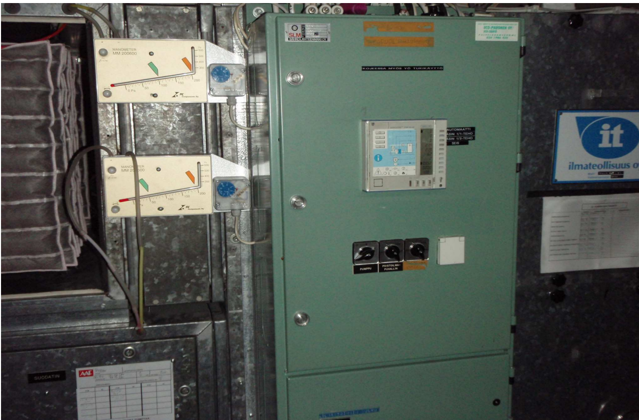
S-KUVA 4. Yleiskuva IV- konehuoneen keskuksesta.
