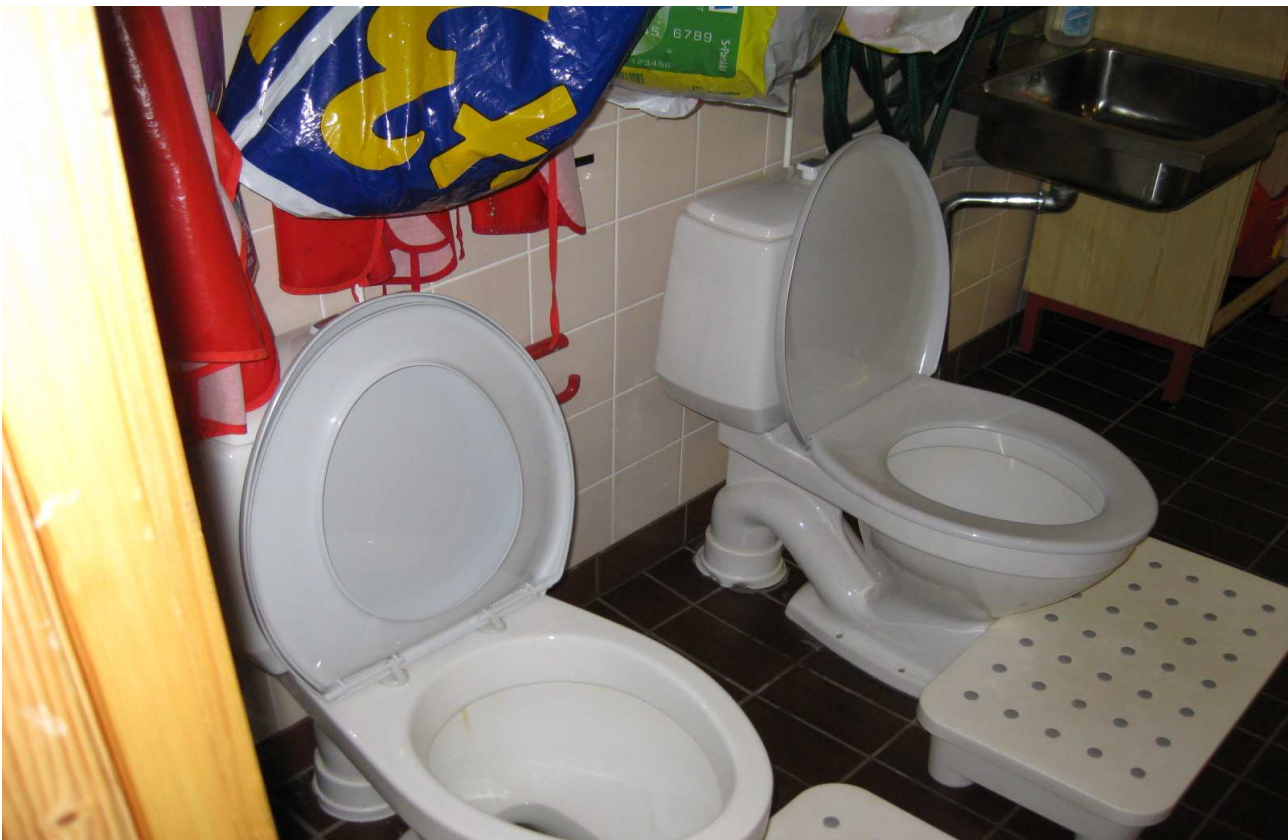
LVI-kuva 9. Yleiskuva vesikalusteista.
