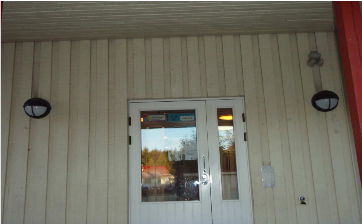
S-KUVA 1. Sisäänkäynnin valaistus.
