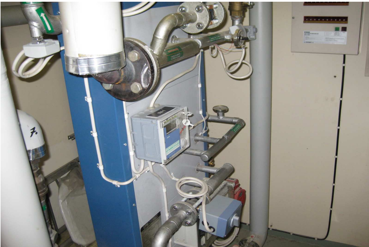
LVI-kuva 1. Yleiskuva lämmönjakohuoneesta.
