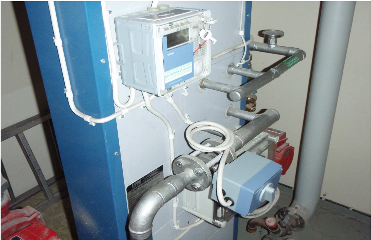
S-KUVA 15. Lämmönjaon yksikkösäädin.
