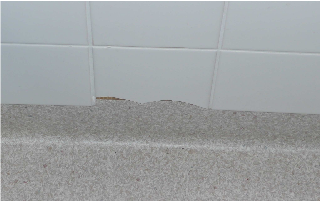
RAK- kuva 9. Lisärakennuksen seinälaattoja on rikki.
