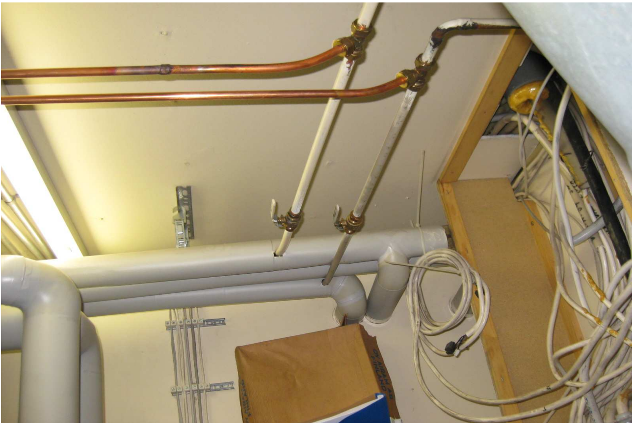
LVI-kuva 7. Yleiskuva käyttöveden sulku- ja säätöventtiilistä.
