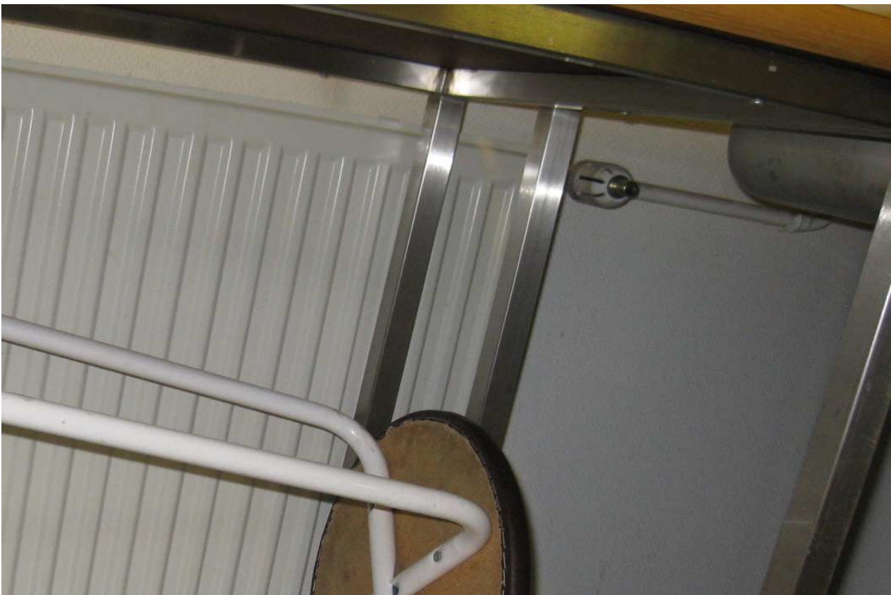
LVI-kuva 5. Yleiskuva lisärakennuksen patteriventtiilistä.
