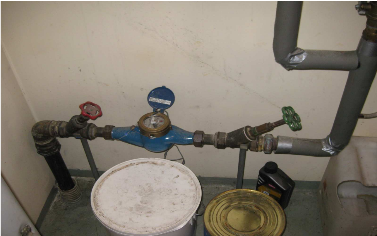
LVI-kuva 6. Yleiskuva vesimittarista ja pääsuluista.
