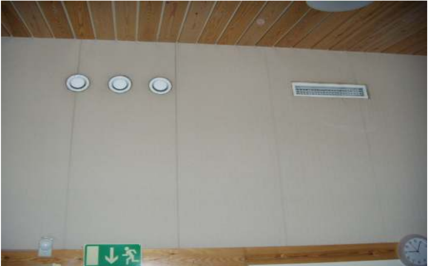
KUVA 17. Yleiskuva päärakennuksen huoneiden ns. ritiläsäleiköstä ja kartiopoistoista.
