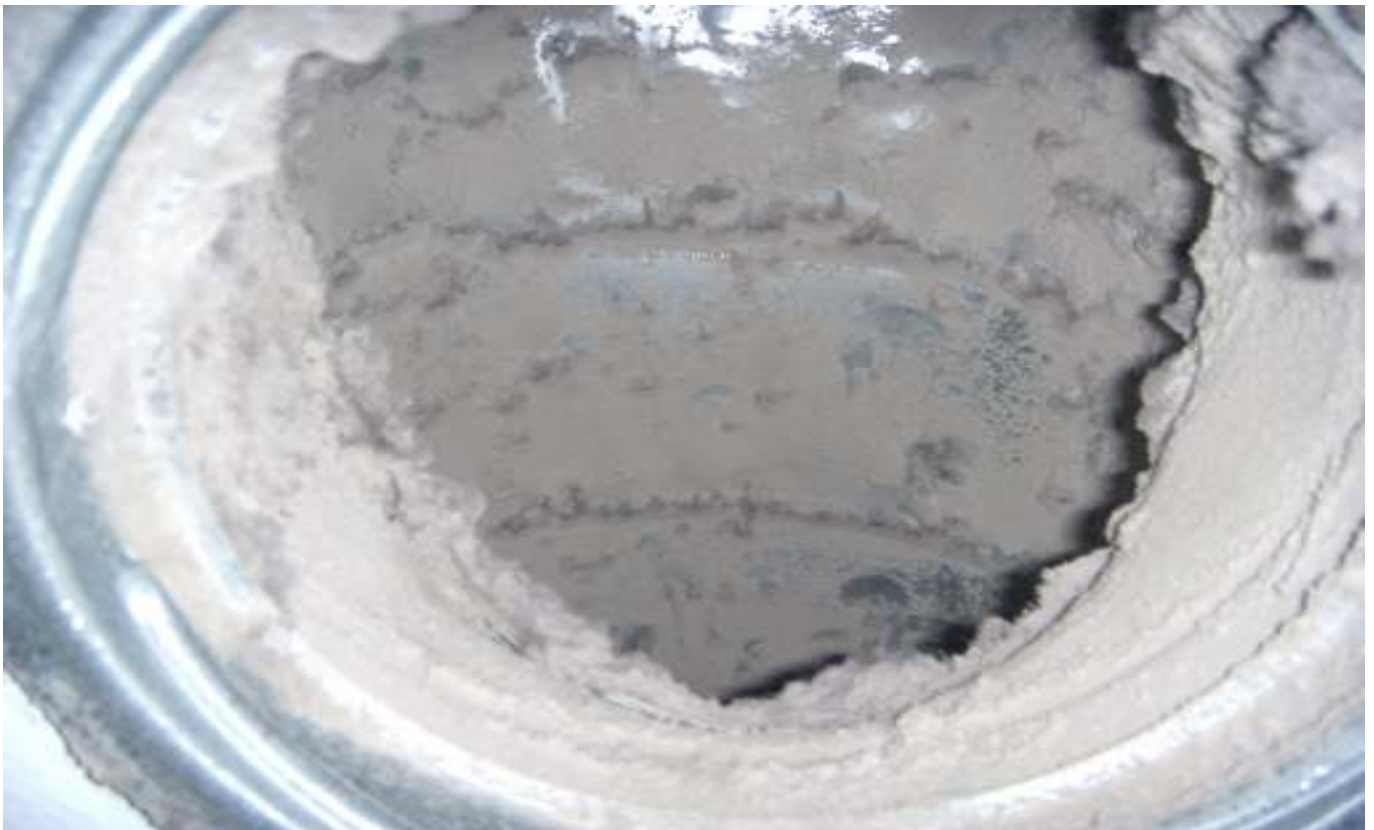
KUVA 16. Yleiskuva lisärakennuksen poistoilmakanavasta.
