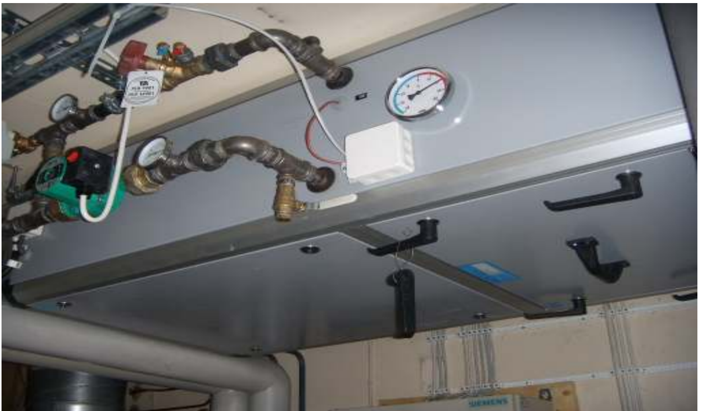
KUVA 2. Yleiskuva päärakennuksen alustatilaa palvelevasta tuloilmakoneesta.
