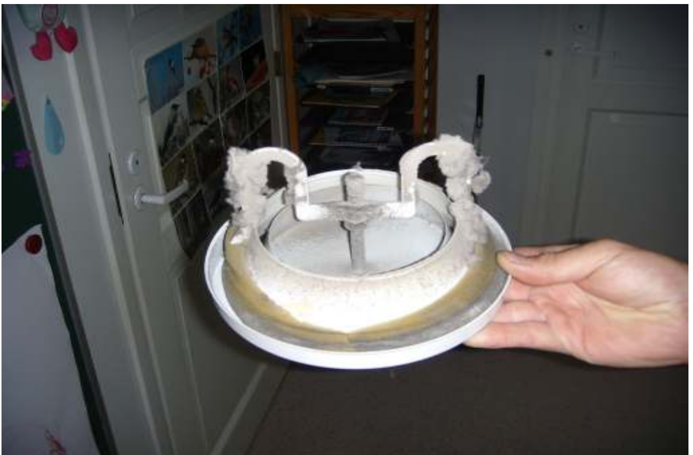
KUVA 20. Yleiskuva lisärakennuksen poistoilmaventtiilistä.
