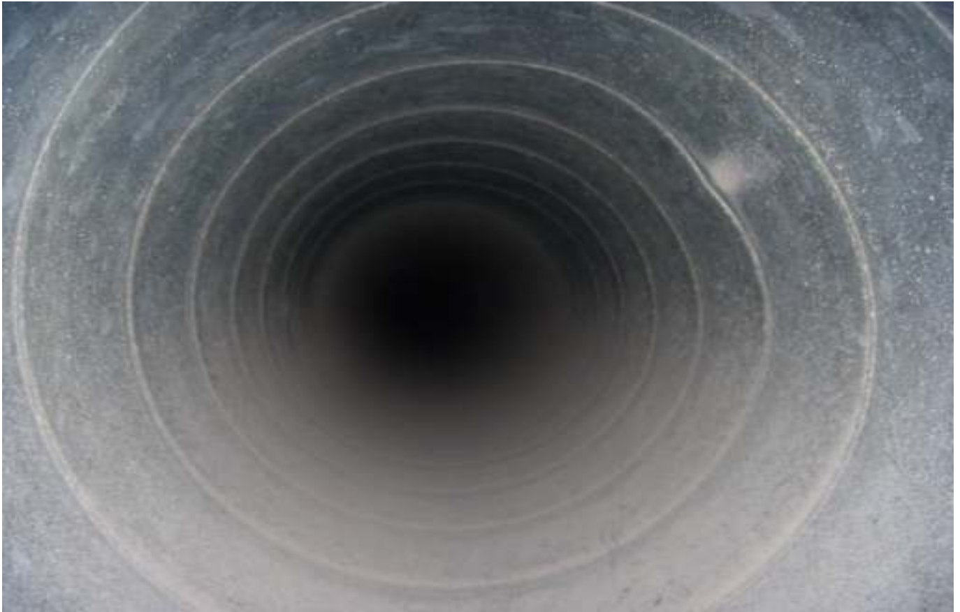
KUVA 13. Yleiskuva päärakennuksen poistoilmakanavasta.
