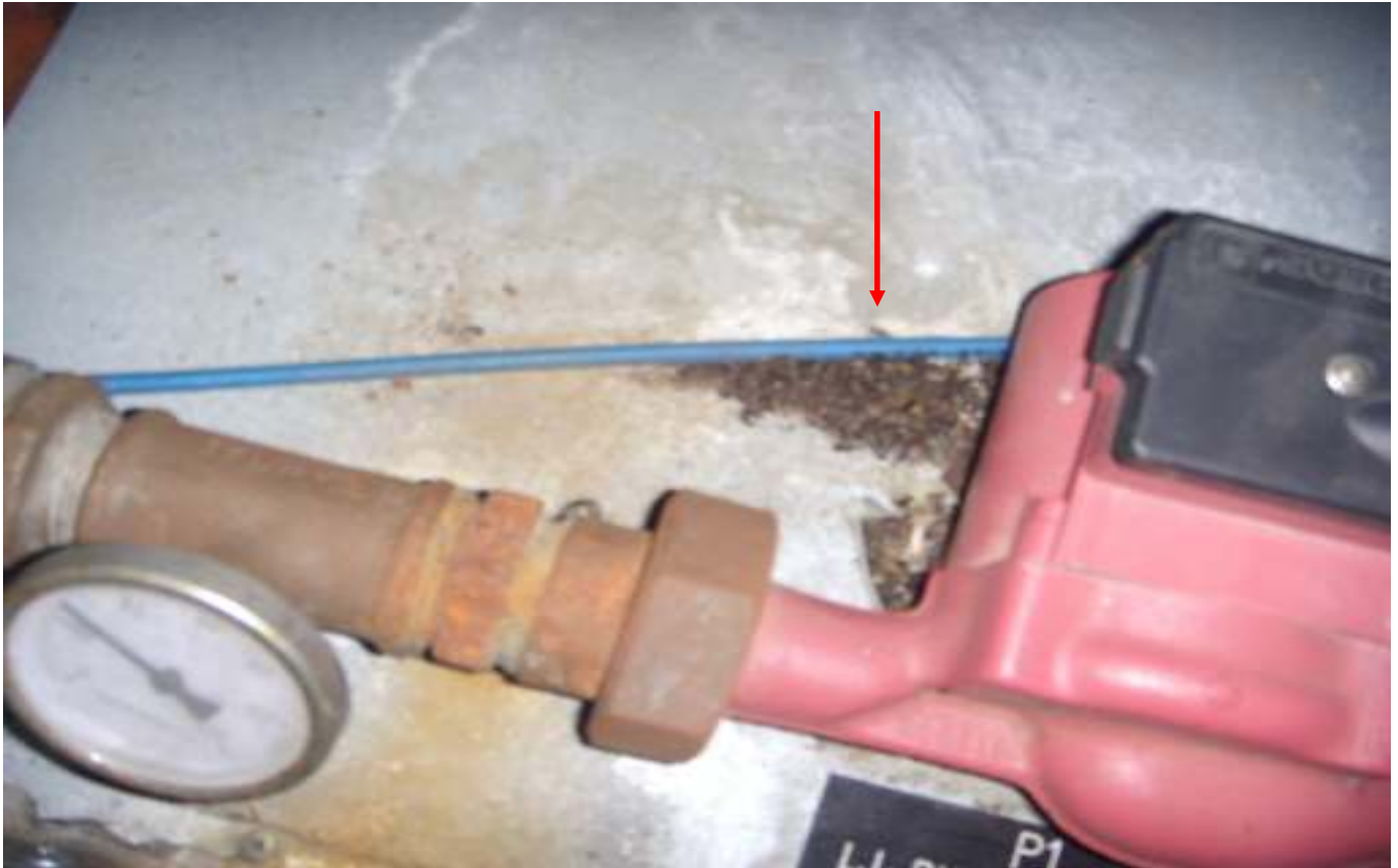
KUVA 11. Yleiskuva lisärakennuksen tuloilmakoneen kammiosta.
