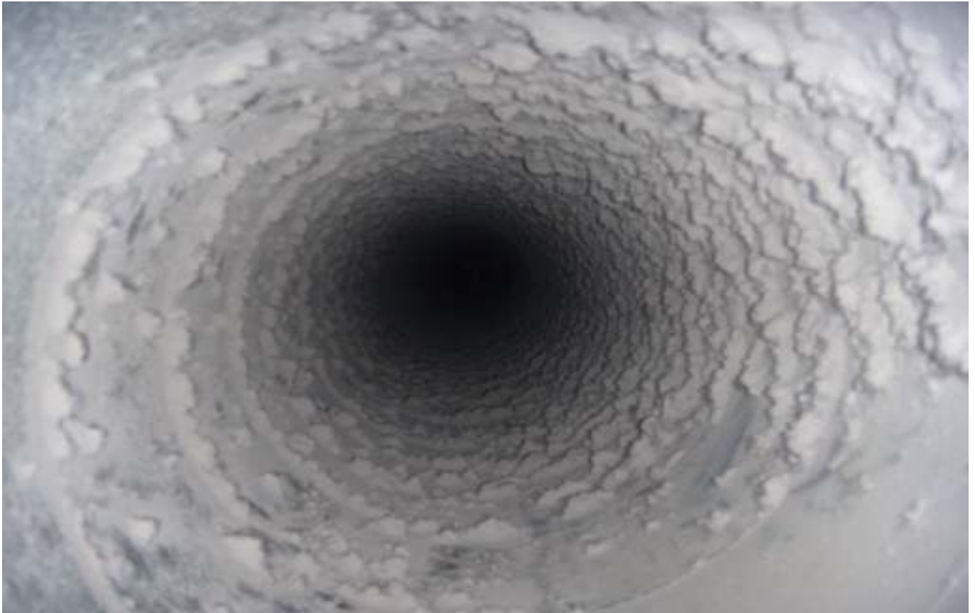
KUVA 15. Yleiskuva lisärakennuksen poistoilmakanavasta.
