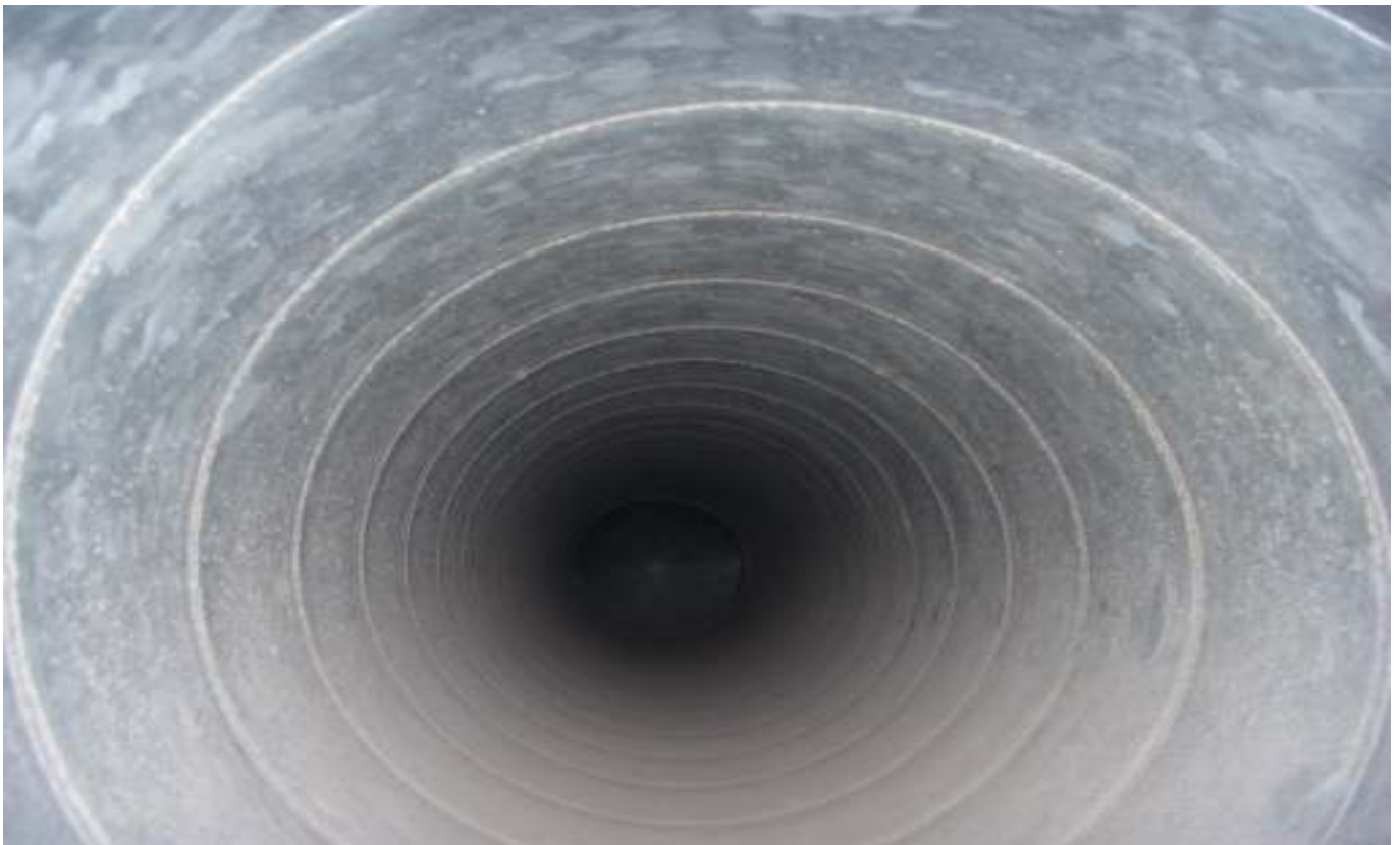
KUVA 14. Yleiskuva päärakennuksen tuloilmakanavasta.
