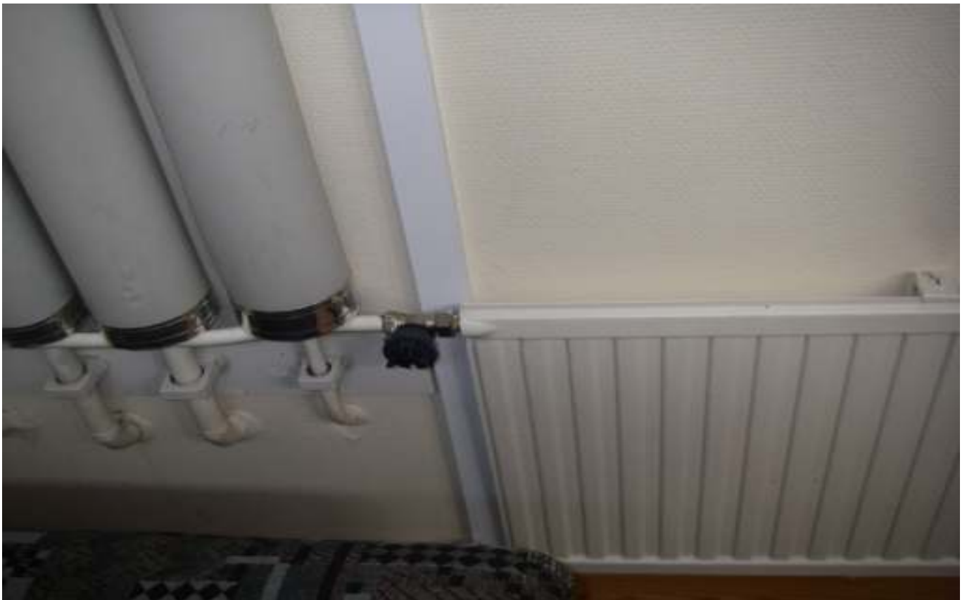
KUVA 22. Yleiskuva rikkiäisestä patteriventtiilistä.
