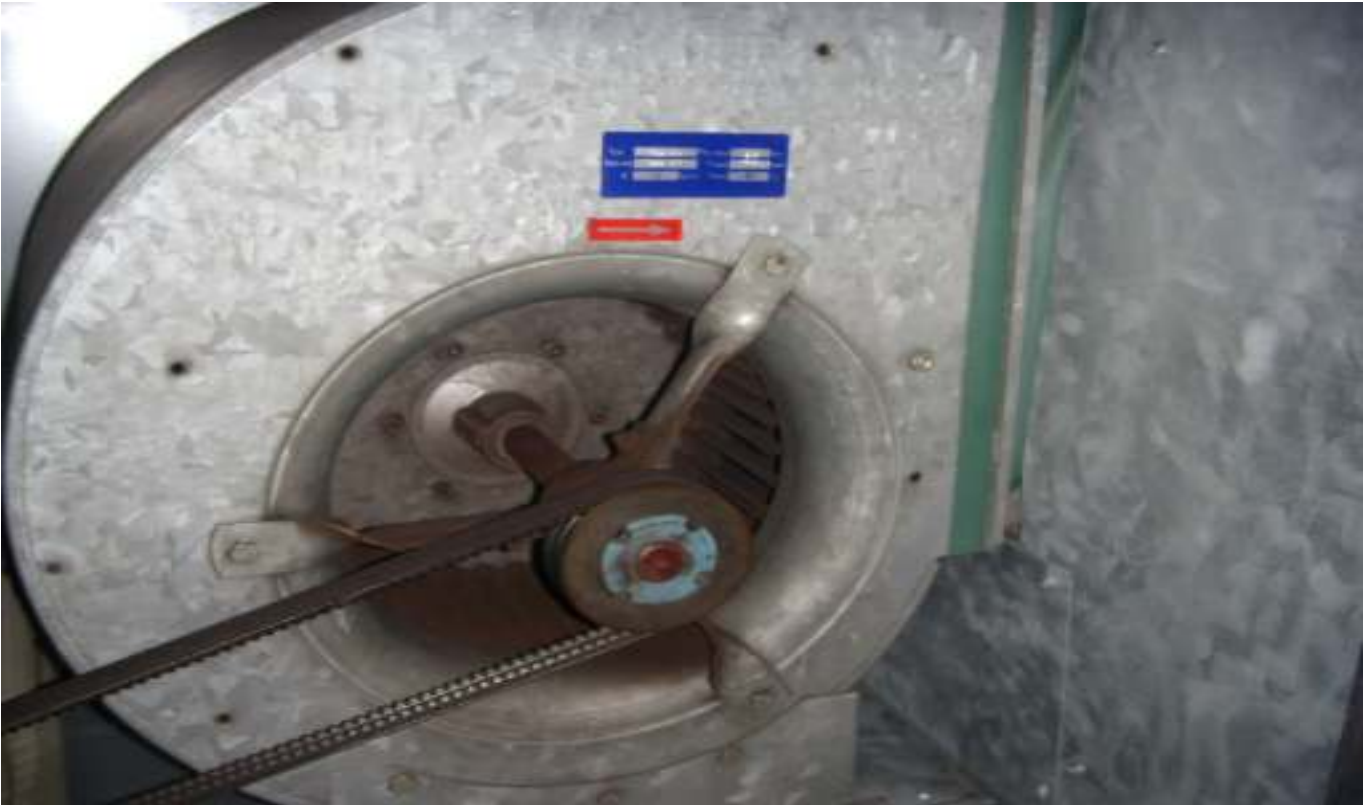
KUVA 7. Tuloilmapuhallin on hieman pölyinen ja nokinen.
