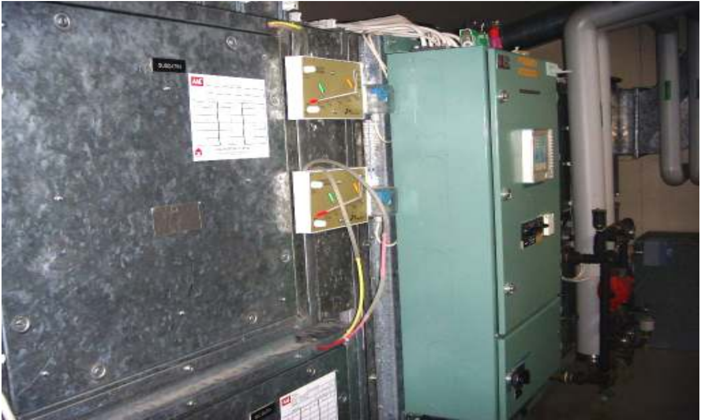
KUVA 1. Yleiskuva päärakennuksen ilmastointikoneesta.
