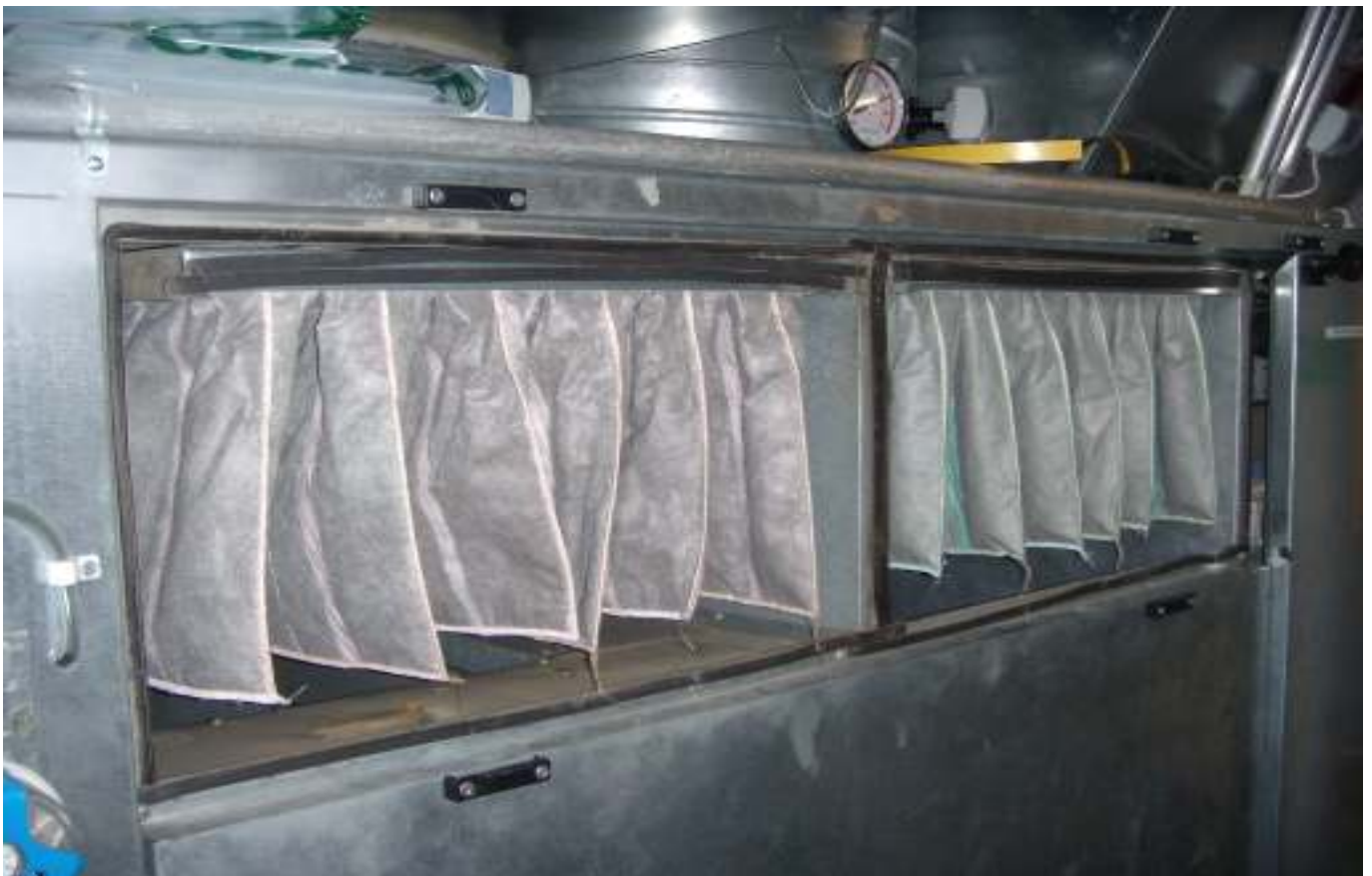
KUVA 10. Yleiskuva lisärakennuksen tulo- ja poistosuodattimista.
