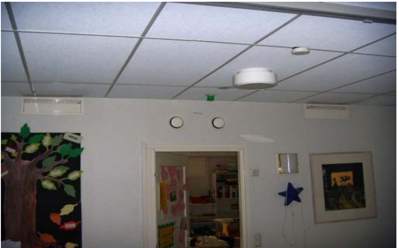
KUVA 18. Yleiskuva lisärakennuksen huoneiden ns. ritiläsäleiköstä ja kartiopoistoista.
