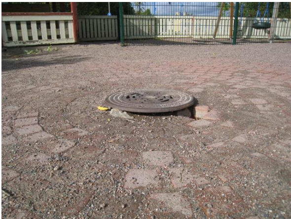
Kuva 3 Vaarallisen ylhäällä oleva sadevesikaivon kansi leikkipihalla.
