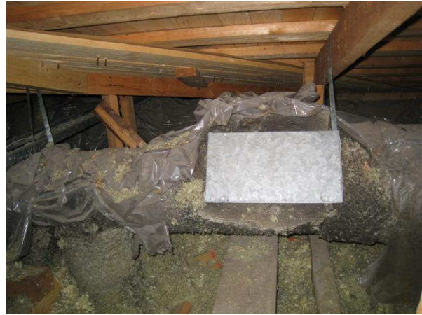
Kuva 22 Jiiritaitteen alla olevaa tummunutta IV-kanavan villaeristettä.
