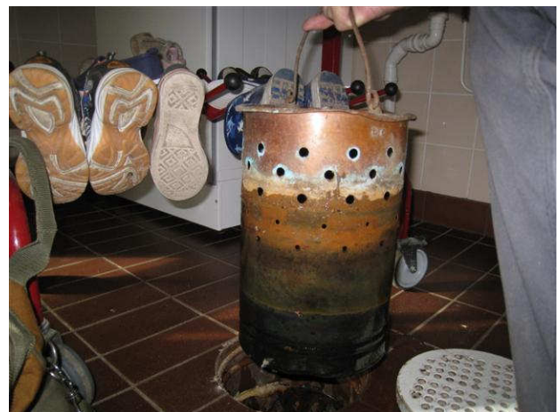
Kuva 30 Märkäeteisten lattiakaivot ovat syviä ja niissä on kuparinen sakkaämpäri. Tämä oli puolillaan pahanhajuista lietettä.
