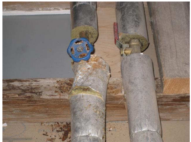
Kuva 26 Asennusontelon lämpöputkien ruostejälkiä ja vuotojälkiä.
