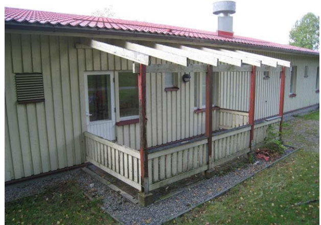
Kuva 38 Huonokuntoinen pergola. Voi harkita käyttötarvetta tai sitten kattaa.
