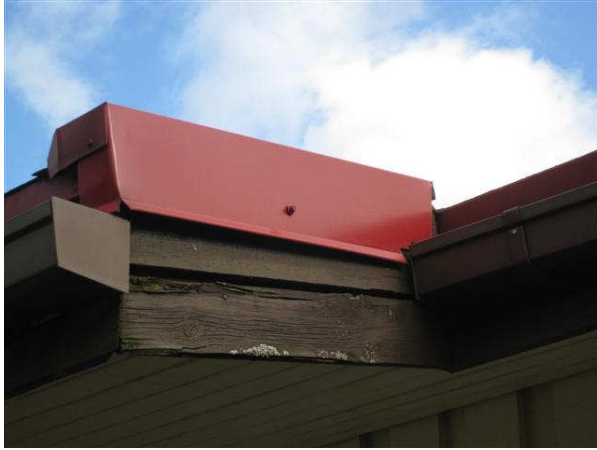
Kuva 19 Lahonnut räystäälauta tuulikaappi 48 räystäällä.
