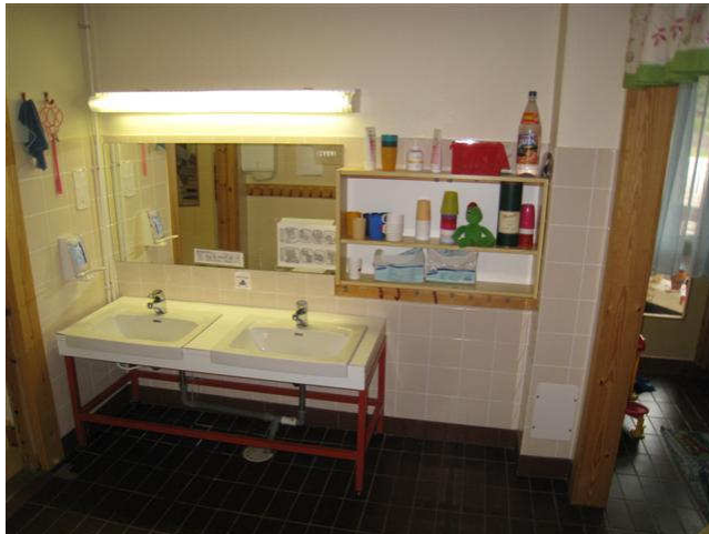
Kuva 27 Tyypillinen lasten pesuhuone. Käyttövesiputket ovat pinnassa.
