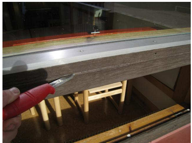
Kuva 16 Ikkunakarmien liitos ei ole tiivis.
