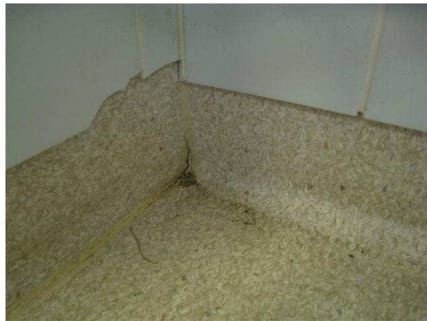
Kuva 44 Vesieristeenä toimivan muovimaton saumoja on rikki.
