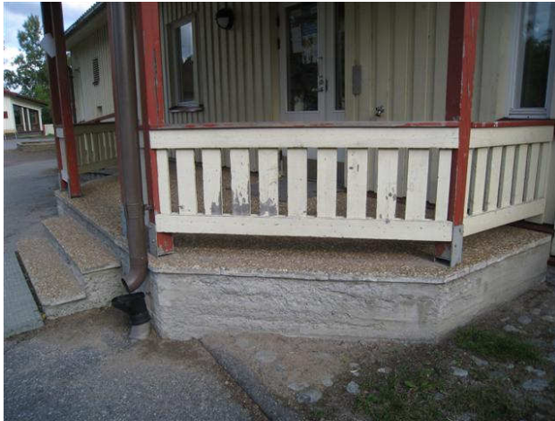
Kuva 39 Sisäänkäynnin betonirakenteissa on korjattavaa, kaide on osin laho.
