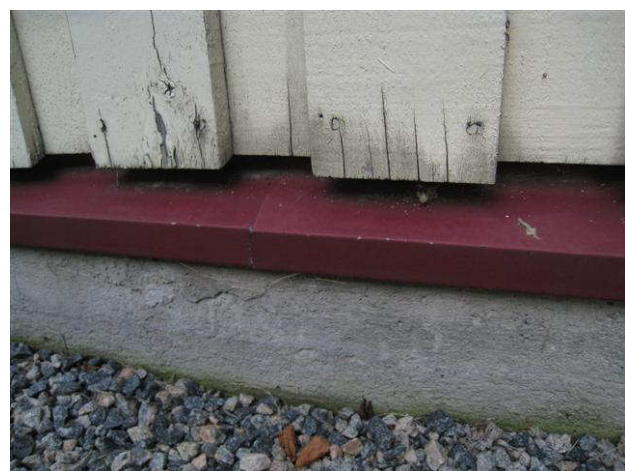
Kuva 36 Lautojen alapäätt ovat kastuneet ja sitten haljenneet.
