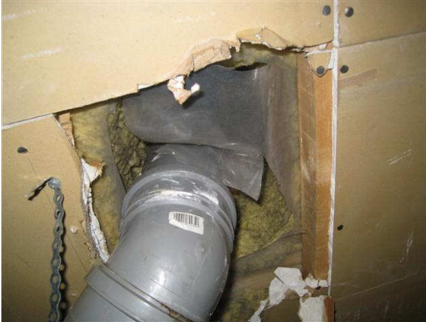
Kuva 25 Asennusontelon yläpohjan huono läpivienti.
