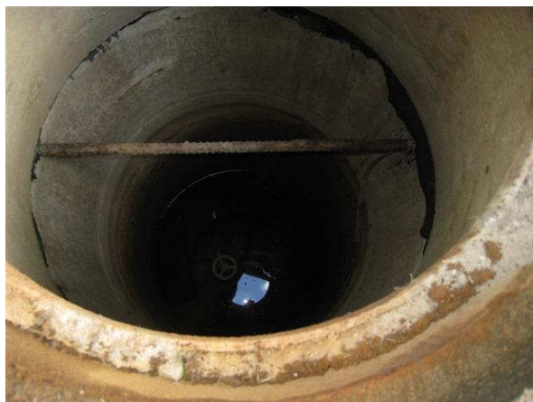
Kuva 5 Perusvesikaivo, jossa pohjalla on venttiili sadevesiviemärissä.
