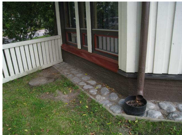
Kuva 4 Lepo- ja leikih.11 kulmalla oleva ränni-kaivo ja perusvesikaivo.
