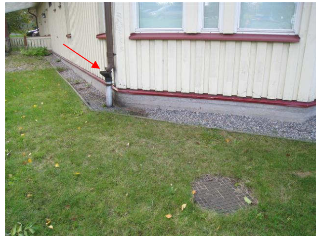
Kuva 34 Salaojan tarkastuskaivo on valurautakannan alla. Kattovedet roiskuaa yli.
