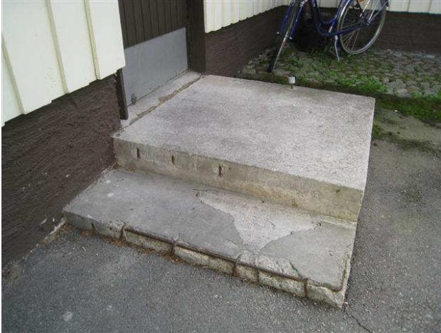
Kuva 13 Huoltoportin betonitaso on pakkasra-pautunut ja teräksiä on jo esillä.
