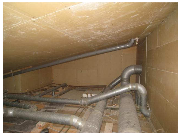
Kuva 24 Asennusontelo wc-pesuhuonetilosten yläpuolella on pölyinen ja sieltä on useita ilmayhteyksiä sisätiloihin. Kattorakenne on heikko.
