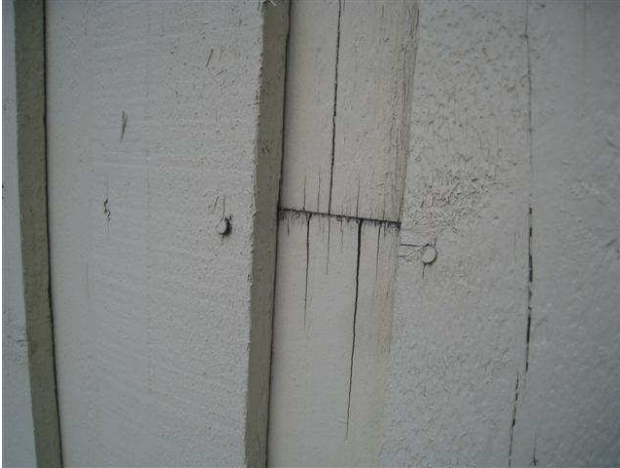
Kuva 37 Haljenneita lautoja ja vettä imeviä liitoksia. Naulaus antaa myöten.
