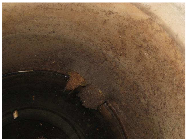
Kuva 6 Perusvesikaivoon tulevat vanhat keltaiset peltosalaojaputket ovat tukossa.
