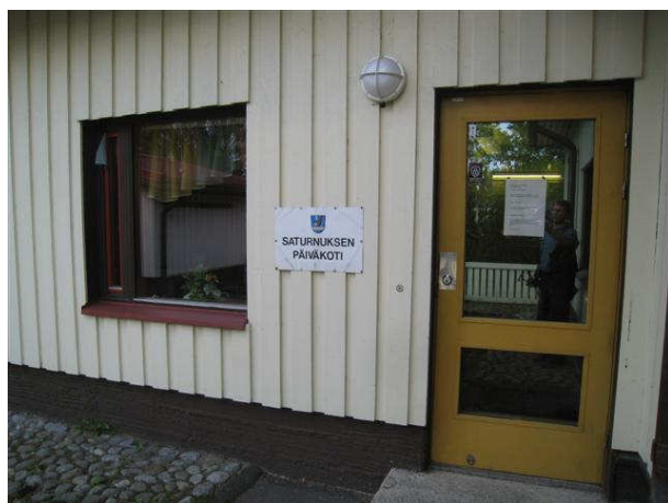
Kuva 11 Toimistotilan 31 kohdalla epäillään olevan ongelmia. ikkunan vesipellin alusta tarkastettiin, ks. kuva 12.
