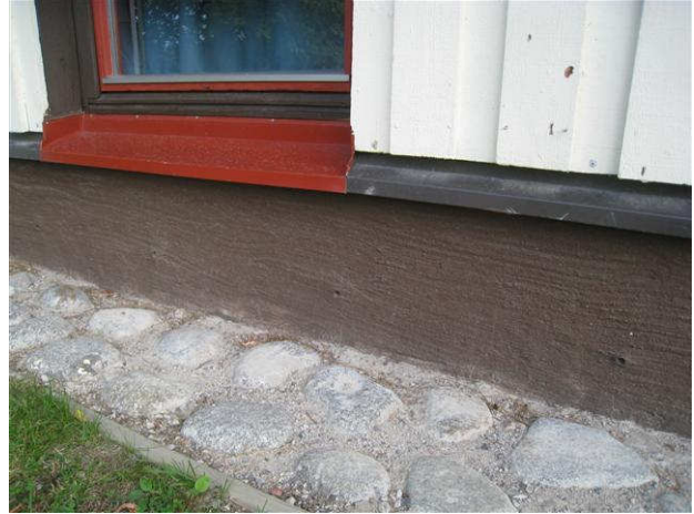
Kuva 8 Perusmuurien varaan on muurattu sokkeli harkoista ja pinnat on slammattu. Kyseessä on valesokkeli.
