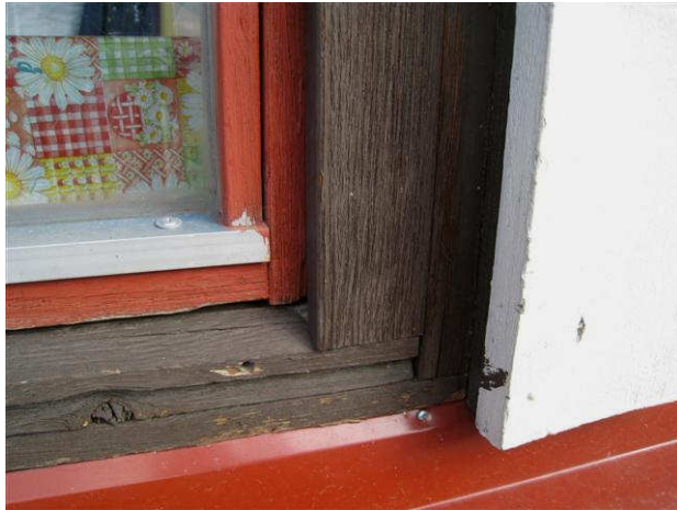
Kuva 15 Ikkunoiden ulkopintojen halkeilua ja huonoja liittymiä.
