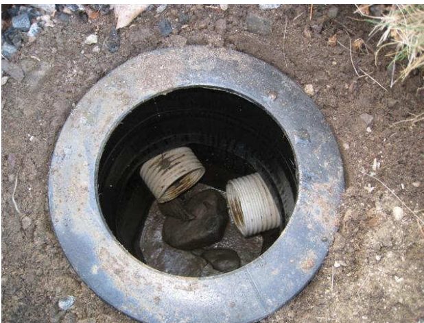
Kuva 35 Salaojat ovat matalassa.
