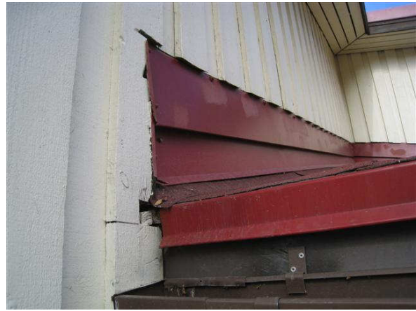
Kuva 20 Huono liittymä katoksen ja ulkoseinän liittymässä wc-pesuh. 39 kohdalla.
