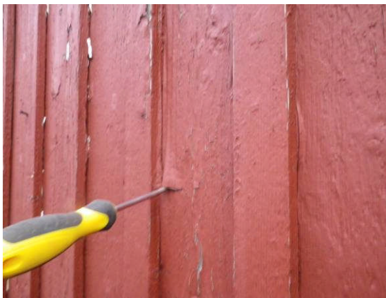
Julkisivun pehmentynyttä kohtaa.
