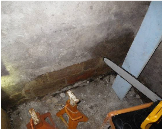
Kellarin maanvastaisten seinien vaurioita.
