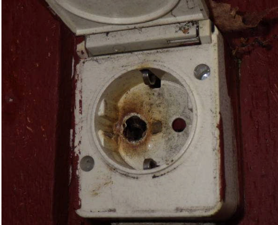
Rikkoutunut ulkopistorasia tulee uusia.
