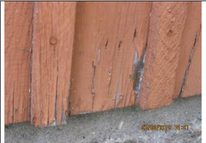
9. Julkisivuverhoilussa on paikoin vaurioita ja pehmentymää
