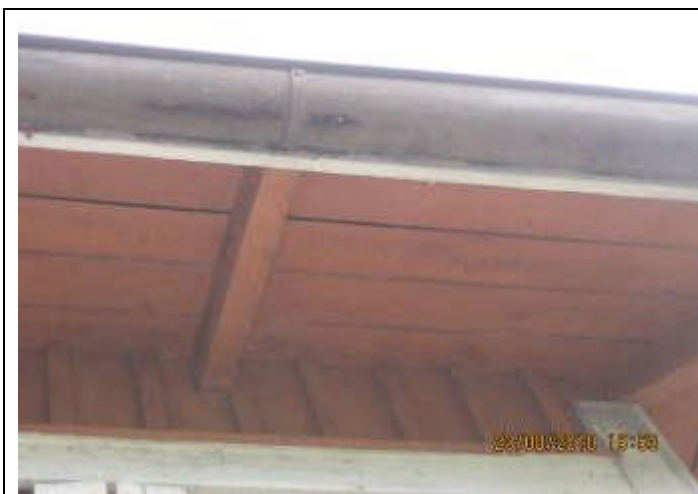
3. Räystäskouru on ruostunut puhki
