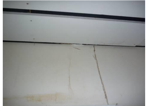
KUVA2: Eteisen levytyksessä kosteuteen viittaavia jälkiä.
