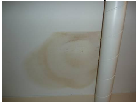
KUVA3: Varastohuoneen katossa vesivuoto- jälki.
