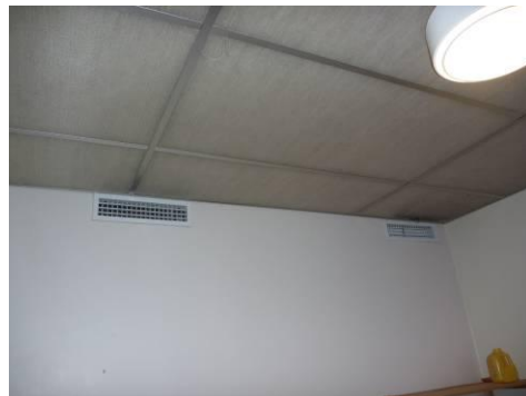
KUVA5: Kuvassa tilojen katoissa käytettyjä akustiikkalevyjä.
