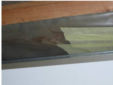
KUVA1: Leikki- ja lepohuoneen alaslaske- tussa katossa vesivuotojälkiä.
