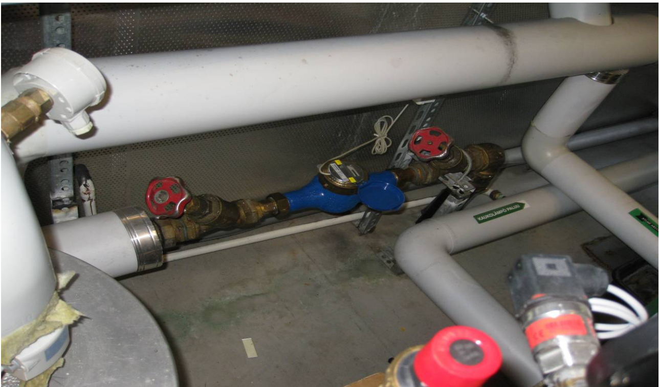
LVI-kuva 2. Yleiskuva vesimittarista ja pääsuluista.
