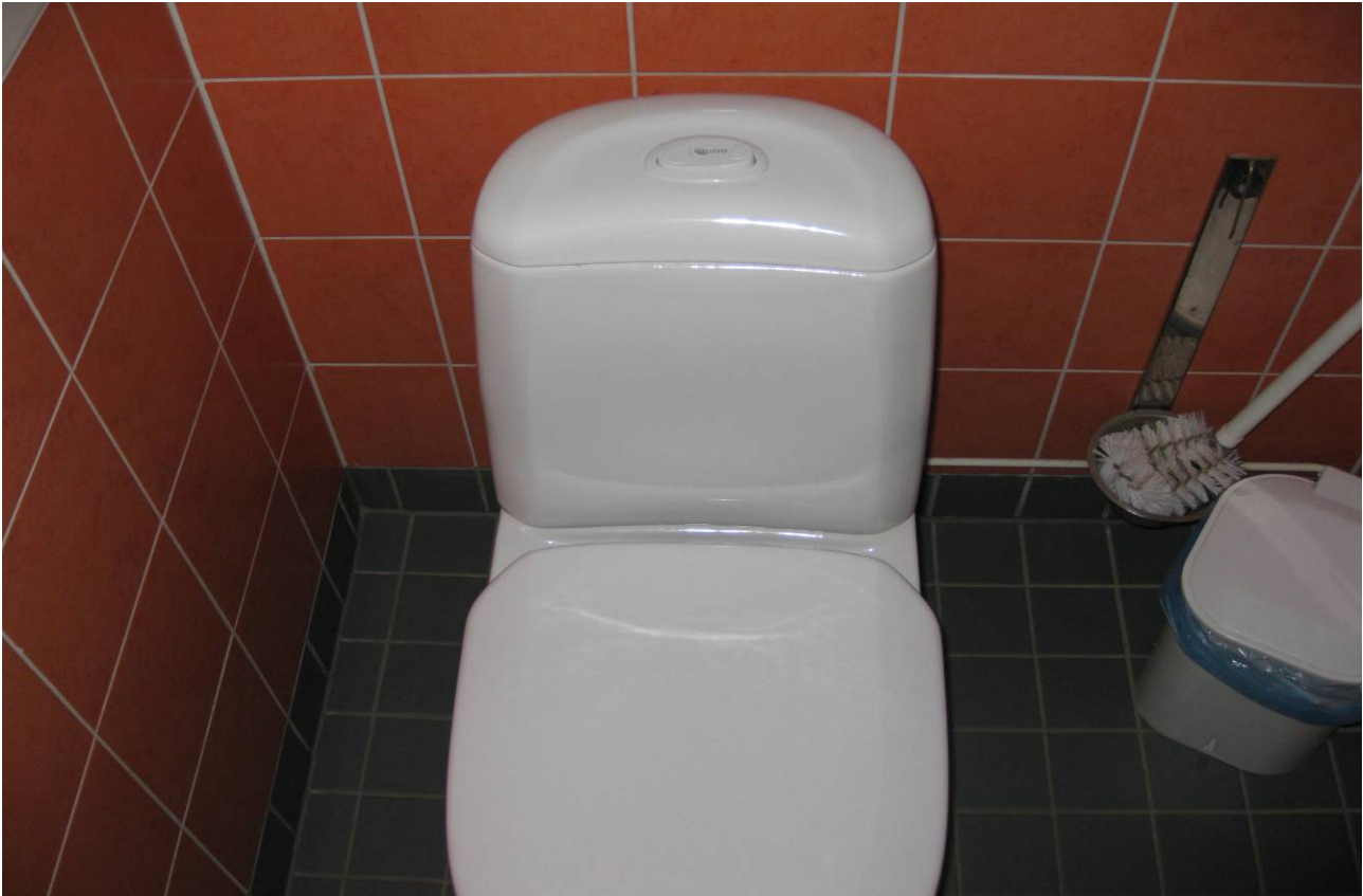
LVI-kuva 6. Yleiskuva wc-istuimesta.
