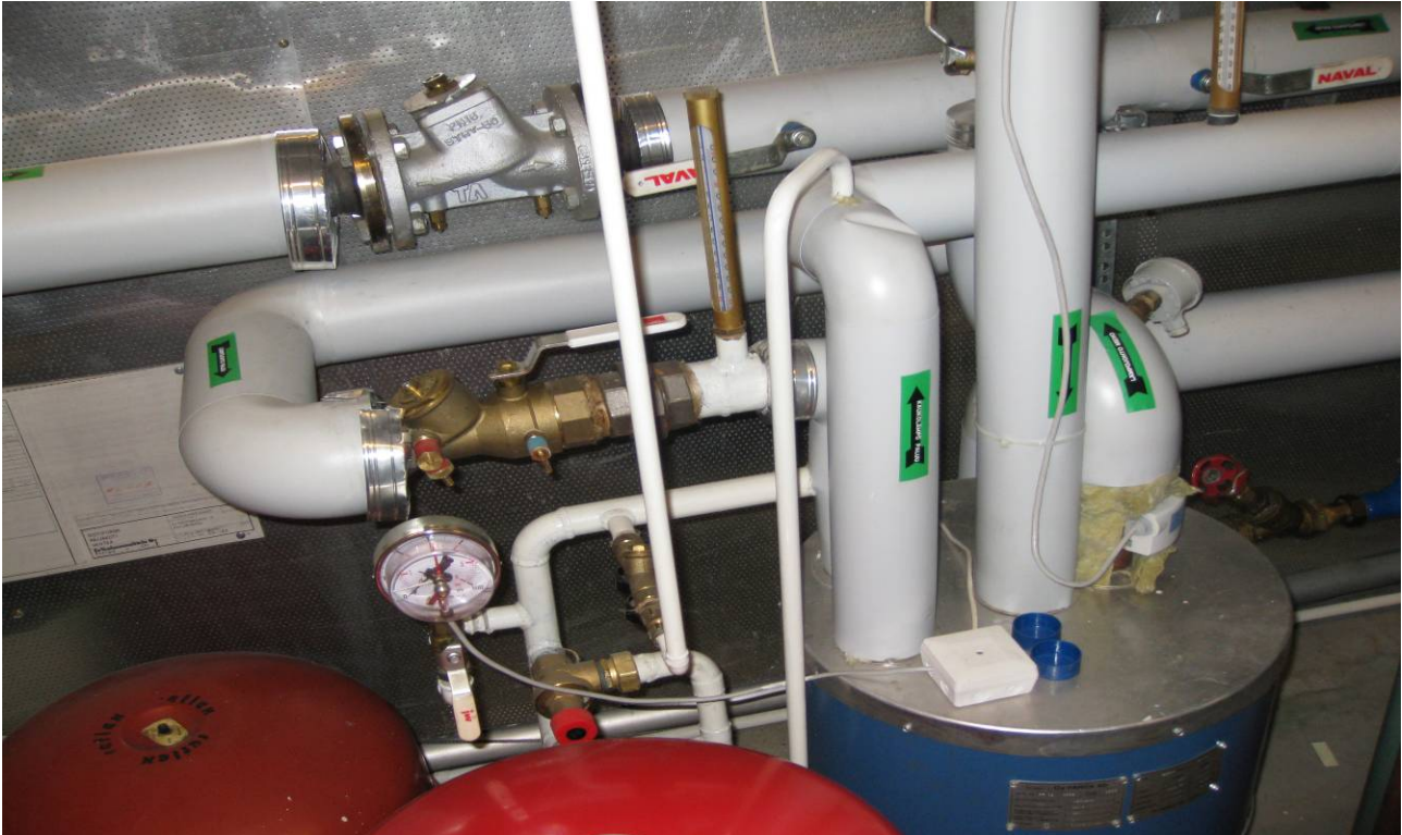
LVI-kuva 1. Yleiskuva lämmönjakuhuoneesta.
