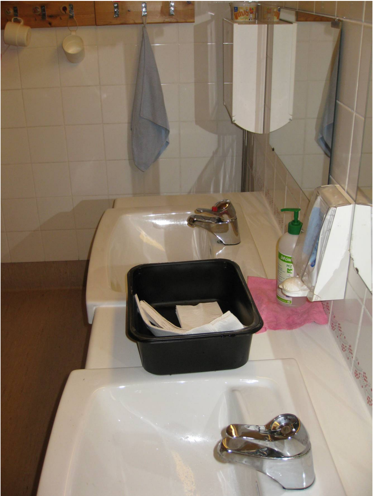
LVI-kuva 3. Yleiskuva vesikalusteista.
