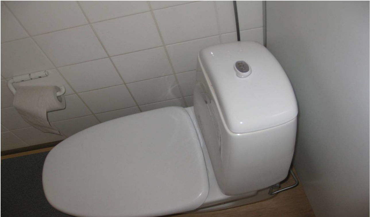
LVI-kuva 4. Yleiskuva wc-istuimesta.
