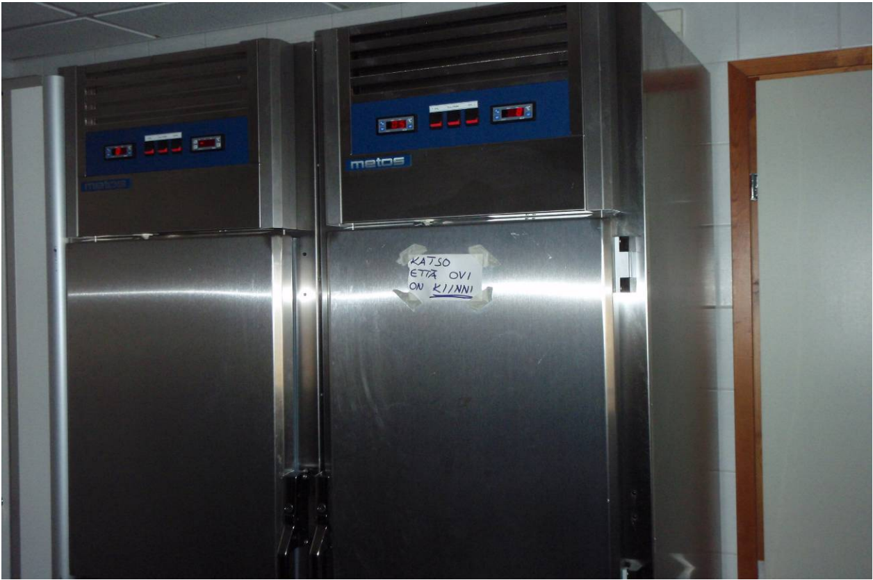
S-KUVA 13. Keittiön laitteet
