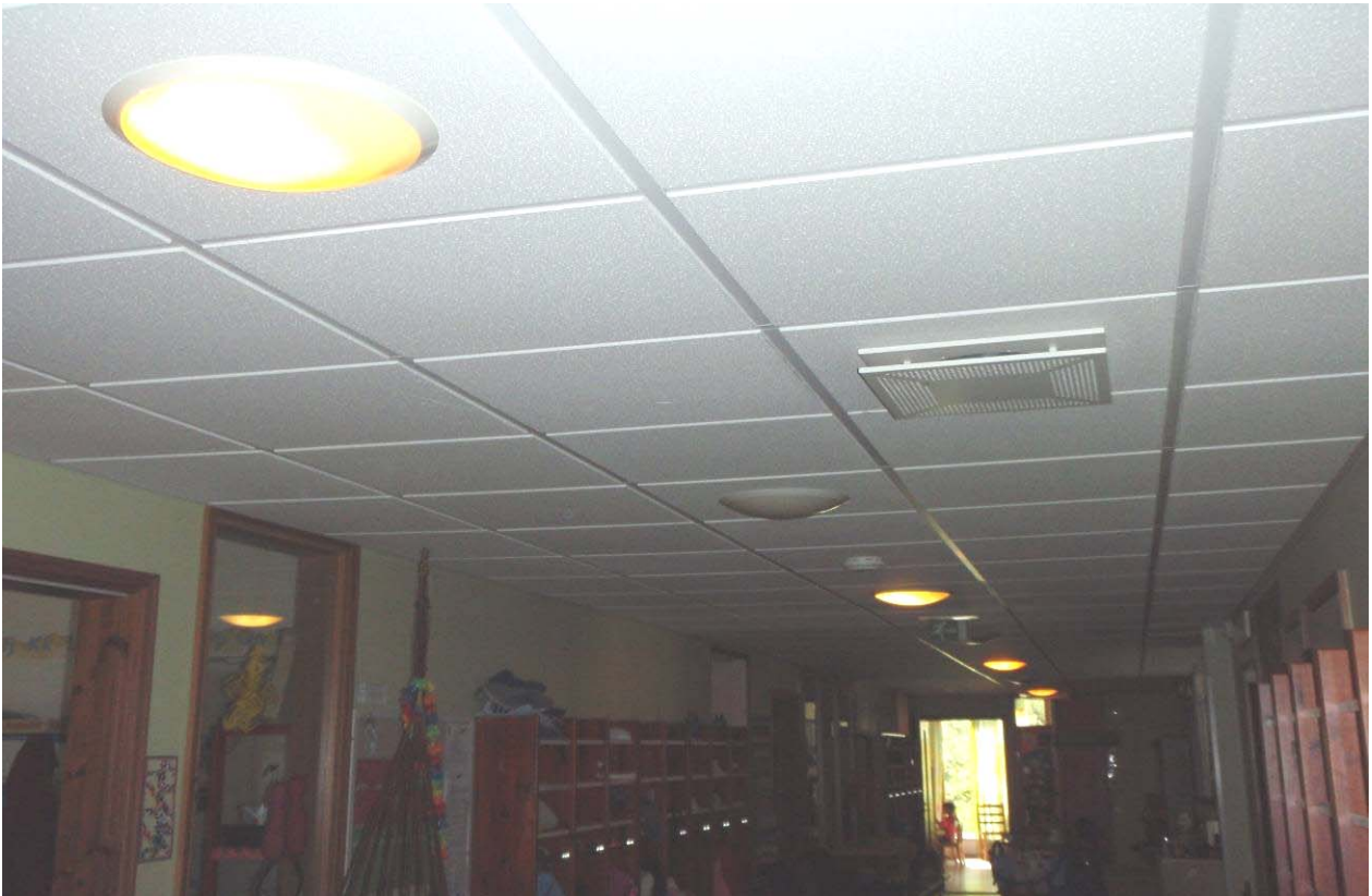
S-KUVA 8. Uuden osan käytävän valaistus
