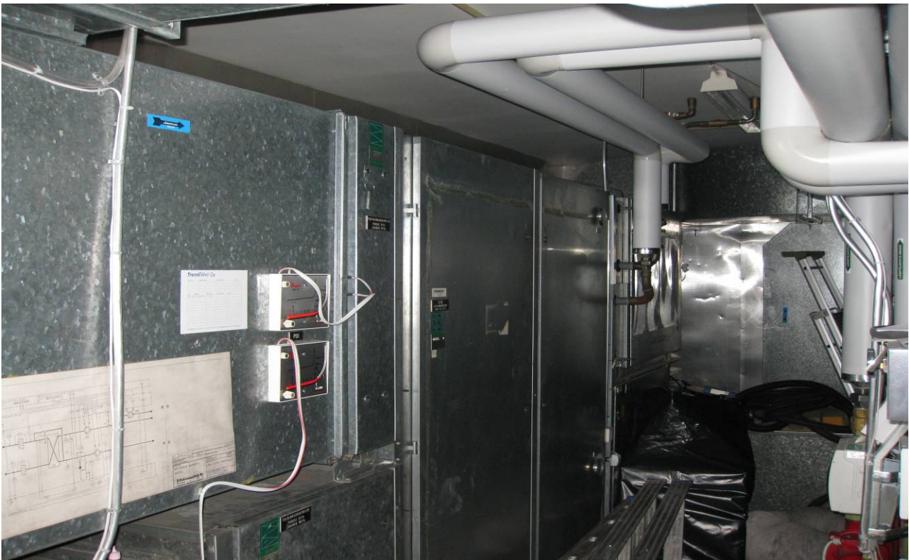
LVI-kuva 7. Vanhan puolen iv-kone.
