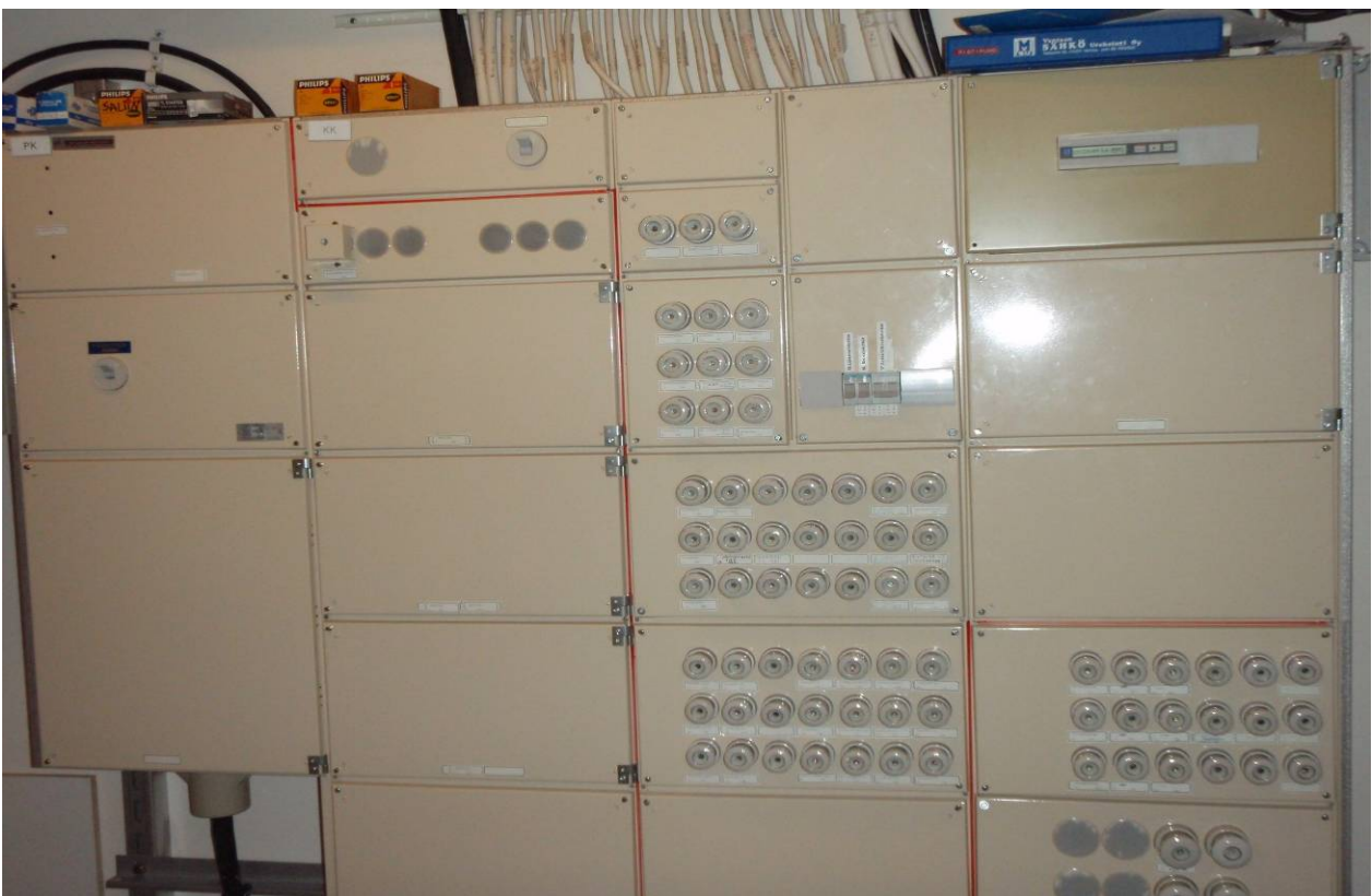
S-KUVA 4. Vanhan osan sähköpääkeskus
