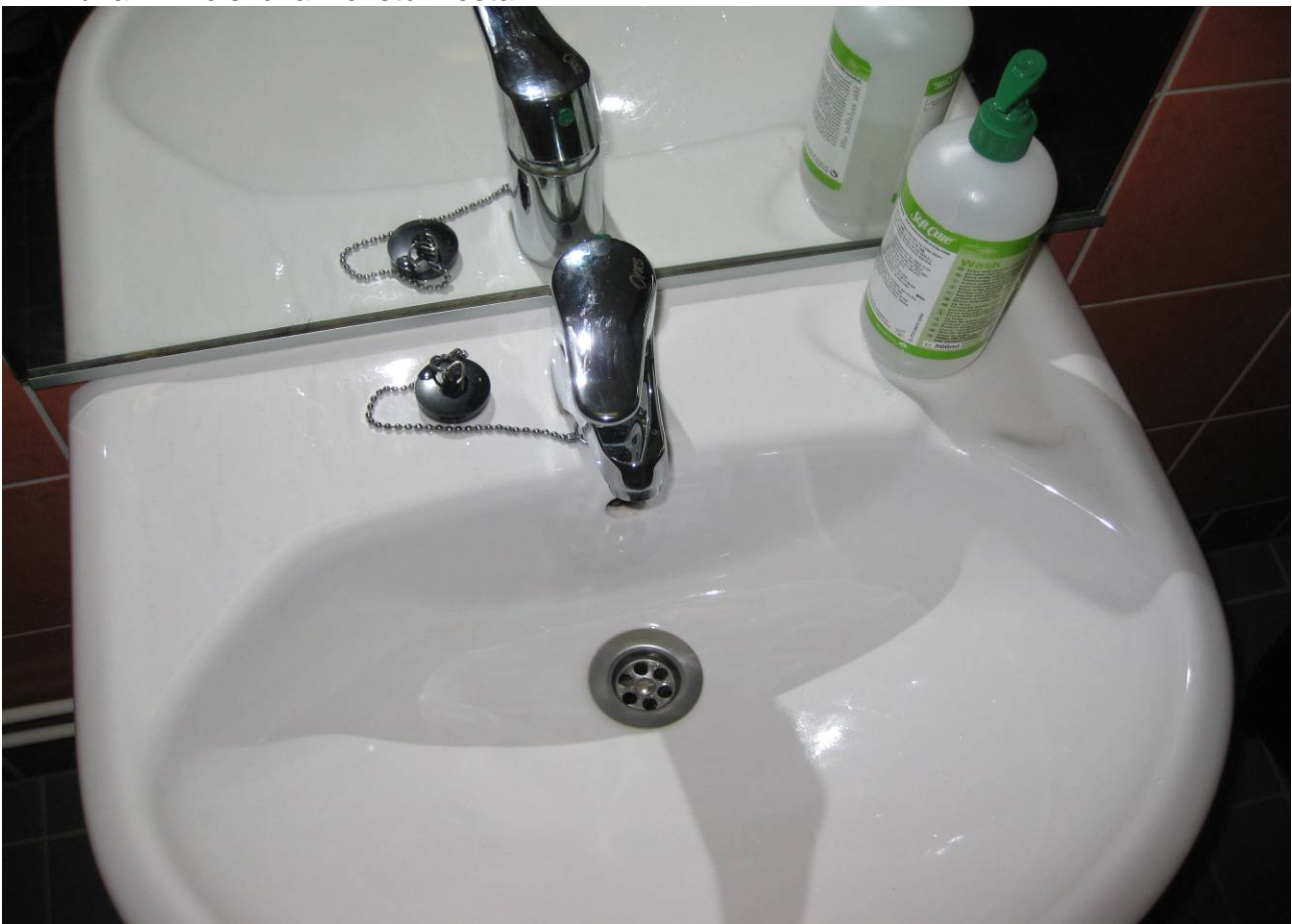
LVI-kuva 5. Yleiskuva vesikalusteista.
