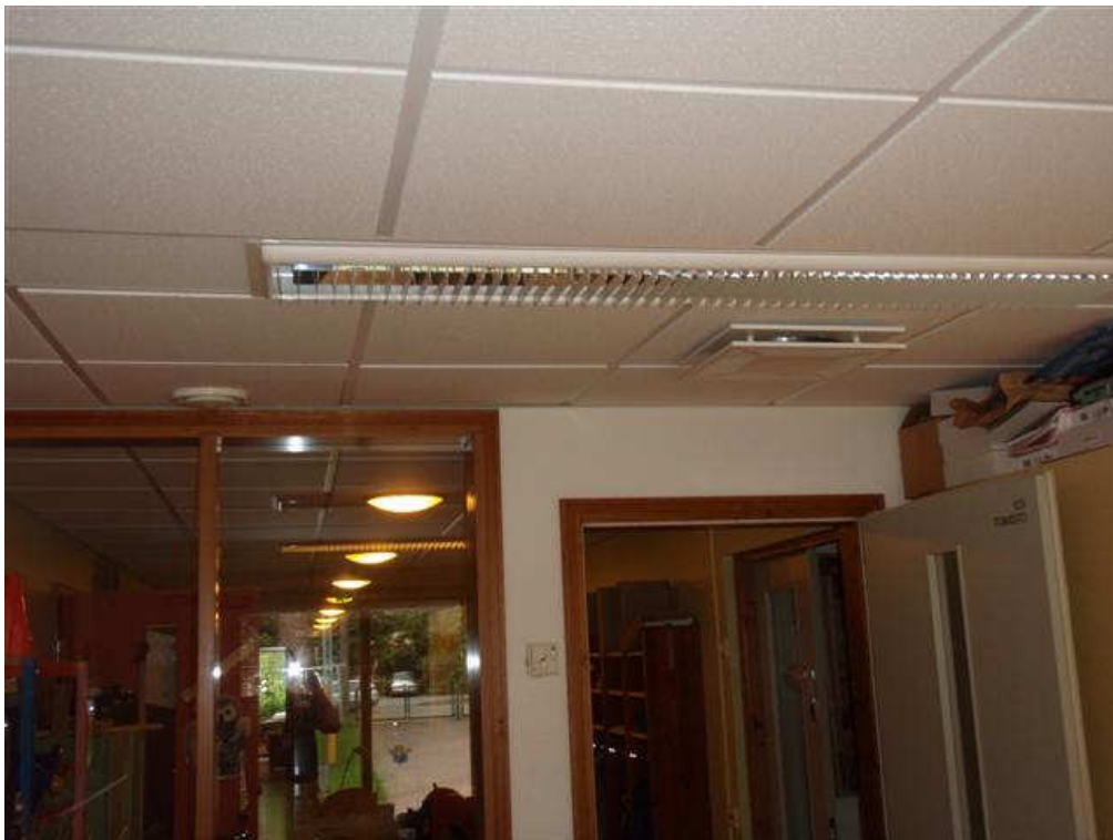
Kuva 5. Tulo- ja poistoilman pääte-elimet asennettu liian lähelle toisiaan.
