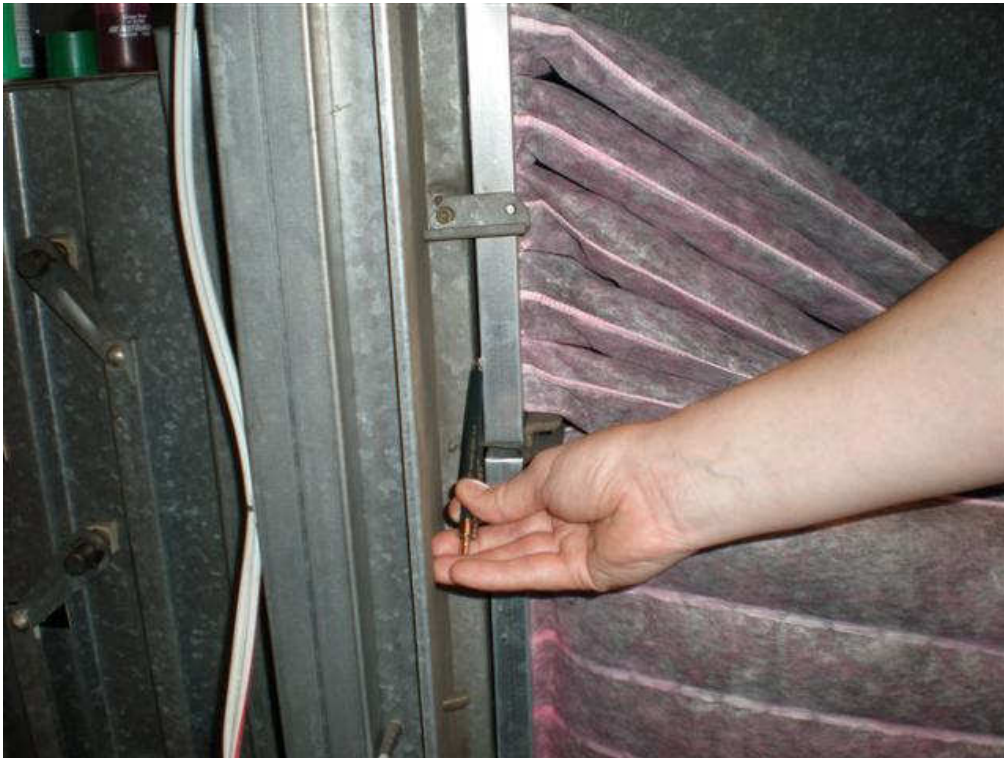
Kuva 3. Tulosuodattimet eivät ole tiiviisti kiinni suodatinkehysessä.
