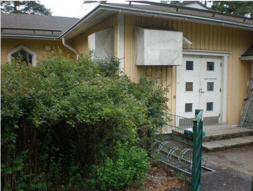
Kuva 1. Tulokoneen raitisilmasäleiköt, toinen osittain pensaiden tukkima.
