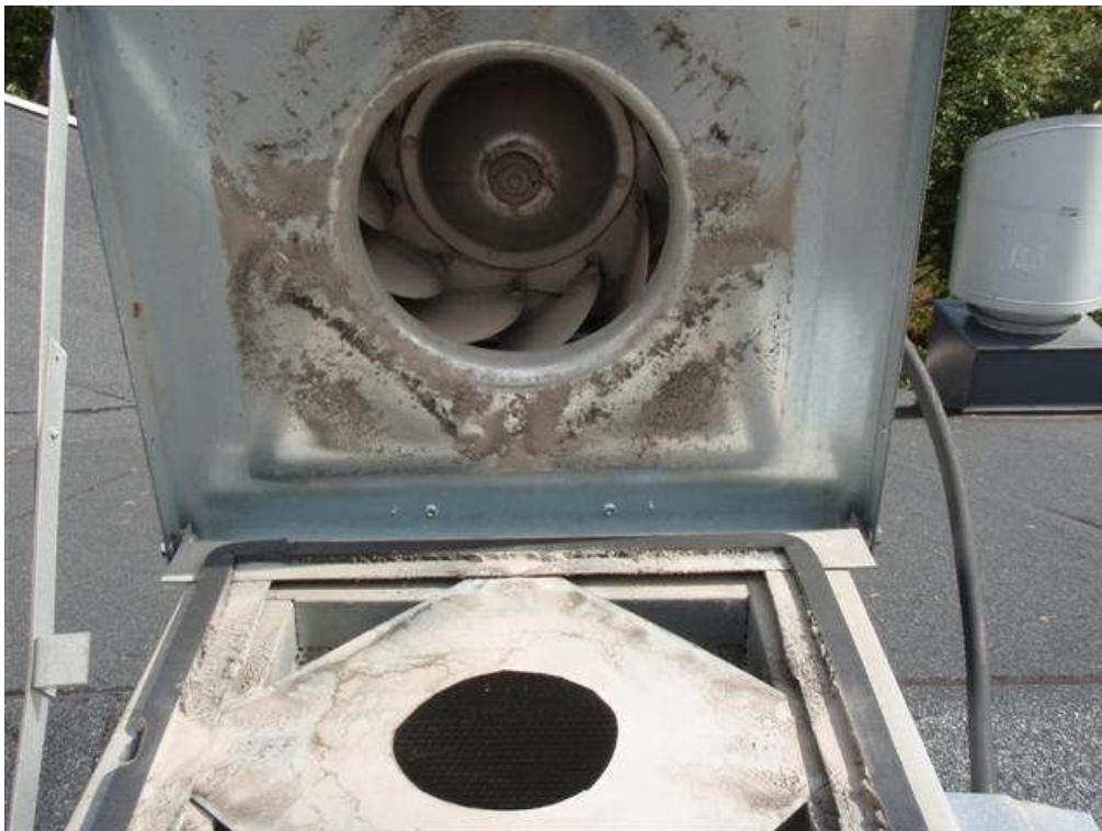
Kuva 8. Huippu-imuri PK3 PF01 puhdistuksen tarpeessa.
