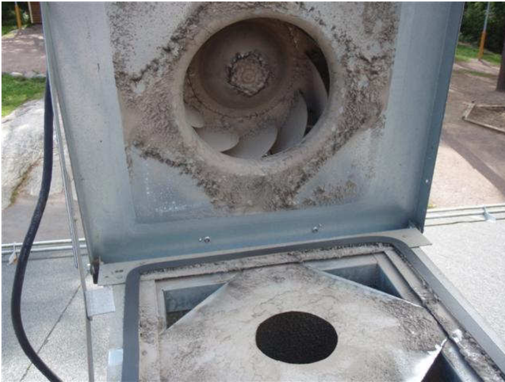
Kuva 7. Huippu-imuri PK2 PF01 puhdistuksen tarpeessa.
