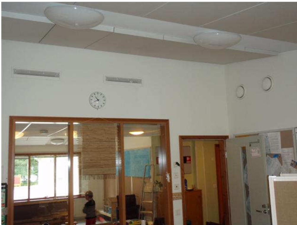
Kuva 6. Tulo- ja poistoilman pääte-elimet asennettu liian lähelle toisiaan.
