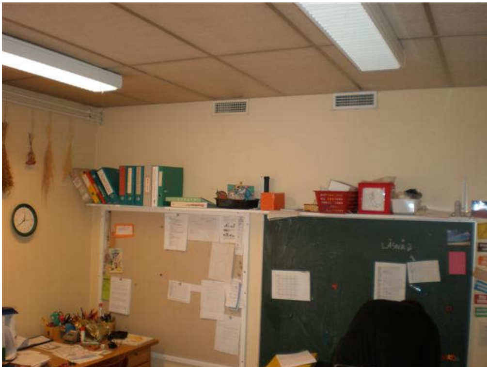
Kuva 4. Tulo- ja poistoilmasäleiköt asennettu lähelle toisiaan.
