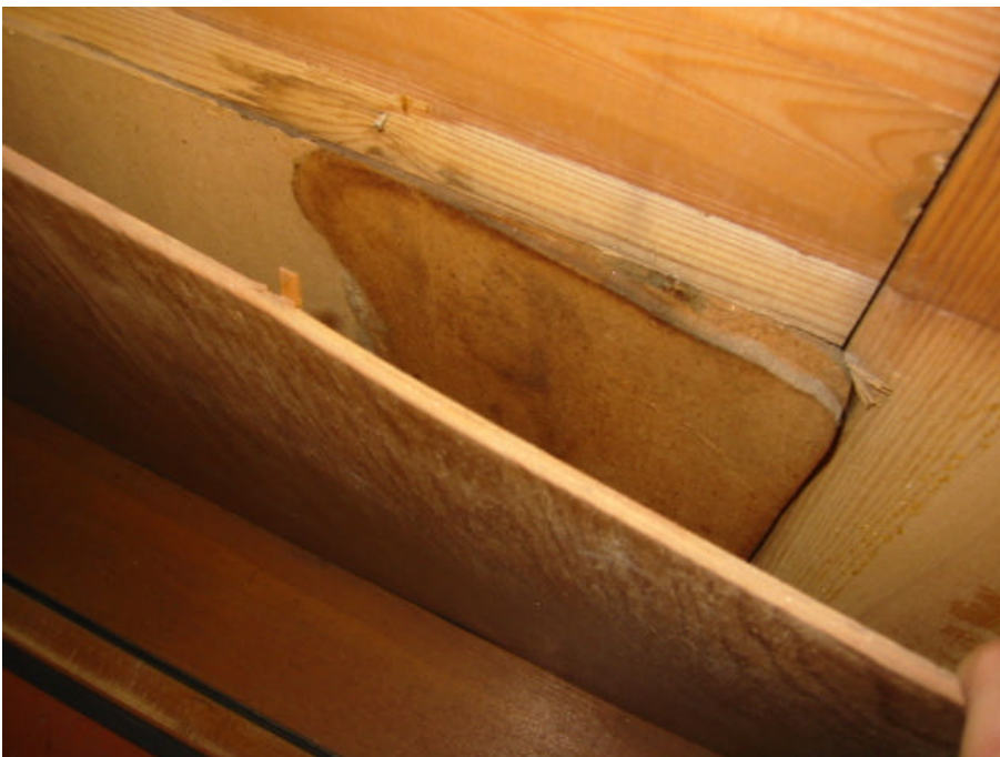
Kuva 10 Vuodon tai yläpuoliseen ikkunaan tiivistyneen kosteuden ovirakenteeseen synnyttämä kosteusjälki.
