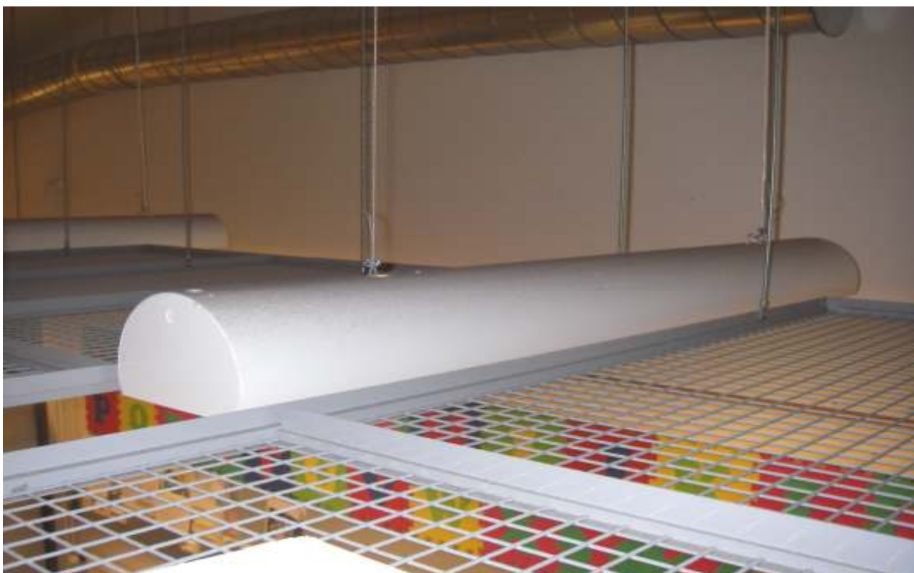
Kuva 6. Lamppujen päällä on pölykertymää.
