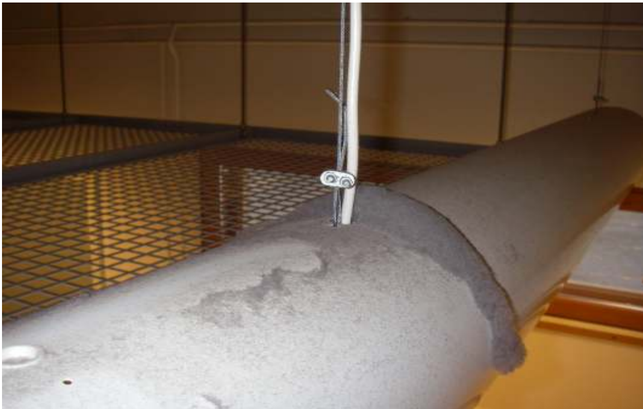
Kuva 5. Lamppujen päällä on melko paljon pölykertymää.
