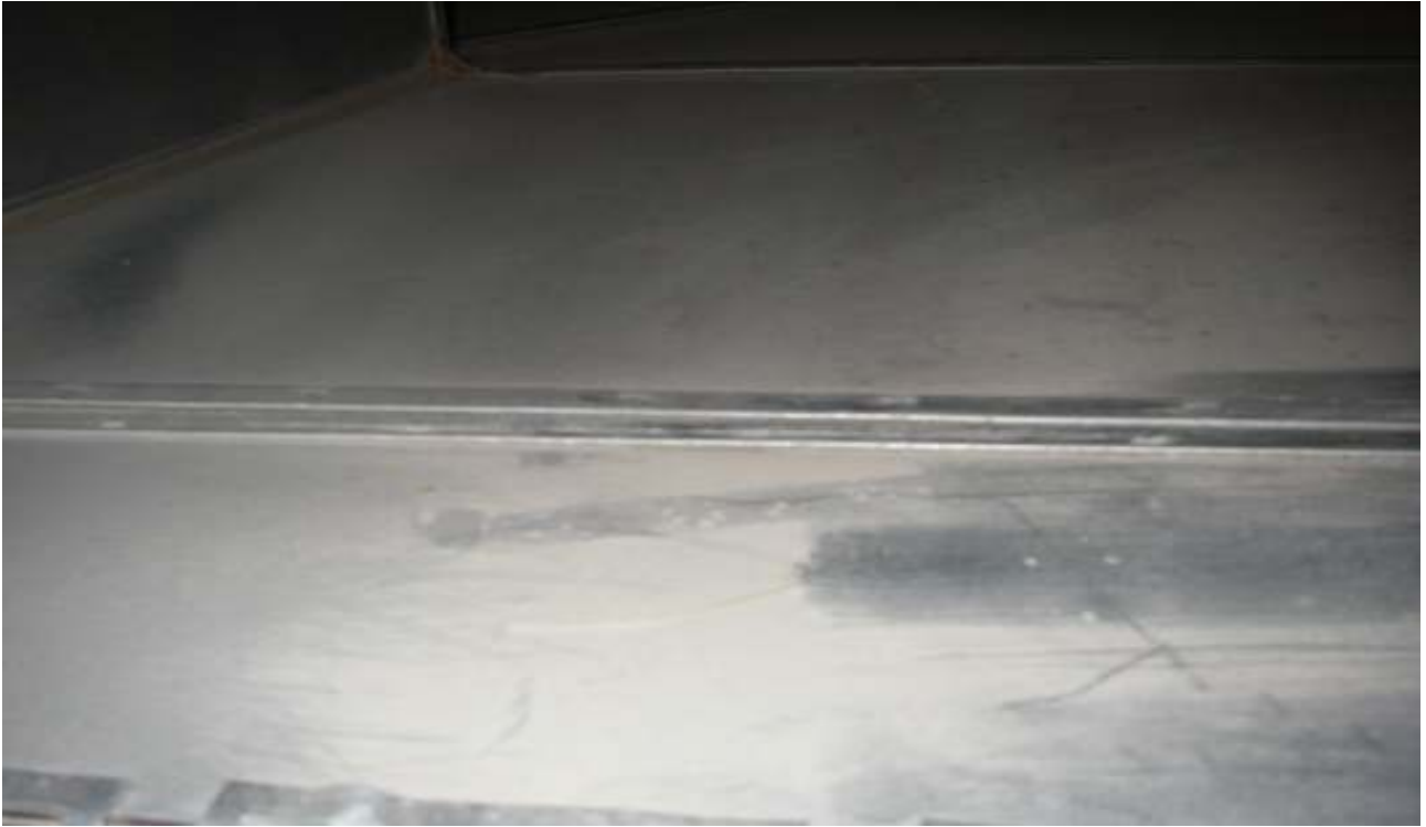
KUVA 1. Poistoilmakanavissa on hieman pölykertymää.
