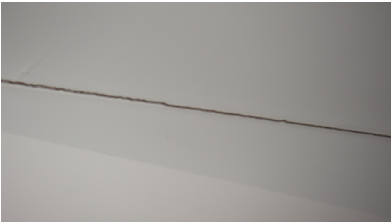
KUVA 4. Seinä- ja kattorakenteiden saumoissa on halkeamia.
