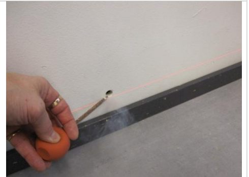
Kuva 8. Päätyseinässä olevan reiän kautta tuli vuotoilmaa voimakkaasti sisäänpäin.
