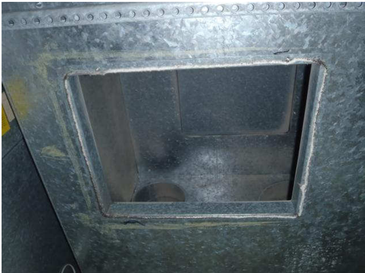
Kuva7. Tarkistusluukun tiivisteenä käytetty asbestinauhaa.
