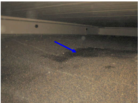
Kuva 6 Riittämätön kapillaarikatko. Hienoainesta sisältävä karkea sepeli on kastunut. Vasemmalla on tuuletusputkia.
