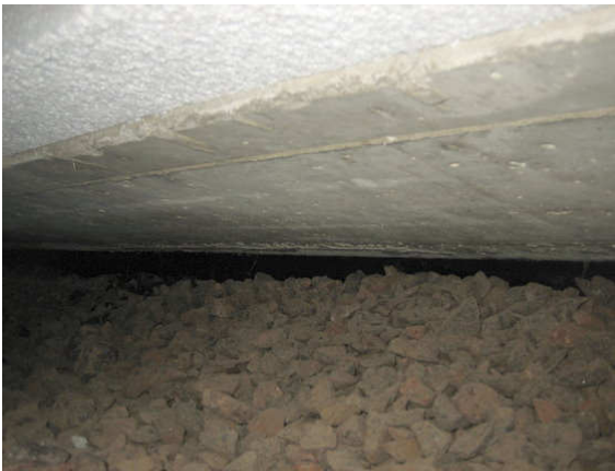
Kuva 11 Sokkeli-elementin takana on tyhjää tilaa.
