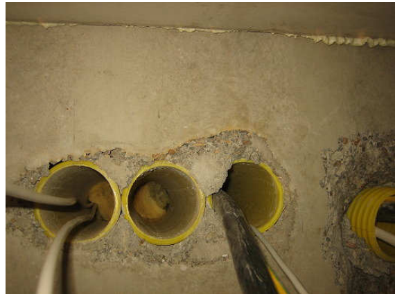
Kuva 10 Ontelolaatan sähköläpivientejä ei ole tiivistetty.
