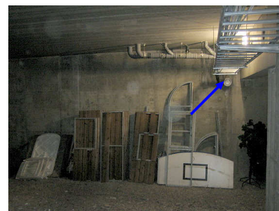
Kuva 12 Putkikanaalin puolelta poistoilmaventtiili (nuoli) alustatilaan. Läpivienti on tiivis- tämätön.
