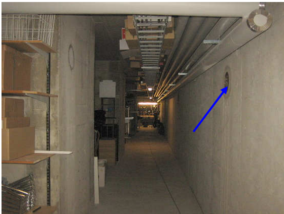
Kuva 15 Putkikanaalia rakennusosalla 1. VSS-tilat ovat vasemmalla. Oikealla teräsputkia, joissa on vaimea imu.
