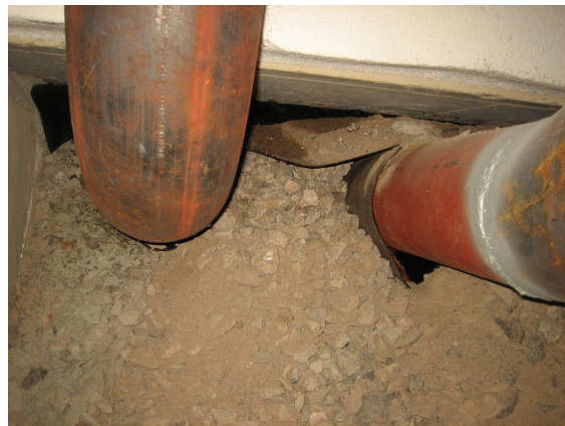
Kuva 18 Viereisessä kuvassa näkyvät putket jatkuvat alustatilan kautta sisäpihan suuntaan.
