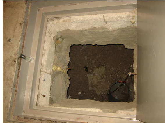
Kuva 2 Alustatilan huoltoluukku on tiivistämätön.
