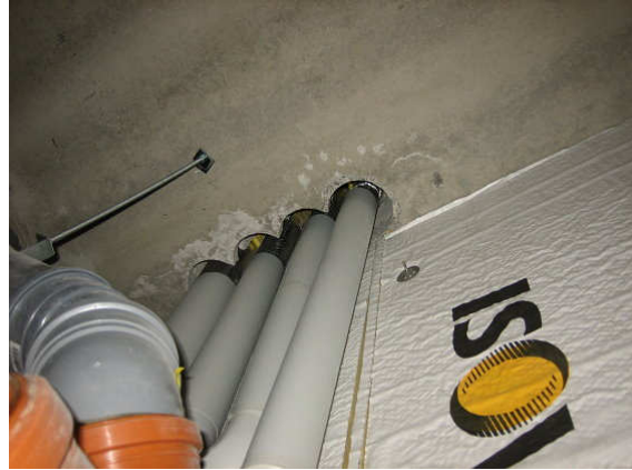
Kuva 14 Em. osalla on ontelolaatassa tiivistämättömiä läpivientejä.
