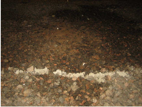
Kuva 7 Sepelin alla on kosteaa hiekkaa.
