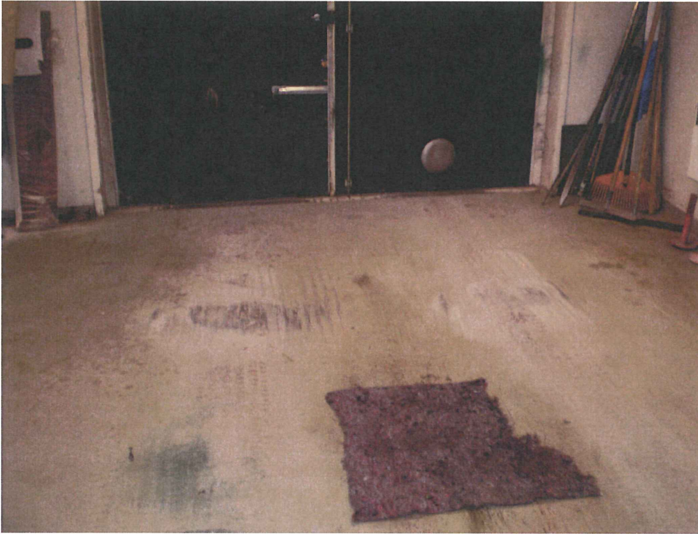
Lattian pinnoitus on kulunut traktorin ajolinjalla.
