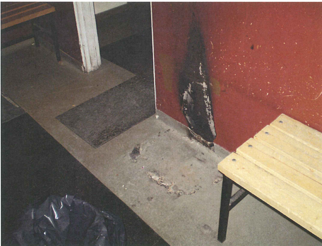
Pukutilan lattiavaurioita. Roskakori on joskus syttynyt palamaan.
