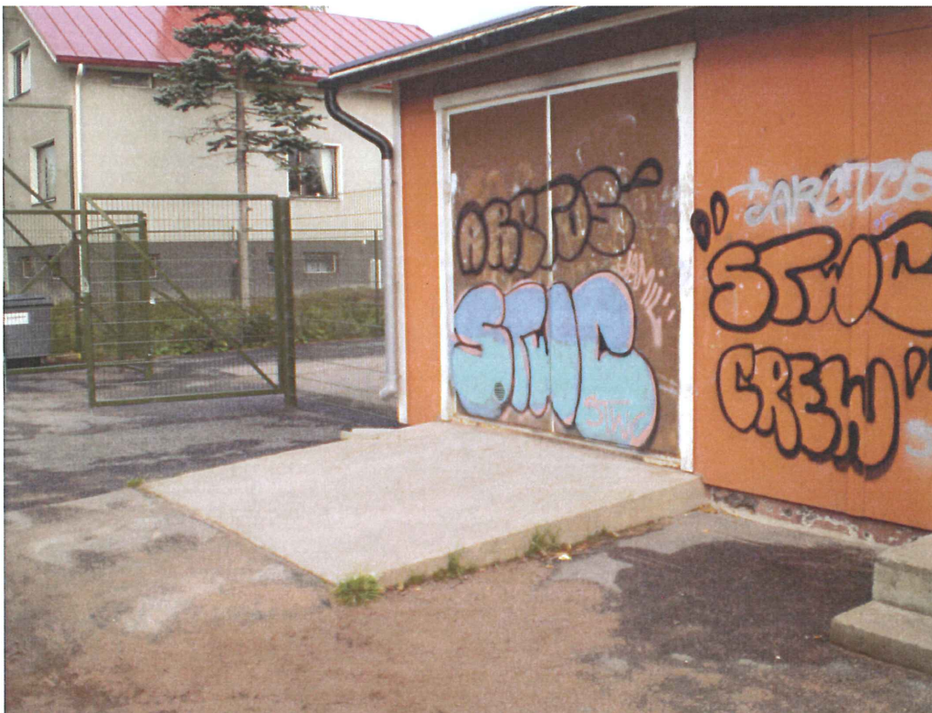
Laajennusosan talliovet ja betoniluiska. Sokkelissa rappausvaurioita.
