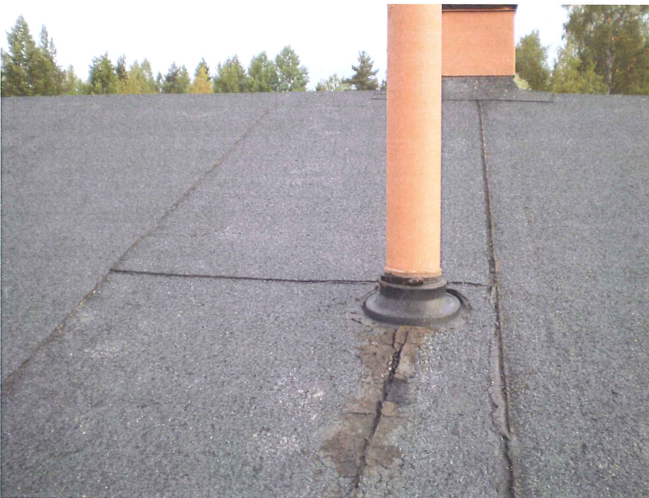
Läpiviennin kohdalla huovassa halkeama
