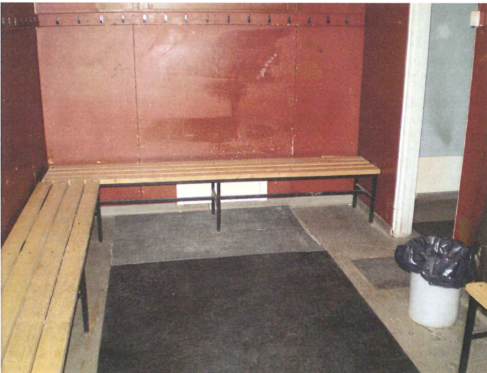
Puku- ja pesutilojen sisäpinnat ovat kuluneet.
