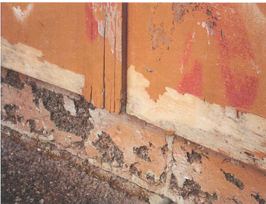
Sokkelissa rappausvaurioita. Ulkovuorivanerit ovat haristuneet ja maali on irronnut.
