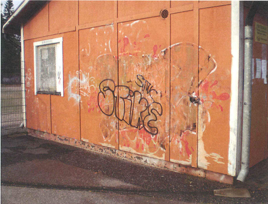
Vanhan osan pääty. Sokkelissa rappausvaurioita. Ulkovuorivanerit haristuneet, maali irronnut.
