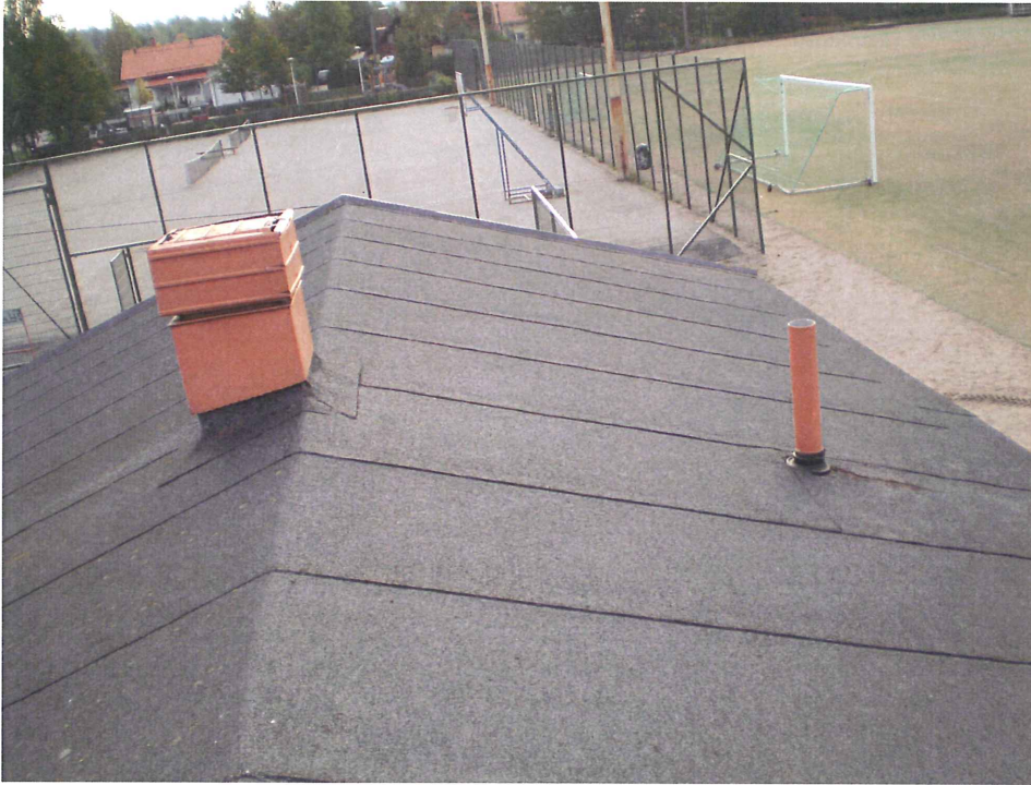
Vesikatteen kunto on pääosin tyydyttävä.
