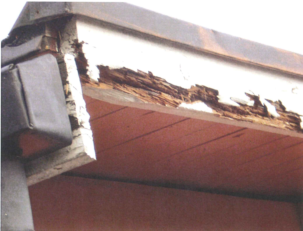
Vanhan osan päädyssä räystäslaudat ovat lahonneet.
