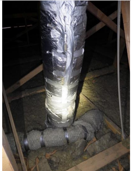
Kuva 34. Käsityöluokan varastohuoneessa olevaa putkikoteloä pitkin yläpohjaan nousevia putkia.
