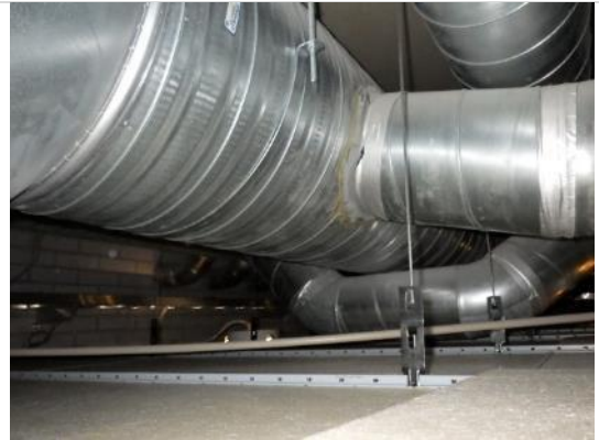
Kuva 55. Kanavien liitoksia on teipattu ilmastointiteipillä, joka ei täytä vaadittuja asetuksia.
