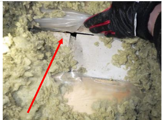
Kuva 40. Höyrynsulun ja väliseinän liittymäkohdat ovat puutteellisia. Höyrynsulku on asennettu vastaavalla tavalla koko rakennuksen alueella ja yläpohjan eristekerroksesta on ilmayhteys luokka- ja oleskelutiloihin.
