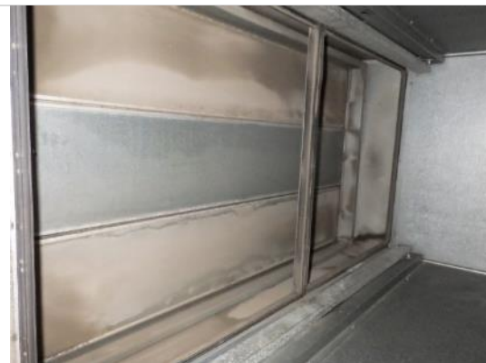
Kuva 52. Sulkupellit ennen suodattimia ovat likaantuneet.
