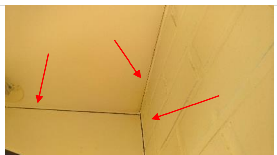
Kuva 14. Luokan 104 ja tilan 016 rakenteiden tyypillinen halkeilu tilojen yläpohjan liitoskohdissa ulko- ja väliseinärakenteisiin.
