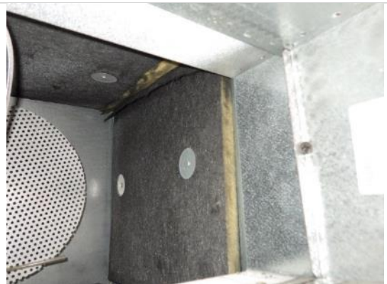
Kuva 57. Luokkien tuloilmakanavien ääniloukkujen vaimennuslevyt on tehty mineraalivillasta. Levyn reunat on jätetty pinnoittamatta.
