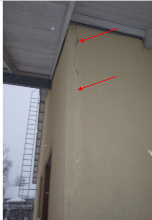
Kuva 1. Päädyn halkeama ulkokuoressa.
