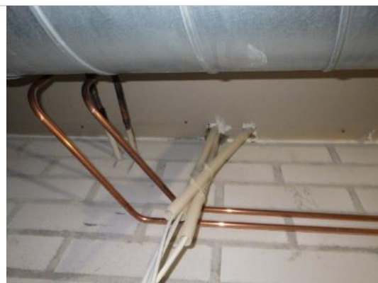
Kuva 45. Sähköjohtojen läpivienti yläpohjan puolelle. Läpivienti on tiivistetty vain osittain.
