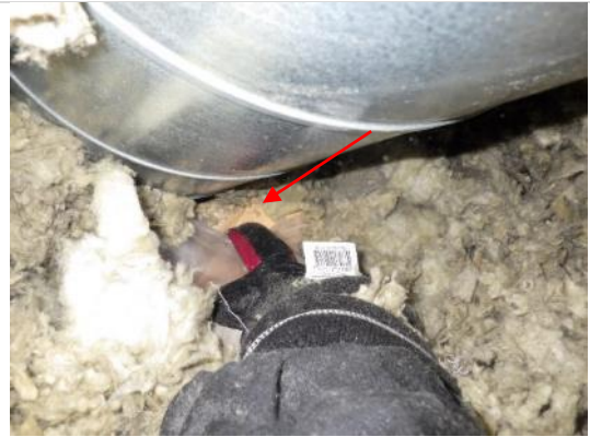
Kuva 42. IV-kanavan tiivistämätön läpivienti yläpohjan höyrynsulussa.
