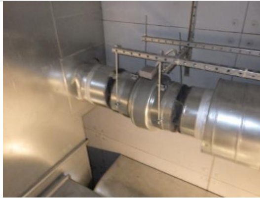
Kuva 54. Rikkoutunut kanavapuhallin, joka korjattiin tutkimusten jälkeen.
