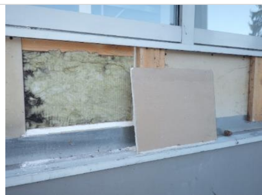
Kuva 8. Tuulensuojalevy poistettu. Levyn saumakohdassa mineraalivillan pinnassa ilmavuo- tojälkiä.
