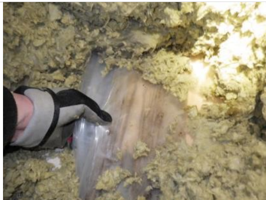
Kuva 39. Höyrynsulkumuovi on auki veden valumakohdassa.
