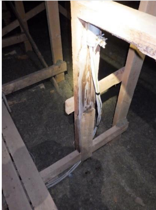
Kuva 41. Antennin runkoputken alla oleva kosteusvaurio.
