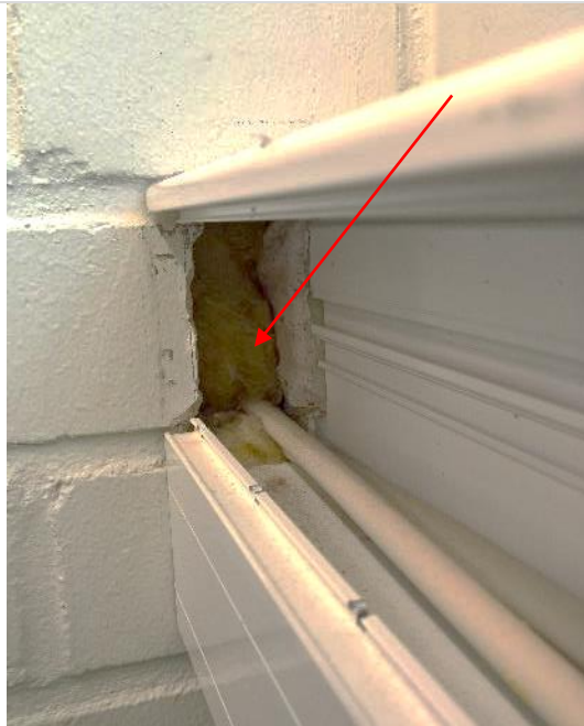
Kuva 15. Luokkien välillä kulkee sähkökouru, jonka sisällä on ääneneristeenä mineraalivillallaa. Villa suositellaan poistettavaksi ja ääneneriste korvataan pölyättömällä tiivistystuotteella.
