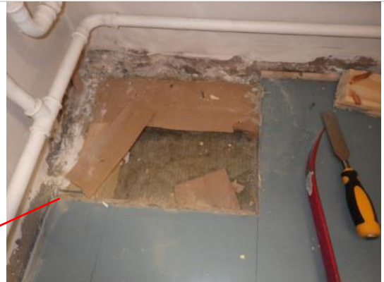
Kuva 59. Lattialaudoituksen ja seinän välistä on ilmayhteys huonetilaan.
