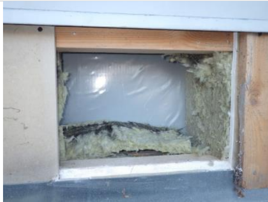
Kuva 9. Sisäpuolen pellin ja mineraalivillan välissä on rakennepiirustuksesta poiketen höyrynsulkumuovi.
