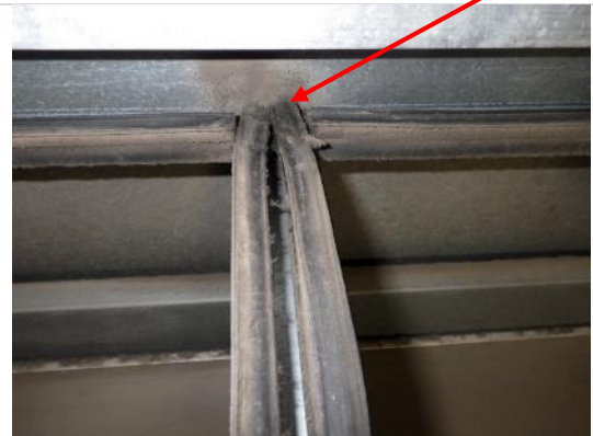
Kuva 49. Ohivuotokohta suodatinkasettien välissä.
