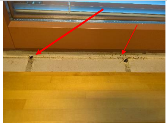
Kuva 10. Sisäpuolen tarkastuksessa todettiin mm. ikkunapenkin alla olevan rakoja suoraan eristekerrokseen, josta virtasi ilmaa sisälle.
