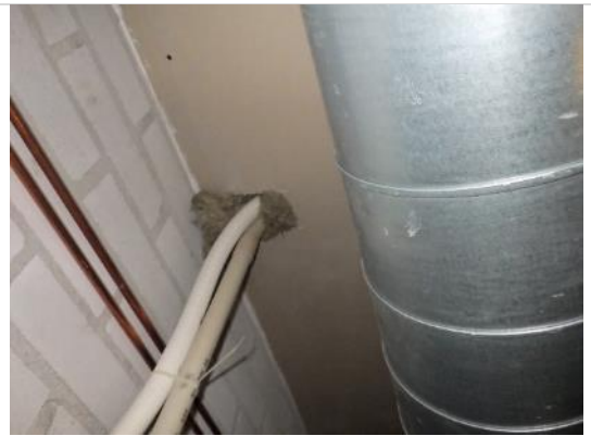
Kuva 44. Yläpohjan liitos sähköputkien läpivientien kohdalla epätiivis ja villapölyllä leviämismahdollisuus alakattotilan kautta myös sisäilmaan.
