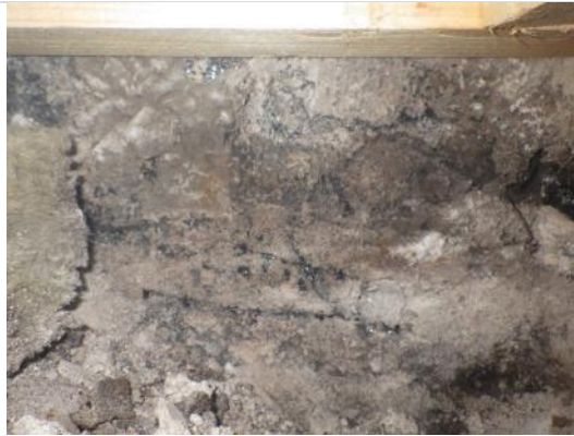
Kuva 62. Alapohjan pohjalla ja osin seinälle nostossa olevan pikisively on kovettunut ja rikkoutunut.
