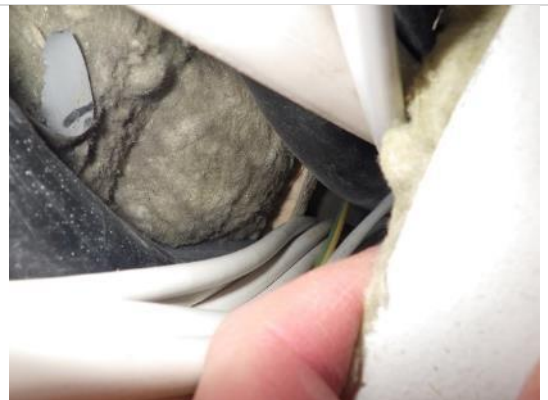
Kuva 28. Läpivientiä ei ole tiivistetty ja sen on täytetty mineraalivillalla
