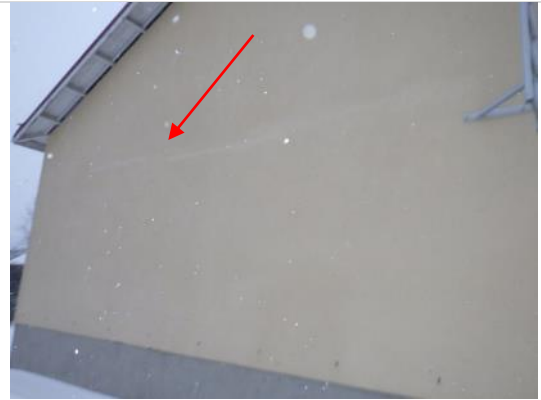
Kuva 2. Päädyn vaakahalkeamia paikkakorjattu aikaisemmin.
