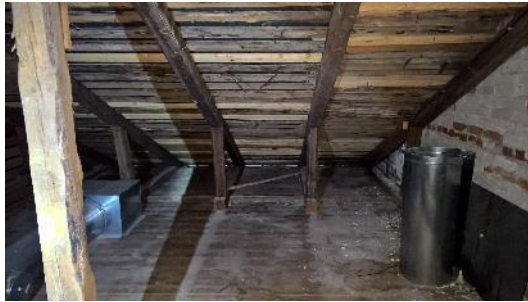
Kuva 68. Yläpohjatilan tuulettuminen puutteellista räystääiden kautta.
