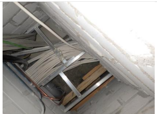
Kuva 30. Varastossa olevan IT-jakokaapin yläpuolella on paljasta mineraalivillaa.
