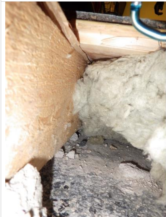
Kuva 67. Laatan pinnalla oleva pikisively on kovettunut ja rikkoutunut.
