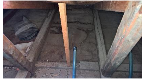
Kuva 69. Eristekerroksen ja palopermannon päällä levyrakenteissa kosteusjälkiä runsaasti.
