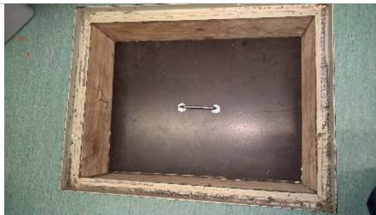
Kuva 25. Ryömintätilan käyntiluukku, jossa puuteita tiivistyksessä ja käyttöturvallisuudessa.
