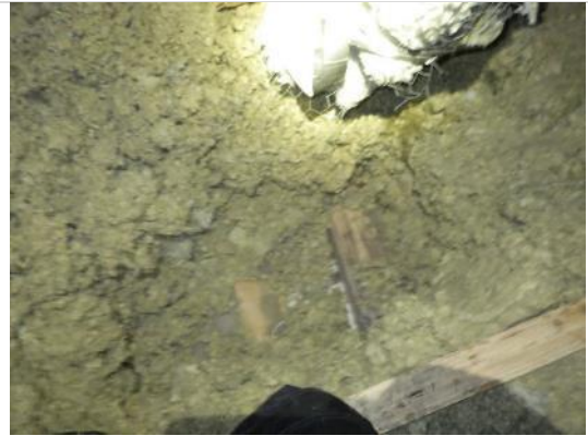
Kuva 38. Putken alapuolella olevassa koolauksessa näkyy kosteusvauriojälki.
