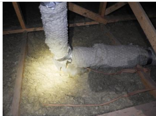
Kuva 36. Putken ulkopintaa pitkin on valunut vettä eristekerrokseen.
