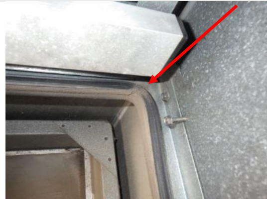
Kuva 50. Ohivuotokohta suodatinkasetin kulmassa.
