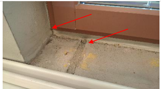
Kuva 12. Tyypik kuva ulkoseinän ja ikkunarakenteen liitoskohdan tiiveydestä. Rakenteen kautta voimakas ilmavirtaus sisälle.
