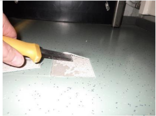
Kuva 24. Lattiamatto on tiukasti kiinni alustassaan. Osa tasoitteen pinnasta irtosi mattopalan mukana.
