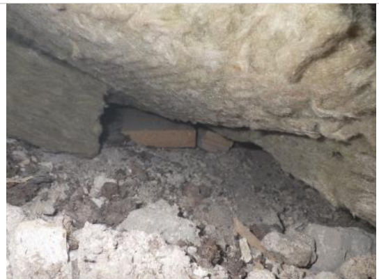
Kuva 61. Alapohjarakenteessa voimakas mikrobiperäinen ja kivihiilitervan hajua.
