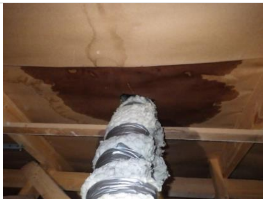
Kuva 35. Aluskate on kastunut viemärin tuuletusputken vesikatteen läpiviennin kohdalla.
