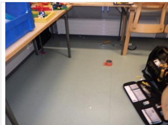
Kuva 21. Alapohjan pinnoitteen kosteuskartoitus pinnoitteen alta.
