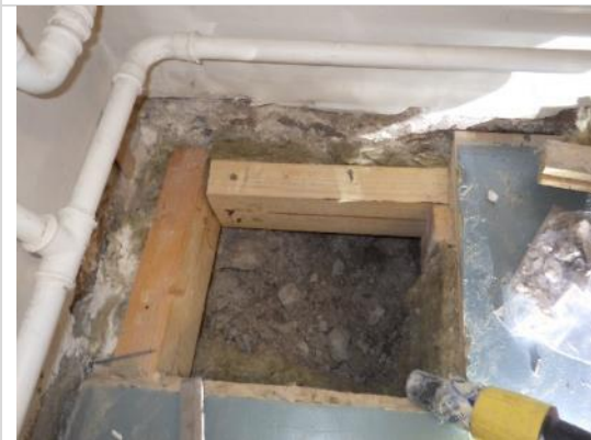
Kuva 60. Avauskohdan pohjalle on aikaisemman korjauksen yhteydessä jäänyt runsaasti vanhaa turvetta ja rakennusjätteitä.
