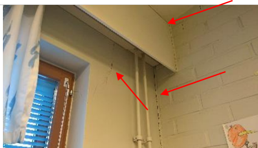
Kuva 13. Terveystoimittajan 020 tilan ulkoseinärakenteiden sisäkuoren halkeamia, joiden kautta virtasi ilmaa sisälle.
