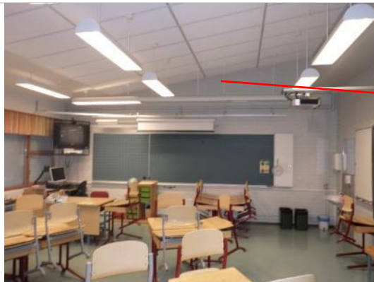
Kuva 16. Luokkien katon ja seinän rajapinnan halkeamat, joiden kautta ilmavirtaus sisälle.
