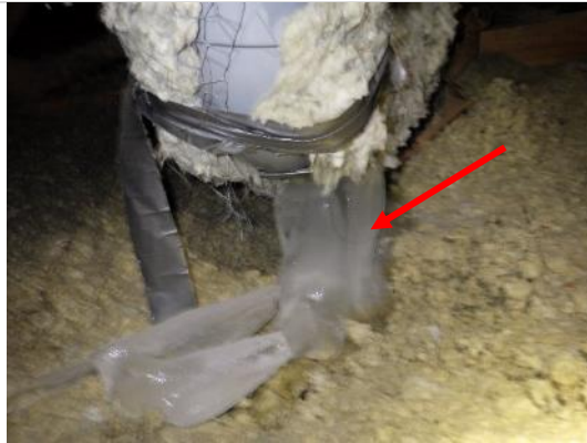
Kuva 37. Putken pintaa valunut vesi on jäätynyt.
