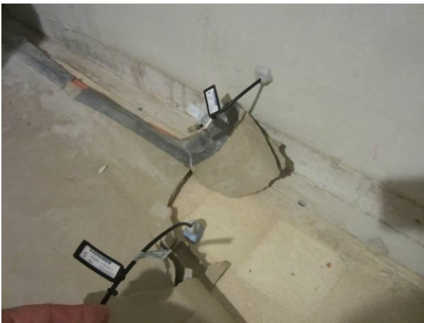
Kuva 5 Porareikämittaukset päätyseinän keskialueella PRS9 ja PRL10, jossa kosteus koholla.
