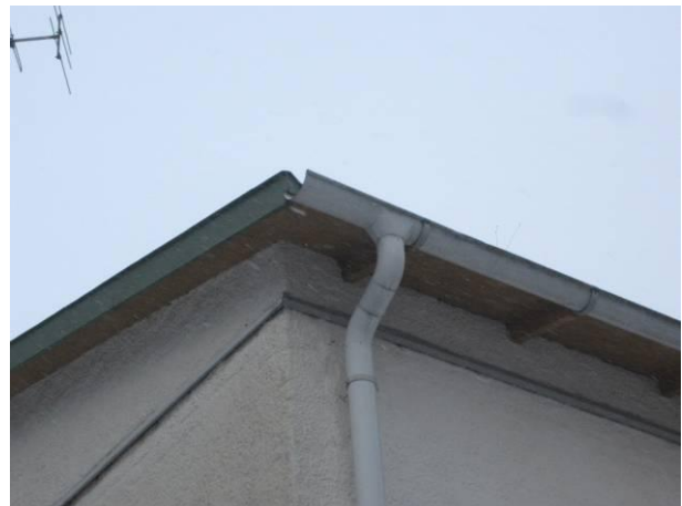
Kuva 2 Kohdehuoneen ulkokulma, jossa oli ollut vesivuotoa rännistä/ syksytorvesta. Ulkoseinän yläosalla on lisätyt listat.
