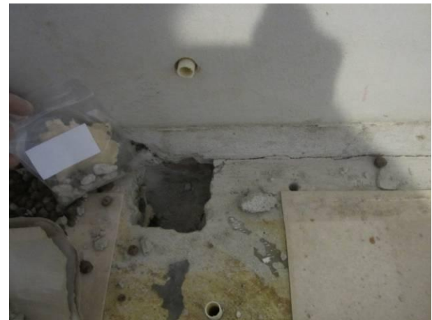
Kuva 6 Rakenneavaus PRL10 viereen ja mikrobinäyte 854-3.
