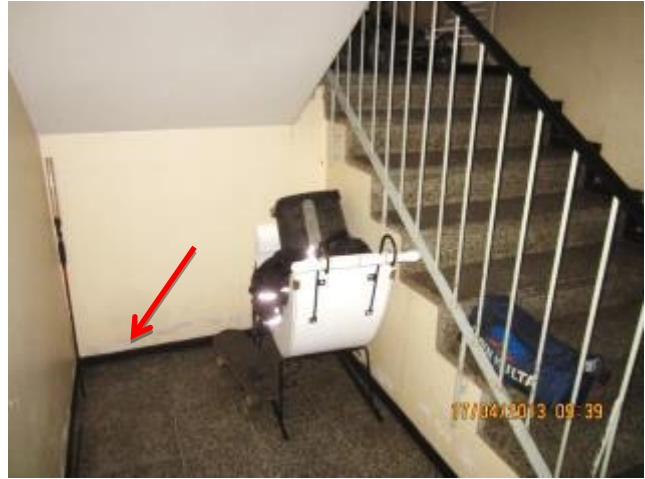
kuva 24 Kosteusjälkiä on lähinnä kellarikerroksen seinissä alaosalla, D-porrashuone.
