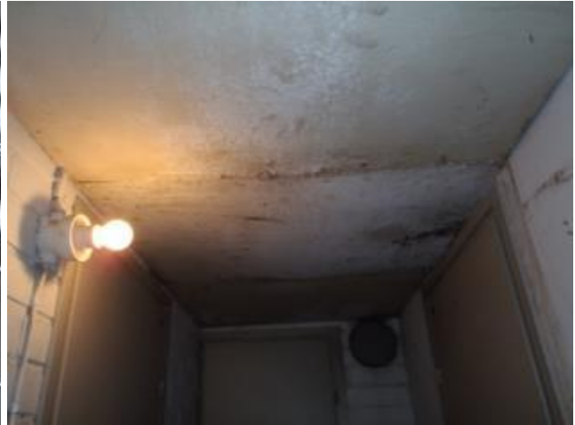
kuva 16 Kellarinvarastokäytävän lastulevyrakenteisessa välikatossa on kosteusvauriojälkiä.
