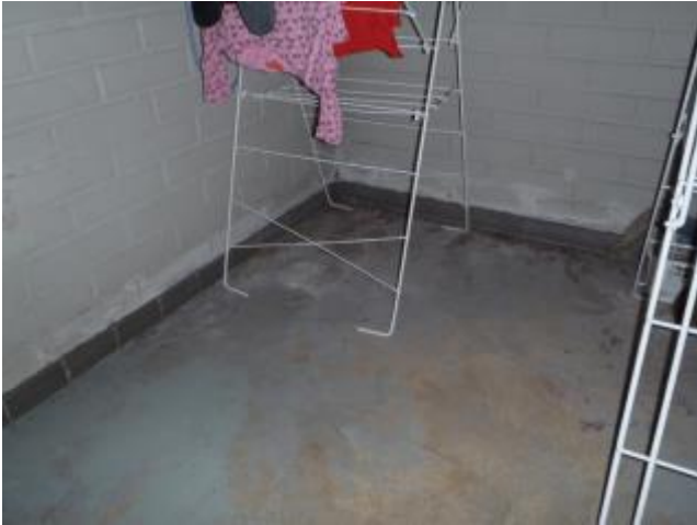
kuva 15 Kuivaushuoneen lattiassa ja seinien alaosissa on kalkkijälkiä.
