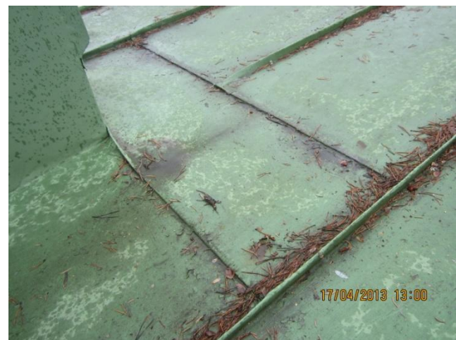
kuva 36 Vuotopaikan kohdalla olevia pellityksiä hormiryhmän yläpuolella.
