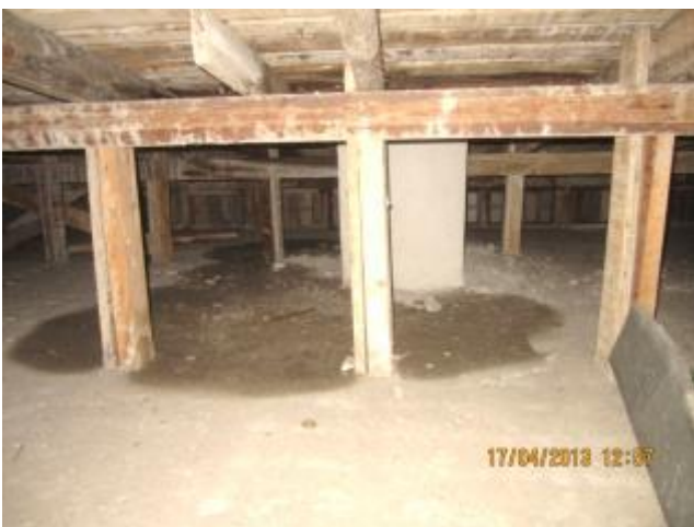
kuva 35 Vesivuotopaikan alla palopermanto on kastunut.
