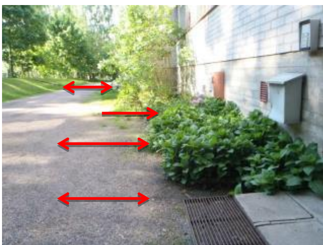
kuva 1 Yläpihan puolella on sokkelivierillä paljon pensaskasvustoa ja pintakallistukset ovat riittämättömät.
