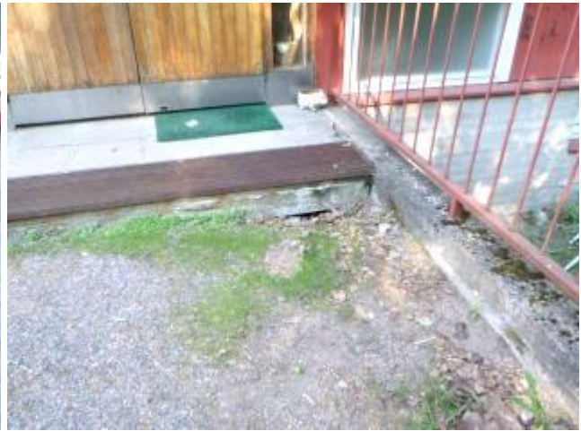
kuva 8 Sisäänkäynnin edustan maan pinta on painunut ja sadevesi on kaivertanut onkalon betonilaatan alle.
