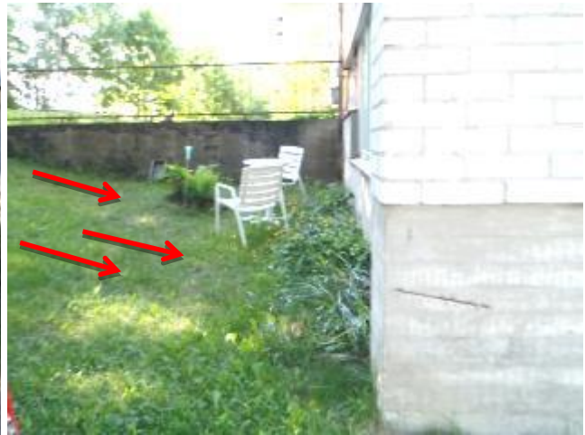
kuva 6 Pohjoispäädyn ja sisäänkäynnin välinen kulma-alue kerää kosteutta.
