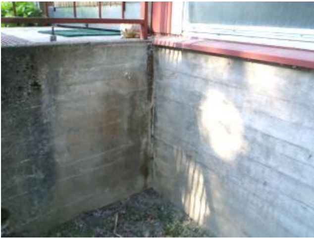
kuva 7 Ulkoportaan ja perusmuurin kulman maan pinta on painunut.
