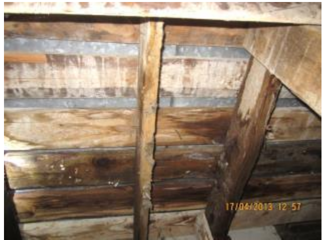
kuva 34 Ruodelaudoituksessa on selvä vesivuoto.
