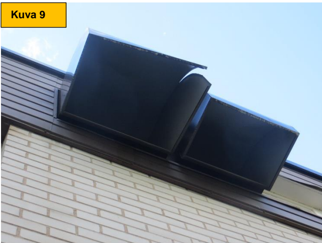
Kuva 9. Tuloilmakanavan pellitys rikki pohjoispäässä. Ks. LVI-raportti.
