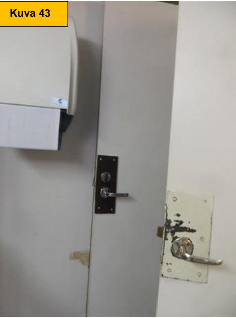
Kuva 43. WC-tilojen kevyet ovet ovat heikkokuntoisia.
