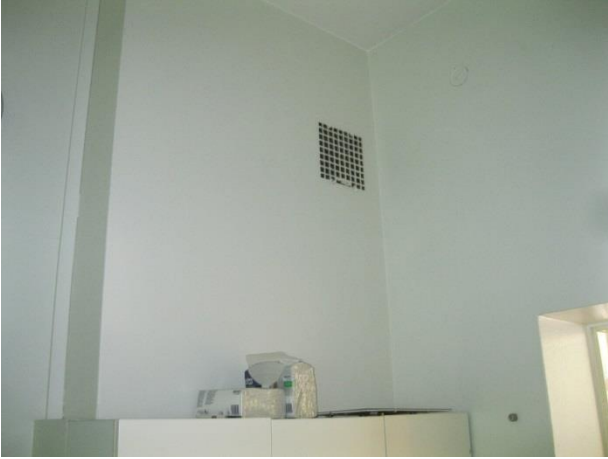
Kuva 4. Kiinteistössä osittain painovoimainen ilmanvaihto, vrt. kuvan päätelaite.
