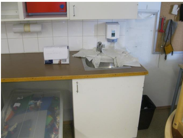
Kuva 2. Tarkastushetkellä vuotanut hana (vanha rakennus ja tyttöjen käsityöluokka).
