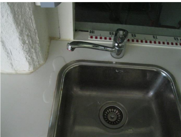
Kuva 6. Huomioitavaa, että säätämätön hana saattaa aiheuttaa vesivahingon.
