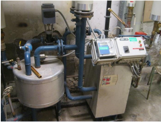
Kuva 1. Lämmönsiirtimet, mallia Parcan.
