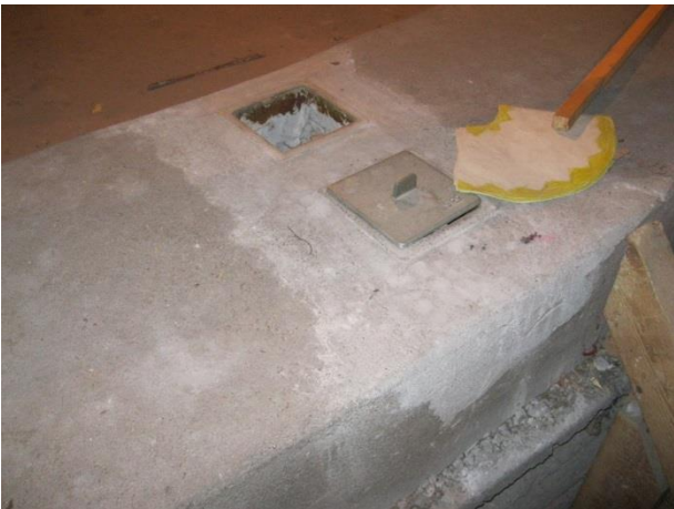
Kuva 5. Ullakolla olevasta vaakakanavasta (iv) puuttui tarkastusluukku.
