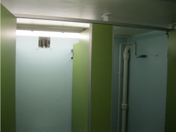
Kuva 7. WC-tilan päätelaite (iv) puuttui tarkastushetkellä.
