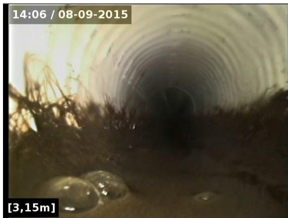
kuva 2. Kuvaus TV5_SO rakennuksen etupihan sivua, linjassa on juurikasvustoa.
