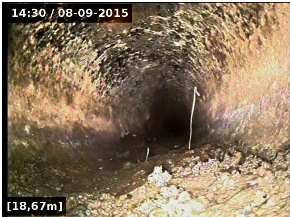
Kuva 19. Pohjaviemäriässä on runsasta kiintokertymää.
