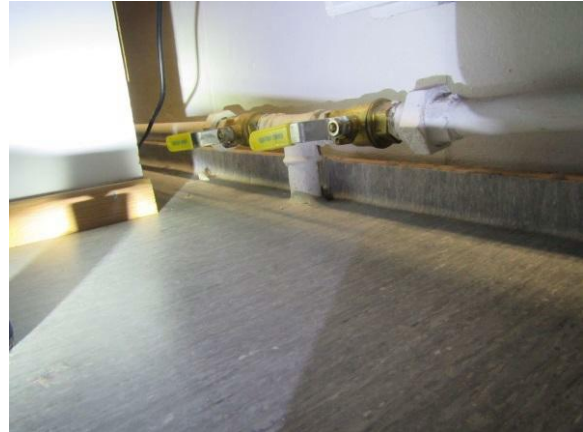
Kuva 7. Patteriverkoston sulkuventtiili 1980-luvulta.
