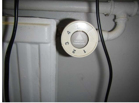
Kuva 11. Uusittu patteriventtiili (1970- luvun malli).
