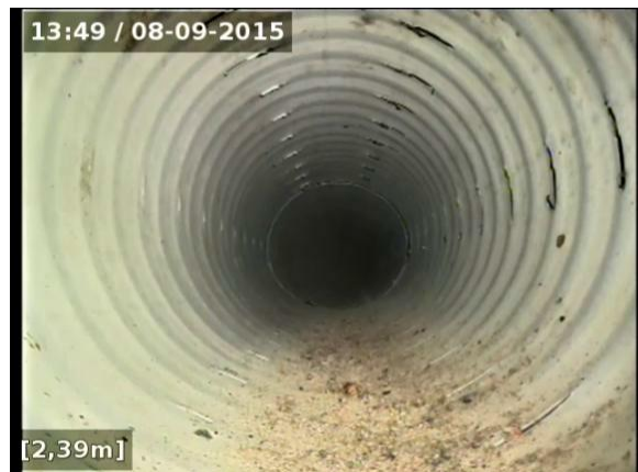
kuva 3. Muilta osin salaojissa ei havaittu toimintaa merkittävästi heikentäviä puutteita.
