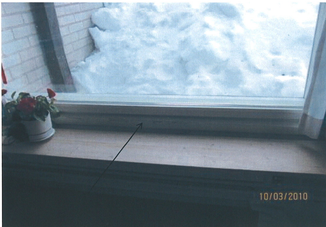
Pienen huoneen ikkunan alla kosteusvauriojälkiä
