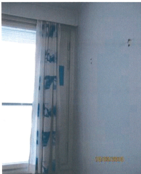
Ikkunan ja seinä välistä tullut vettä sisälle
