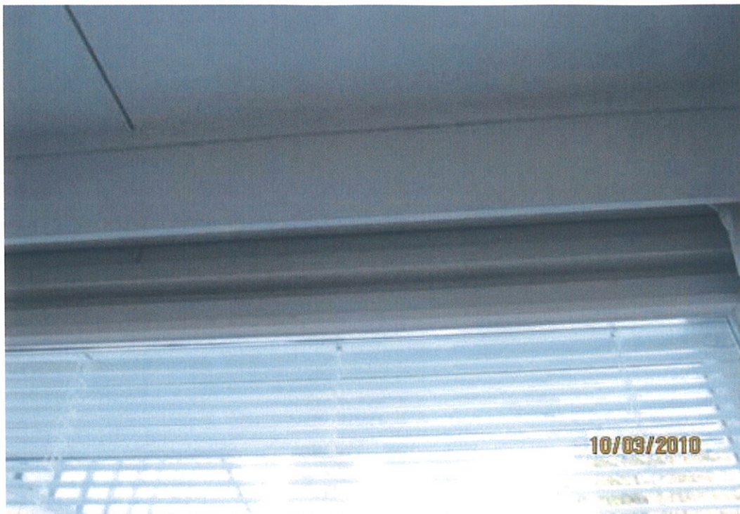
Ikkunan päältä tullut vesi sisälle
