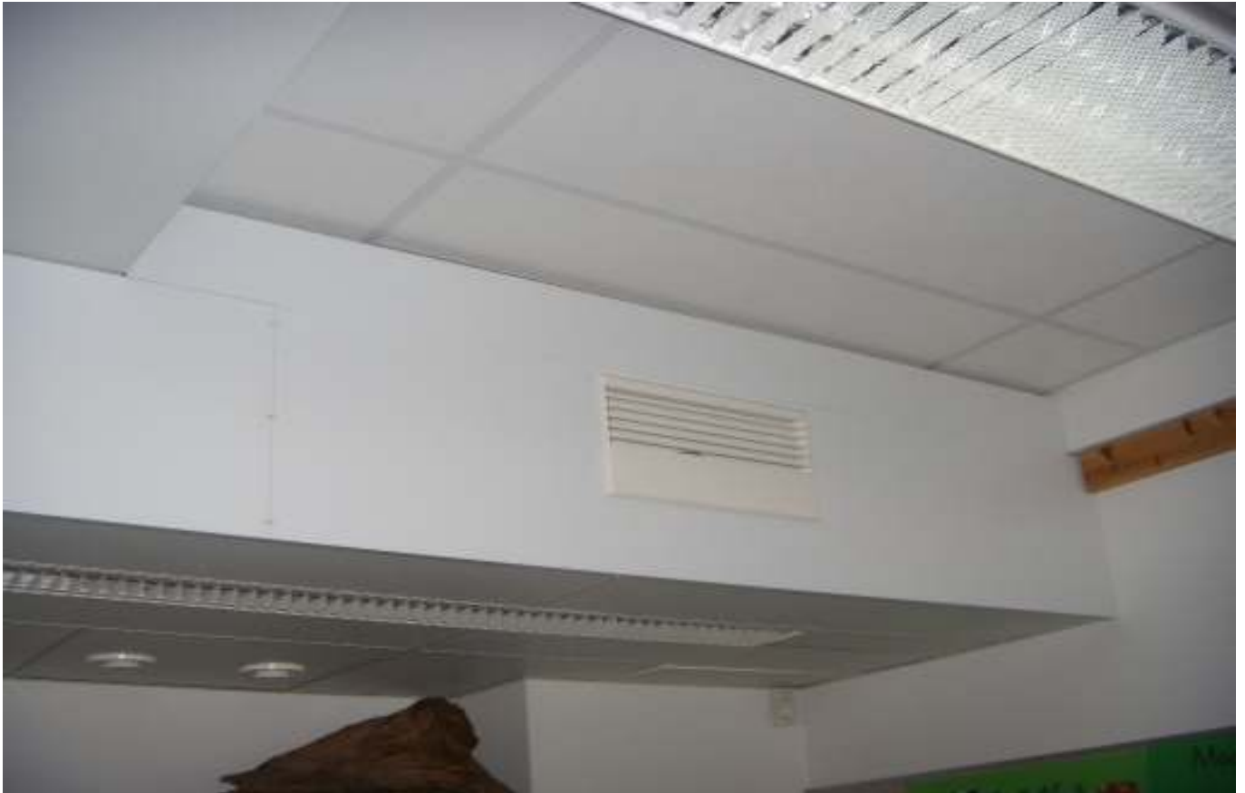
KUVA 9. Luokkatilojen tuloilmasäleiköt ovat ritiläsäleikköjä.
