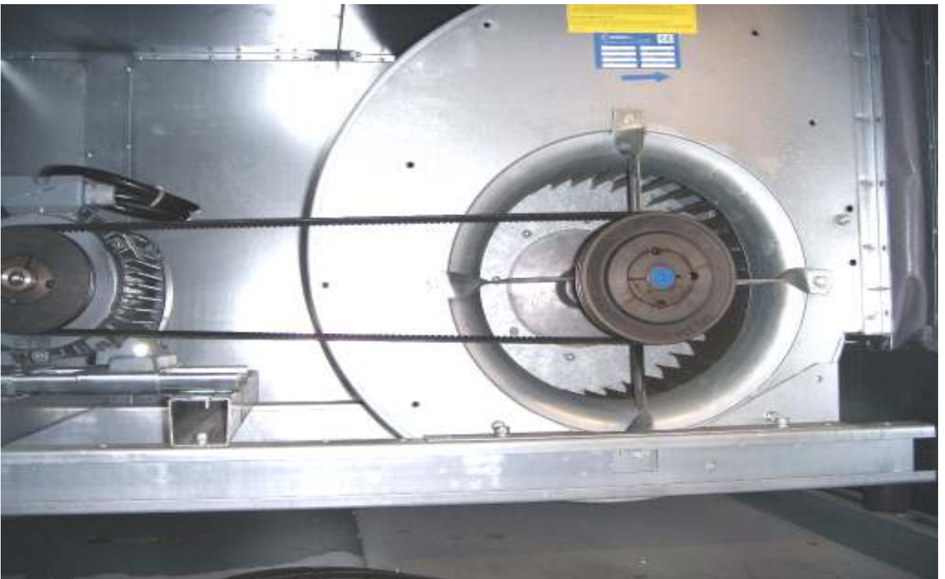
KUVA 6. Poistopuhaltimen urapyörä on hieman löysällä.
