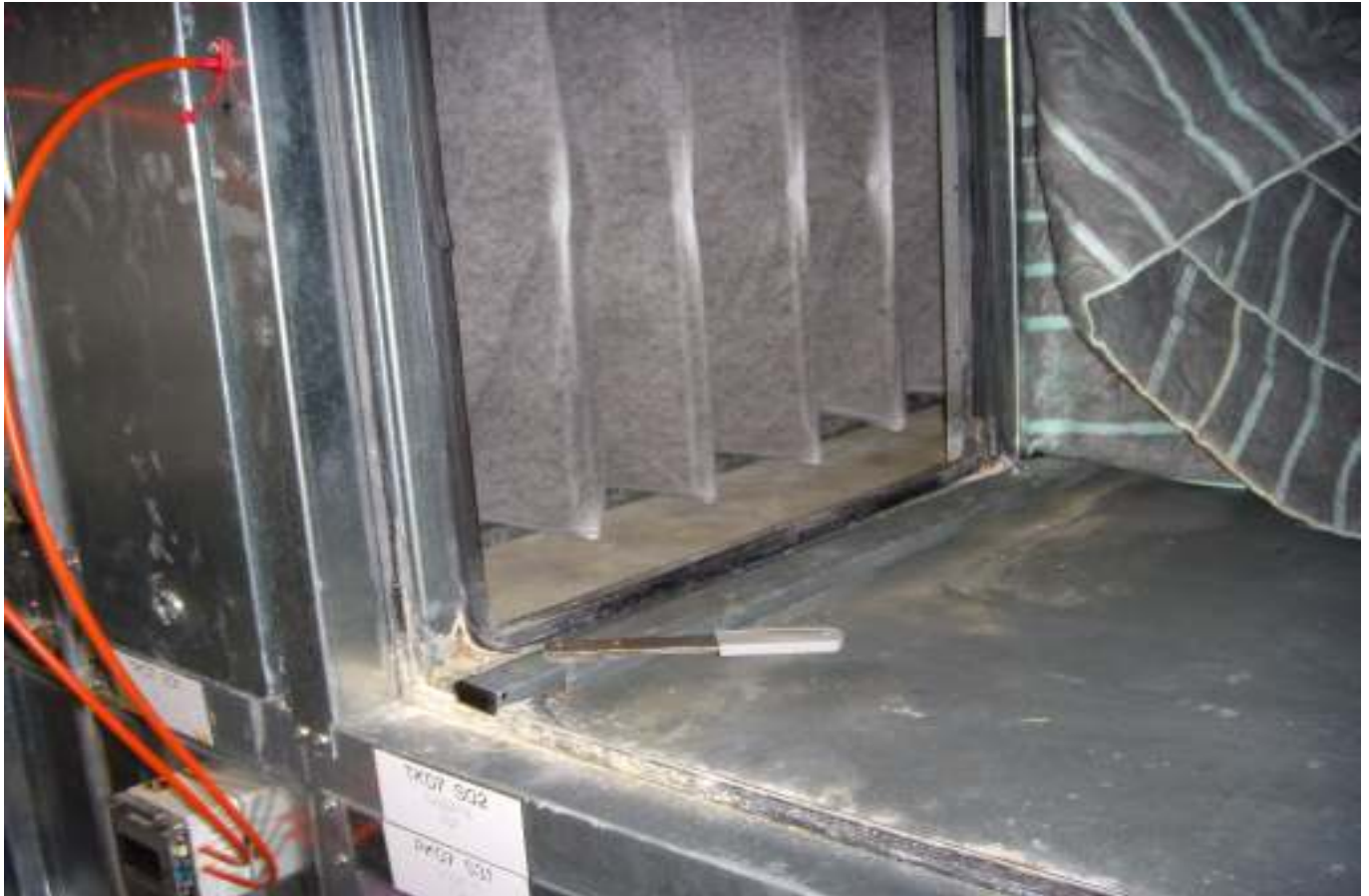
KUVA 3. Tuloilmakammio on suodattimien kohdalta likainen.
