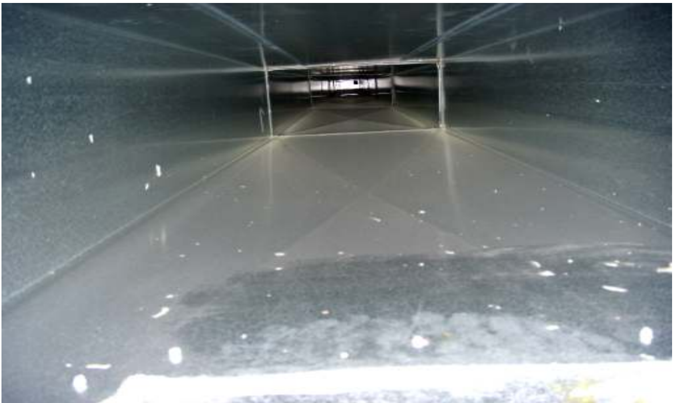
KUVA 8. Luokkien tuloilmakanavissa on hieman pölykertymää.
