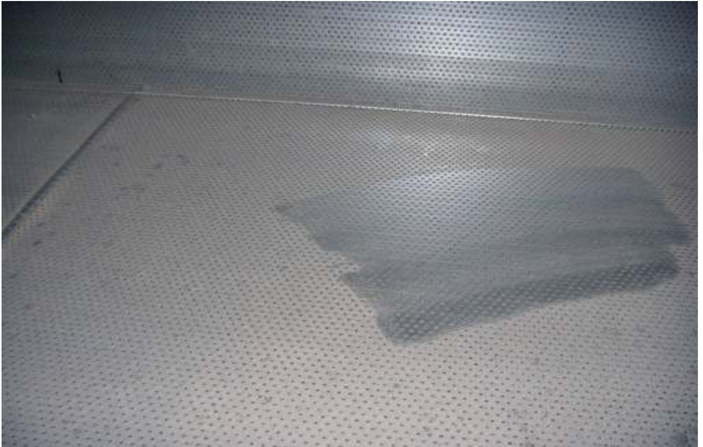
KUVA 7. Poistoilmakammiossa on hieman pölykertymää.
