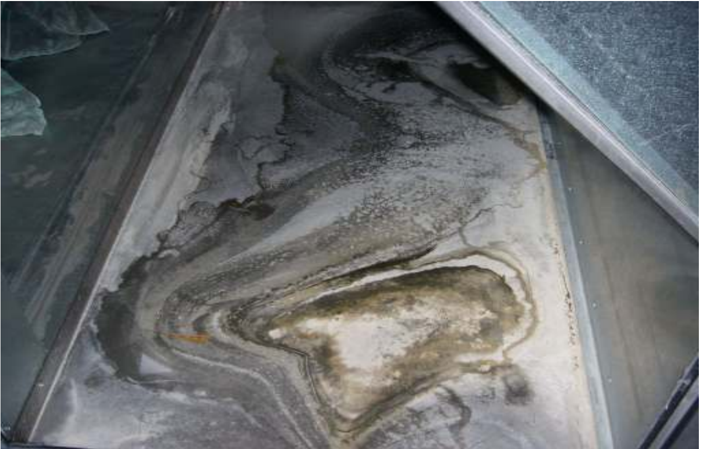
KUVA 5. LTO- kammiossa on kosteuden jättämiä jälkiä.
