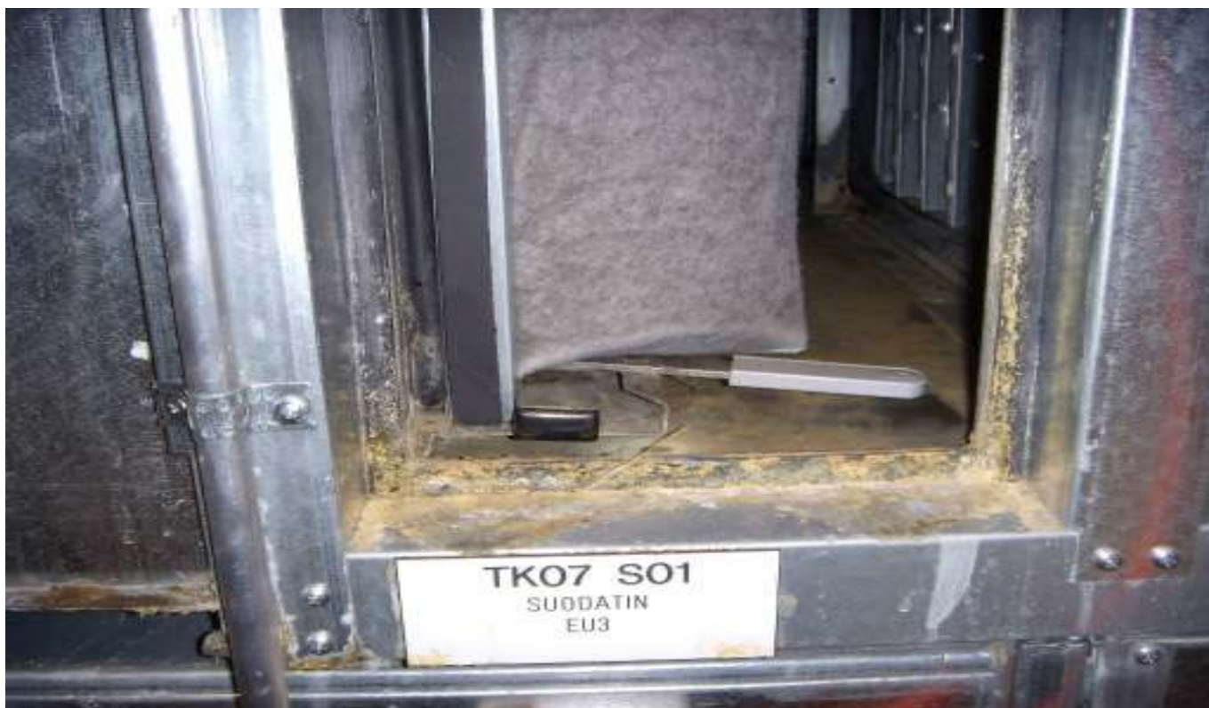
KUVA 2. Tuloilmakammio on suodattimien kohdalta likainen.
