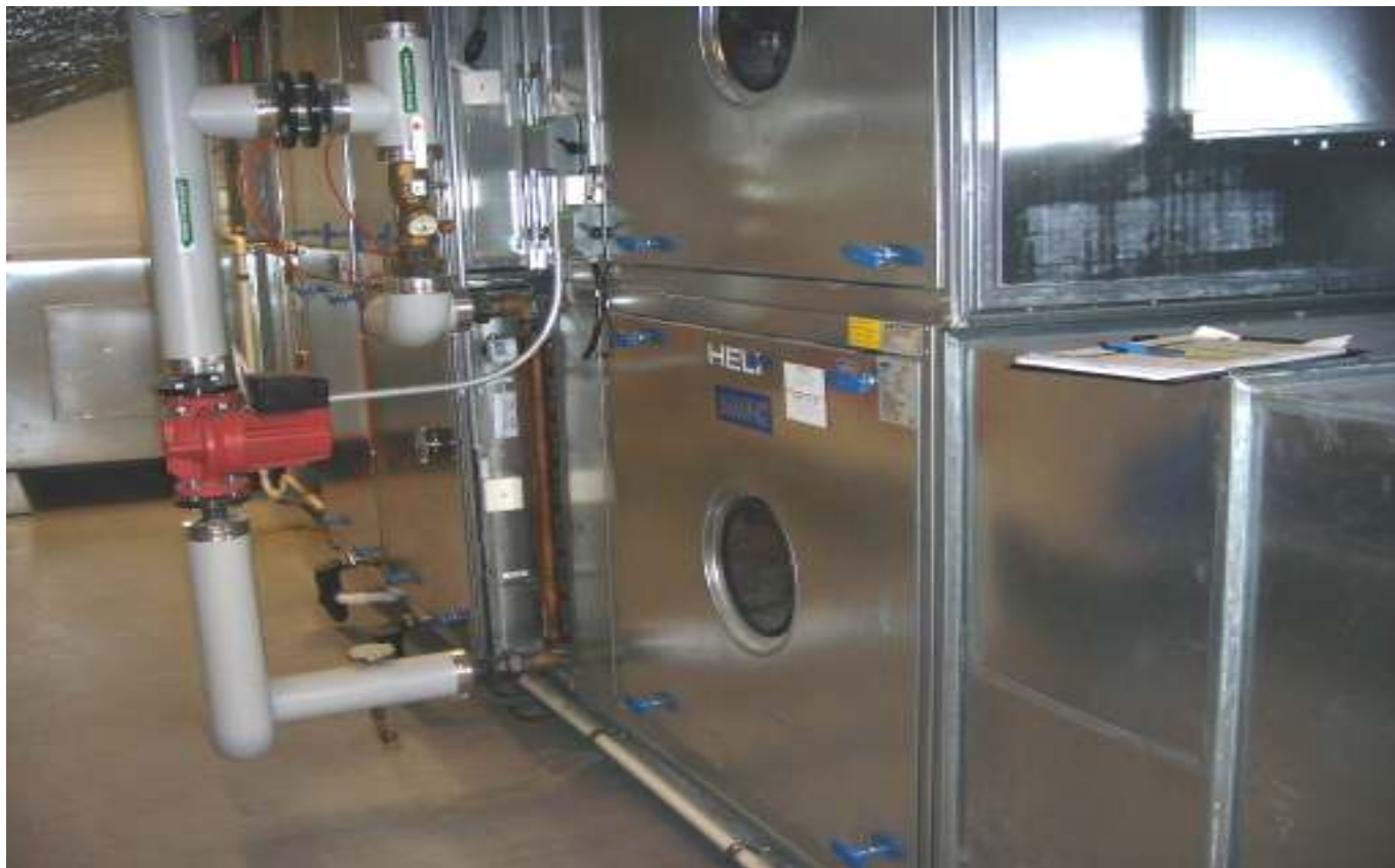
KUVA 1. Ilmastointikone on Kojan valmistama ns. pakettikone.
