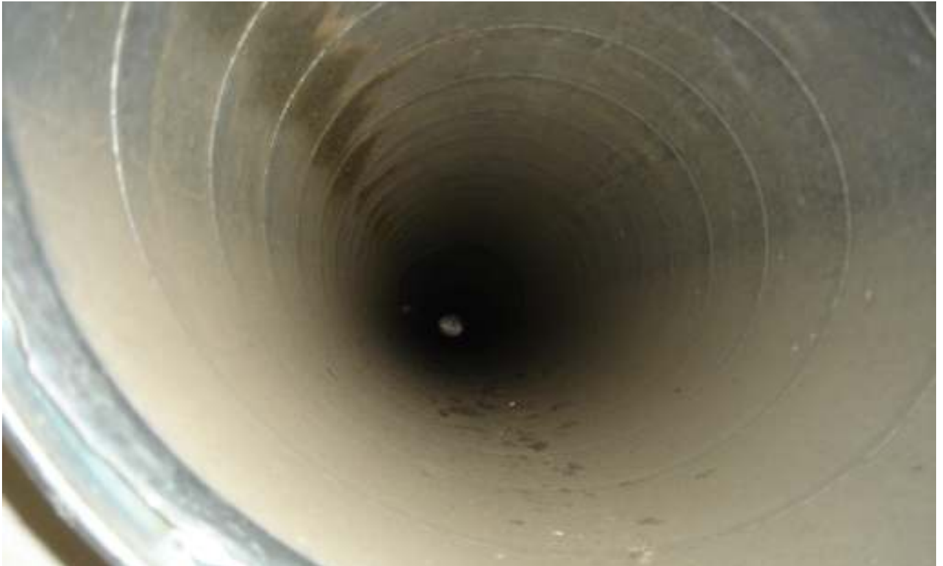
KUVA 26. Yleiskuva musiikkiluokan tuloilmakanavasta, kanava on erittäin likainen.
