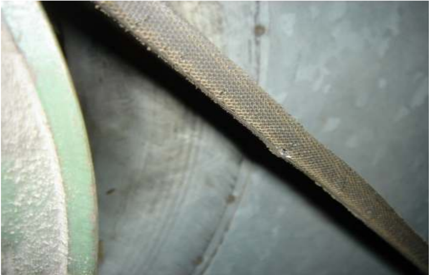
KUVA 11. Kiilahihnat ovat kuluneita ja osin murtuneita.
