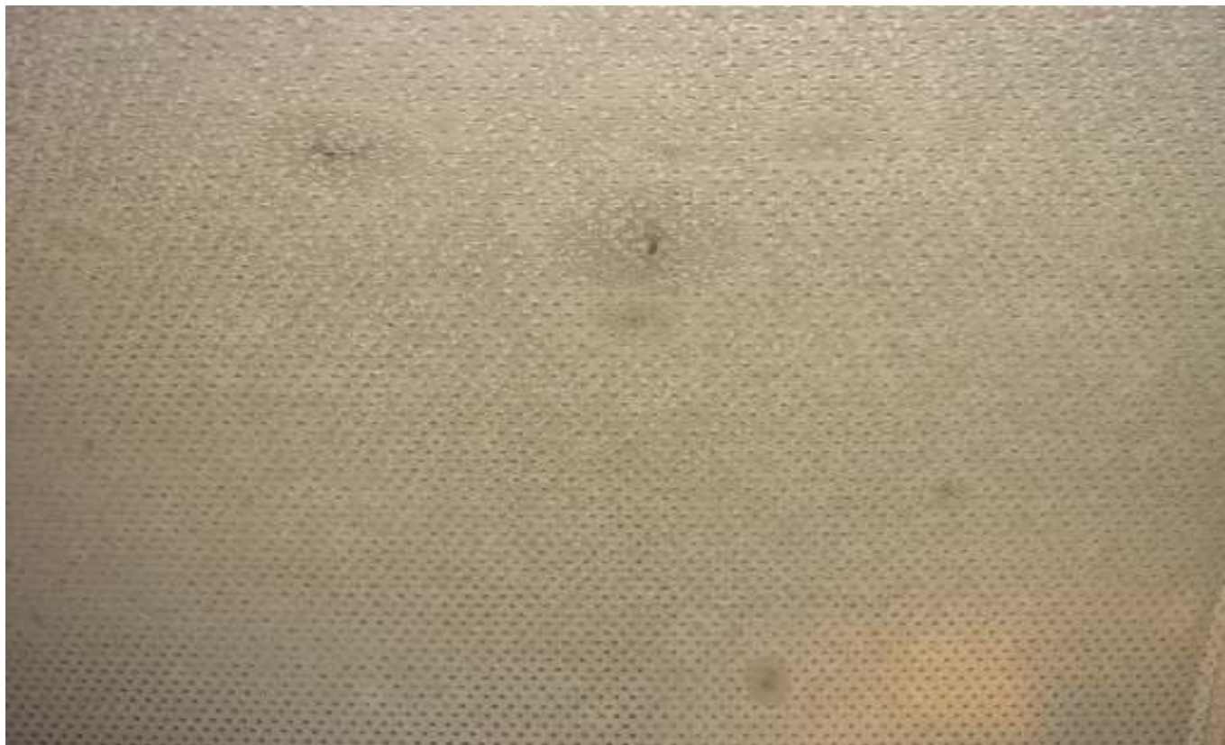
KUVA 22. Äänenvaimennusosien reikäpellin ja äänenvaimennusmateriaalina toimivan villan välissä ei ole muovikalvoa.
