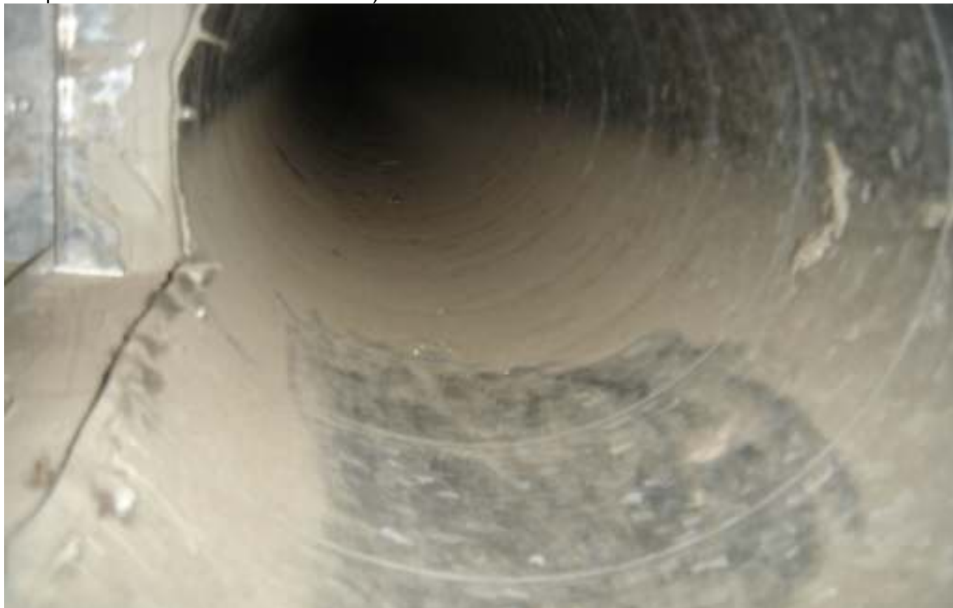
KUVA 25. Yleiskuva luokka 110 tuloilmakanavasta, kanava on erittäin likainen.
