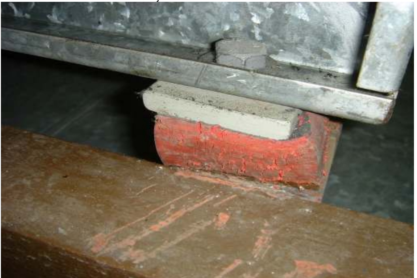
KUVA 12. Puhaltimien värinävaimentimet ovat murtuneita ja uusinnan tarpeessa.
