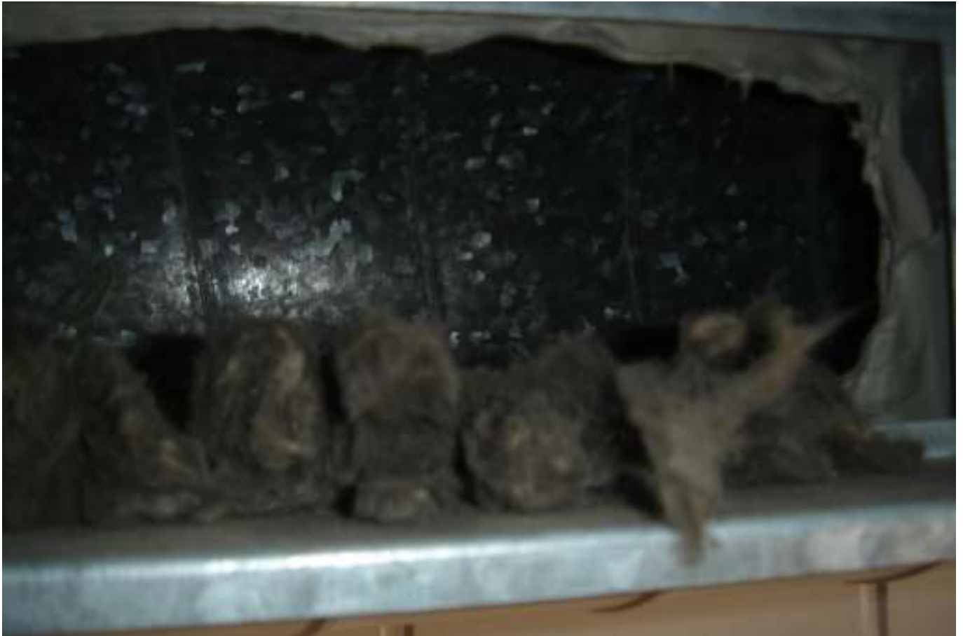
KUVA 30. Luokkahuone 110 tuloilmasäleikön takana on erittäin paljon epäpuhtauksia.
