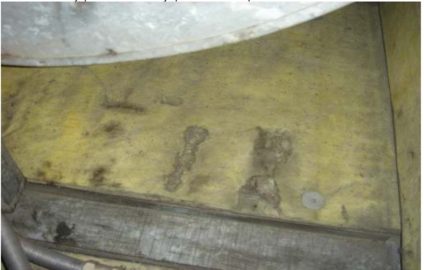
KUVA 8. Tuloilmakoneen villapinnat ovat likaisia paikoin kolhiintuneita.
