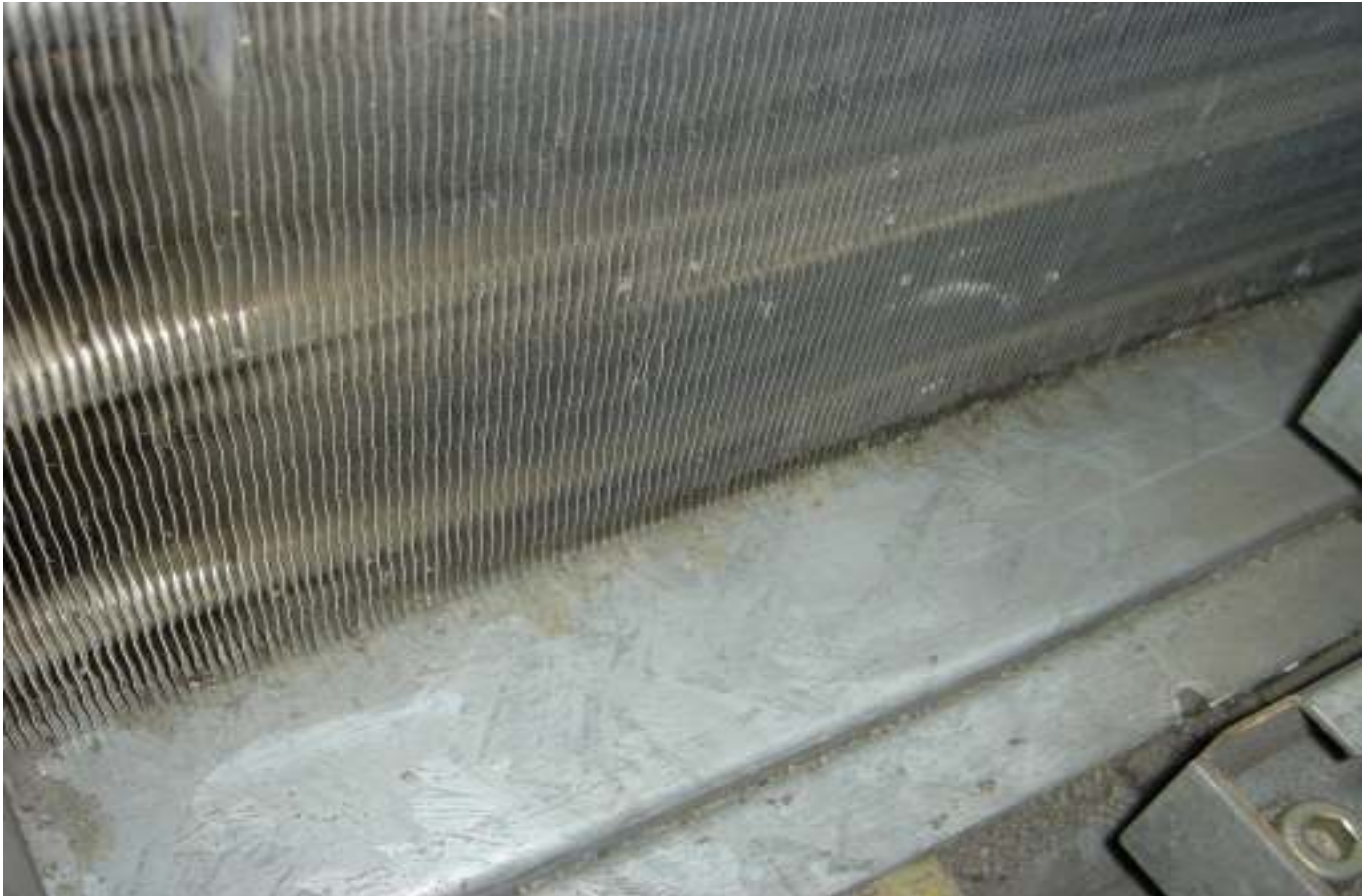
KUVA 7. Lämmityspatteri on likainen ja puhdistuksen tarpeessa.
