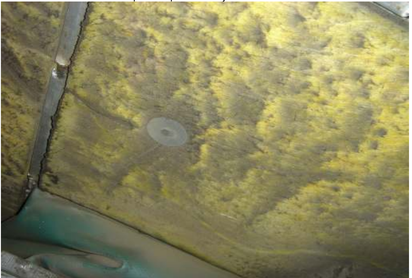
KUVA 19. Tuloilmakoneen villapinta on paikoin rikki ja erittäin likainen.
