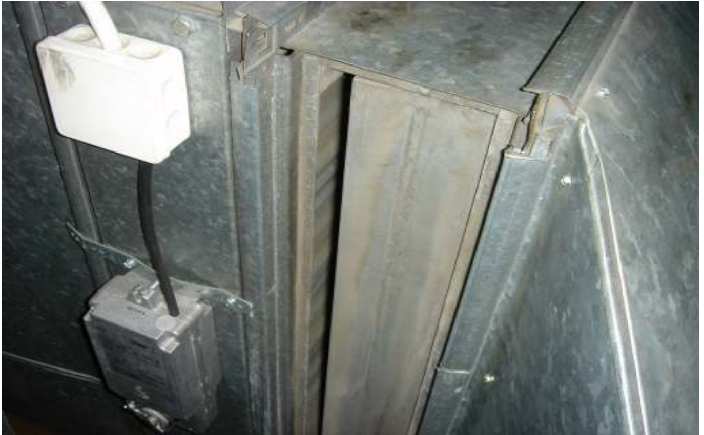
KUVA 3. Suodatinkasetti ei ole tiivis koneen runkoon nähden ja siitä tapahtuu huomattavaa ohivirtausta.
