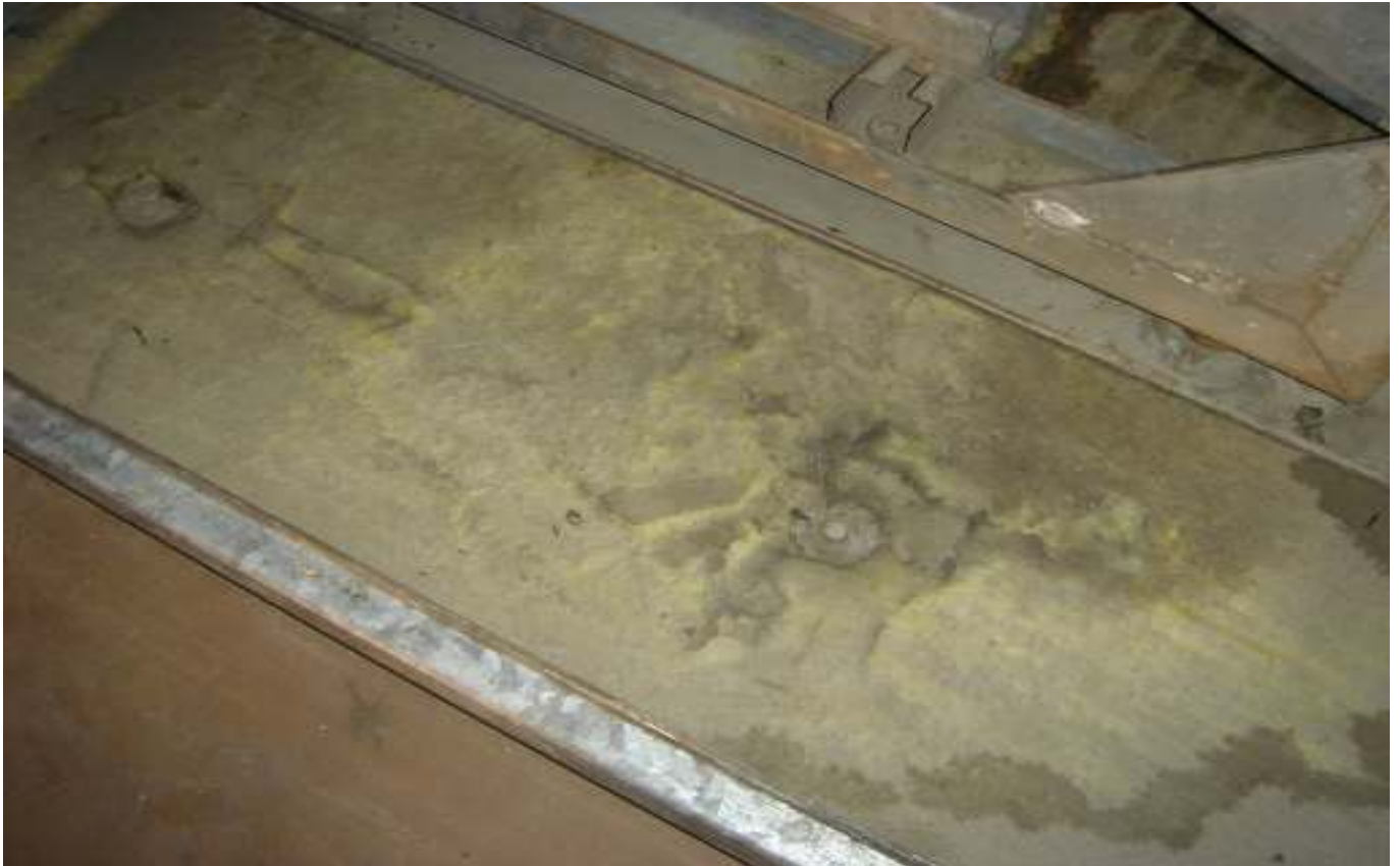
KUVA 18. Tuloilmakoneen villapinta on paikoin rikki ja erittäin likainen.
