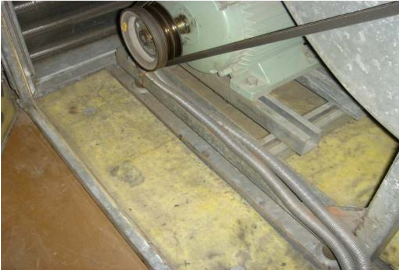
KUVA 9. Tuloilmakoneen villapinnat ovat likaisia paikoin kolhiintuneita.
