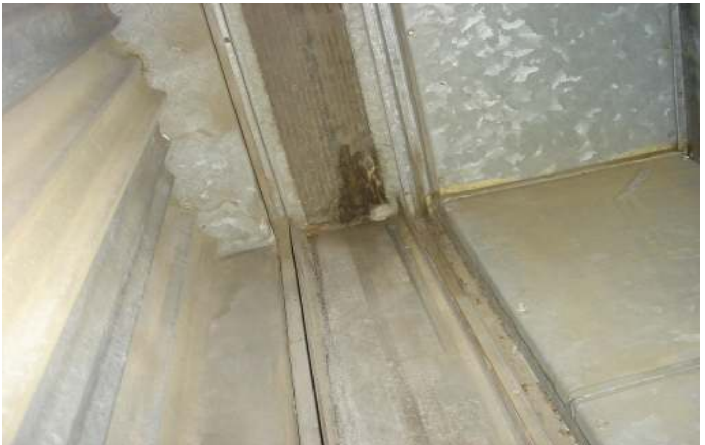
KUVA 4. Suodattimen jälkeen oleva runko-osa on likainen ohivirtauksen vuoksi.
