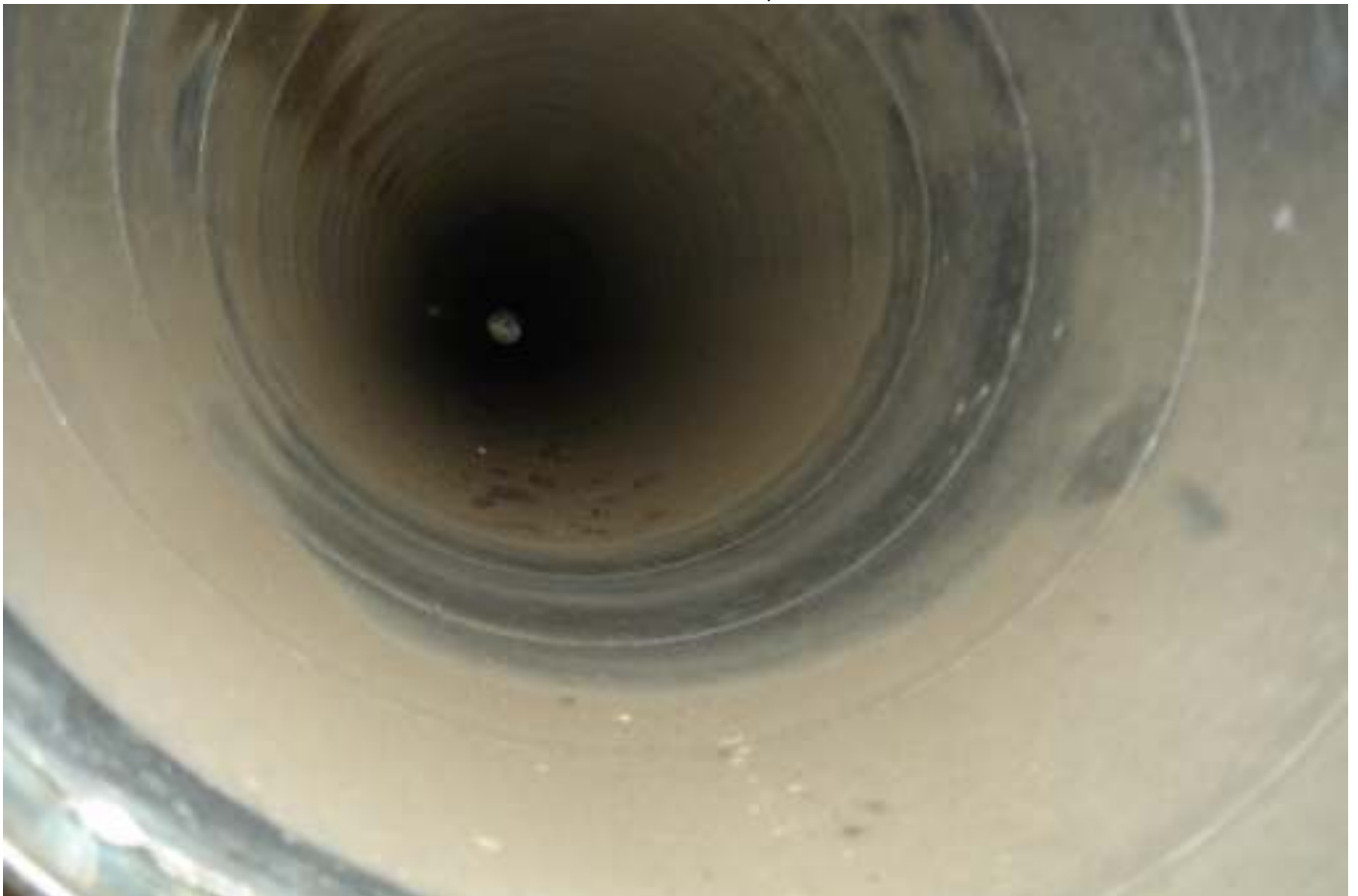
KUVA 27. Yleiskuva musiikkiluokan tuloilmakanavasta, kanava on erittäin likainen.
