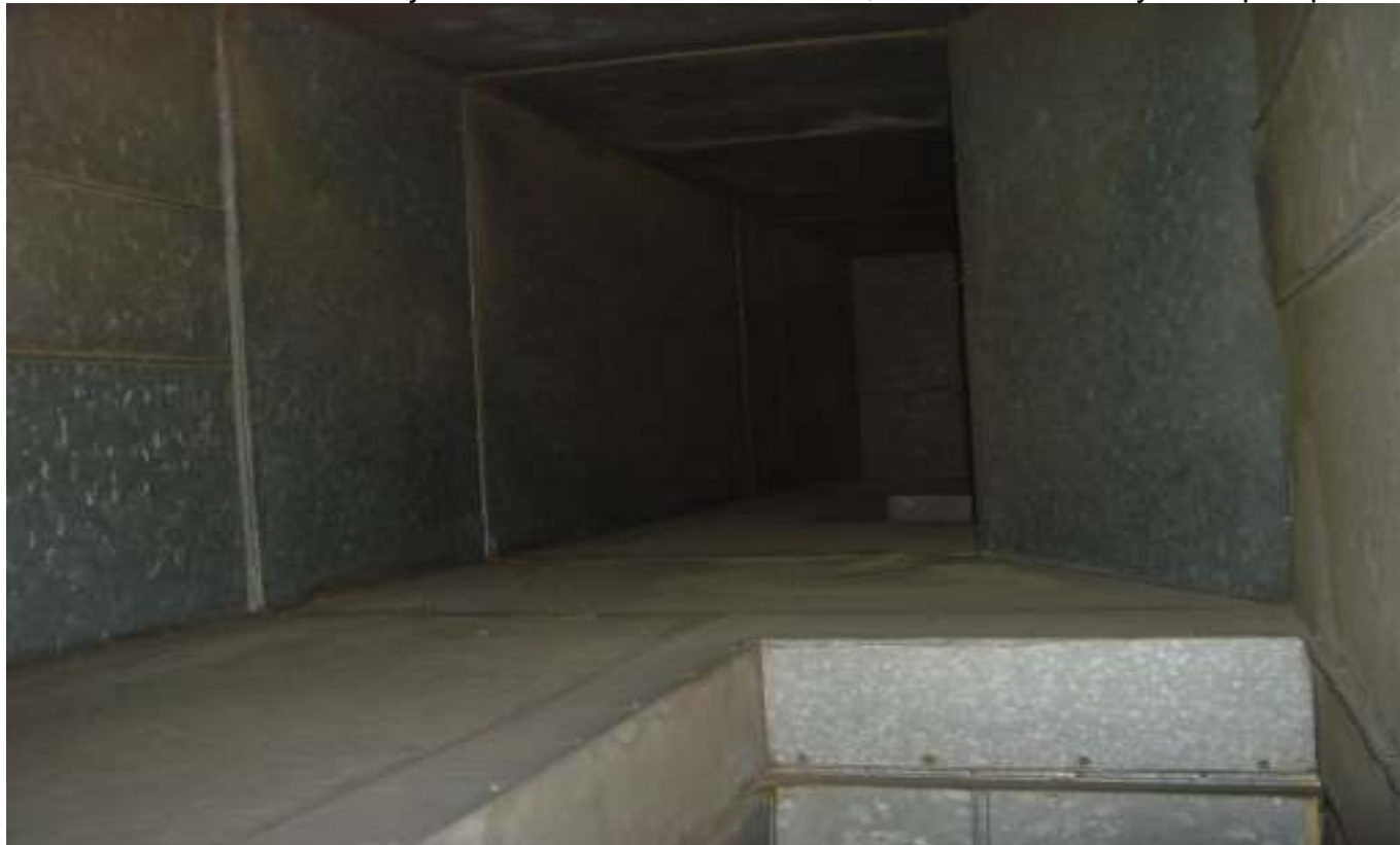
KUVA 2. Raitisilmakammio on likainen ja puhdistuksen tarpeessa.
