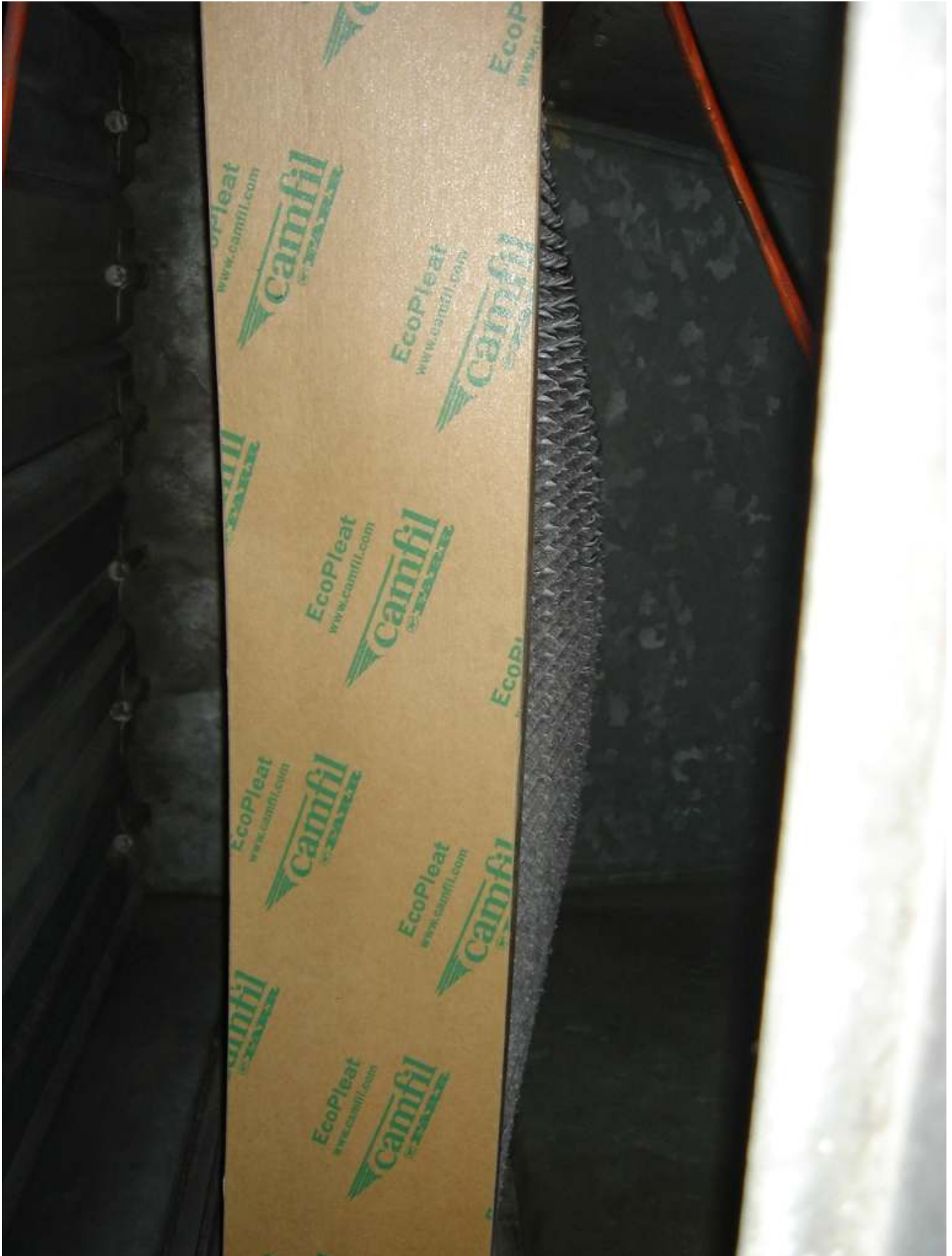
KUVA 13. Tuloilmakoneen suodatinkasetti on pullistunut, koska se on tukossa.
