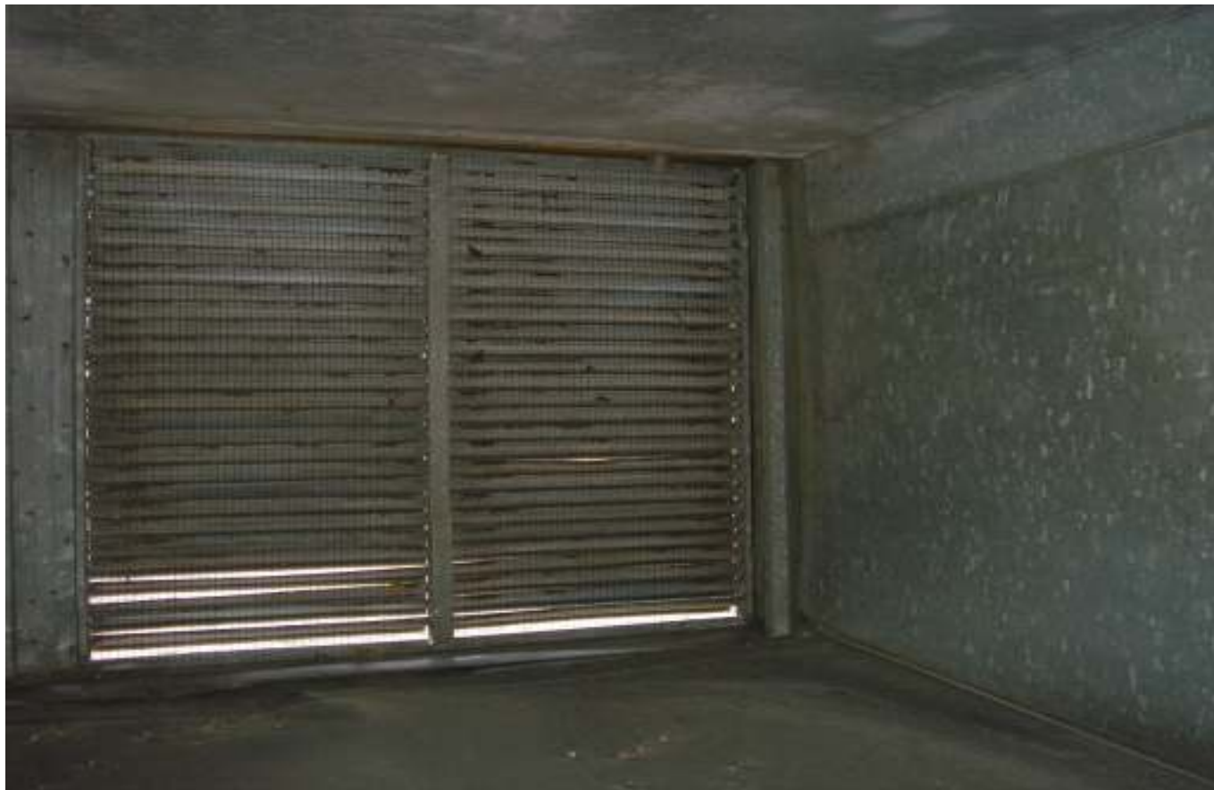
KUVA 1. Raitisilmakammio ja ulkoilmasäleikkö ovat likaisia, kammiossa on myös ampiaispesä.
