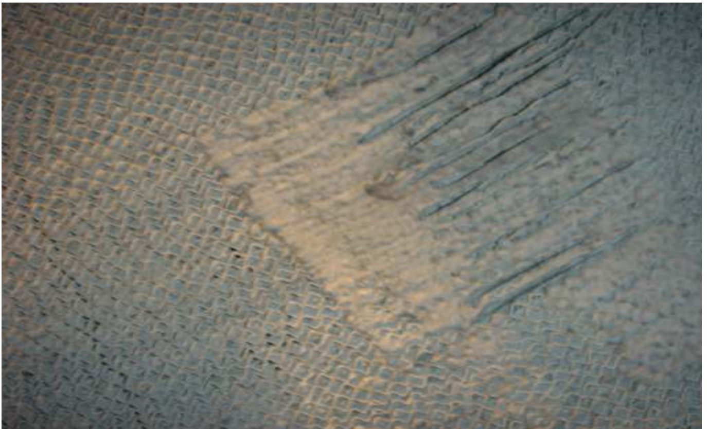
KUVA 6. LTO-kenno on hiertynyt paikoin kelvottoman kuntoon.
