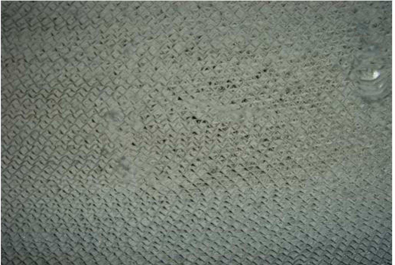
KUVA 5. Lämmöntalteenottokenno on tukossa.
