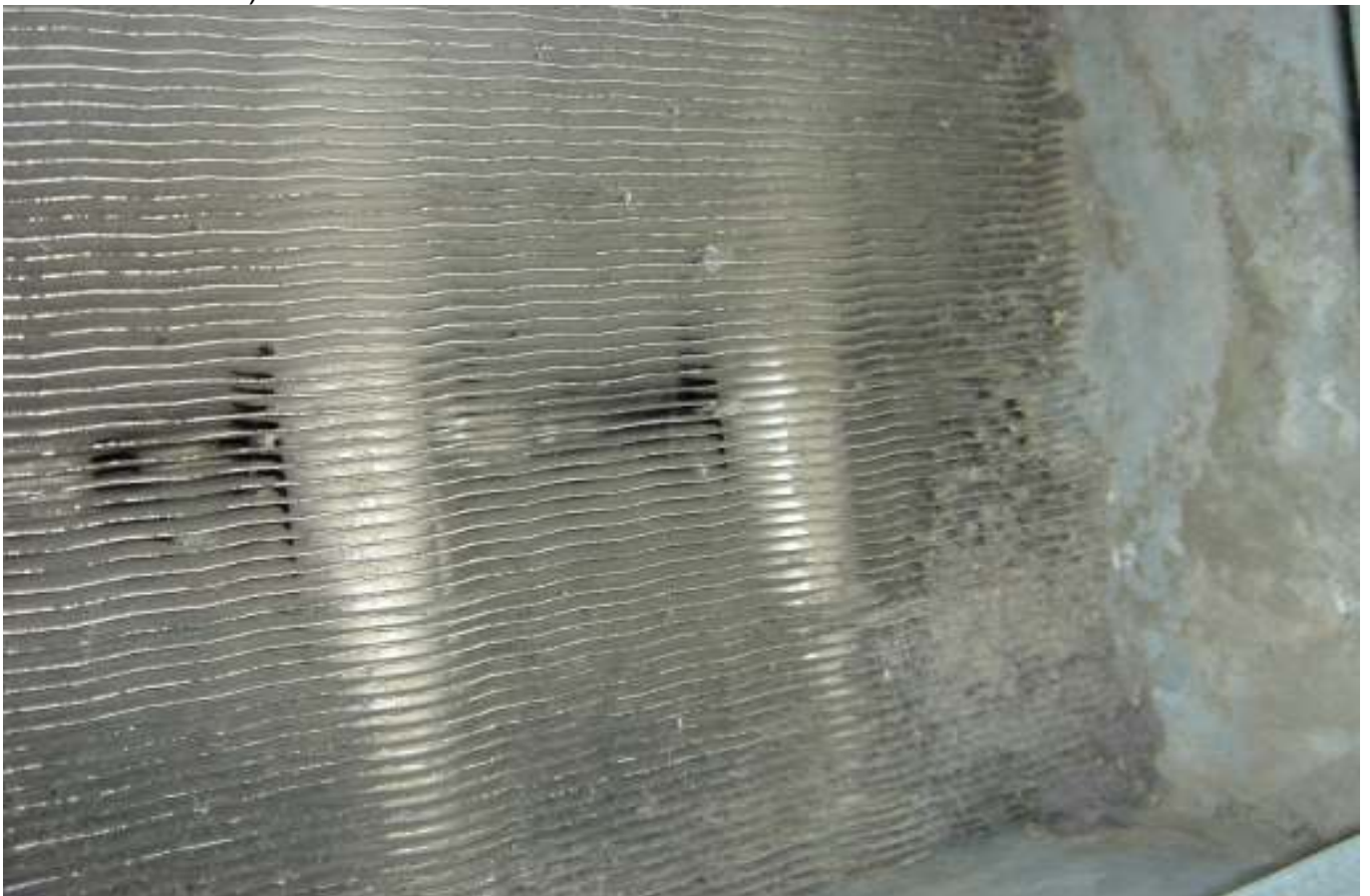
KUVA 17. Lämmityspatteri on likainen ja osin tukkeutunut.
