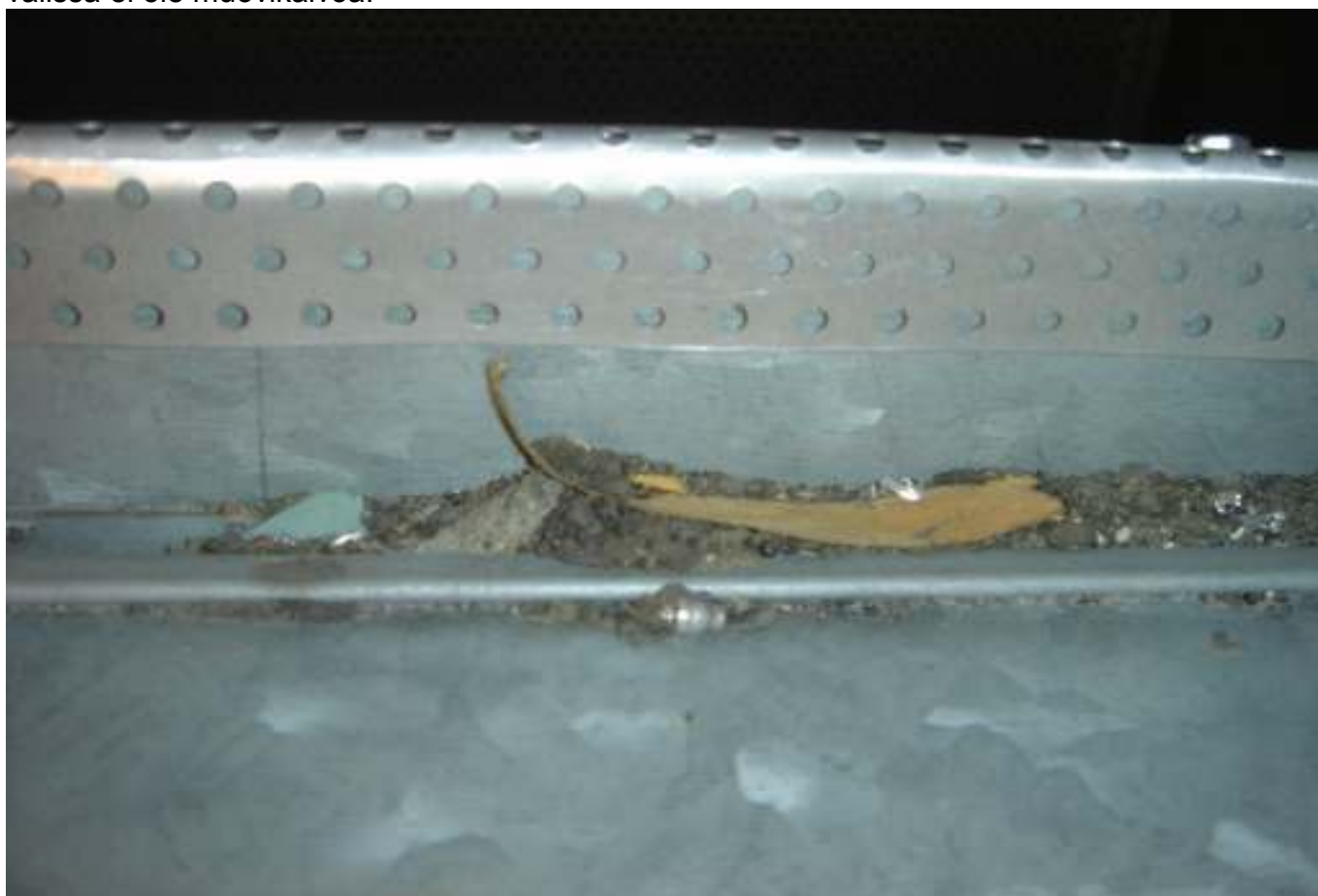
KUVA 23. Tuloilmapuolen äänenvaimennuskammiossa on paikoin huomattavasti roskaa.
