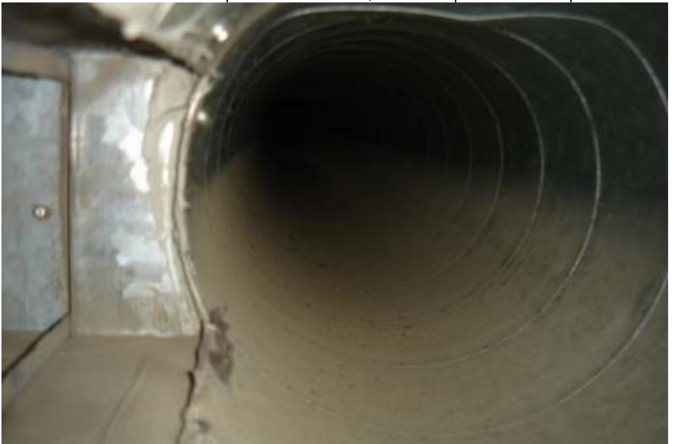
KUVA 29. Yleiskuva luokka 044 tuloilmakanavasta, kanava on erittäin likainen.
