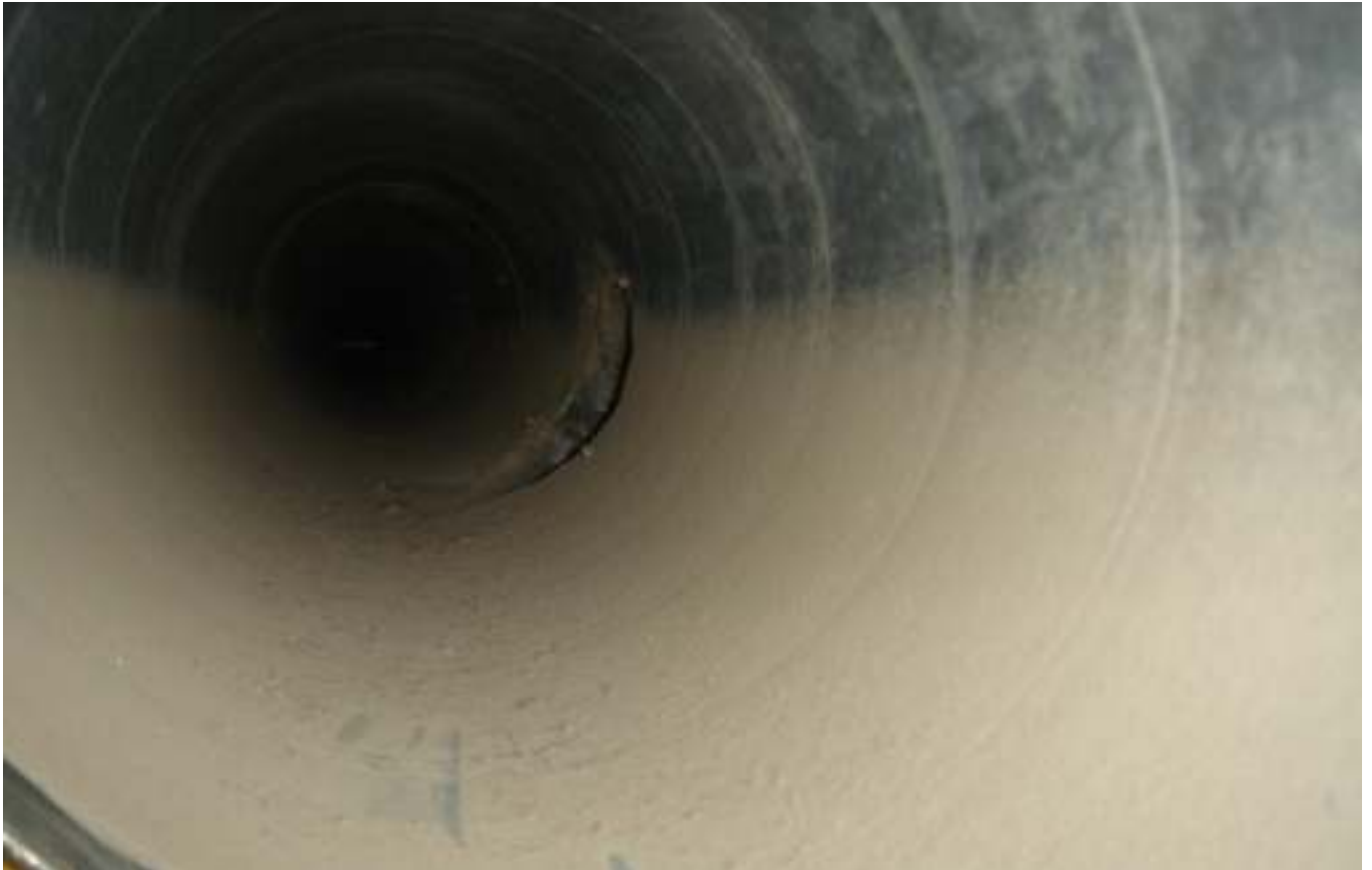
KUVA 28. Yleiskuva huone 040 poistoilmakanavasta, kanava on puhdistuksen tarpeessa.
