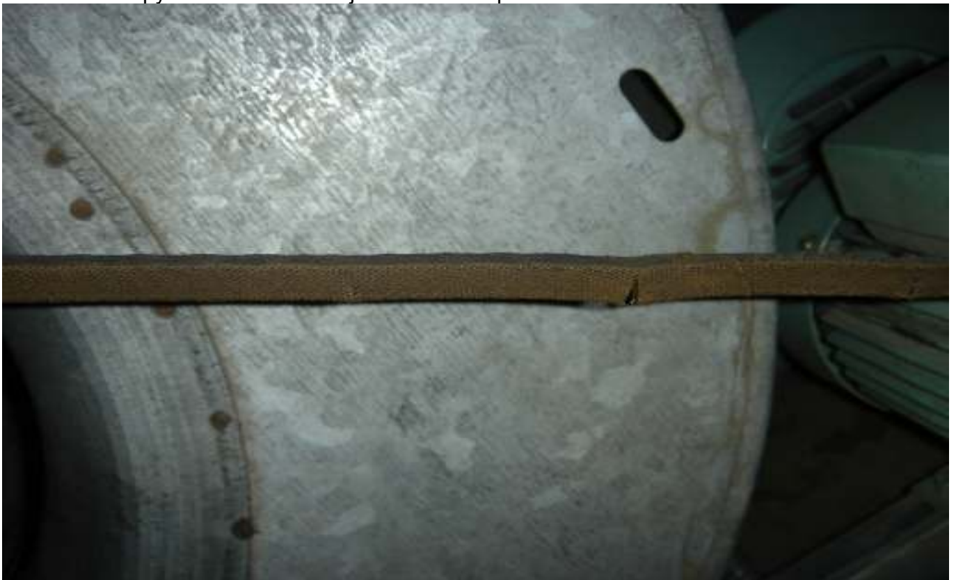
KUVA 21. Kiilahinnat ovat paikoin lähes poikki.
