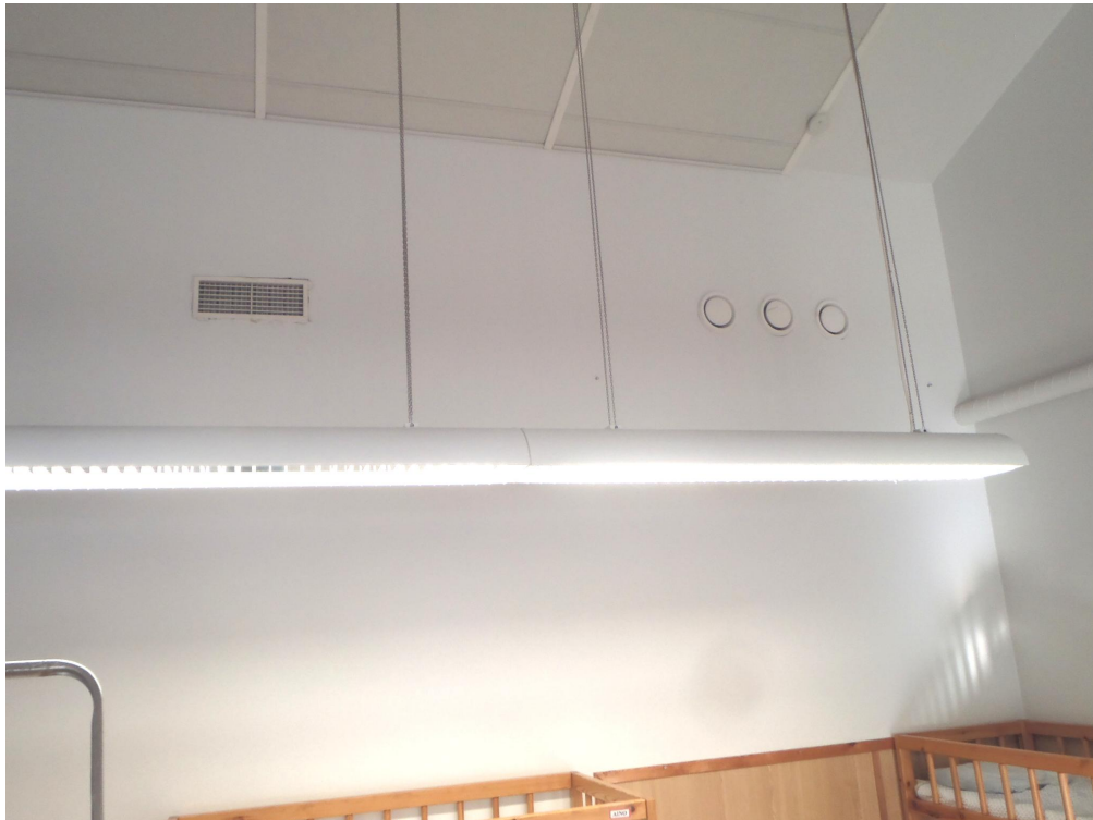
Kuva 16. Tulo- ja poistoilman pääte-elimet.
