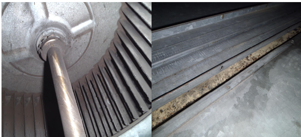
Kuvat 5-6. Ilmanvaihtokoneen puhaltimissa ja kammioissa on havaittavissa pölyä ja roskia.
