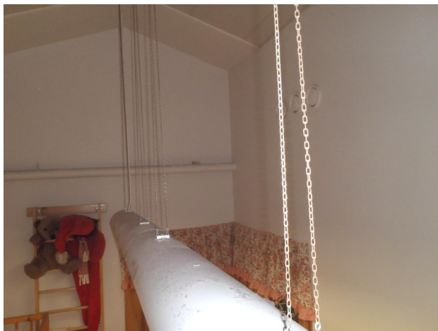
Kuva 17. Arkistokaappien päällä on pölykertymää.
