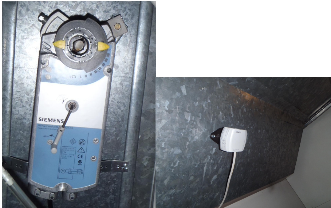
Kuvat 11-12. Ilmanvaihtokoneen peltimoottorit ja lämpötila-anturi.
