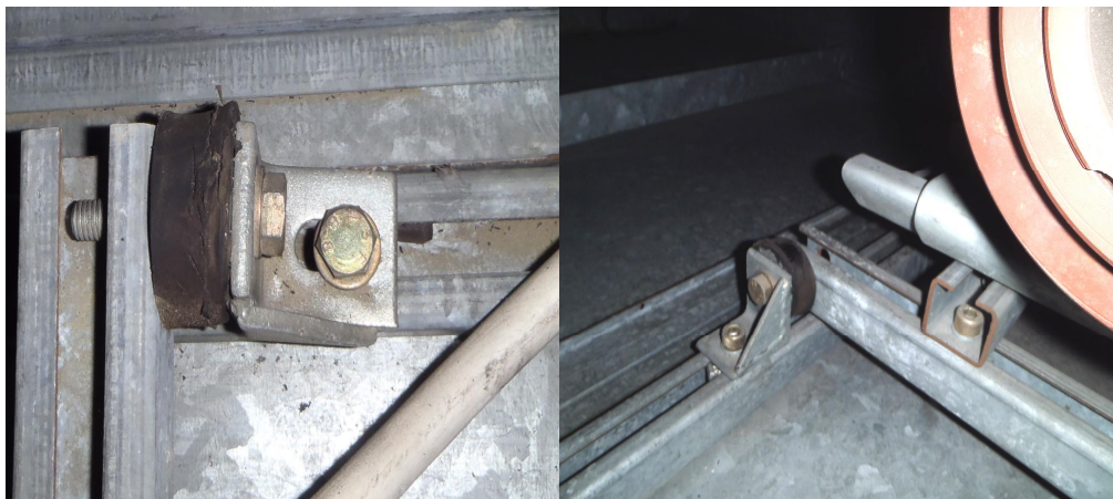
Kuvat 8-9. Puhaltimien kumityynyt ovat heikossa kunnossa.
