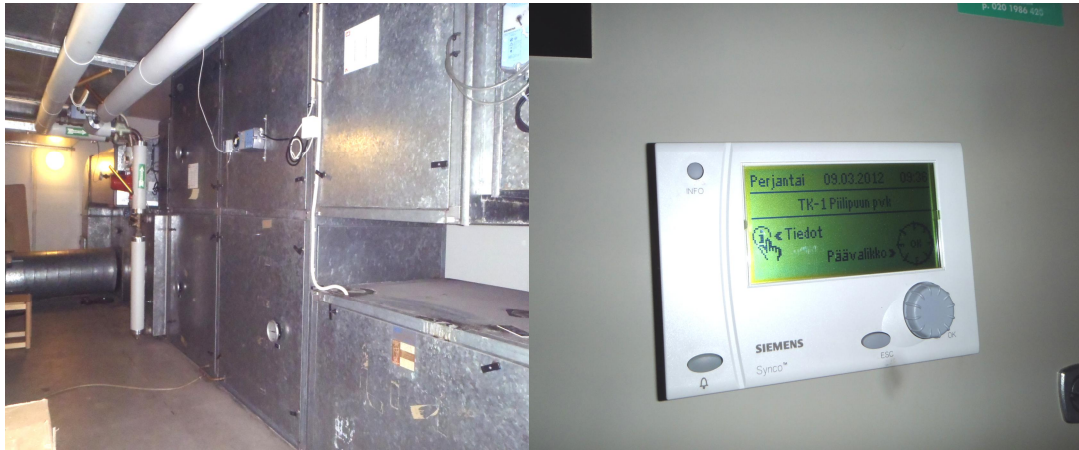
Kuvat 1-2. Päiväkodin ilmanvaihtokone ja säädin.
