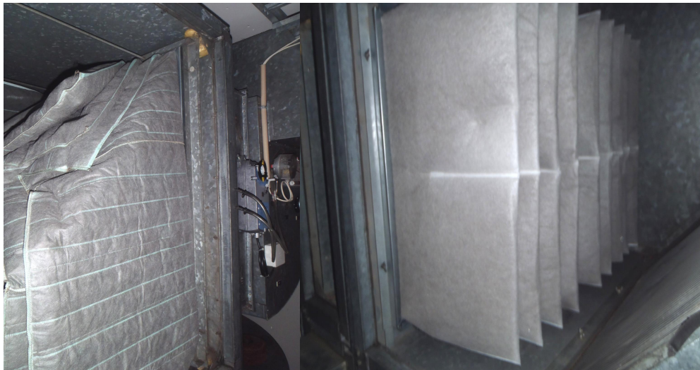
Kuvat 3-4. Suodattimet ovat pussisuodattimia ja niistä puuttuvat tiivisteet.
