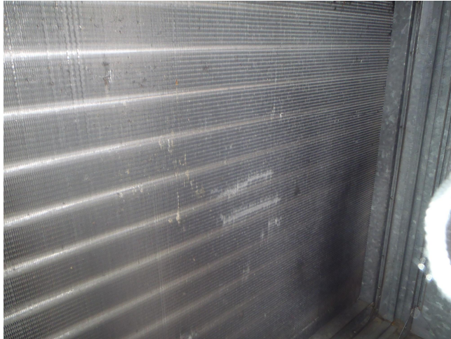
Kuva 7. Lämmityspatterissa on muutama pieni kolhu.
