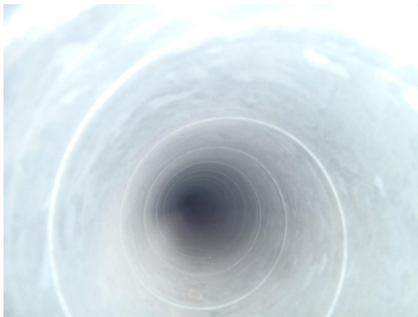
Kuva 15. Poistoilmakanavat ovat melko puhtaat.
