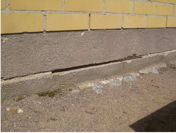
Kuva 5 Sokkelin ruostunutta raudoitusta näkyvillä.
