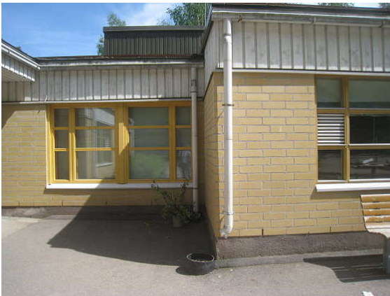
Kuva 3 Syöksytorven heitinosan ja kattovesikaivon keskinäinen sijainti puutteellinen.
