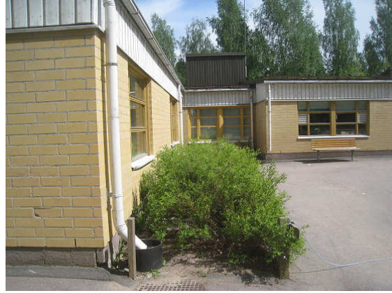
Kuva 6 Sokkelikulmissa on vaurioita.
