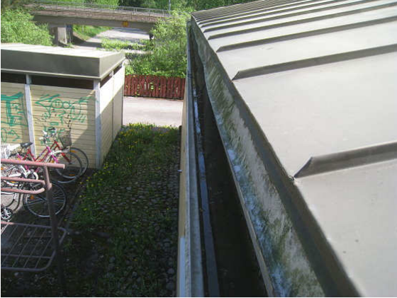
Kuva 23 Räystäskouruissa on kasvijätettä.
