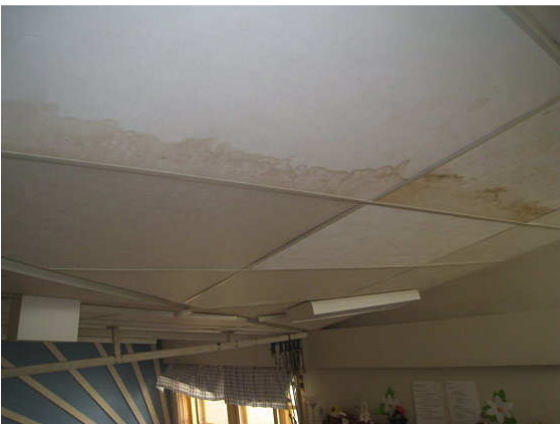
Kuva 27 Liikuntasalin katossa vanhoja vesivuotojälkiä.
