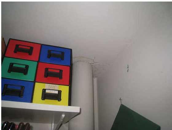
Kuva 33 Viemärin läpivientikohdassa vesi- vuotojälki.
