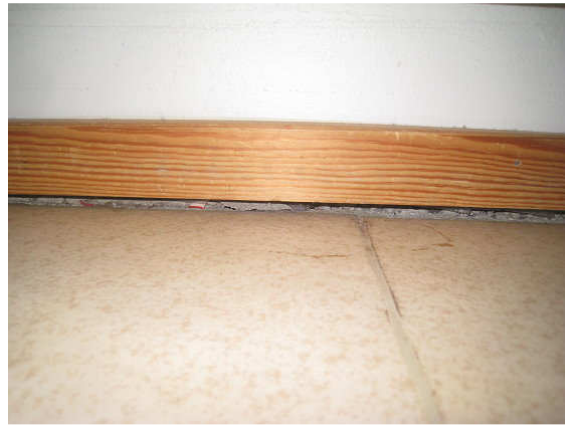
Kuva 8 Lattian ja ulkoseinän sokkelirakenteen liittymä ei ole rakenteiden liikkumisista johtuen tiivis.
