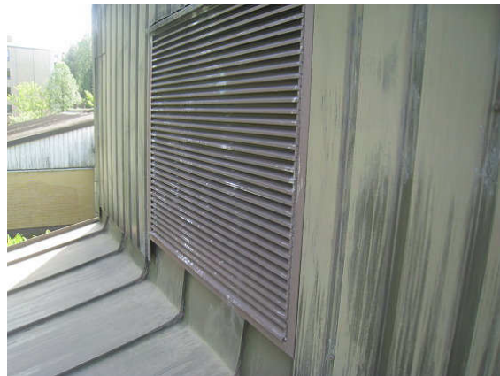
Kuva 34 Suojaamaton IV:n tuloilmasäleikkö.
