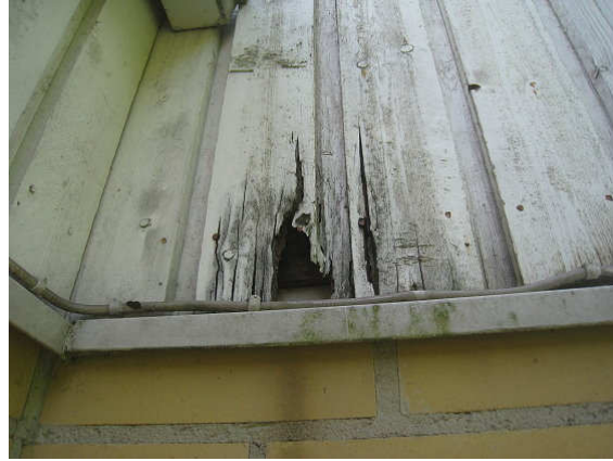
Kuva 12 Pystylomalaudoitus lahonnut yhdestä kohtaa.
