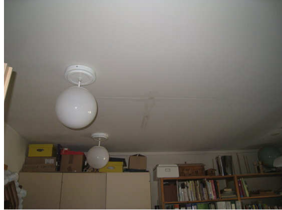
Kuva 24 Vesijälki tilan 20 katossa.
