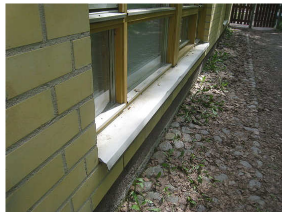
Kuva 16 Vesipellin asennus puutteellinen.
