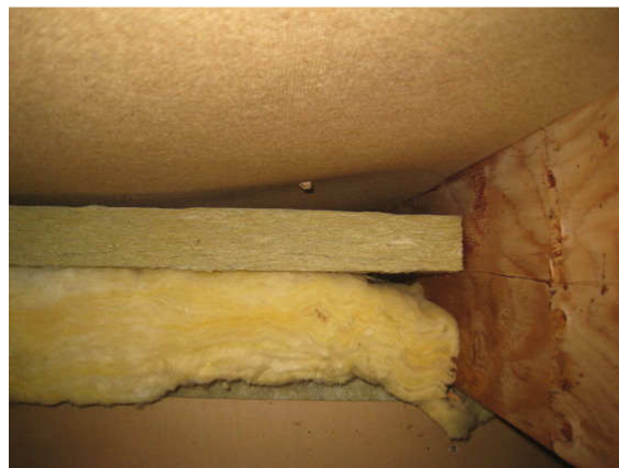
Kuva 22 Vesikaton tuulettumisessa on puutteita ja puurakenteissa on kosteuden aiheuttamia jälkiä.
