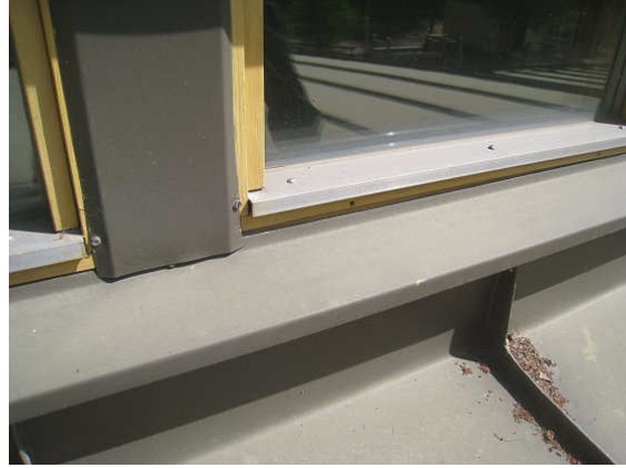
Kuva 18 Vesipellin asennus puutteellinen.
