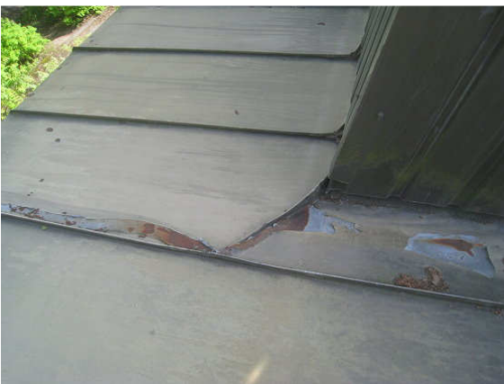
Kuva 21 Peltikatteen muovipinnoite on irtoillut ja pelti on alkanut ruostumaan.
