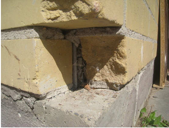
Kuva 11 Tiili haljennut ja taustan kipsilevyä näkyvillä.
