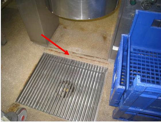
Kuva 29 Keittiön lattian massapinnassa halkeama.
