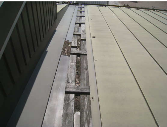
Kuva 19 Puurakenteiset kattotikkaat ja kulkusillat ovat huonokuntoiset.
