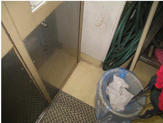
Kuva 31 Muovimaton juurinosossa halkeama.
