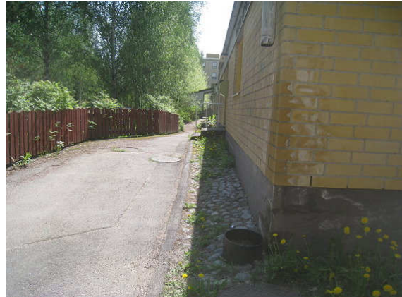
Kuva 2 Syöksytorvea ei ole, jolloin ulkoseinän vesirasitus on suuri.
