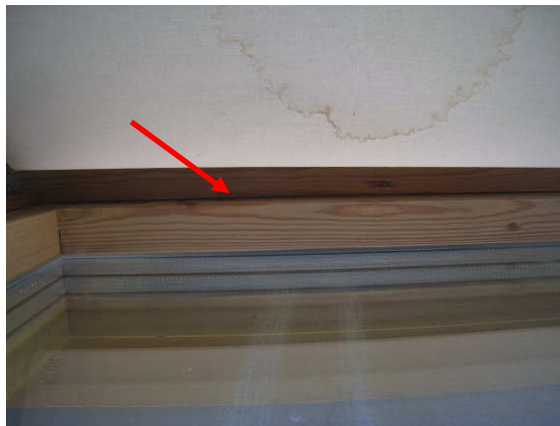
Kuva 13 Tilan 48 ikkunaliittymän vesivuotokoh- toa.
