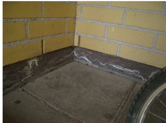
Kuva 4 Sokkelissa kalkkihärmettä ja halkeamia.
