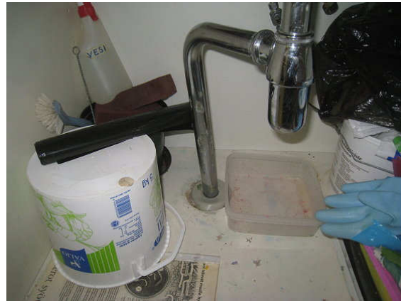
Kuva 32 Allaskaapin pohjalevyssä kosteusvaurio.
