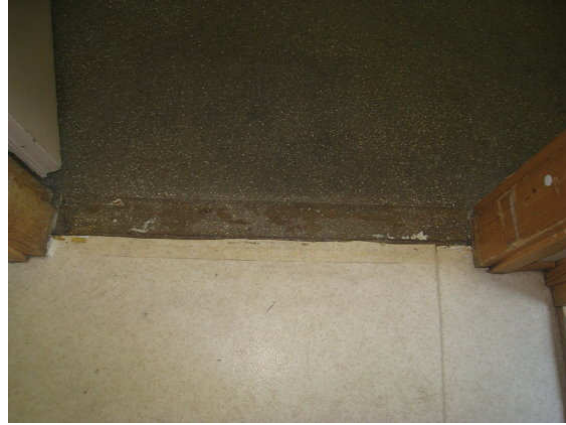
Kuva 30 Keittiön massapinnon ja käytävän muovimaton liittymä ei ole tiivis.
