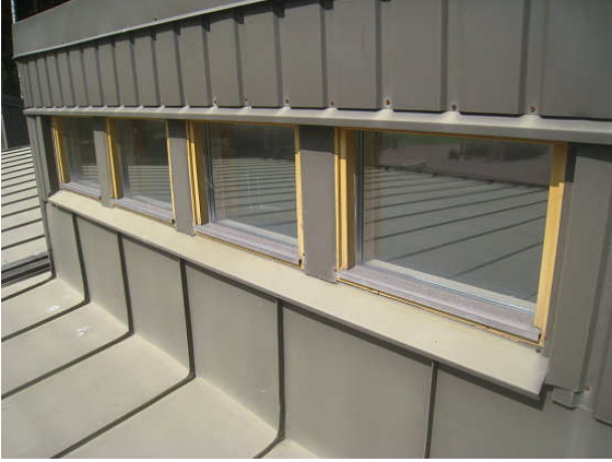
Kuva 17 Kattolyhtyjen ikkunoissa halkeilua.
