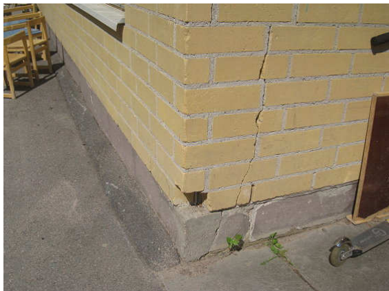
Kuva 10 Julkisivutiilimuurauksessa ja sokkelissa halkeamia.
