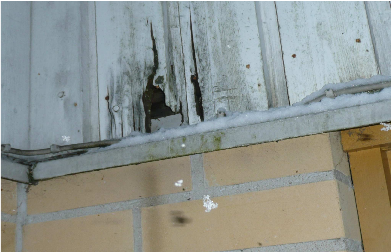
RAK- kuva 6. Päiväkodin puujulkisivun muutamassa kohdassa esiintyy lahovaurioita.
