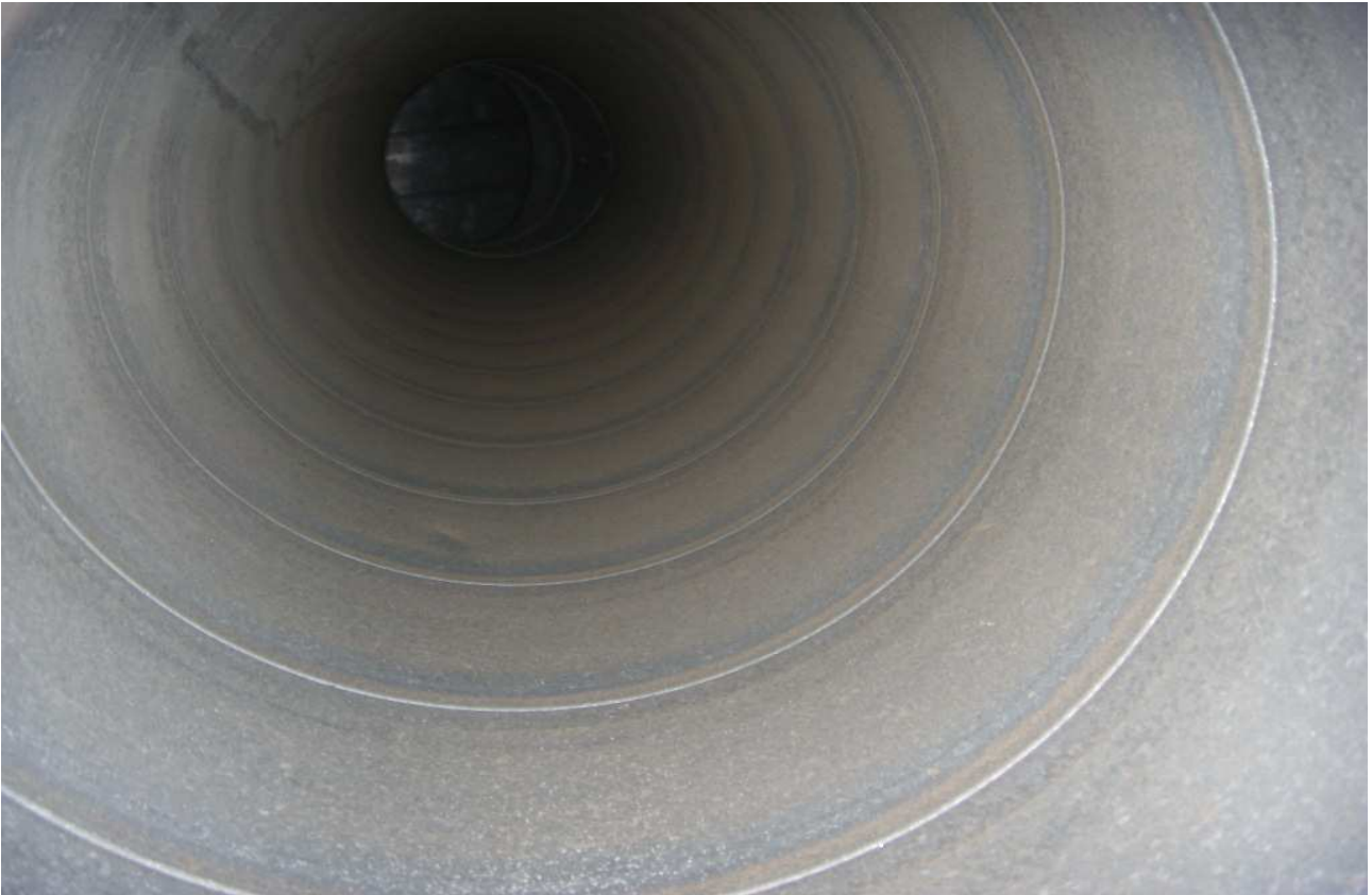
LVI- kuva 14. Yleiskuva tuloilmakanavasta.
