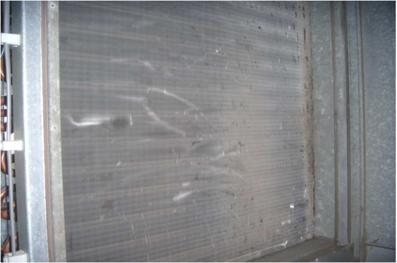
LVI- kuva 10. Yleiskuva tuloilmakoneen lämpöpatterista.
