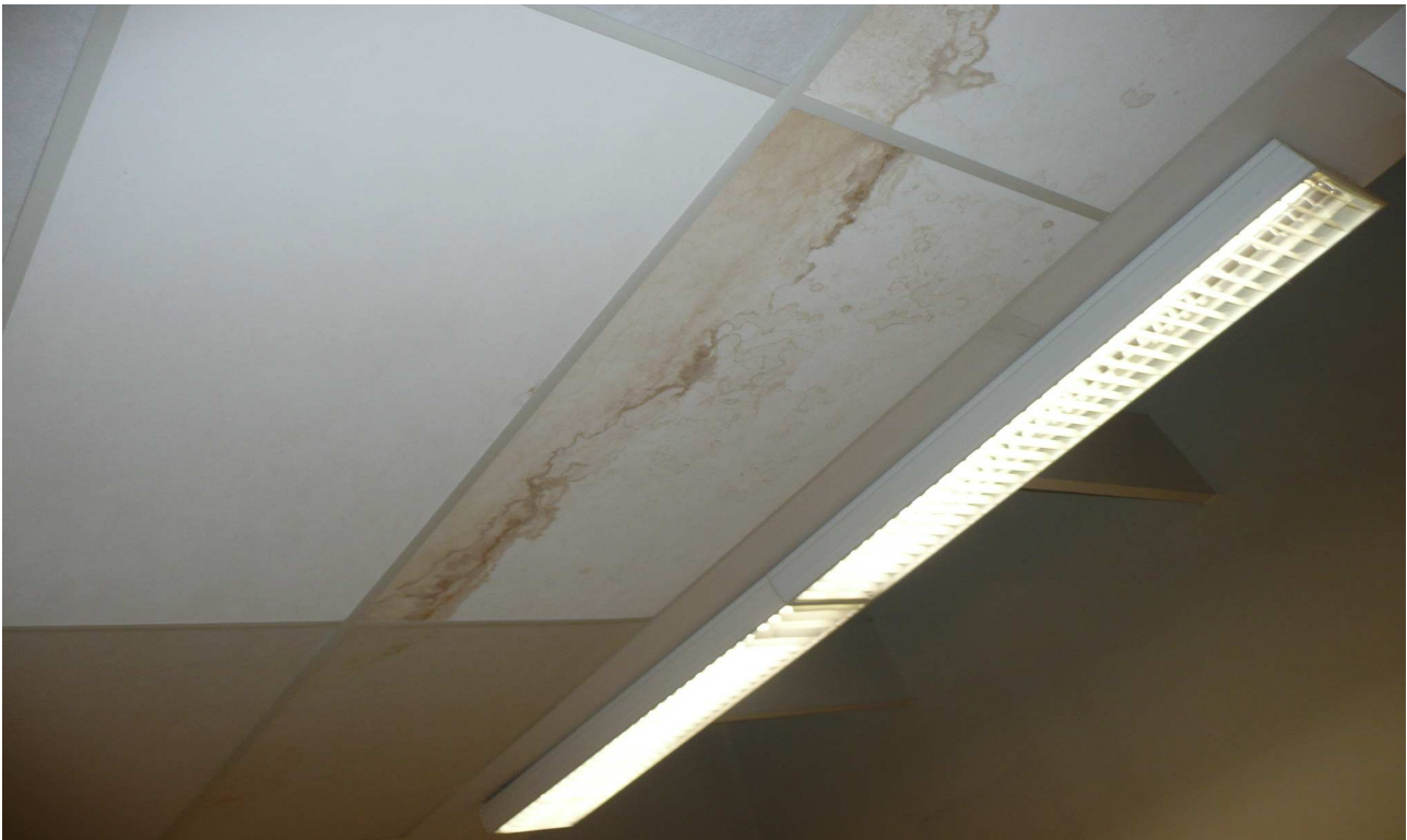
RAK- kuva 11. Leikkihuoneen katossa on merkkejä katon vesivuodoista.
