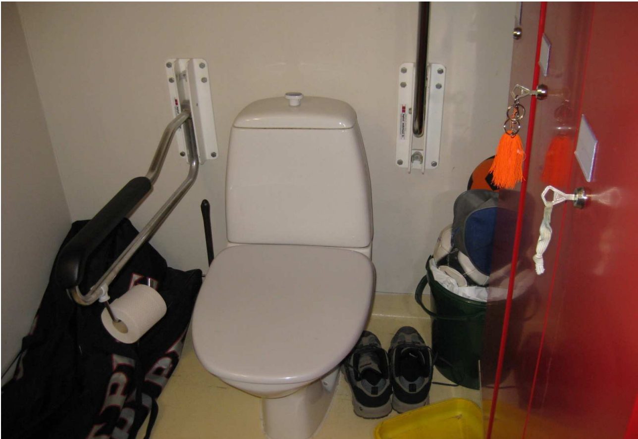
LVI- kuva 7. Yleiskuva vesikalusteista.
