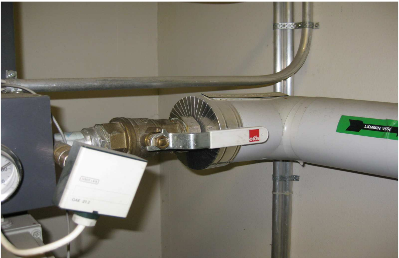
LVI- kuva 5. Yleiskuva käyttöveden sulkuventtiilistä.
