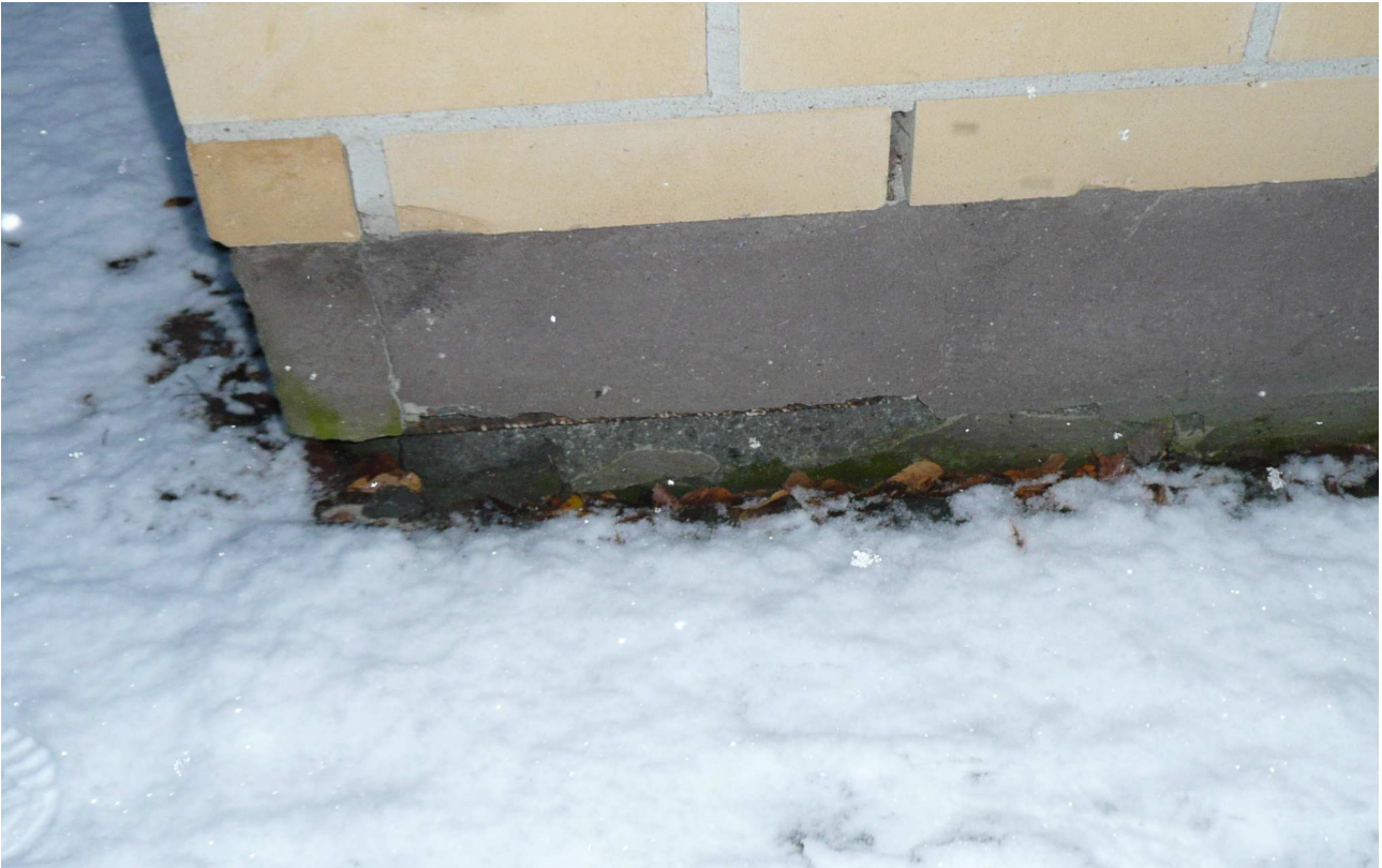
RAK- kuva 4. Sokkelipinnoissa havaittiin paikallisia vaurioita.
