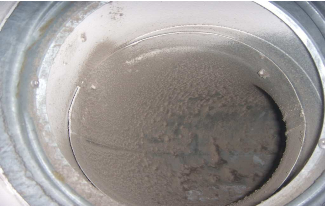
LVI- kuva 15. Yleiskuva poistoilmakanavasta.
