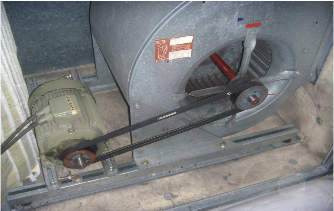
LVI- kuva 12. Yleiskuva tuloilmakoneen kammiosta, joka on eristetty mineraalivillalla.
