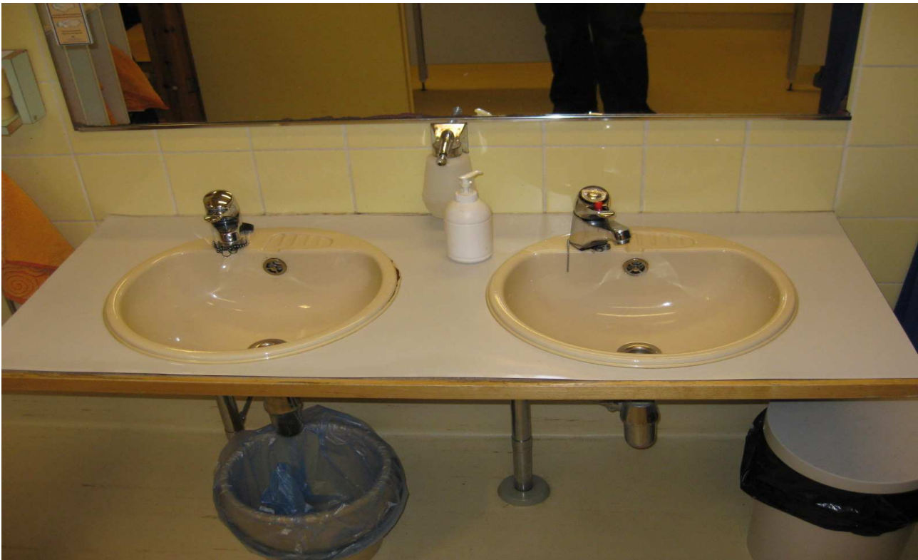
LVI- kuva 6. Yleiskuva vesikalusteista.
