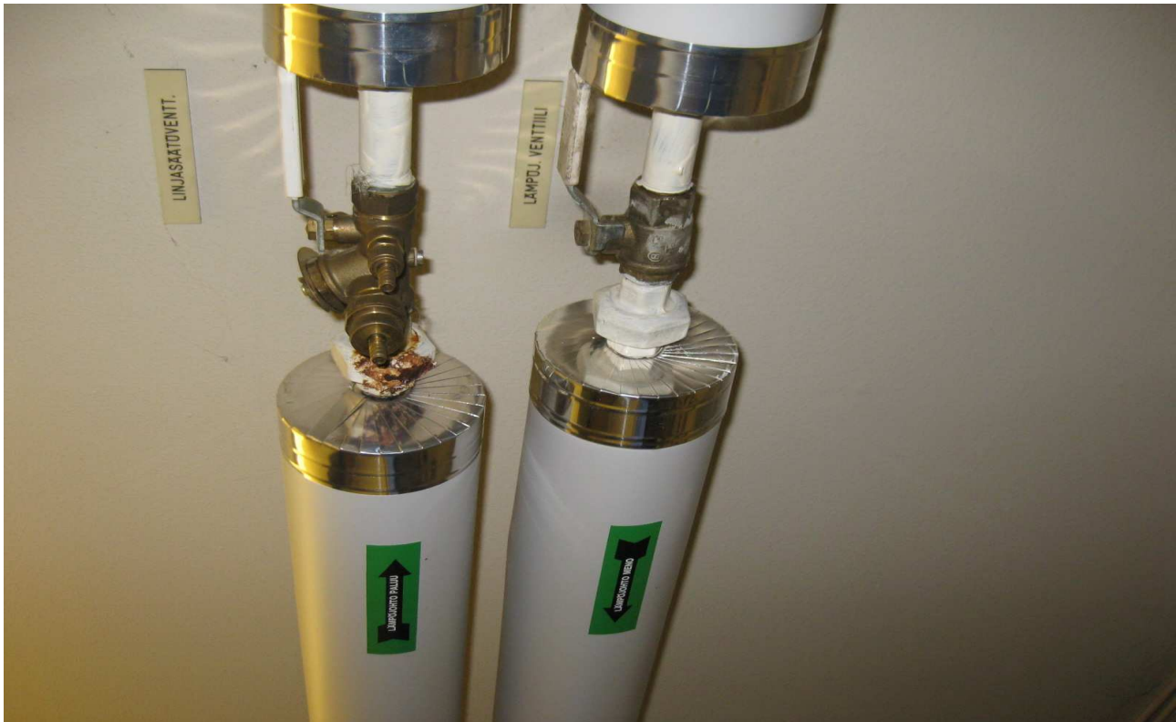
LVI- kuva 2. Yleiskuva lämpöjohtoverkoston venttiileistä.
