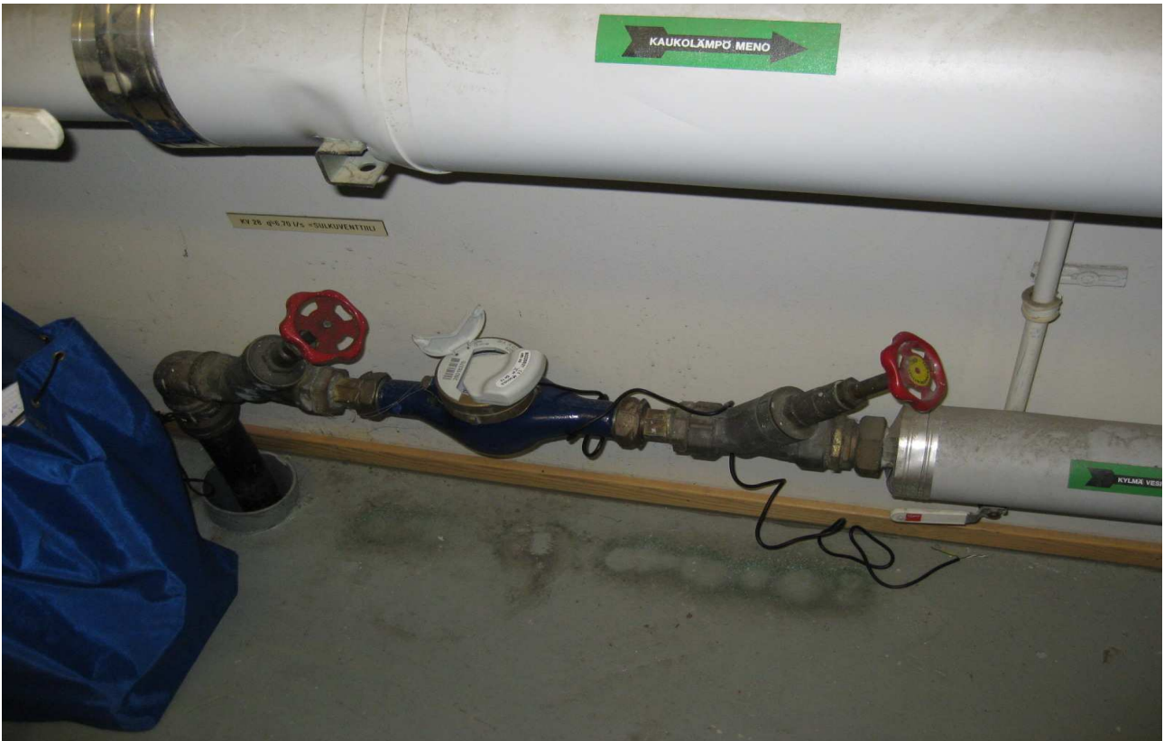
LVI- kuva 4. Yleiskuva vesimittarista ja pääsuluista.
