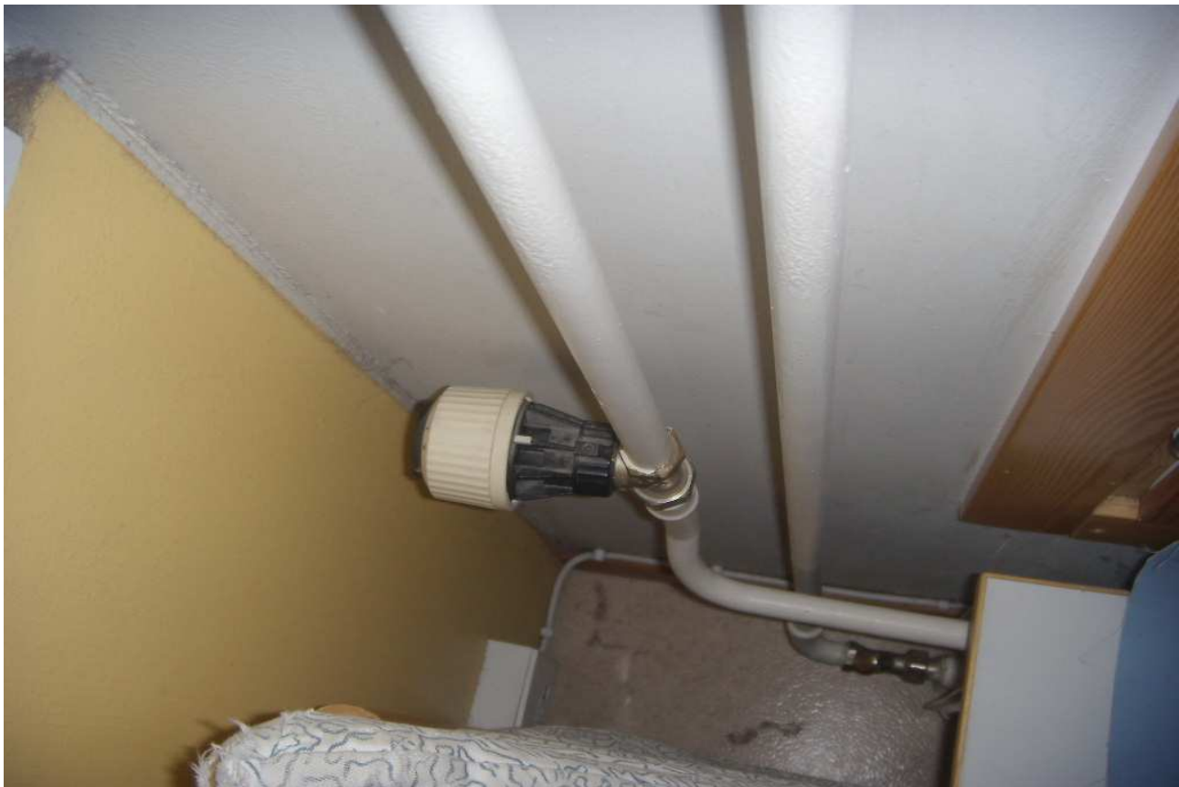
LVI- kuva 3. Yleiskuva patteriventtiilistä.
