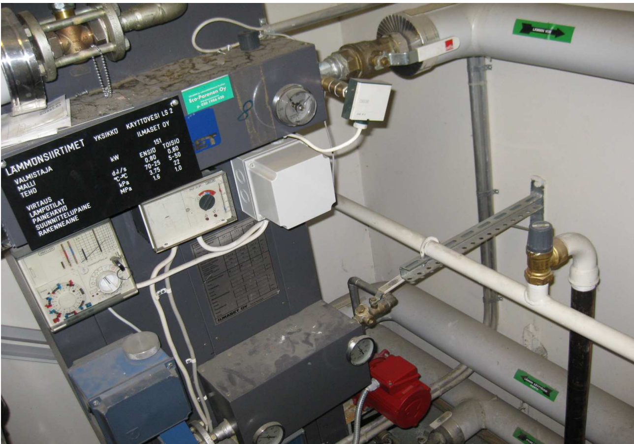
LVI- kuva 1. Yleiskuva lämmönjakuhuoneesta.
