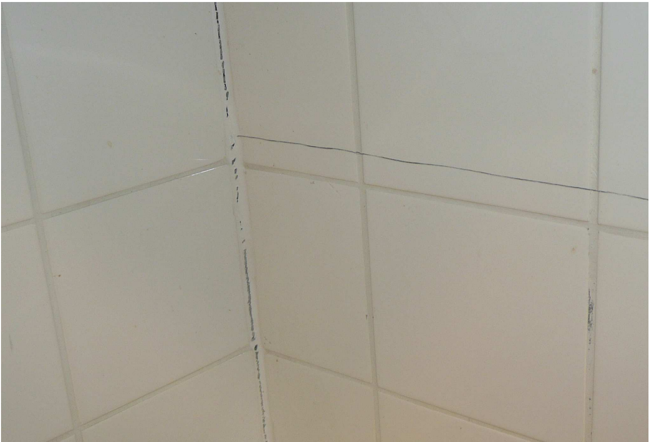
RAK- kuva 9. Keittiön seinissä esiintyy halkeamia.
