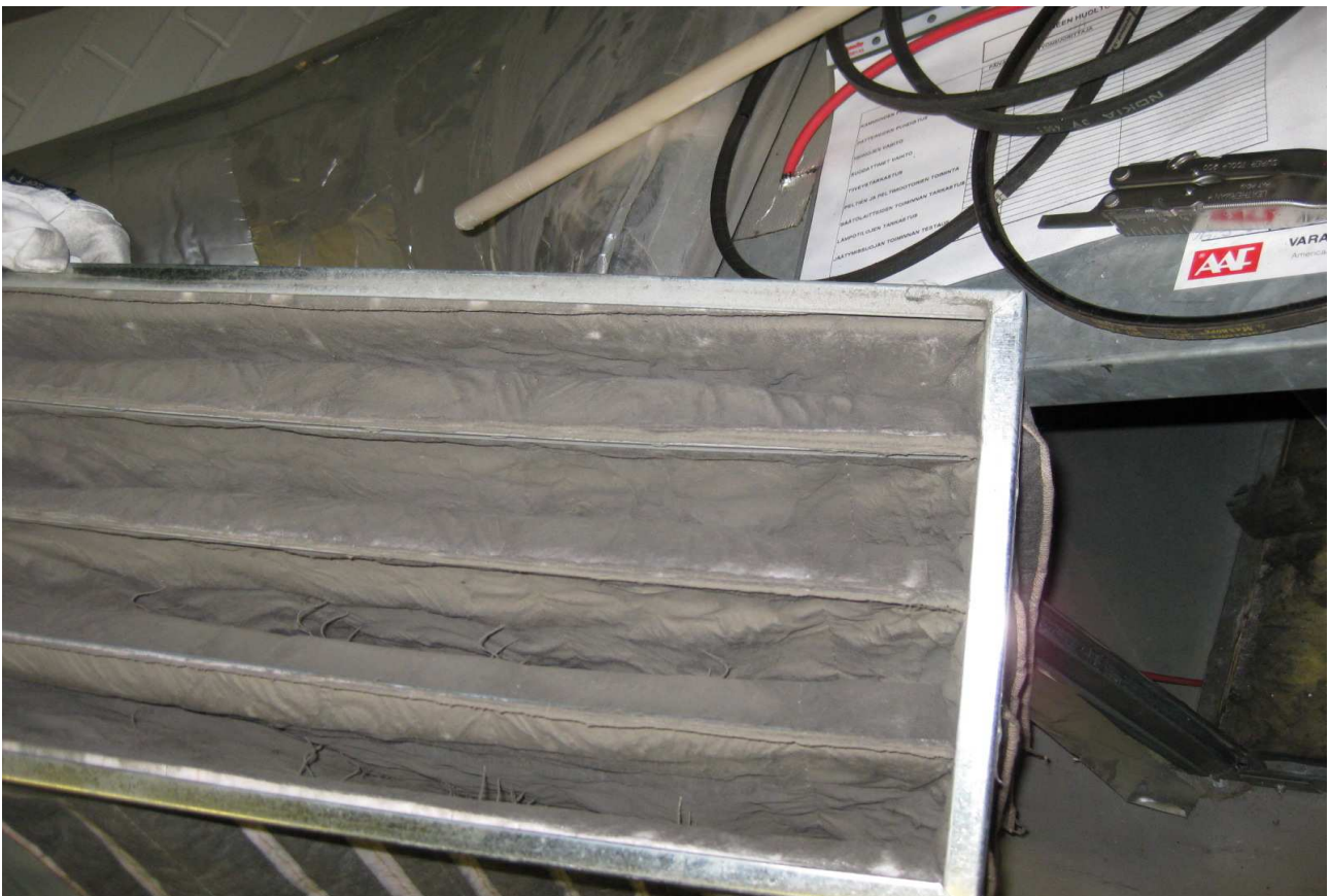
LVI- kuva 9. Yleiskuva tuloilmasuodattimesta.
