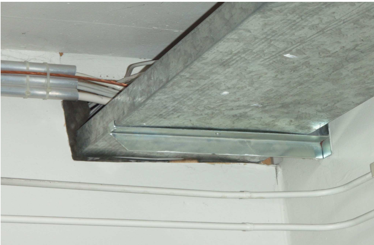
S- kuva 6. Pääkeskustilan avonainen kaapeliläpivienti.
