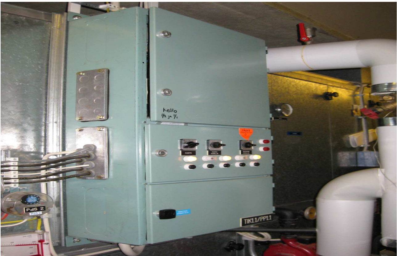
S- kuva 4. IV- konehuoneen keskus.
