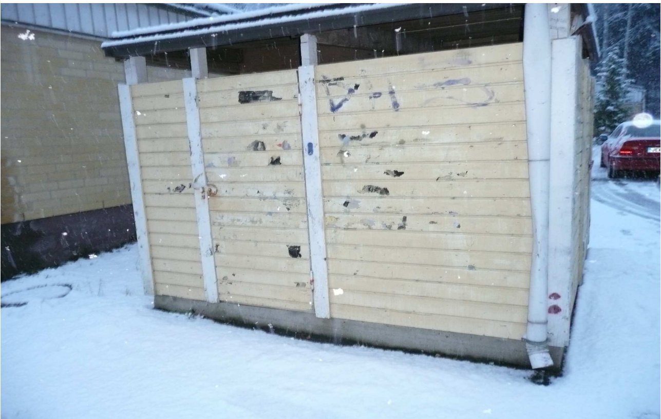
RAK- kuva 4. Jätekatoksen julkisivussa esiintyy värvaihteluja ja pinnan tummumista.
