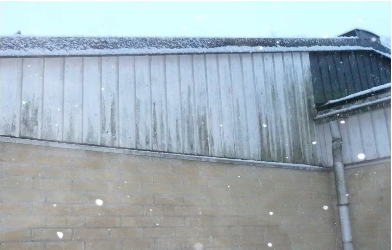
RAK- kuva 5. Päiväkodin puujulkisivun maalipinnassa esiintyy säännöllisesti pinnan tummumista.
