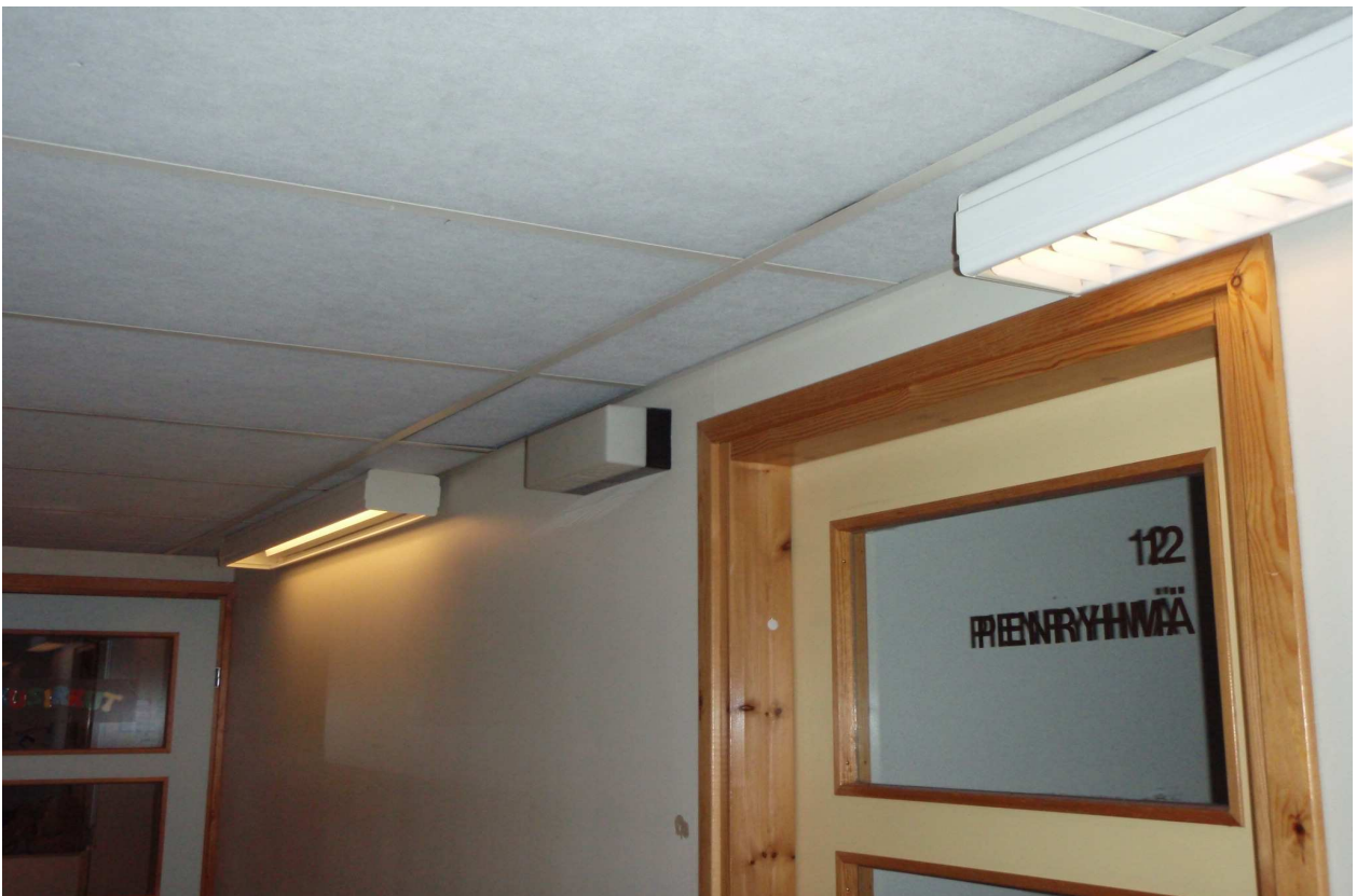
S- kuva 8. Käytävän valaistus.
