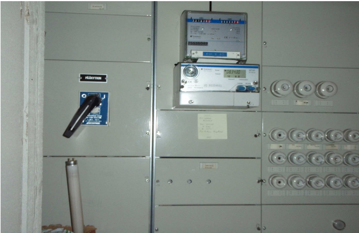
S- kuva 3. Sähköpääkeskus.
