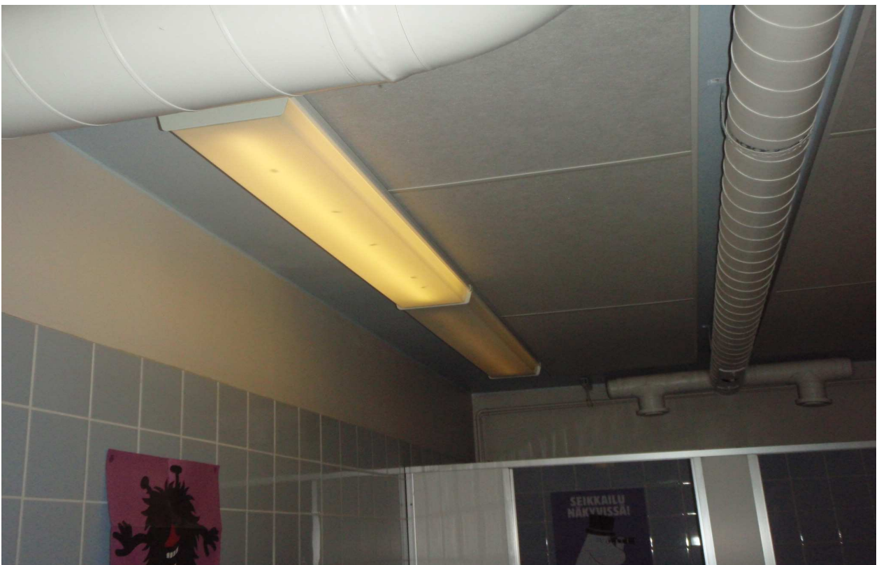
S-kuva 10. WC-tilojen valaistus.
