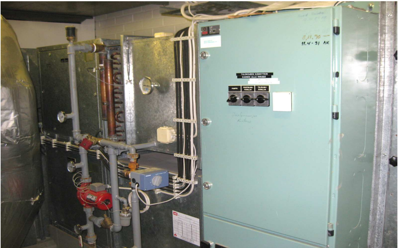
LVI- kuva 8. Yleiskuva IV- konehuoneesta.
