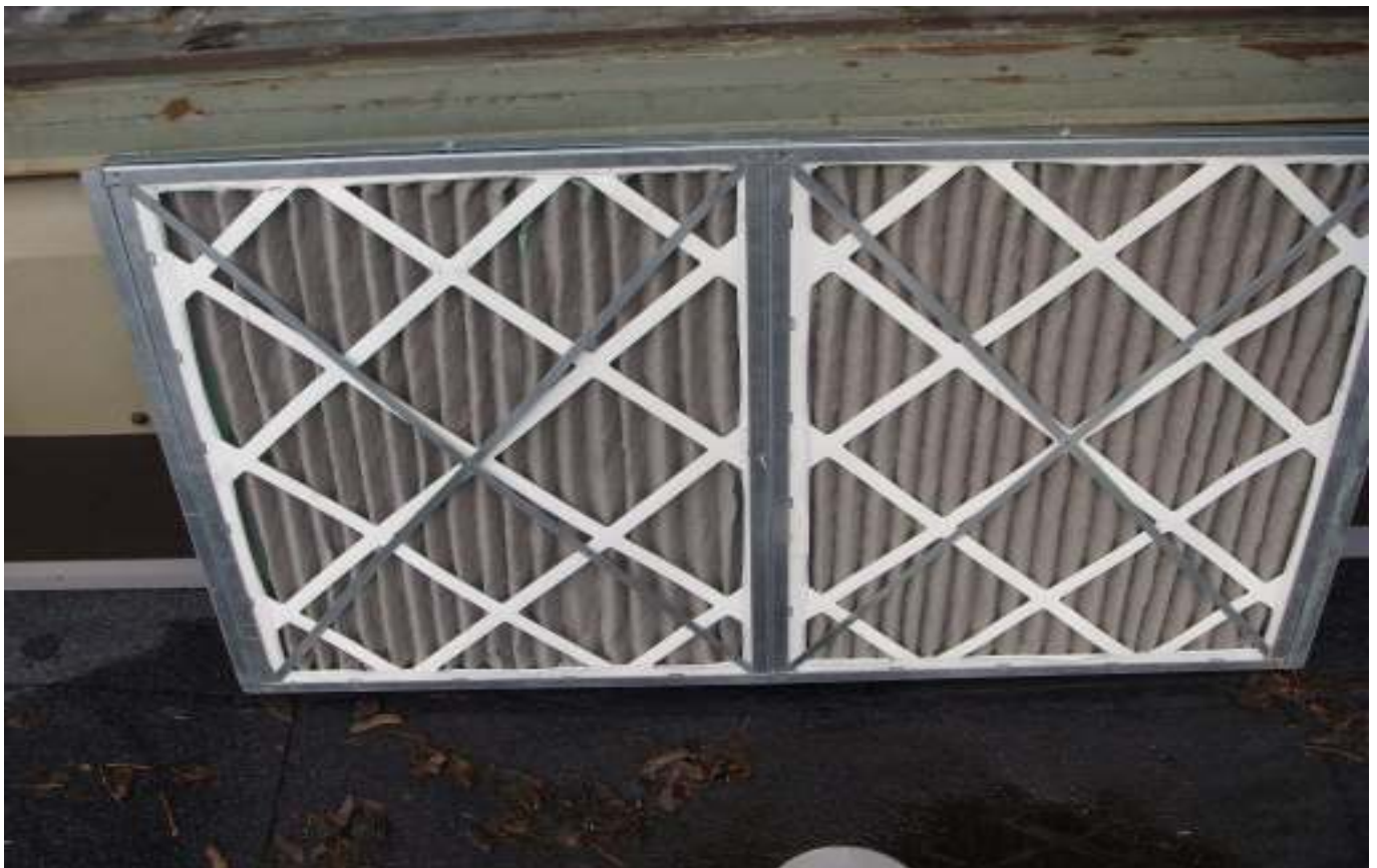
KUVA 4. Poistoilmasuodattimet ovat melkein tukossa.
