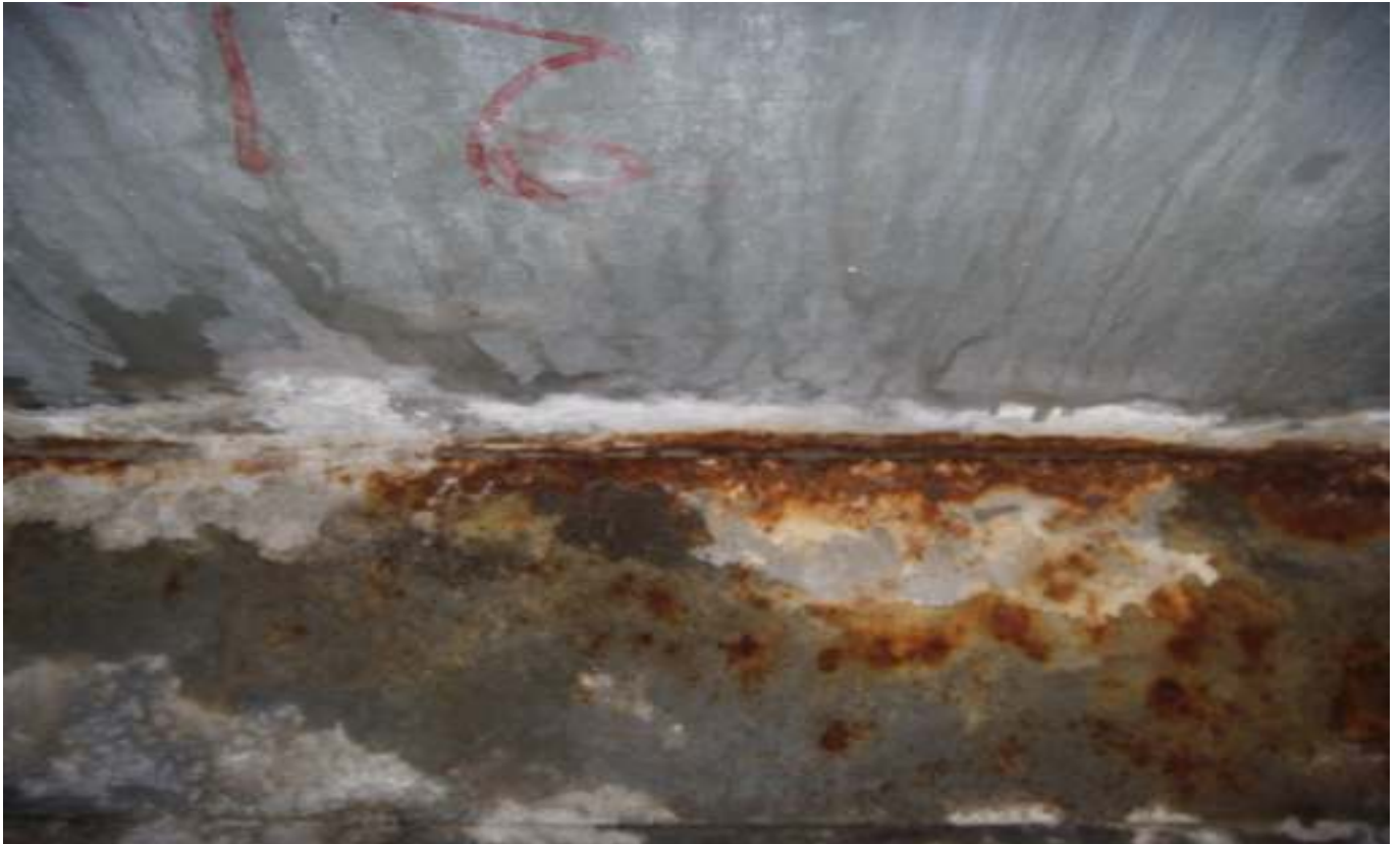
KUVA 7. Tuloilmakammioon on päässyt valumaan vettä.
