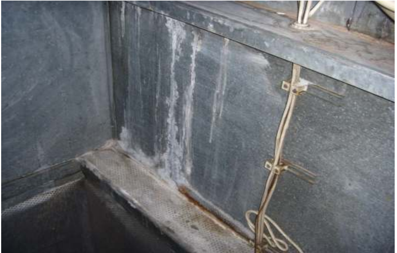
KUVA 3. Tuloilmakammio on pölyinen ja sinne on päässyt valumaan vettä.
