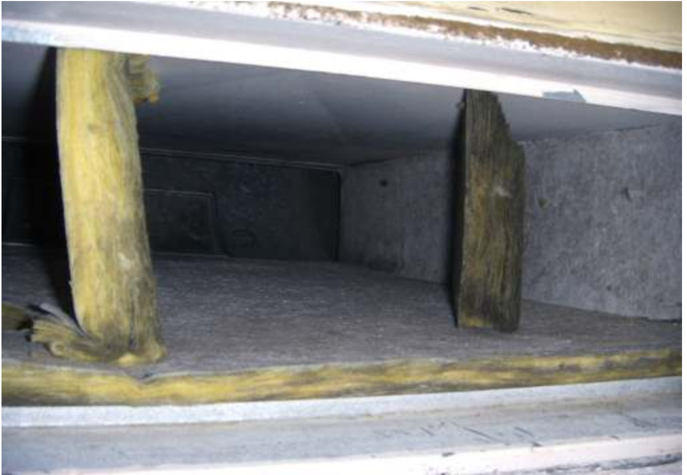
KUVA 13. Luokkahuoneen n:o 192 tasauslaatikko on vuorattu mineraalivillalla.
