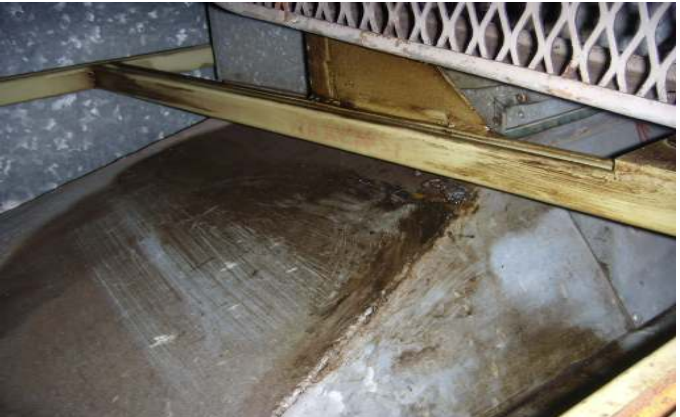
KUVA 2. Tuloilmakammiossa on öljyjälkiä.
