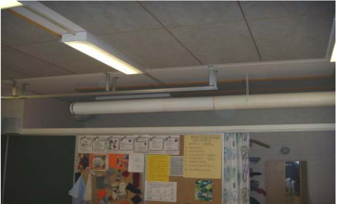
KUVA 15. Yleiskuva käsityöluokan tuloilmaputkesta.
