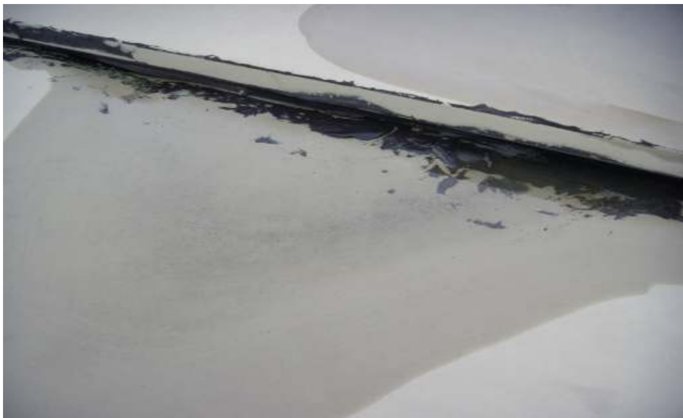
KUVA 12. Suojaellityksen saumoista saattaa päästä sadevettä kanavien eristykseen ja sieltä kanaviin sisälle.
