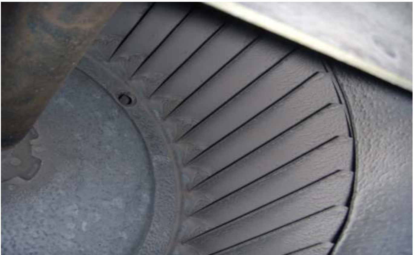
KUVA 6. Tuloilmapuhallin on pölyinen.
