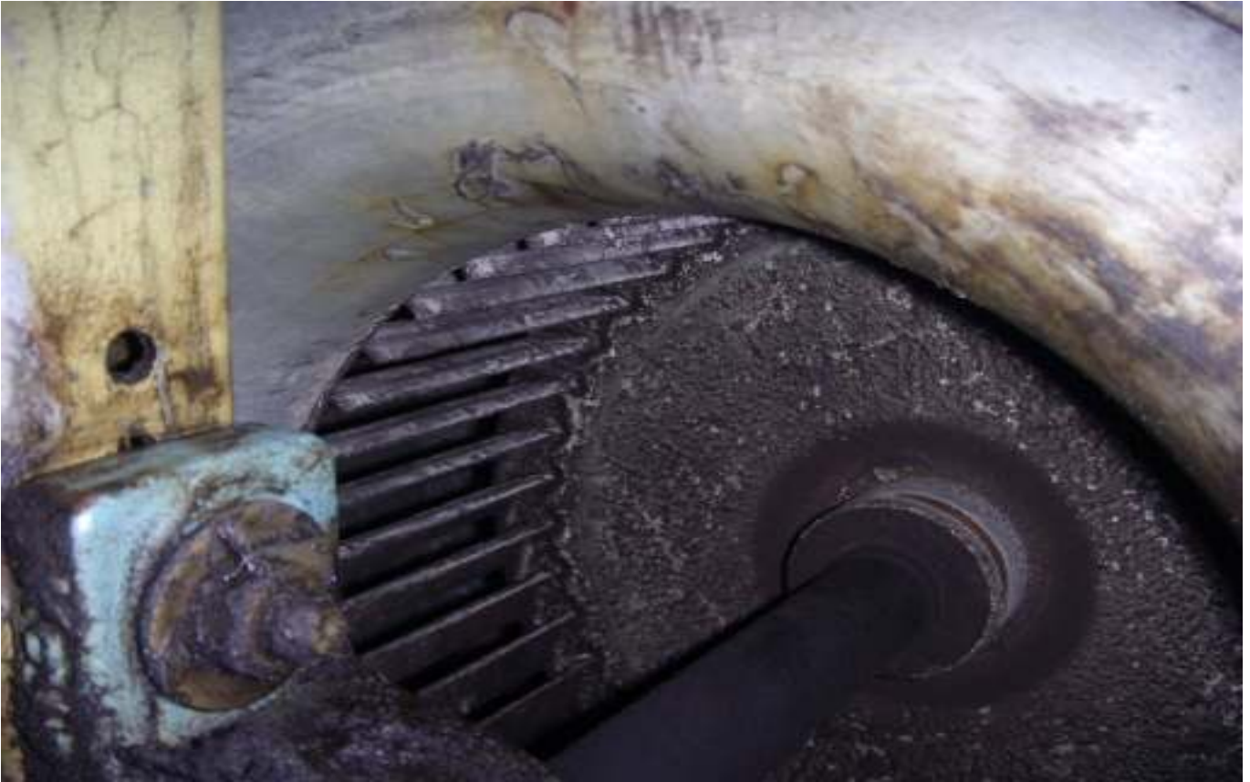
KUVA 1. Tuloilmapuhallin on melko likainen.
