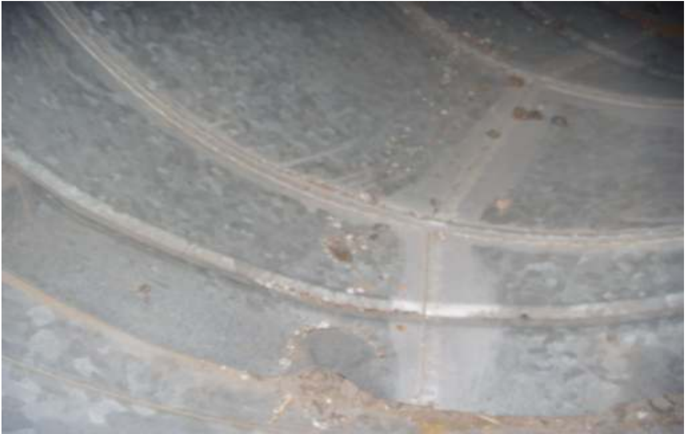
KUVA 9. Vesikaton poistoilmakanavassa on hieman soraa.
