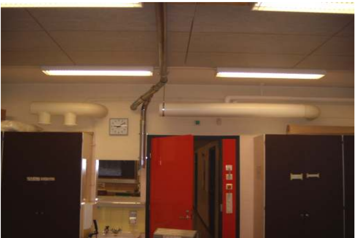
KUVA 16. Käsityöluokan tuloilmaelin on aivan oven yläpuolella.
