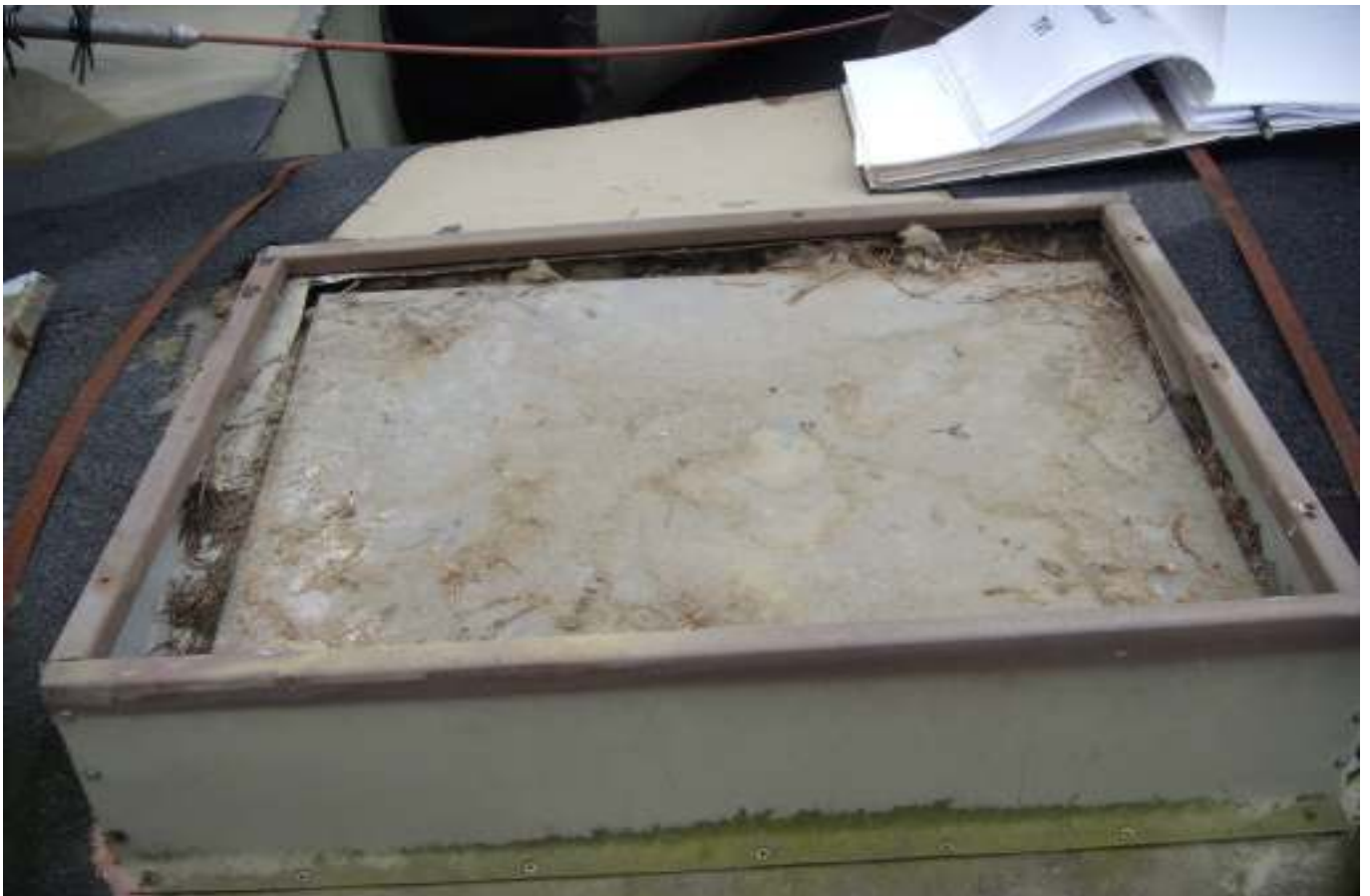
KUVA 10. Puhdistusluukkujen kiinnitysruuvit puuttuvat kokonaan.
