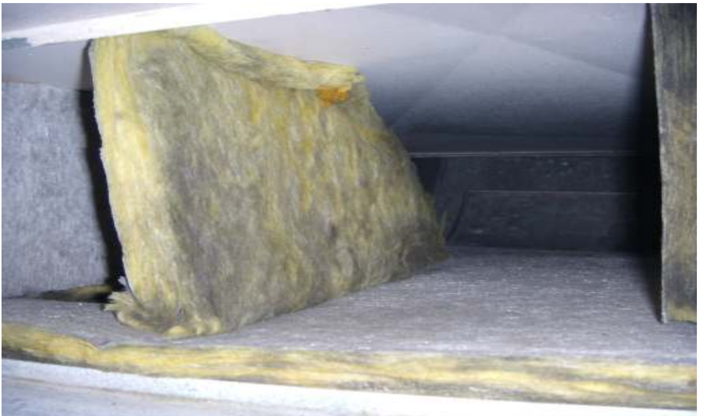
KUVA 14. Luokkahuoneen n:o 192 tasauslaatikko on vuorattu mineraalivillalla.
