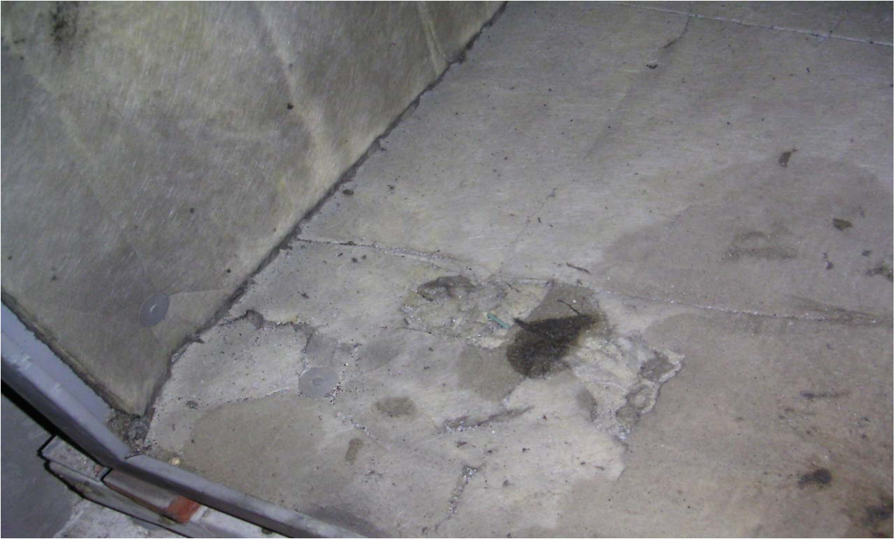
KUVA 1. Koneen kammion seinät on vuorattu mineraalivillalla, joka on alttiina kolhuille.
