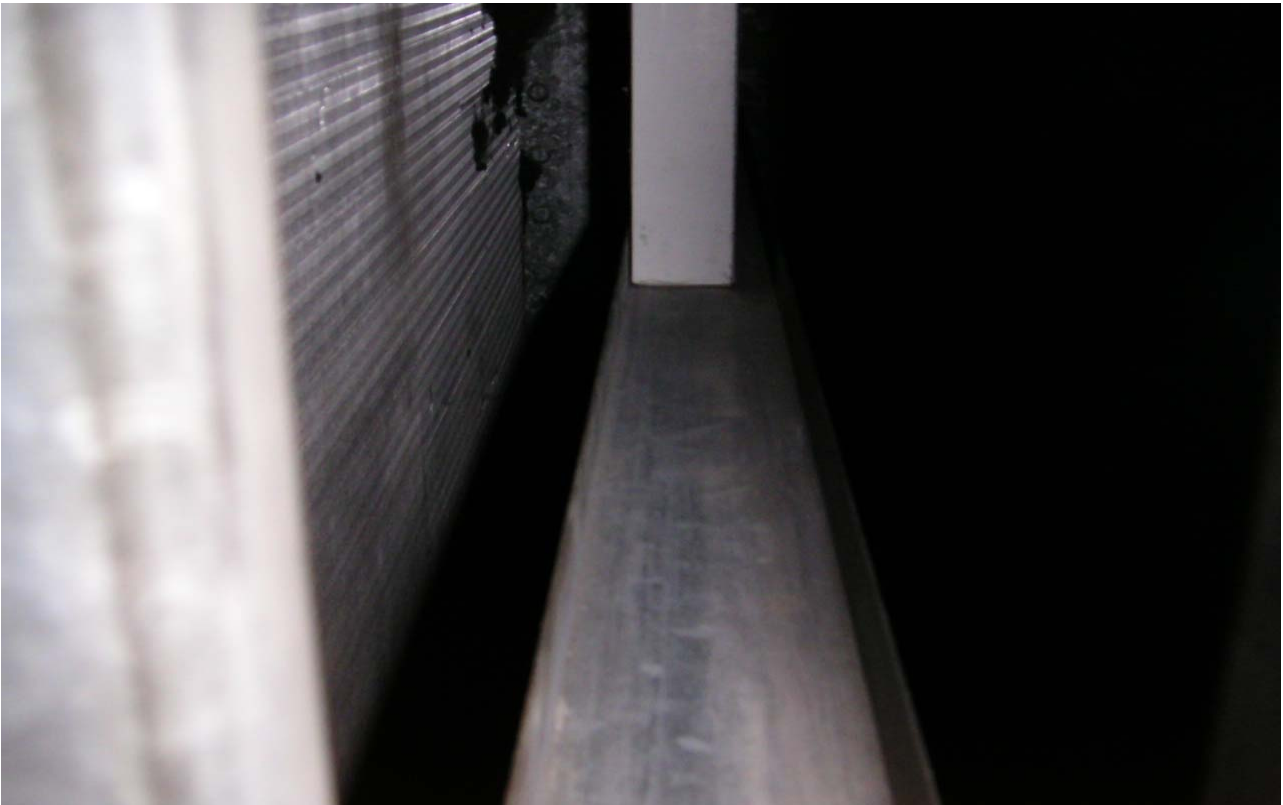
KUVA 2. Lämpöpatteri on likainen.
