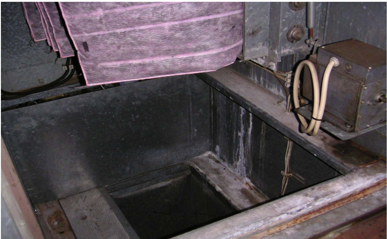
KUVA 6. Tuloilmakammioon on päässyt vuotamaan vettä.
