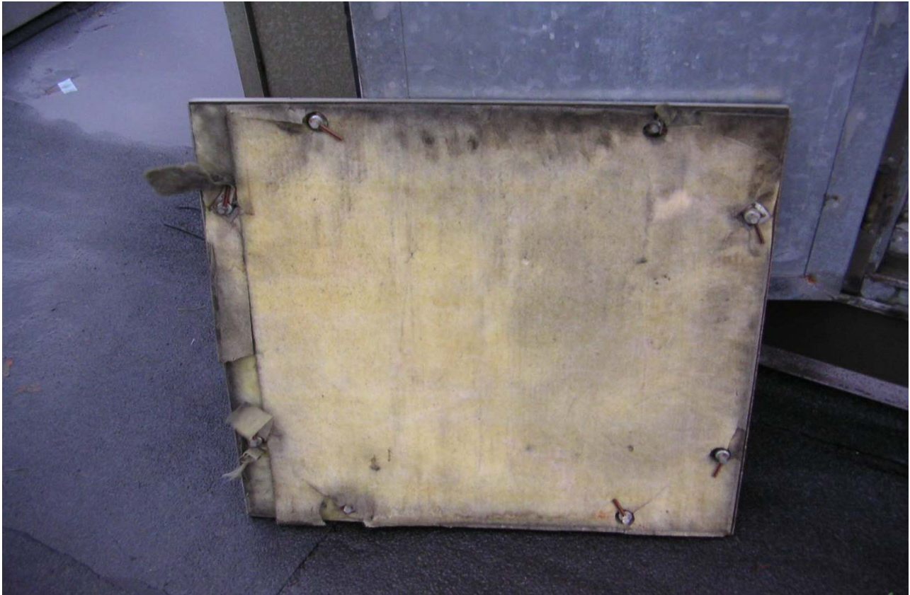
KUVA 7. Suodatin luukussa on villapinta, joka on paikoin rikki.
