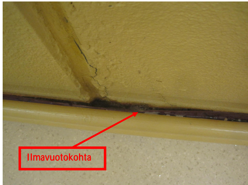
Kuva 2. Esimerkki kuva on luokkahuoneen 187 ulkoseinän ilmavuotokohdasta.
