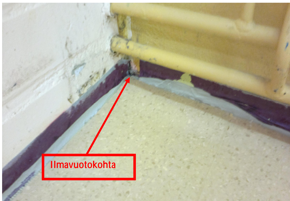
Kuva 5. Esimerkki kuva on luokkahuoneen 154 ulkoseinän ilmavuotokohdasta.
