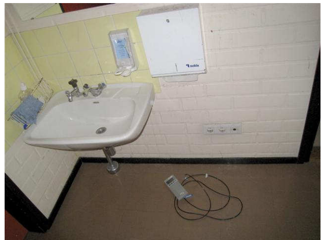
Kuva 8 Lavuaarien alta kosteusmittaus musiikki-luokan 115 kohdalla.
