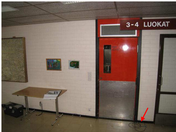
Kuva 9 Ruokalan ja keittiön välisen oven edustalla on kosteus koholla PRL27 .
