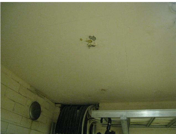
Kuva 5 Kosteusvaurioita sähköpääkeskustilan 031 katossa, pintakosteudet koholla.
