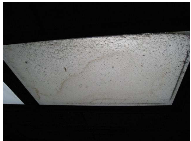
Kuva 10 Ruokalan kattokuvun lasin päällä on likaa ja vuotojälkiä .
