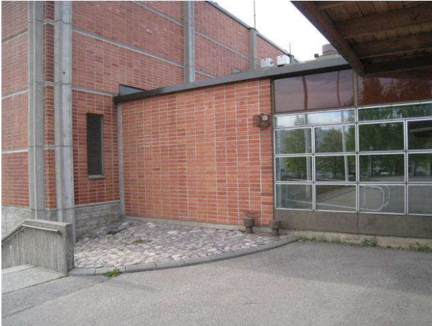
Kuva 7 Pääsisäänkäynnin vierusta, jossa aulan luiskan kohdalla kosteus on koholla.
