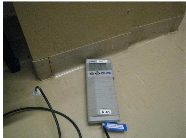
Kuva 4 Pukuhuone 016 putkikotelon vieressä kosteus on koholla LPR15
