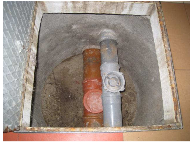
Kuva 14 Viemärikaivoissa ei ole tiiviitä tuplankansia, kaivon pohja on melko kuiva. Kaivojen syvyys on 1–2 metriä
