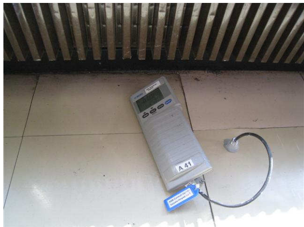
Kuva 6 Spk 031 yläpuolella aulan 101 luiskan alapäässä kosteus koholla LPR23.
