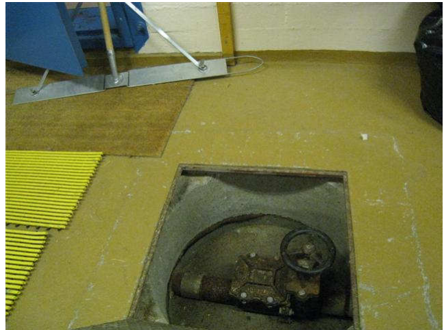
Kuva 2 Väestönsuojatilan VSS 032 venttiilikaivo, jonka pohja on kostea.
