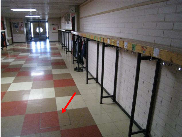
Kuva 13 Soluauula 151, jossa on putoamisriskin aiheuttava neliönmallinen viemärien tarkastusluukku lattiassa.
