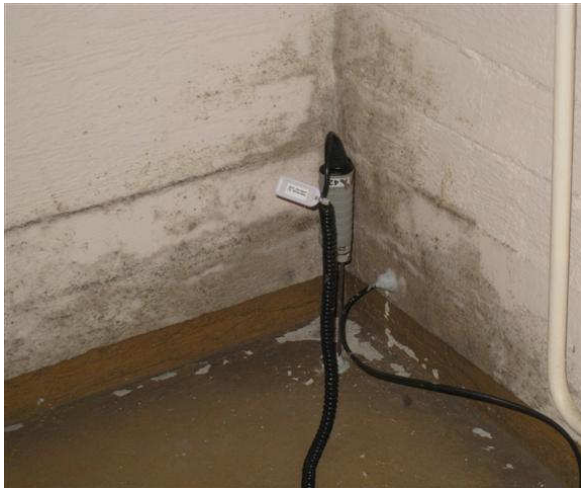
Kuva 1 VSS 032 hieman homeinen nurkka, josta mittaukset PRS 9, PRS10 ja PRL10. Lattiakosteus hieman koholla.
