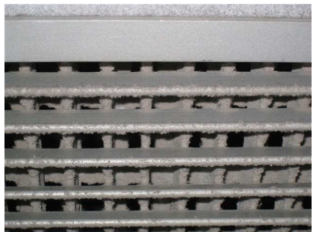
Kuva 12 Tuloilmaventtiili on likainen ruokalan ka-tossa.
