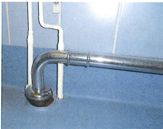
Kuva 1. Tilan 130 teräksisen pesualltaan viemäriiliitos ei ole tiivis.
