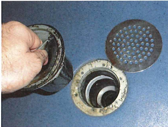
Kuva 3. WC-tilan 134 vesilukko on irrotettavissa puhdistusta varten.
