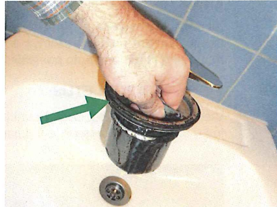
Kuva 4. Irrotettu lattiakaivon vesilukko. Kumitiiviste, joka estää veden virtauksen vesilukon sivuilta ja viemärikaasujen pääsyn huoneeseen, on osoitettu nuolella.
