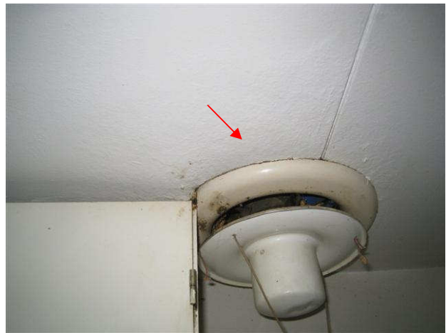
Kuva 38 Keittiön poistoventtiili, jonka ympärillä oleva lastulevy on kosteusvaurioitunut.
