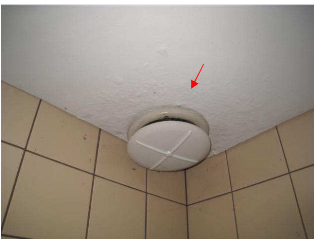
Kuva 41 Suihkunurkan kohdalla olevan venttiilin ympärillä on kosteusvaurio levyssä.
