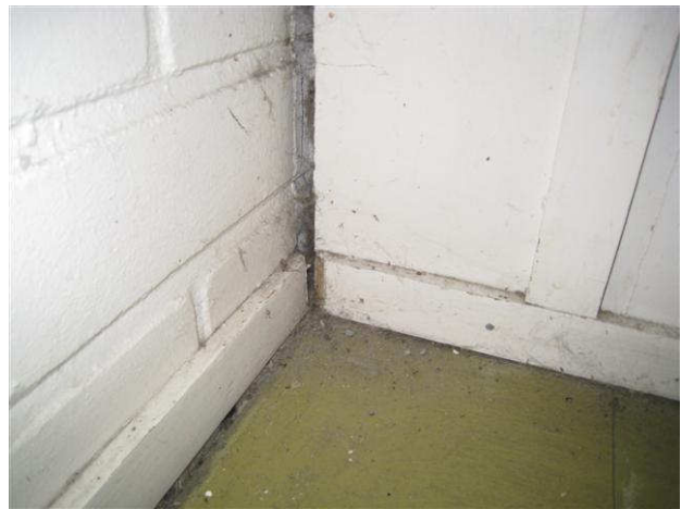
Kuva 44 Yhteisaulan lattian ja huoneiston välisen seinän rajalle on tullut 1,5 cm rako peruslaatan liikkumisen takia.
