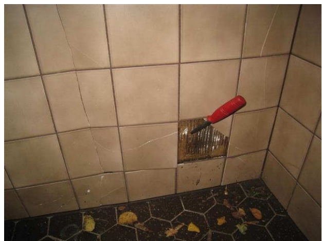
Kuva 40 Kosteus- ja mikrobivaurioitunut lastulevyseinä suihkunurkassa.
