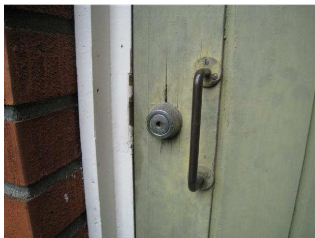
Kuva 29 Ulko-ovien maalipinnat ovat kuluneet.
