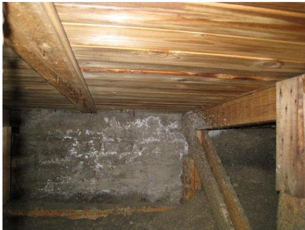
Kuva 3 Huoltorakennuksen piipun vesijälkiä.
