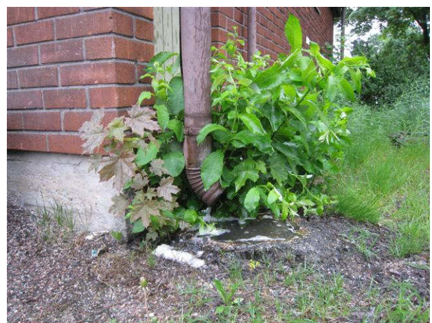
Kuva 24 Syöksytorvien päistä ei ole johdettu vesiä, vaan ne painumat perustuksiin ja salaojiin.
