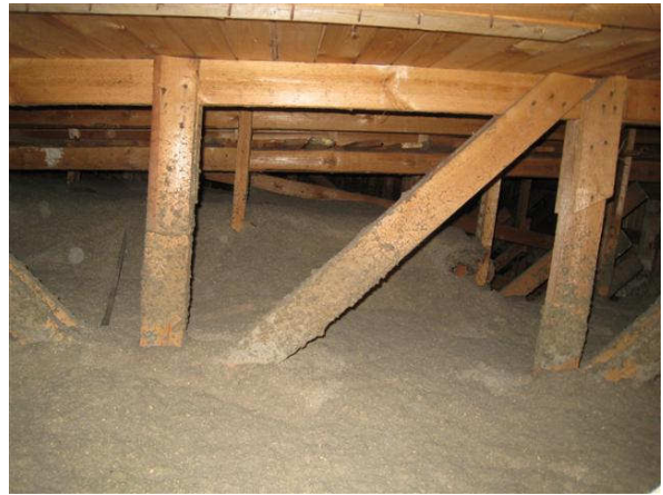
Kuva 20 Yläpohjaontelossa ei ole palokatkoja.
