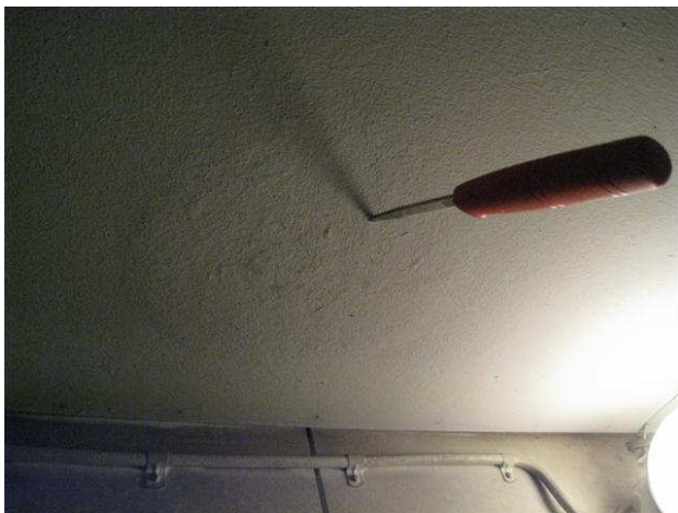
Kuva 5 Kosteus- ja mikrobivaurio huoltorakennuksen katossa.
