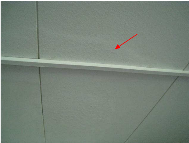
Kuva 39 Kosteusvaurioitunut kattolevy huone-tilan katossa.
