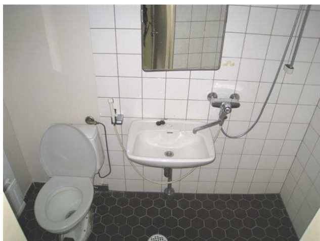
Kuva 35 Tyypillinen wc-suihku-tila, jossa suihkun kohdalla ollut aiemmin amme. Suihkun kohdalla on puurakenteinen seinä.
