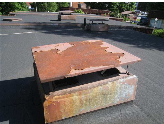
Kuva 17 IV-piipun pellitykset ovat ruosteessa.
