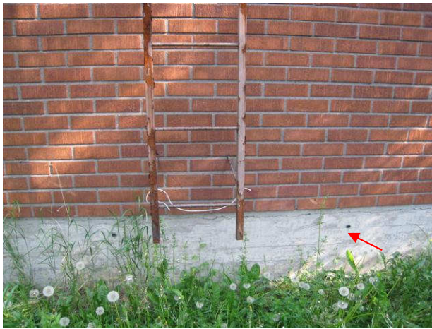
Kuva 21 Ruostuneet talotikkaat, tiilimuuraukset ovat pääosin ehjiä, sok. tuuletusputki.
