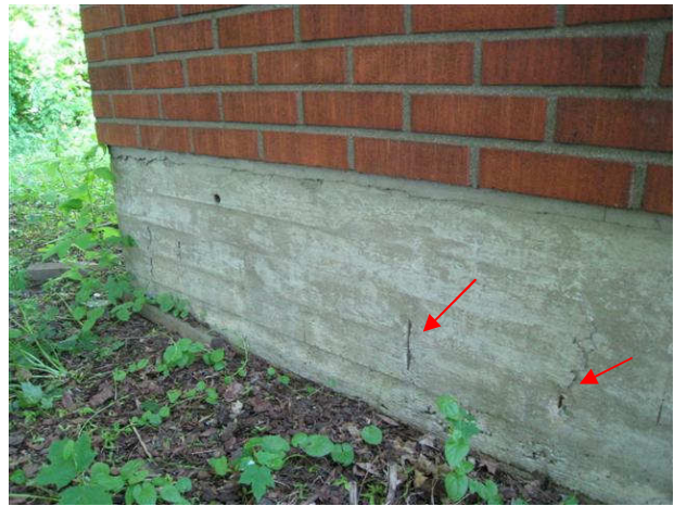
Kuva 22 Ruosteisia rakenneteräksiä pinnassa.
