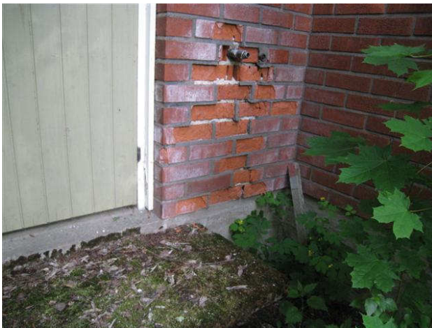
Kuva 23 Vesipostin kohdalla ovat tiilet rikkoutuneet kastumisen ja pakkasrapautumisen takia.
