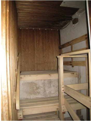
Kuva 7 Huoltorakennuksen kulunut sauna.
