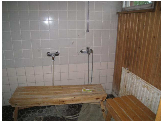
Kuva 8 Huoltorakennuksen pesuhuone, jossa on tapahtunut kosteusvaurioita.
