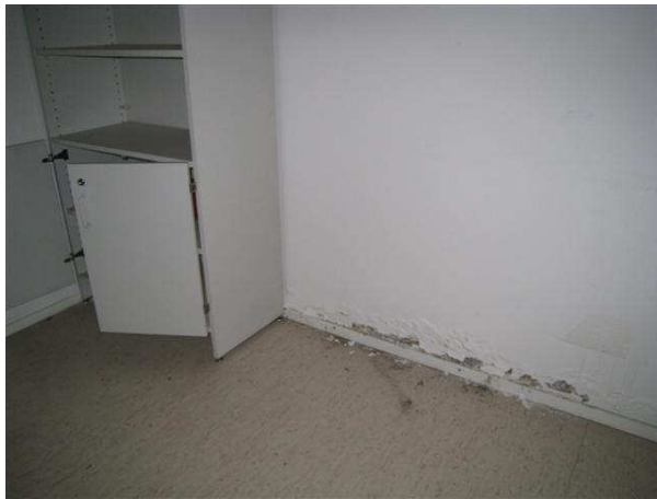
Kuva 9 Saunan pesuhuoneen kohdalla on kerhohuoneessa kosteusvaurioita.
