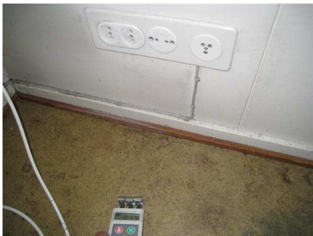
Kuva 47 Alkuperäisiä asennuksia ja pintamateriaaleja. Pintakosteus vastasi tässä normaalia.
