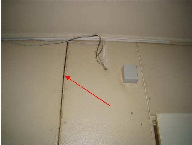
Kuva 43 Asunnon eteistilan levysaumassa on ylöspäin levenevä rako johtuen peruslaatan kallistumasta.
