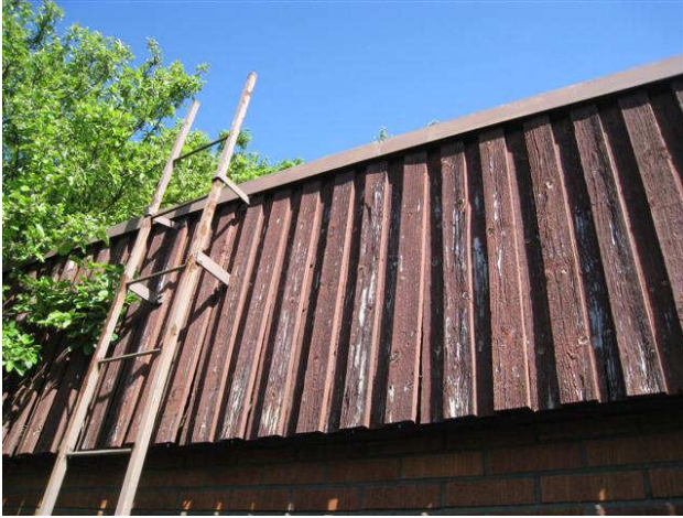
Kuva 25 Julkisivuissa on pulpettikattojen otsalaudat huonossa kunnossa.
