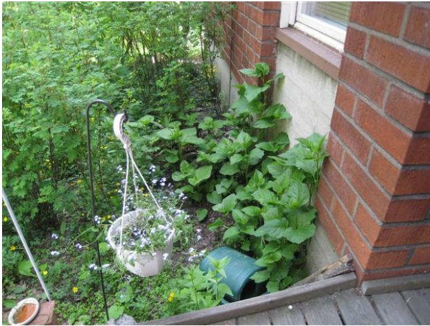
Kuva 27 Sokkelien vierellä on multamaata ja istutuksia.
