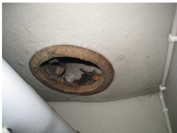
Kuva 6 Kosteus- ja mikrobivaurio IV-kanavan kohdalla katossa.
