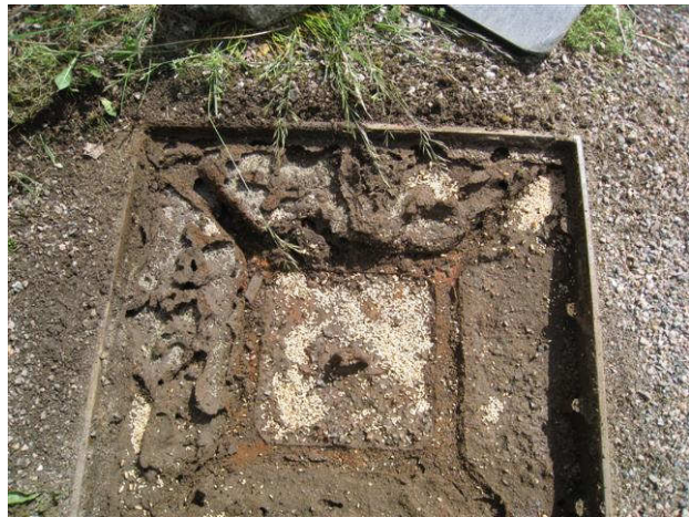
Kuva 52 Tätä tarkastusluukku ei ole avattu vähään aikaan.
