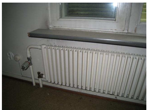
Kuva 48 Lämpöputkivedot on tehty lattiarakenteessa eristetilassa, mikä on vuotoriski.
