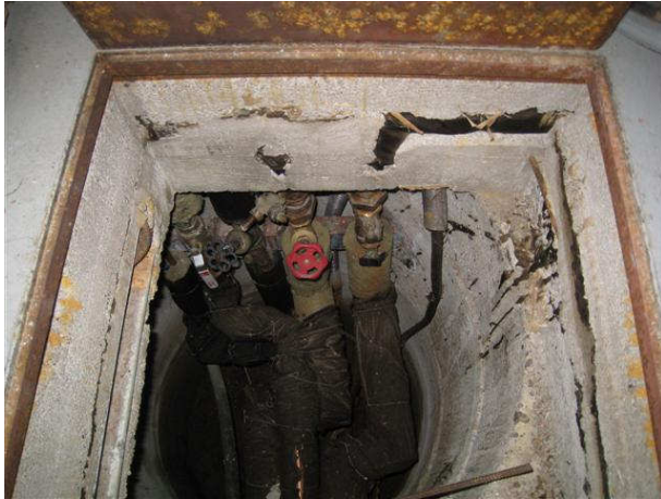
Kuva 55 Sähkö- ja putkinousukaivo C-D -talon yhteisvaraston lattiassa. Reunoilla on lastusementtilevyä
