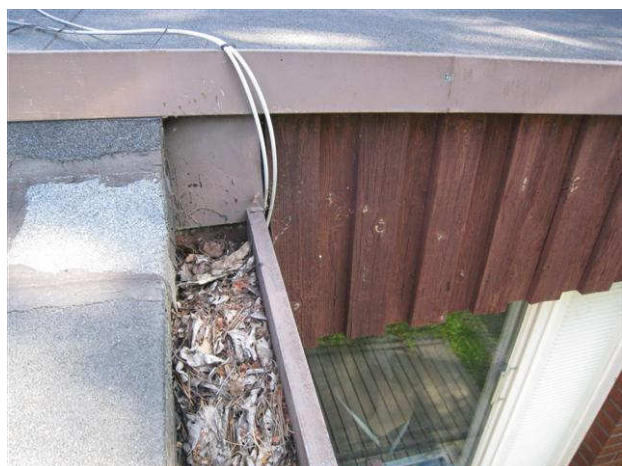
Kuva 18 Ränneissä on vanhaa lehtijätettä ja multaa. Rännit ovat ruostuneet.
