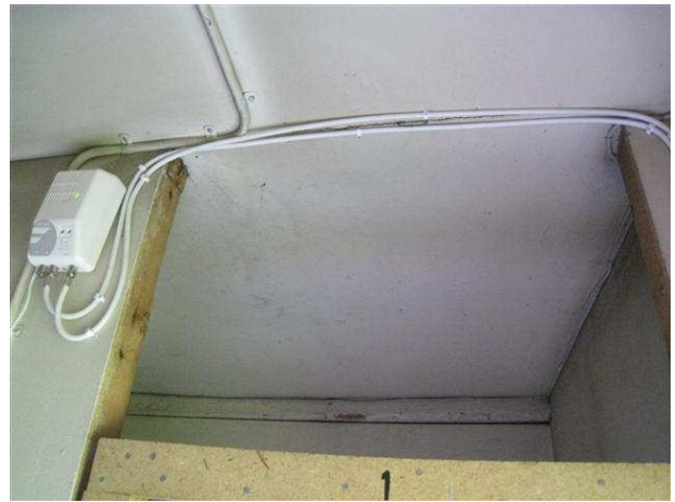
Kuva 50 Kosteusvaurioitunut kattolevy yhteisessä varastotilassa.
