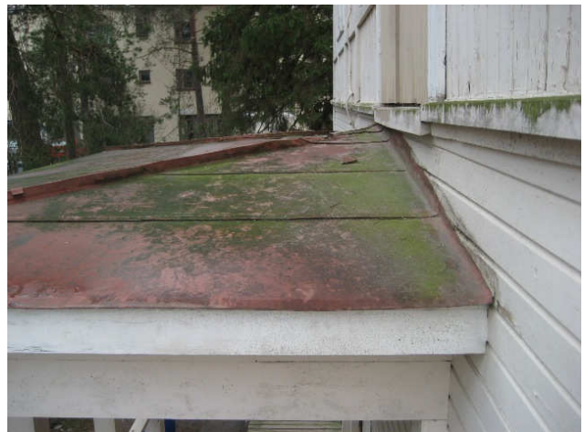
Kuva 14 Pohjoissivun sisäänkäyntikatoksen peltinosto seinälle ei ole riittävän korkea.
