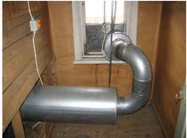
Kuva 24 IV-puhallin länsisivun kapeassa tilassa.
