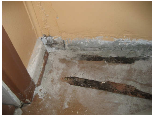
Kuva 34 Piipun juuressa 2. krs:ssa on homeista maton alustaa.
