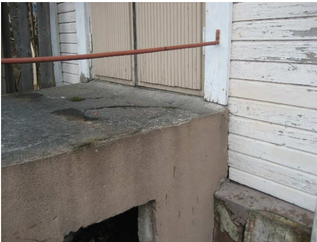
Kuva 5 Länsisivun betoniportaan ja ulkoseinän välissä voi olla lahovaurioita.
