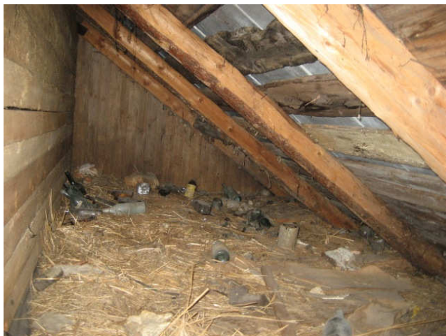
Kuva 25 Yleiskuva sivuonkalosta länsisivun eteläkulmalla. Osa laudoista on tummunut ja niissä on vuotojälkiä. Eristeenä on mm. olkia ja kutterinpurua.
