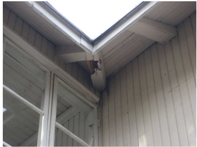
Kuva 16 Kuistin pohjoissivun ja ulkoseinän liittymän jiirin kattotuoli on laho.
