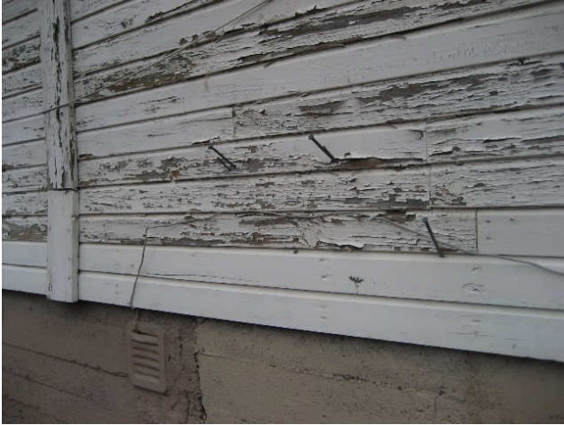
Kuva 15 Eteläpäädyn panelointia on uusittu alareunasta. Takana voi olla lahoa hirttä. Pystyjakolistaa on jatkettu.
