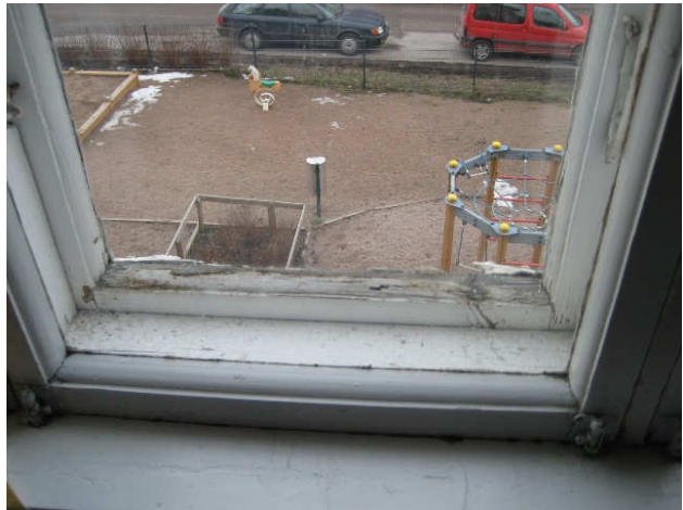
Kuva 30 Eteläpäädyn ikkuna 2. kerroksessa. Ulkopuutteessa on vuotojälkiä.
