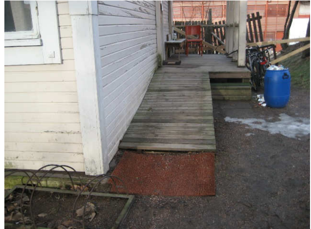
Kuva 6 Pohjoissivulla kulkusillan kautta roiskuva vesi rasittaa seinää.
