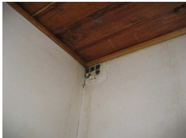
Kuva 36 1. krs:n wc-tilan ilmanvaihtoventtiili on jätetty väliseinän ja alakaton taakse.
