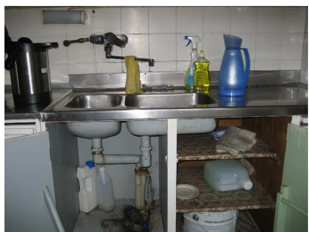
Kuva 32 Keittiön alakaapissa on kosteusvauriota.
