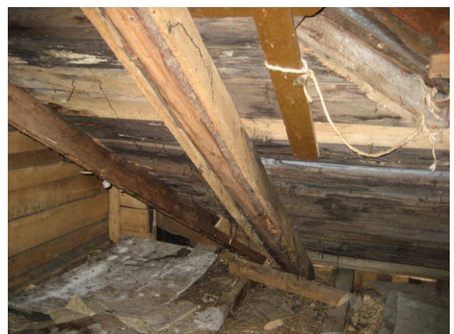
Kuva 26 Länsisivun pohjoiskulmalla oleva onkalo, jossa on katossa kulkuluukku. Katto-tuolia on joskus vahvistettu. Katossa on vuotojälkiä ja paikoin lahoa.
