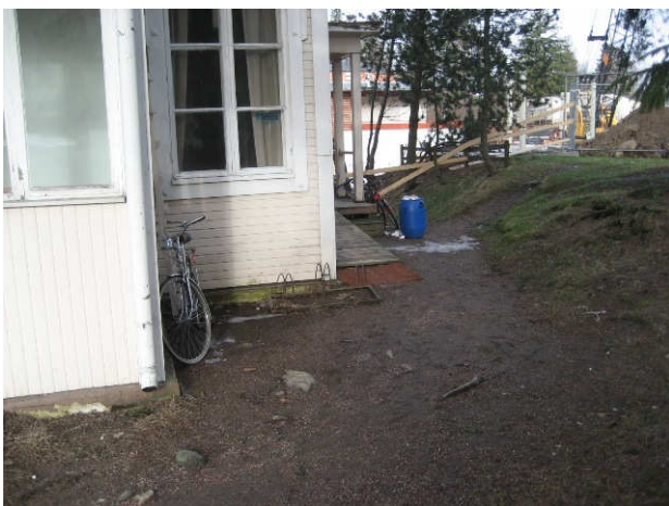
Kuva 1 Maan pinta viettää koilliskulmalla kohti rakennusta ja puurakenteita on hyvin lähellä maanpintaa. Rännivesiä ei ole johdettu loitommalle.
