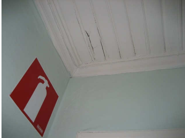
Kuva 33 Vuotojälkiä 1. krs:n paneelikatossa piipun juuressa.
