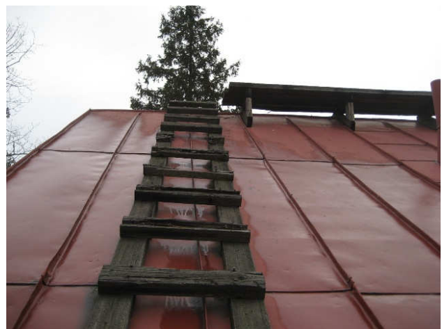
Kuva 18 Puiset kattotikkaat ovat lahot.
