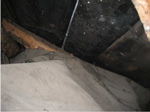
Kuva 21 Hiiltynyttä kattolaudoitusta piipun lähellä.
