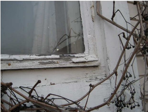
Kuva 29 Länsisivun 1. krs ikkunan alaosan kitti on osin irti. Vesipeltjeä ei ole.
