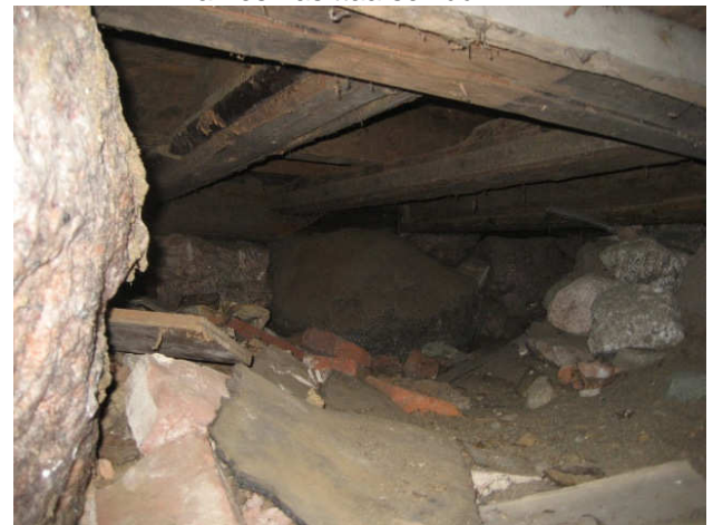
Kuva 8 Näkymä kulkuluukusta luoteiskulmalle, jossa vanhassa tukiorressa on lahoa.
