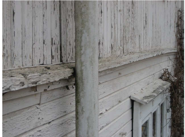
Kuva 12 Länsisivulla oleva jakolista ja ikkunan vuorilaudat ovat osin lahoja.
