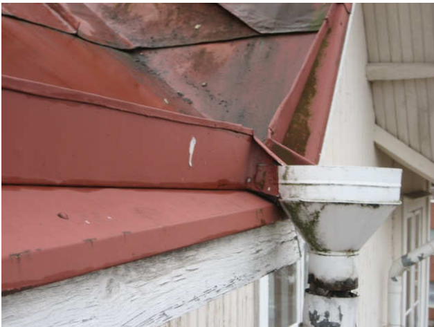
Kuva 17 Länsisivun jalkaränni ja liitoskohdasta katkennut syöksytorvi. Pellit ovat ruosteisia.
