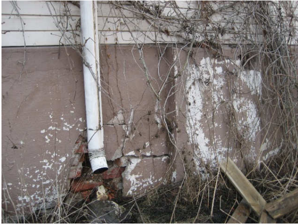
Kuva 3 Länsisivulla oleva sokkelivaurio johdetaan rännivesistä. Sokkelin ulkopinta on rapattua tiiltä, takana on kiviä ja/ tai säästöbetonia.
