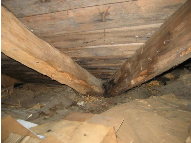
Kuva 27 Kuistin pohjoissivun ja ulkoseinän liittymän jiirin kattotuoli on laho, ks. kuva 16 vastaava kohta ulkoa.
