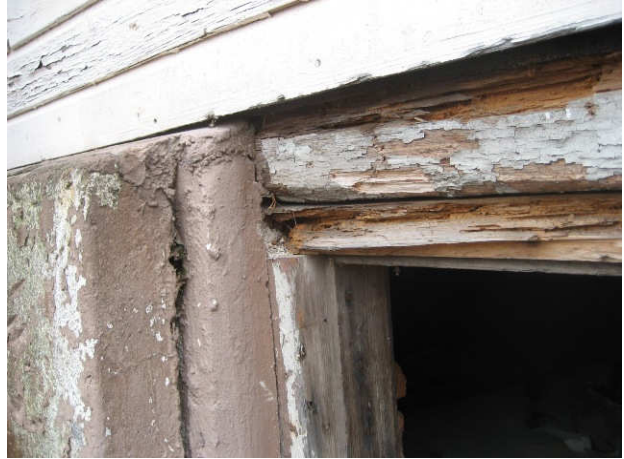
Kuva 4 Länsisivun kulkuluukun kohdalla on lahoa hirttä, jossa on hyönteisvaurioita. Sokkeliliittymä on väärin tehty, eikä puun ja kivirakenteen välissä ole bitumia tv.
