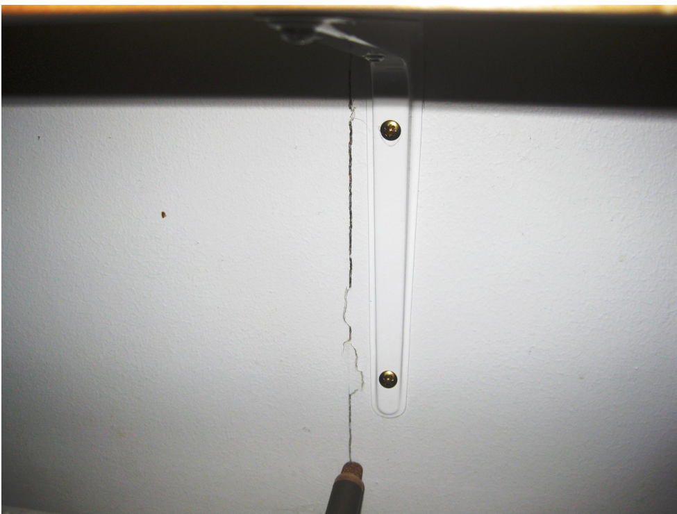
Kuva 8. Selvästi vaurioituneiden ulkoseinien alaosien, väliseinien ja ovikarmien yms. materiaalit poistetaan, mikäli vaurioita havaitaan.
