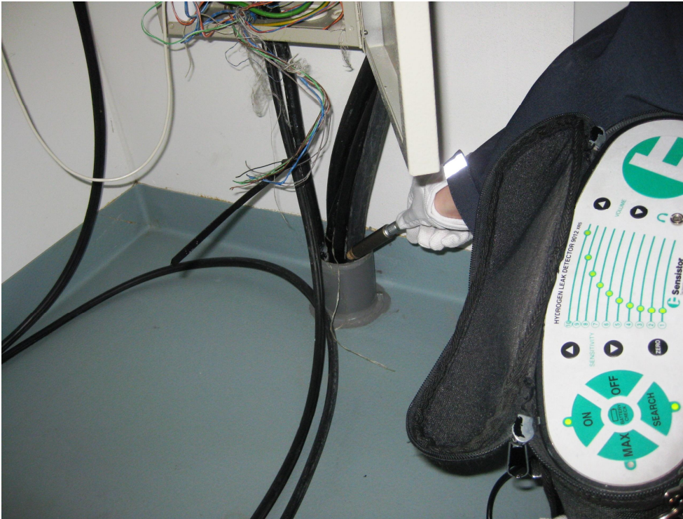
Kuva 1. Telehuoneen 113 tiivistämätön kaapeliläpivienni.
