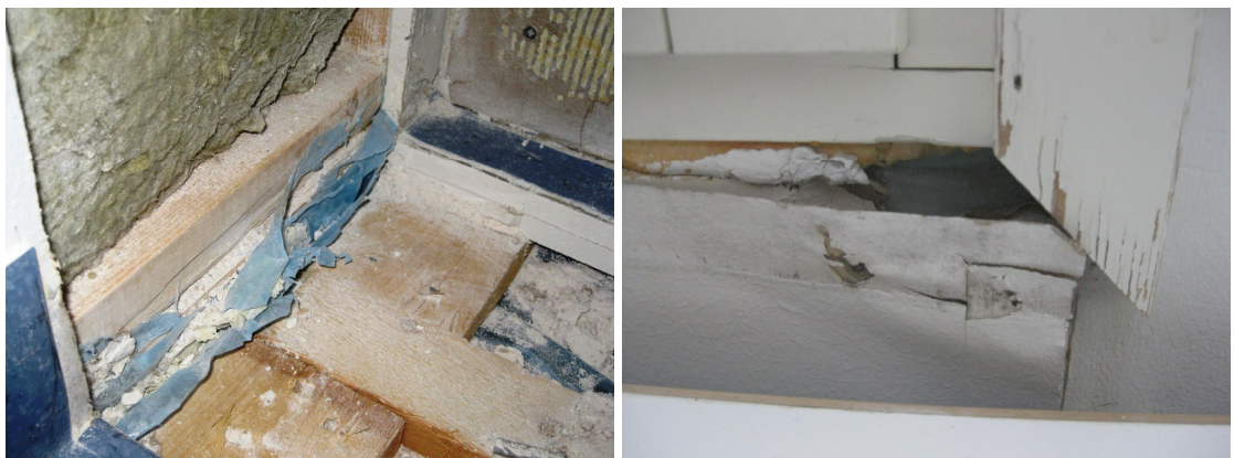
Kuva 4. Opetustilan 132 rakenneavauskohta ja vesivuotojen seurauksena vaurioitunut ikkunalistoitin. Listan takaa oli havaittavissa höyrinsulun päättyvän kipsilevyn kanssa samaan tasoon.
