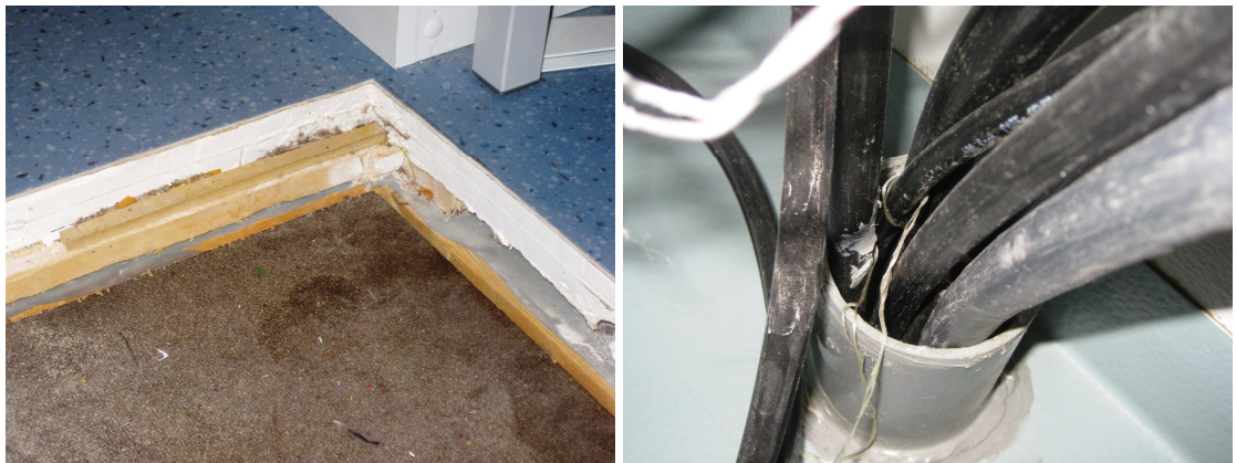
Kuva 1. Alustatilan kulkuluukku ei ole ilmatiivis. Telehuoneen 113 alapohjarakenteen kaapeliläpivientien suojaputki on tiivistetty, mutta suojaputken ja kaapeleiden väli on tiivistämättä.
