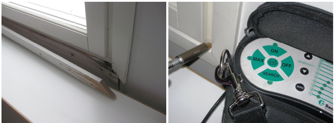
Kuva 2. Merkkiaineanalyysointilaavimalla havaittiin merkkiainetta ikkunaliittymistä.
