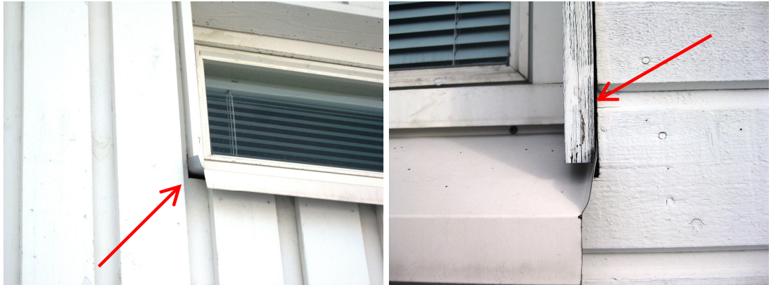
Kuva 5. Ikkunan vesipellitöiden alapuolella on paikoin isojakin rakoja, joista viistosade voi päästä rakenteen sisälle. Ulkopuolella olevan smyygilaudoituksen ja vaakapaneloinnin välissä on selviä rakoja, joista sade vedellä on mahdollisuus päästä rakenteen sisälle.
