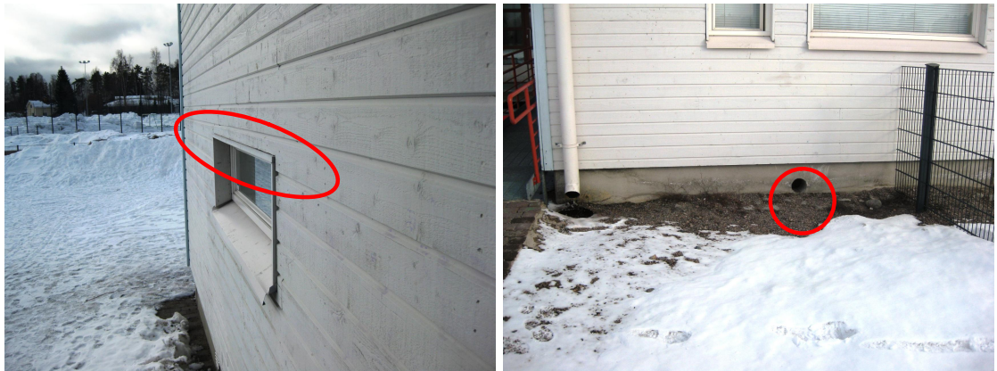
Kuva 6. Ikkunan yläpuolella oleva laudassa ei ole kallistusta. Alustatilan korvausilmakot sijaitsevat sokkelissa lähellä maanpintaa. Osasta puuttuu ritiläventtiili.
