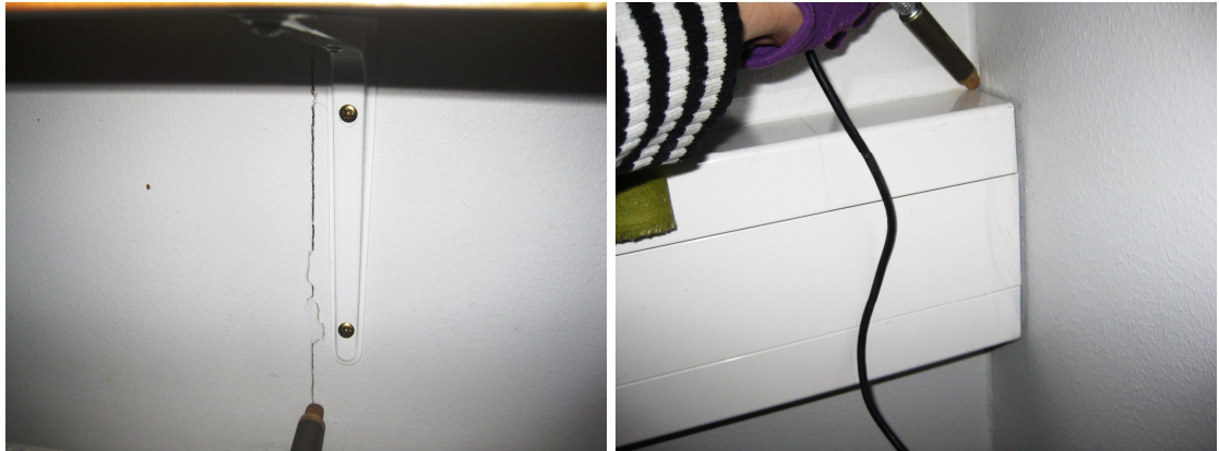
Kuva 3. Merkkiaineanalysaattorilla havaittiin merkkiainetta ikkunaliittymien lisäksi seinän halkeamien sekä sähkökoteloinnin ympäristöstä.
