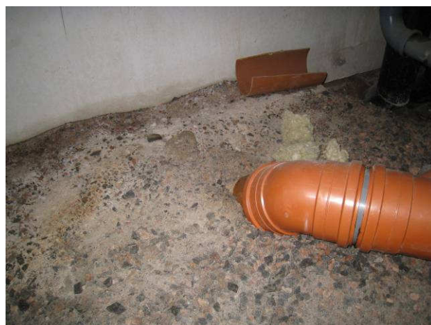
Kuva 18 Mikrobikasvua länsipäädystä tuulikaapin 101 alapuolella.
