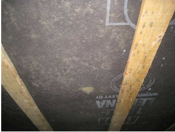
Kuva 19 Vähäistä mikrobikasvua kulkuluukun lähellä opetusvälinevarasto 131 alla.
