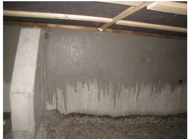
Kuva 4 Sokkelipalkin tuenta ja voimakasta kondenssia pohjoissivulla itäpuoliskolla.
