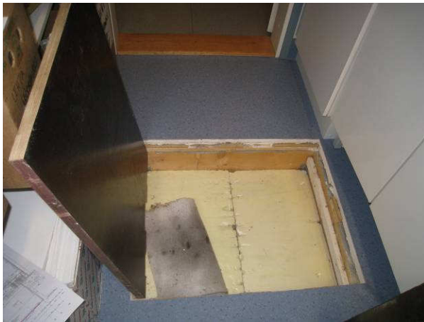
Kuva 9 Tilassa 131 oleva alustatilan luukku ei ole tiivis.
