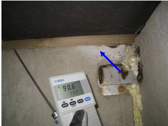
Kuva 25 Eteläsivun kaakkoisnurkalla ilman kosteus 91 % RH, kondenssia.
