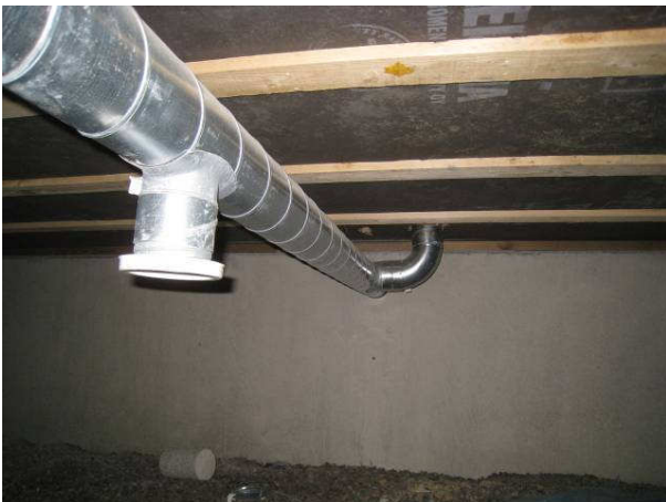
Kuva 23 Keskialueen poistokanava ja venttiili, sekä nousu tilojen 130–131 välistä.
