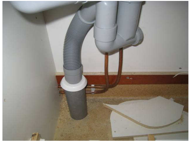
Kuva 14 Esiopetustilan 135 alakaapissa oleva viemäri liittymä ja muovimaton juurinos-to.
