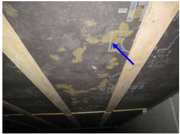
Kuva 20 Selvää mikrobikasvua tilojen 133 ja 135 alla.
