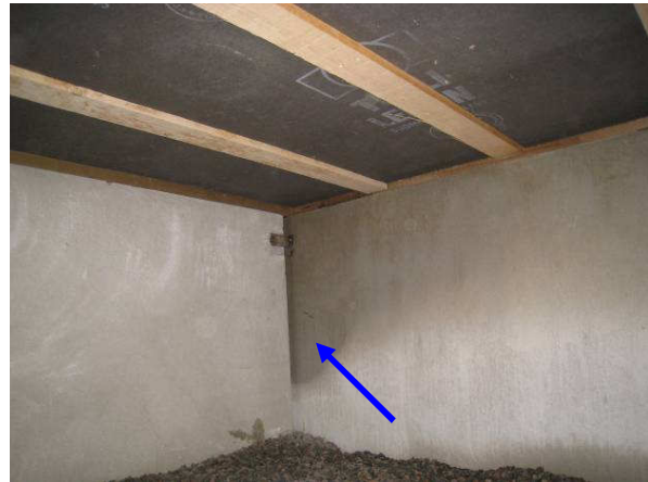
Kuva 26 Itäpäädyn sokkelipalkin ja keskialueen palkin liittymä, kosteus tiivistyy sokkelipalkkiin nurkassa.
