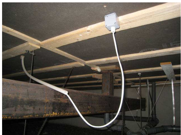
Kuva 24 Poistomurin lämpötila-anturi spk-tila 108–tele 113 alapuolella.
