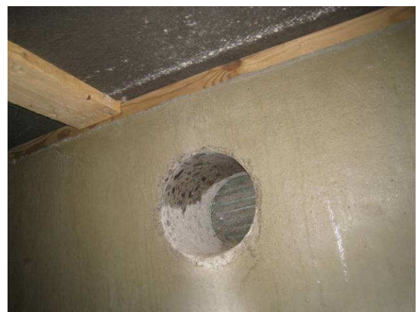
Kuva 22 Länsipäädyn keskiontelon venttiiliaukko, sokkelipinta on märkä, venttiili likainen.
