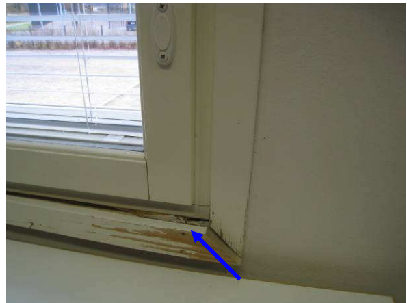
Kuva 28 Kosteusvaurioita eteläsivun ikkunassa opetustilassa 132.
