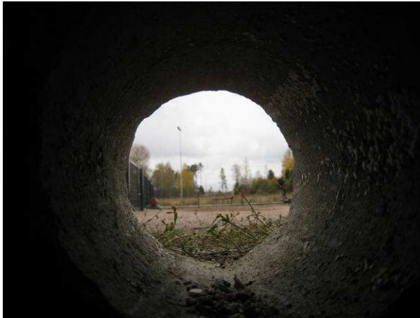
Kuva 21 Korvausilmareitit on tehty lähelle maanrajaa, venttiili puuttui (ilkivalta).
