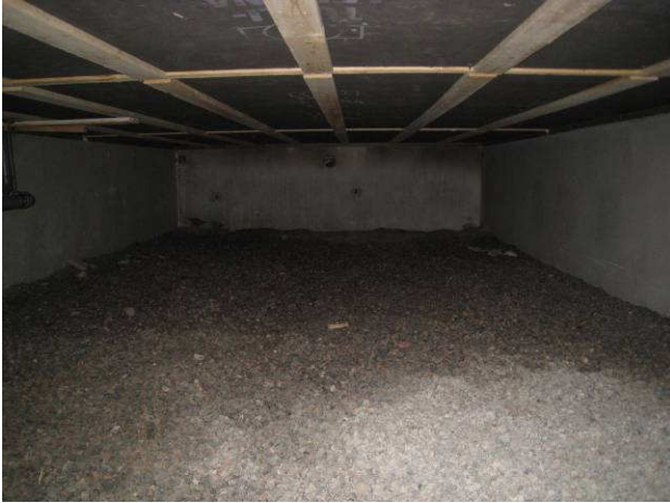
Kuva 1 Keskiontelotila, venttiili perällä, maanpinta on kostea.
