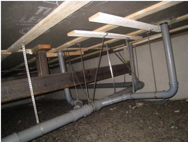
Kuva 3 Teräsrakenteita, joita ei ole maalattu.
