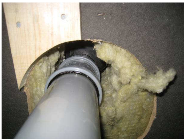
Kuva 11 Hulppea viemärin läpivienti on tiivistämättä.
