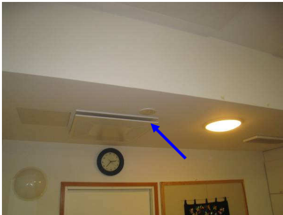
Kuva 27 Sijoitukseen nähden vääränlainen tuloilmaventtiili leikki- ja lepotilassa 133.
