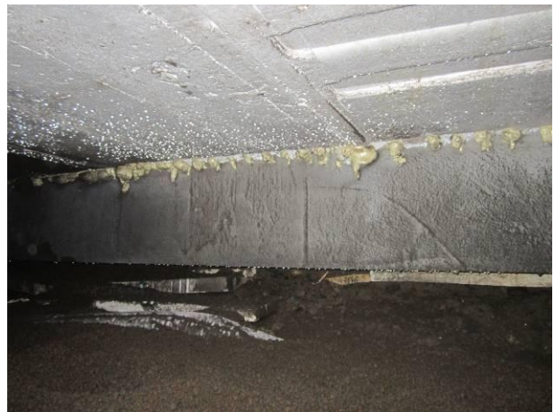
Kuva 14 Kevytsoran pinta on kostea, alapohjan styroxxkatto on täynnä vesipisaroita.
