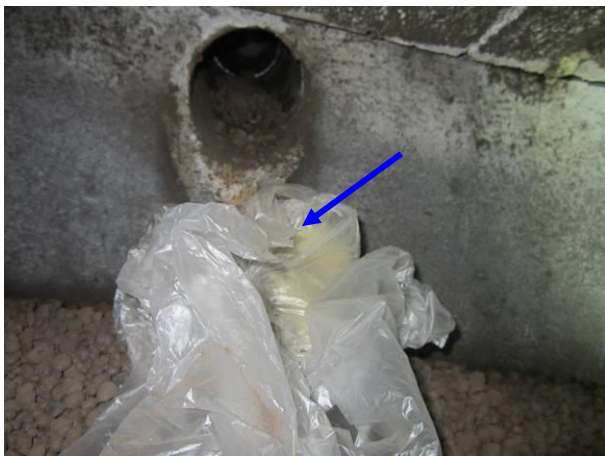
Kuva 7 Alustatilan puolelta muovilla ja villalla tukittu korvausilmaventtiili prh 62 alla.
