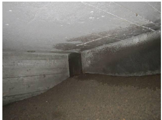
Kuva 20 Lepoh 39 alla kulmaus kohti yhteistilaa 40, kostea sokkelipalkki, vastatäyttö ok.
