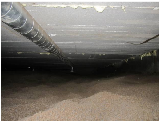
Kuva 19 Tilojen Rh30–Rh 37 alusta on kuiva, sokkelipalkki on kostea.
