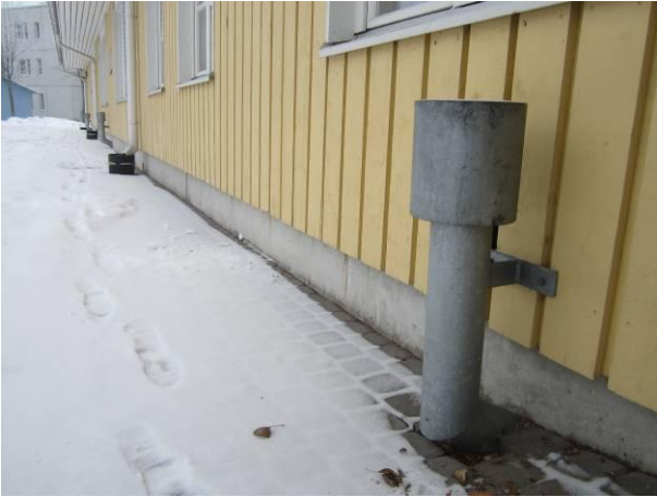
Kuva 3 Käyttämätön korvausilmaputki, maanpinnat ovat tasaiset rakennusvierellä.
