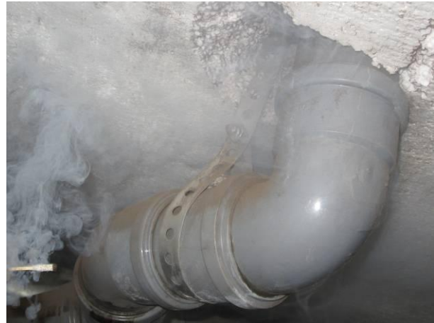
Kuva 22 Muutama viemäritiivistys on tekemättä mm. Kuraet 60 seutuvilla. Savukokeen mukaan ei havaittu ilmavuotoa.
