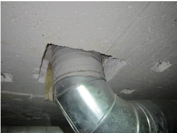
Kuva 23 Alustatilan IV-kojeen kanavaläpiviennit ovat tiivistämättä.
