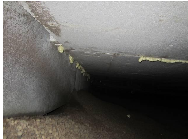
Kuva 24 Sokkelireunoilla paikallinen tiivistyspuute prh 62 seutuvilla.
