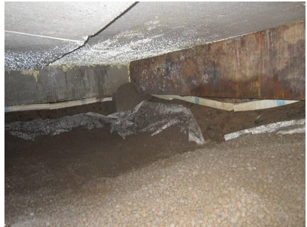
Kuva 18 Tilan Rh 25 kostea kulmaus ja painanne, lisäksi märkää muottivaneria.
