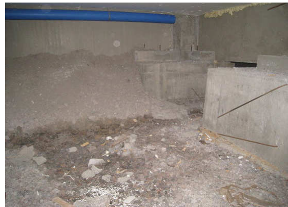
Kuva 6 Kostea sepeliä, pinnalla puusälää. Harjateräkset sojottavat vaarallisesti.
