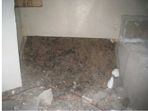
Kuva 20 Sokkeli-elementin alla kostea hiekaista soraa.
