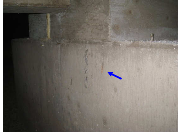
Kuva 8 Betonipinnoilla on paikoin muottivanerilevyn jäämiä.
