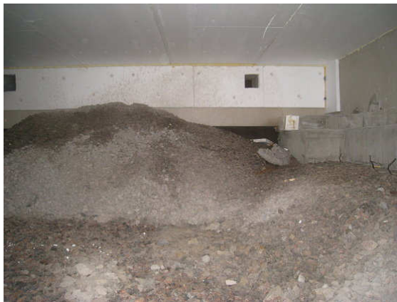
Kuva 15 Kostea sepeliä. Vastatäyttö puuttuu.
