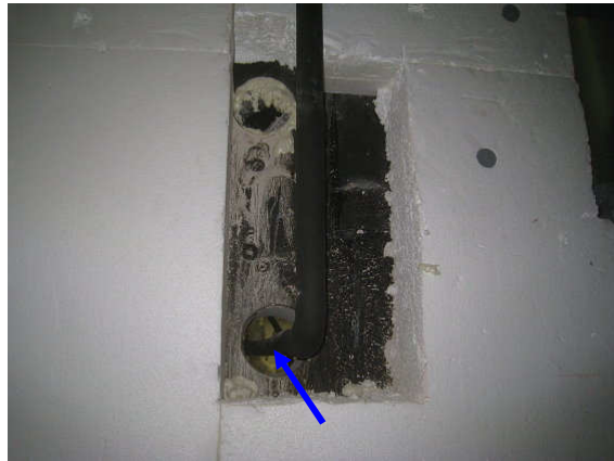
Kuva 22 Alustatilasta yhteys lämmönjakohuoneeseen putkiläpiviennin kautta.
