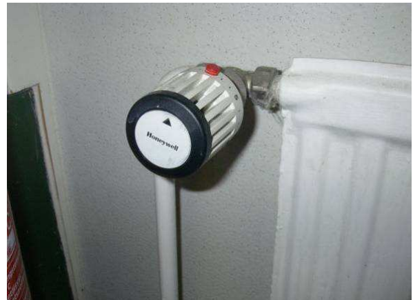
Termostaattiset patteriventtiilit ovat vanhoja.
