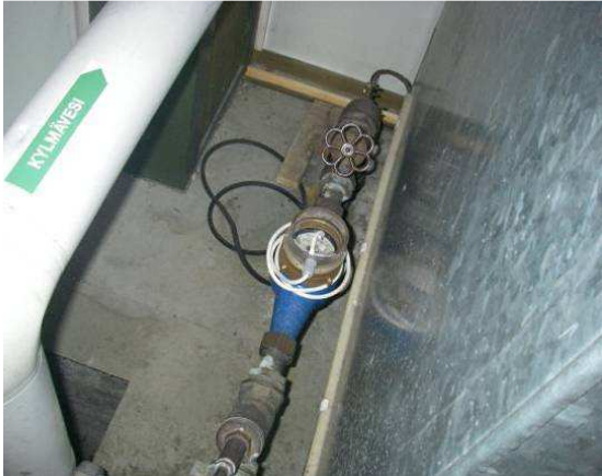
Vesimittari. Tonttijohto ja sulut ovat vanhoja 1970 luvulta.
