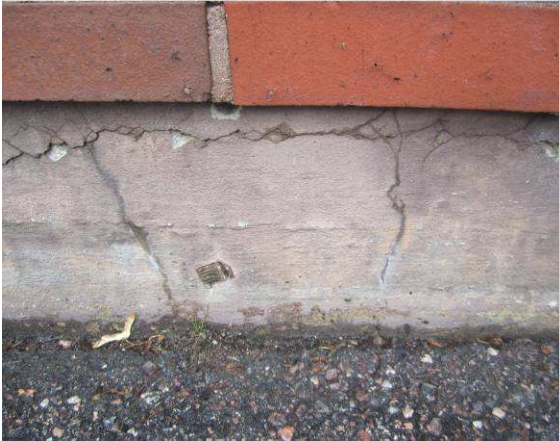
Sokkelipinnoissa oli paikoin havaittavissa pintavaurioita.
