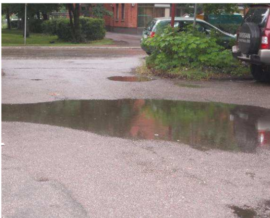
Vesi pääsi lammikoitumaan piha-alueille.
