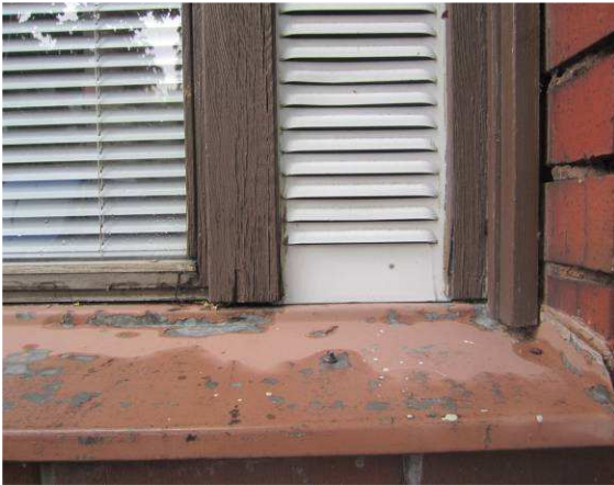
Ikkunoiden ulkopuitteiden/vesipeltien kunto oli heikko.
