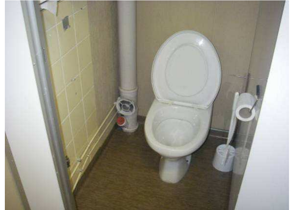
Vesi- ja viemärikalusteet ovat 1980 luvulta.
