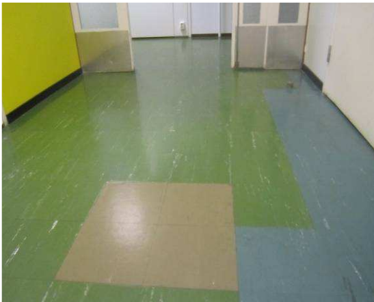
Lattiapinnoitteet olivat kokonaisuutena tyydyttävässä kunnossa.
