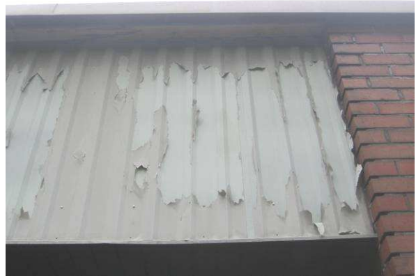
Peltiverhouksen maalipinnat olivat paikoin heikossa kunnossa.
