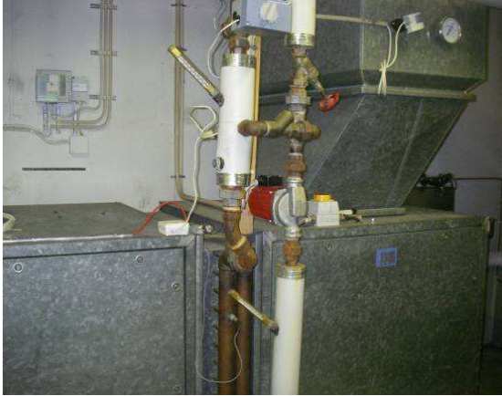
Tuloilmakone sijaitsee lämmönjakohuoneessa.
