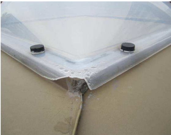
Kattoikkunoiden kulmissa esiintyi vaurioita.
