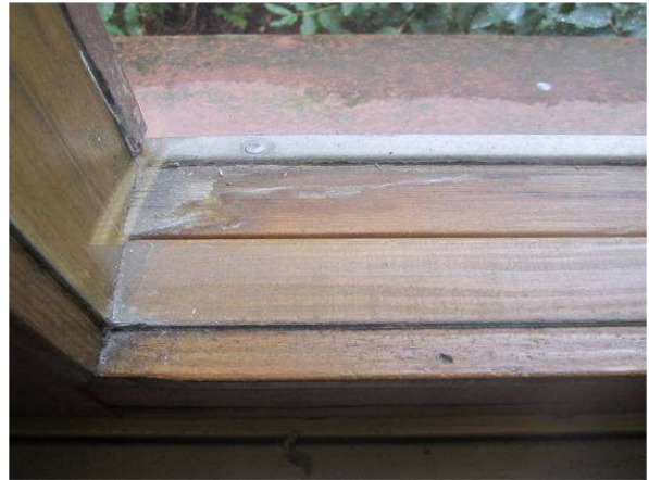
Alkuperäistä ikkunarakennetta. Puitteissa on havaittavissa kosteuden aiheuttamia jälkiä.
