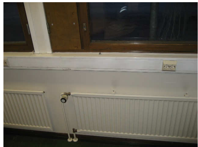
Kuva 8 Lämmityspotkien runkolinjat ovat lattiasa, missä ne ovat riski vuotojen takia.
