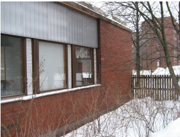
Kuva 1 Pohjoissivun lounaiskulmalla maanpinta vaikuttaa viettävän kohti rakennusta ja viereinen piha on ylempänä.
