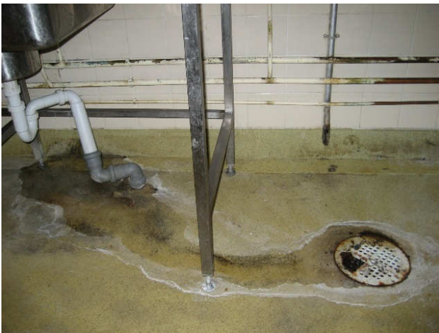
Kuva 11 Keittiön 035 akrylibetonilattioiden läpivientiliittymät lattiaan ovat kuluneet.
