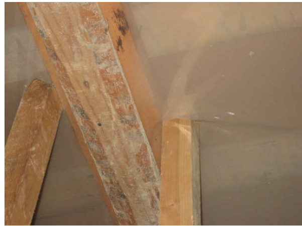
Kuva 24 Alakaton kannakkeet rikkovat höyrynsulun.
