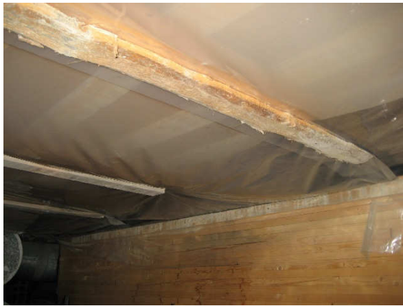
Kuva 23 Vuotojälkiä palkin kyljessä käytävän 039 kohdalla.
