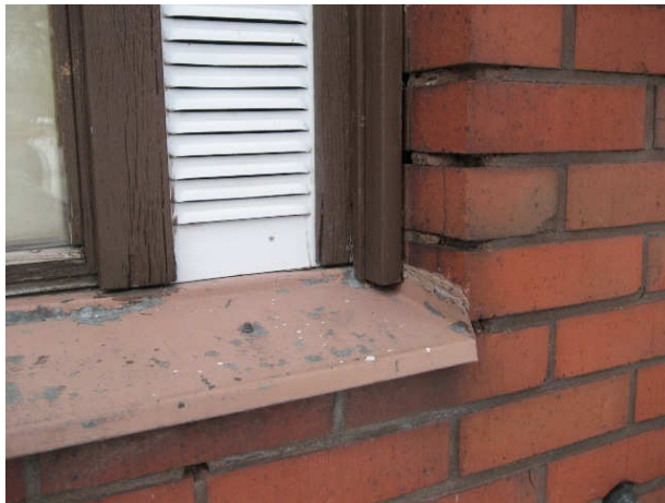
Kuva 5 Tiilisaumoissa on rapautumia. Vesipeltien sivuliittymä seinään ei ole tiivis.
