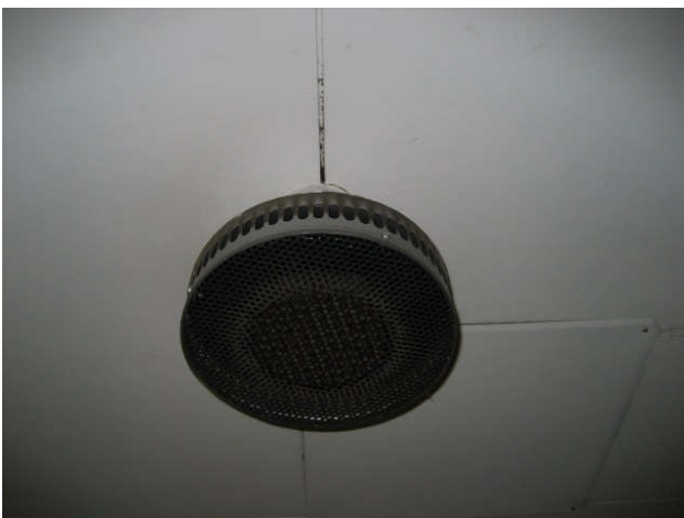
Kuva 13 Perhekeittiössä 008 on likaisia tuloilmaventtiileitä.
