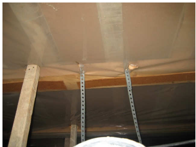
Kuva 20 IV-kanavien ripustukset rikkovat höyrynsulun.
