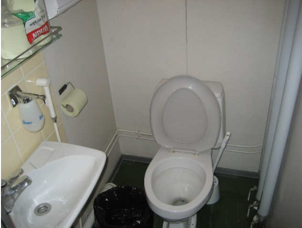
Kuva 9 Wc-tilassa 028 on viety käyttövesiputkia lattiaan, mikä on vuotoriski.
