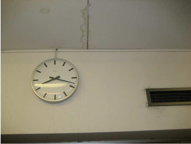
Kuva 15 Vanhoja vuotojälkiä kodinhoito-opetustilan 034 katossa IV-kotelon yläp..
