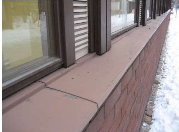
Kuva 6 Vesipeltien kaltevuus on riittämätön. Peltien jatkoksissa ei ole hakasaumaa.
