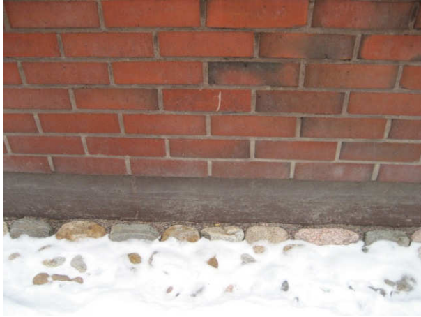
Kuva 3 Itäisivulla sokkelin vieressä on mukulakiveys. Alimpaan tiiliriviin ei ole tehty tuuletusreikiä.
