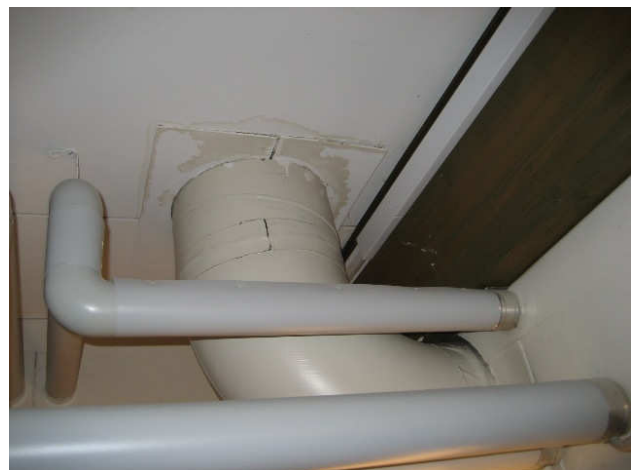
Kuva 14 Vanhoja vuotojälkiä wc-tilan 032 katos- sa.
