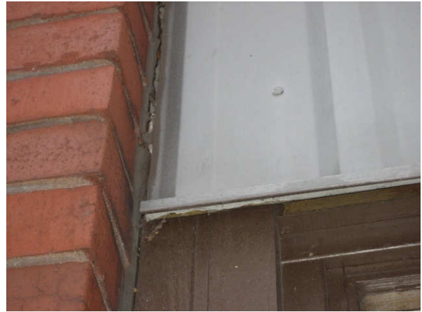
Kuva 4 Lounaiskulmalla peltiverhouksen ja ulkoseinän, sekä ikkunaliittymän kittaus on halki.
