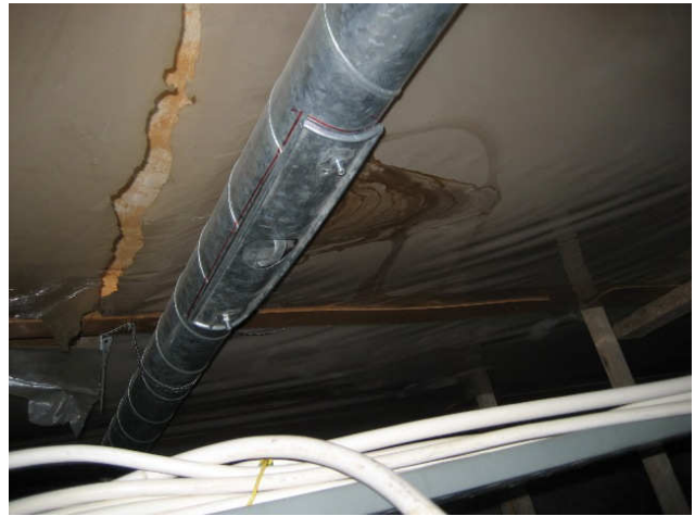
Kuva 18 Käytävän 007 ja opetuskeittiö 035 rajalla on alakaton yllä yläpohjan muovi halki ja on vanhoja vuotojälkiä.
