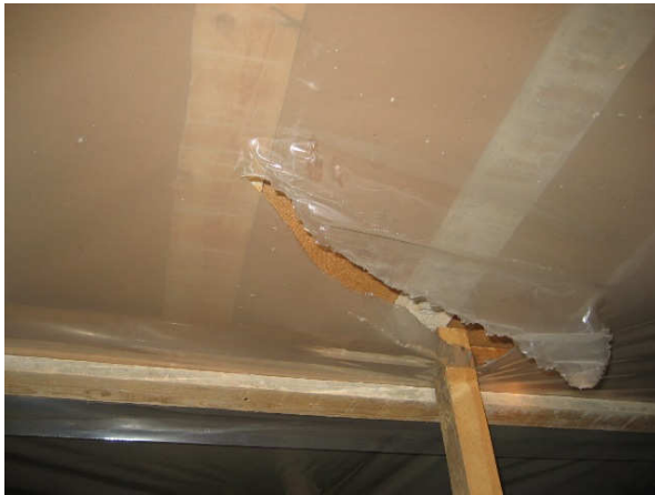
Kuva 21 Selvä repeytymä höyrysulussa käytävän 039 ja opetuskeittiön 042 rajalla.
