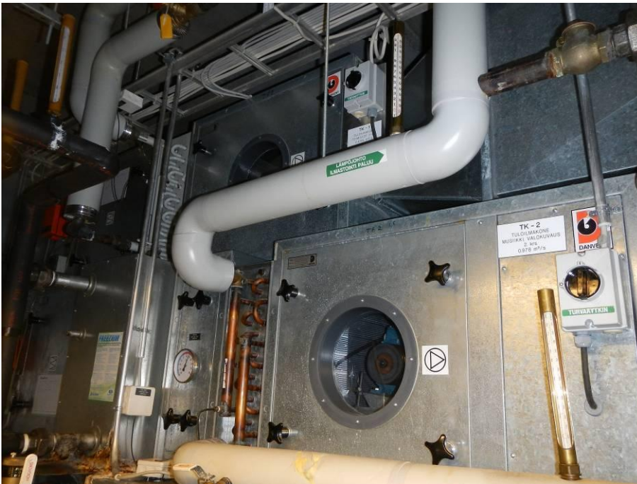
Kuva 11. Yleiskuva TK1 (ylempi kone) ja TK2 (alempi kone) konepaketeista.
