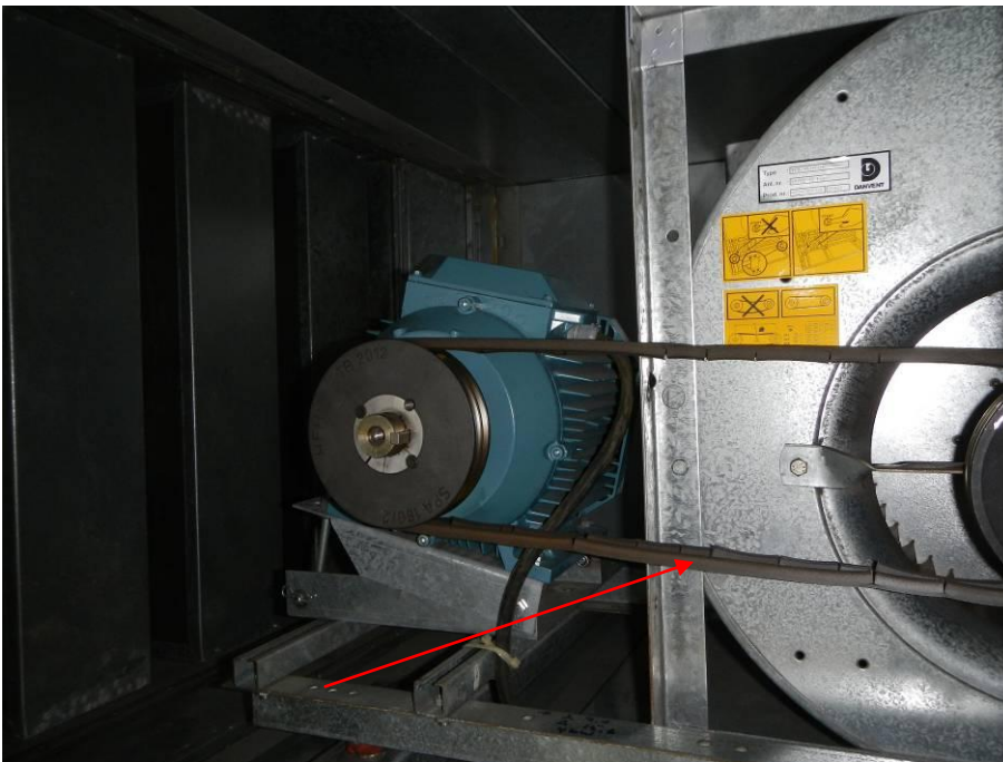
Kuva 7. Kiilahihnat ovat huonossa kunnossa.
