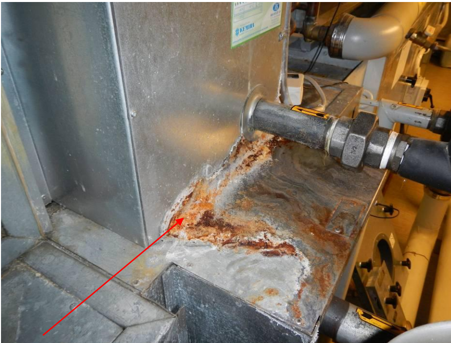
Kuva 15. LTO-patteri on syöpynyt.
