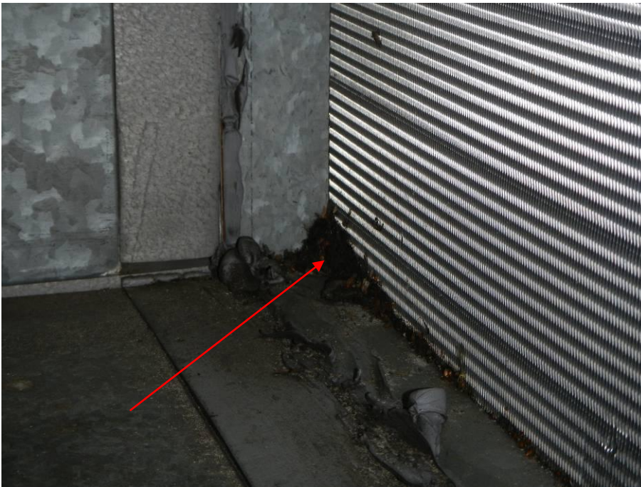
Kuva 17. Lämmityspatterissa on epäpuhtauksia.
