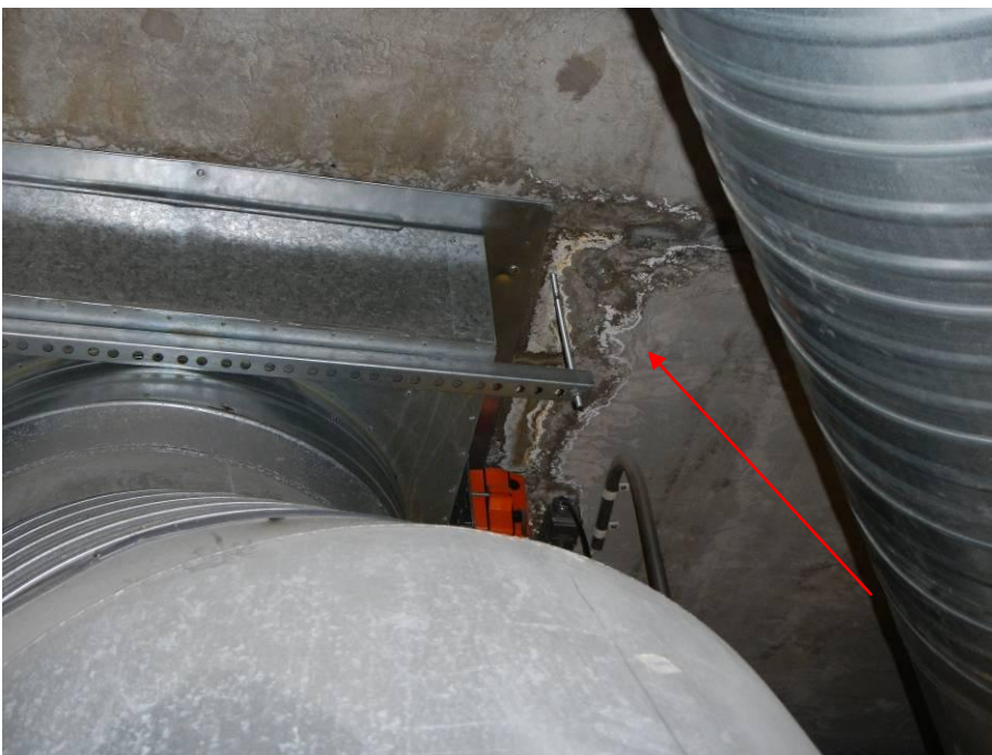
Kuva 32. Ilmanvaihtokonehuoneen kattoläpivienti vuotaa.
