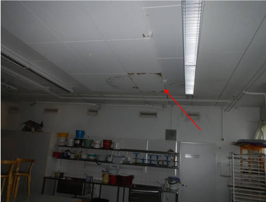
Kuva 31. Luokkatilan katossa on vanhoja kosteusvauriojälkiä.
