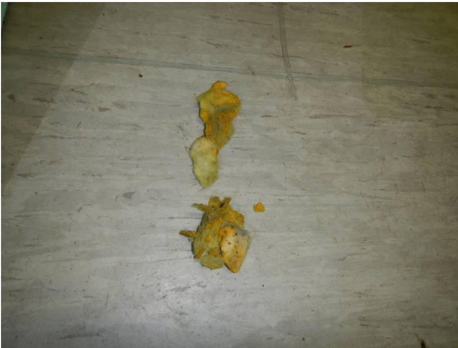
Kuva 10. Tulopuolen äänenvaimennuslamellit ovat rikki ja sisäänpuhallusilmaan pääsee mineraalivillakuituja.
