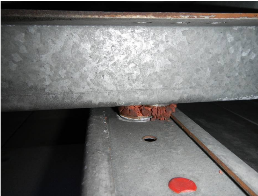
Kuva 8. Tärinänvaimentimet ovat rikki.
