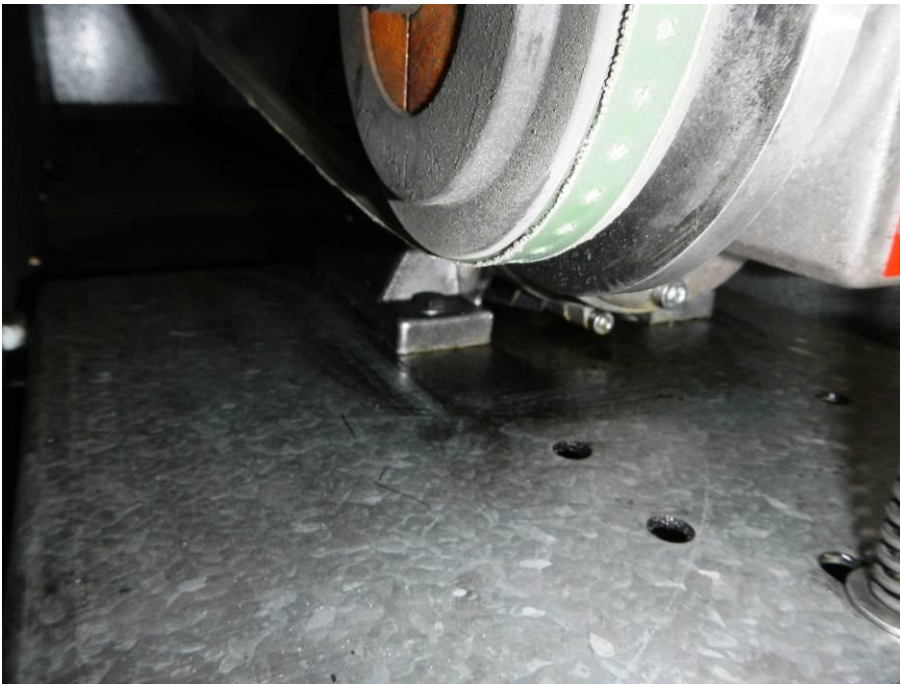
Kuva 22. LTO:n moottorin alapuolella on öljyjäämiä.
