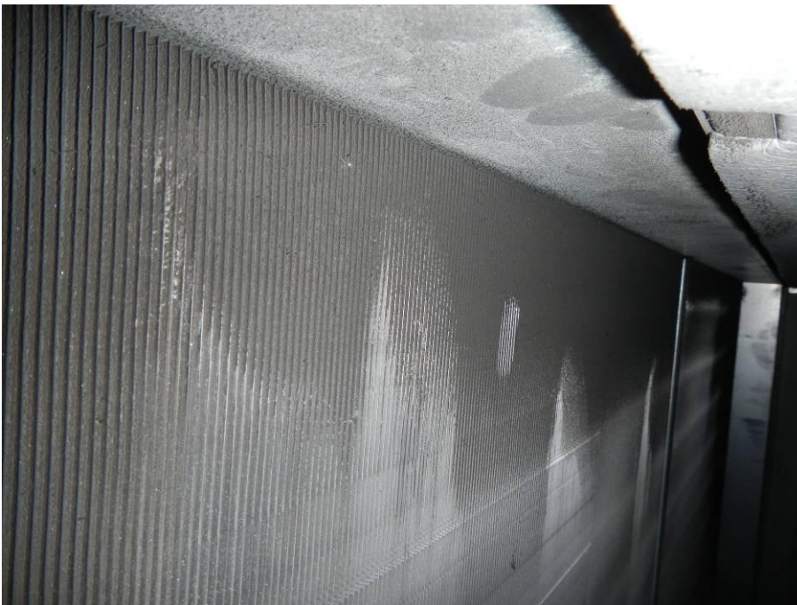
Kuva 23. Lämpöpatteri on nokinen.
