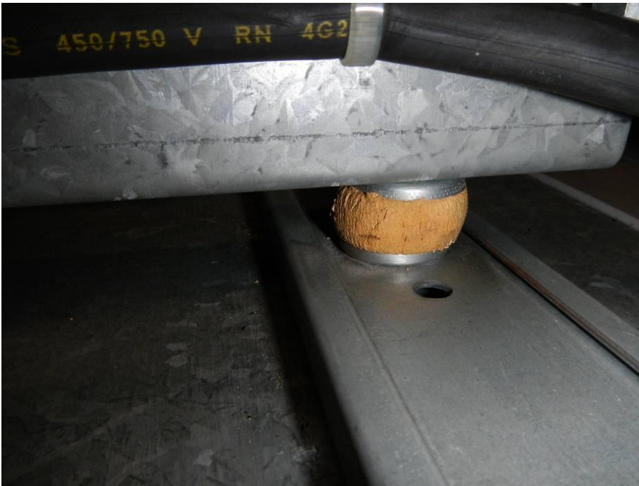
Kuva 20. Tärinän vaimentimet ovat murtuneet.
