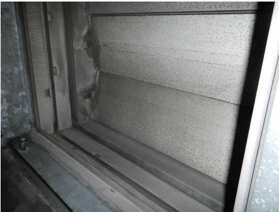
Kuva 19. Tulopuolen raitisilmapelti ei sulkeudu kunnolla.
