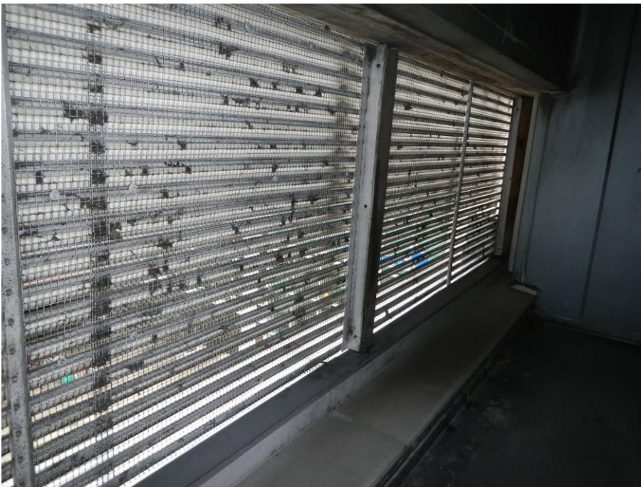
Kuva 12. Ulkosäleikössä on epäpuhtauksia.
