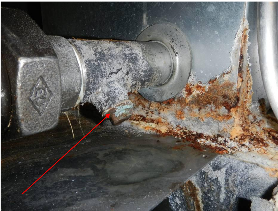
Kuva 16. LTO-putken tulppaus vuotaa.
