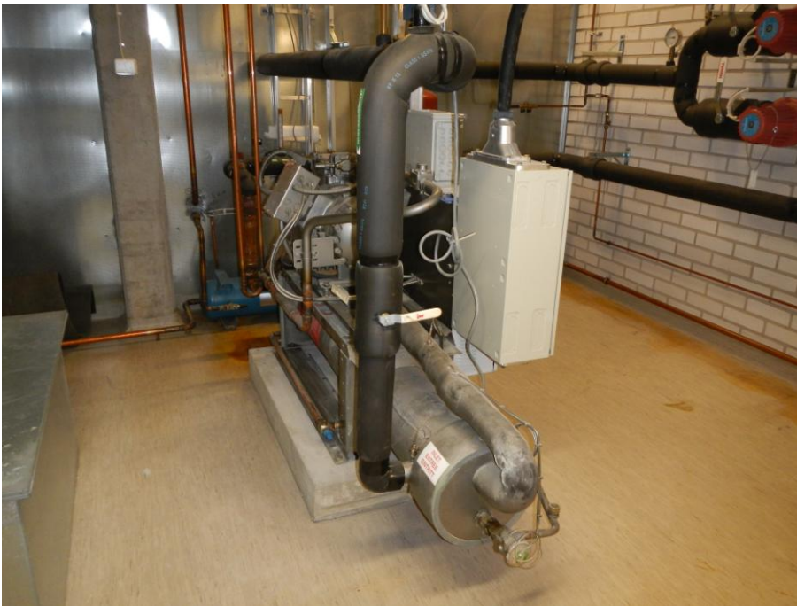
Kuva 33. Yleiskuva VJK-30 jäähdytyskoneesta.
