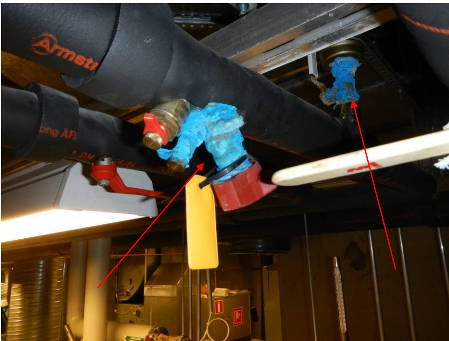
Kuva 14. LTO- putket ja venttiilit ovat syöpyneet voimakkaasti.
