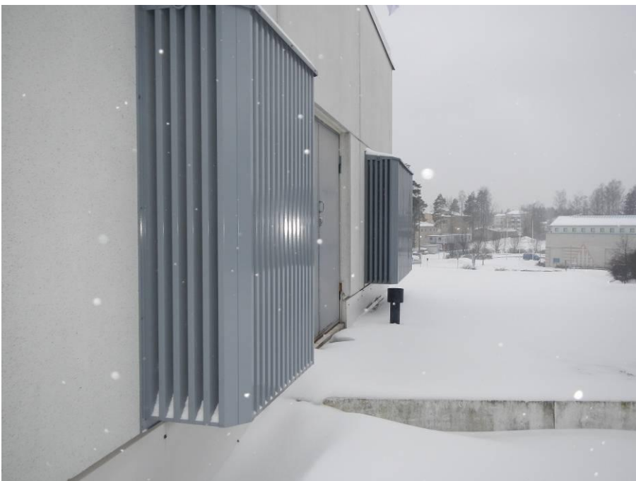
Kuva 25. TK7 ja TK11 koneiden raitisilmasäleiköt on korvattu lumisieppareilla.
