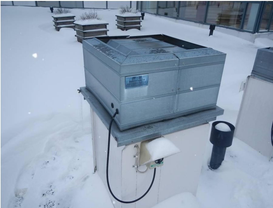
Kuva 24. Yleiskuva vesikatolla olevista paikallispoistoista.
