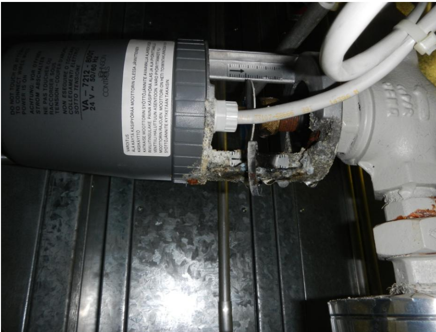
Kuva 37. Alkuperäiset kenttälaitteet ovat paikoin huonossa kunnossa.
