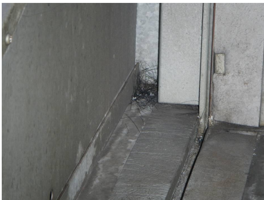
Kuva 5. Suodatinkammiossa on LTO- kennon harjoista irronneita kuituja.
