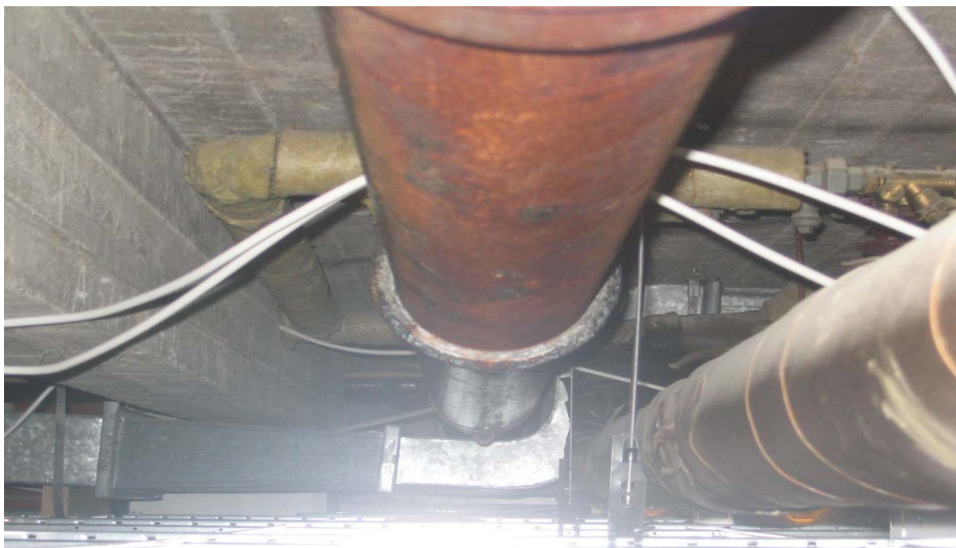
KUVA 1. Sadevesiviemäri putkiliitoksia kerhotilan katossa.
