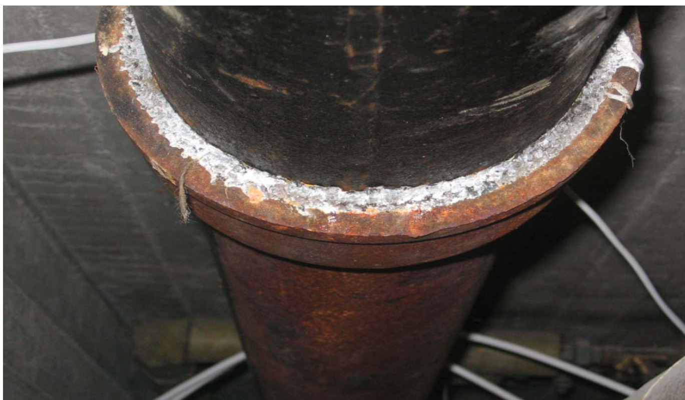
KUVA 2. Sadevesiviemäri putkiliitoksia kerhotilan katossa.
