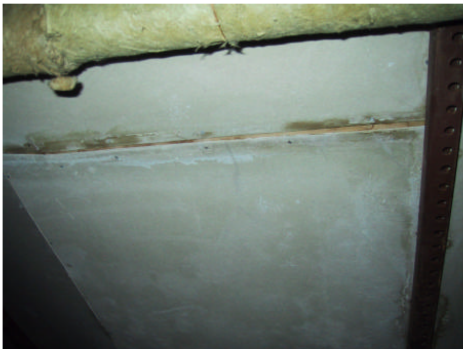
Kuva 8. Vuotojälkiä junaradan ja laituritasojen betonirakenteiden vuorauslevyissä.
