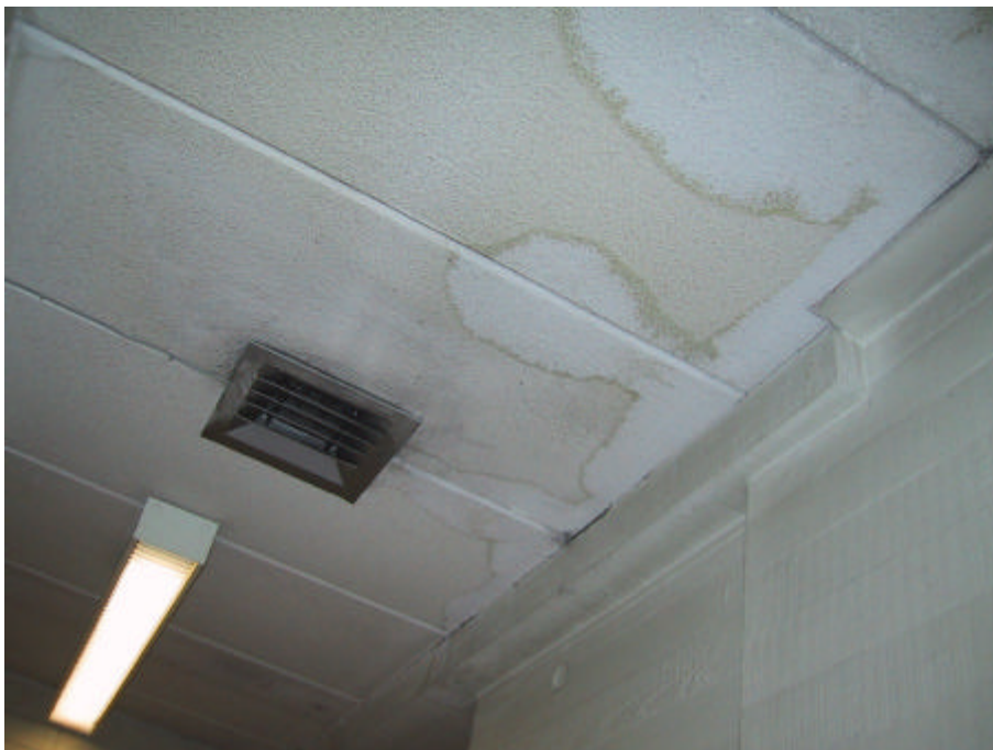
Kuva 6 Vuotojälkiä käytävän 110 katossa, kosteuden lähde on vuotavat junaradan ja laituritasojen betonirakenteet.
