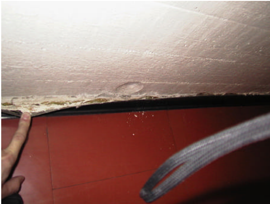
Kuva 5. Kosteusvaurio käytävän 110 betoniseinään liittyen.
