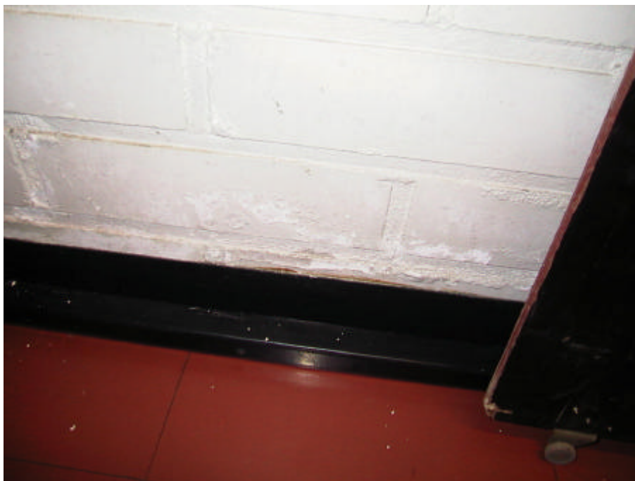
Kuva 3 Vanhoja kosteusjälkiä käytävän 110 seinän alaosassa.
