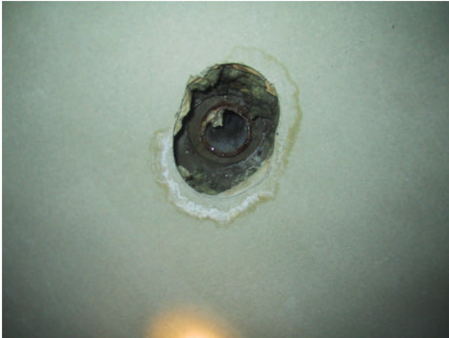
Kuva 9 Vuotoa junaradan betonirakenteessa olevan teräsputken kautta.
