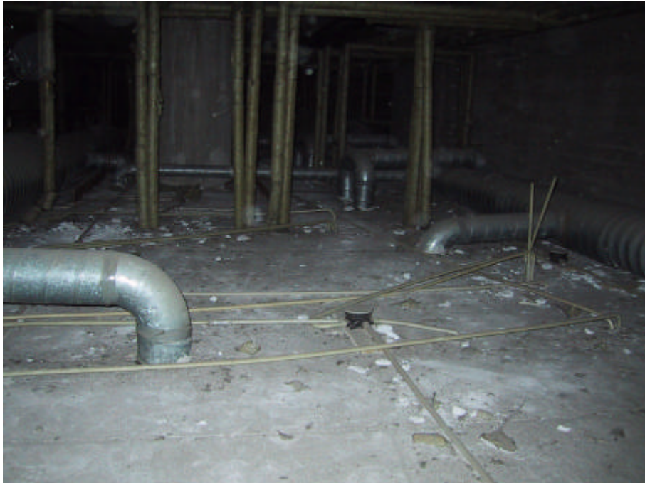
Kuva 10 Siporex-laatason päällä välitilassa on runsaasti roskaa ja pölyä.
