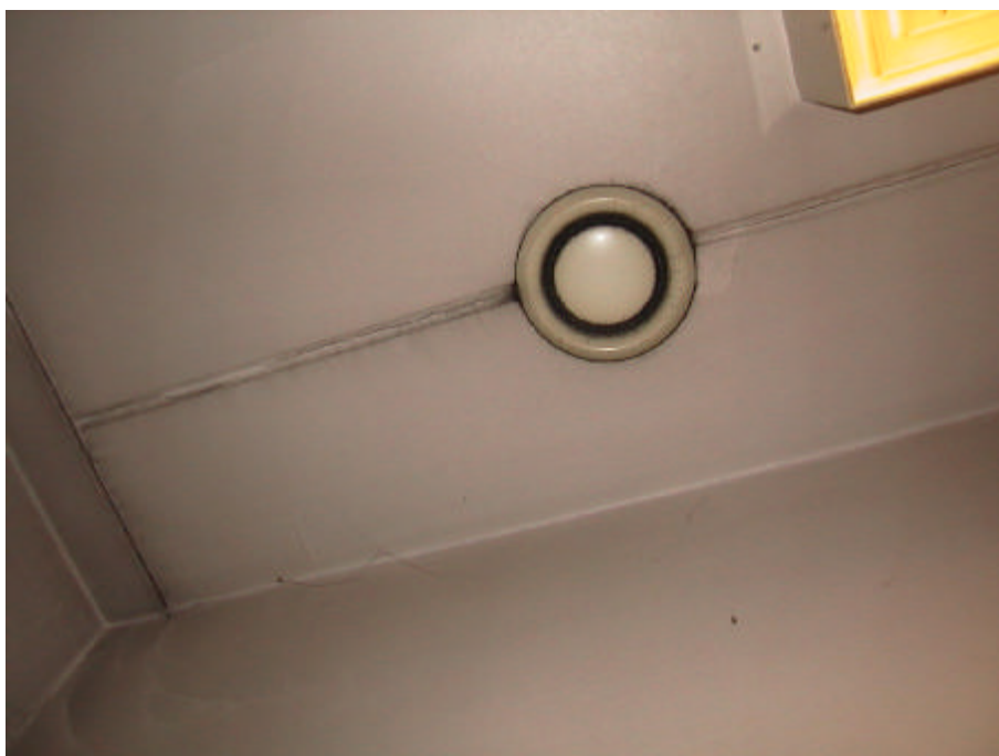
Kuva 12 Likainen ilmanvaihdon päätte-elin (ks. myös kuva 6).
