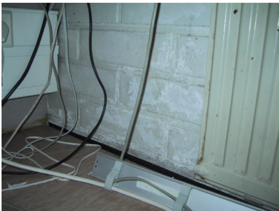
Kuva 4 Vanhoja kosteusjälkiä huonetilassa102 Lipunmyynti (yleisö-WC:n puoleinen seinä).
