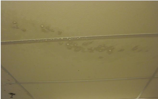
Kuva 27. Kosteutta akustiikkalevytyksen alapinnassa
