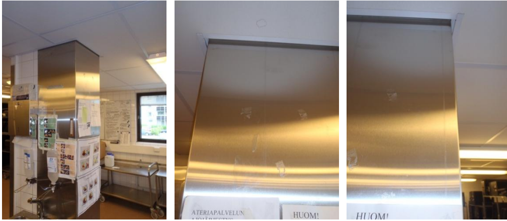
Kuvat 14, 15 ja 16. Keittiön katon vesivuotojälkiä
