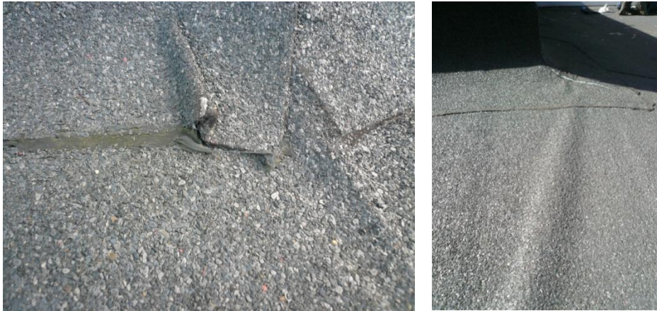
Kuvat 42 ja 43. Katteessa on reikiä ja se on paikoin irti
