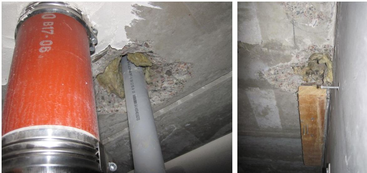
Kuvat 17 ja 18. Tiivistämätön läpivienti ja aukko palkin molemmin puolin
