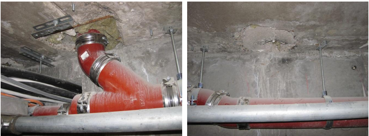
Kuvat 28 ja 29. Epätiivis läpivienti ja aukko ontelolaatassa
