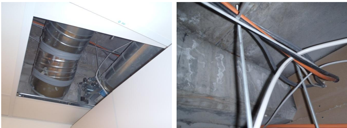
Kuvat 44 ja 45. Alakattolevytyksen avaus kaapin päältä. Palkin kyljessä ja ontelolaattojen pohjassa näkyy veden valumajälkiä
