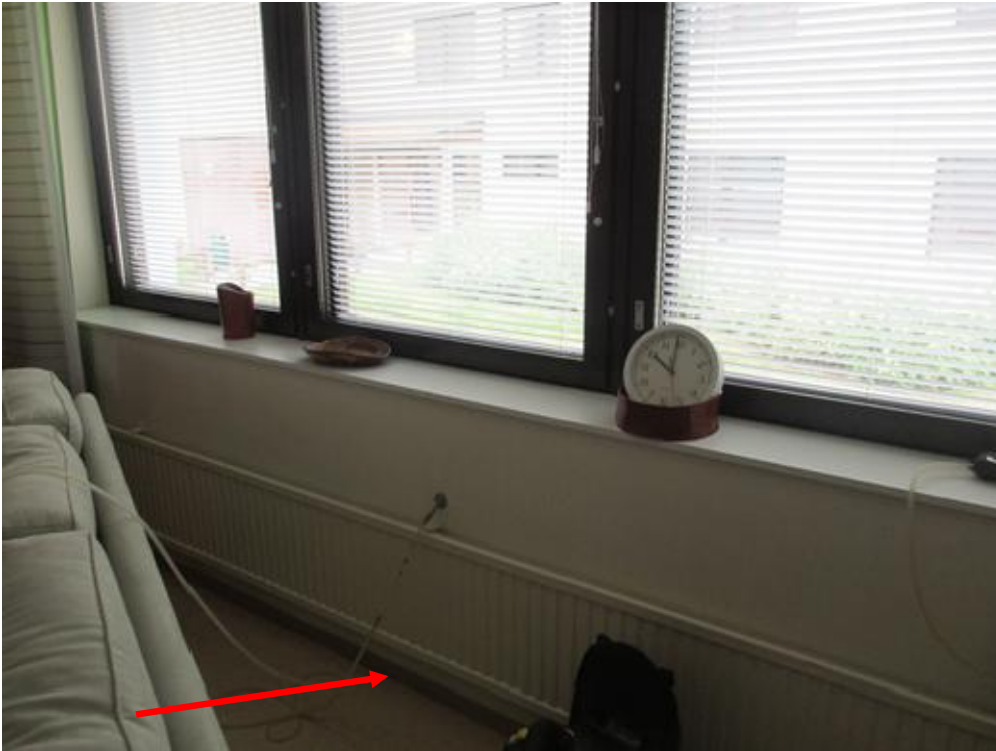
Kuva 4. Lattia- seinäliitoksesta mitattiin merkkiainekokeessa koko huoneen matkalla voimakasta ilmavuotoa.
