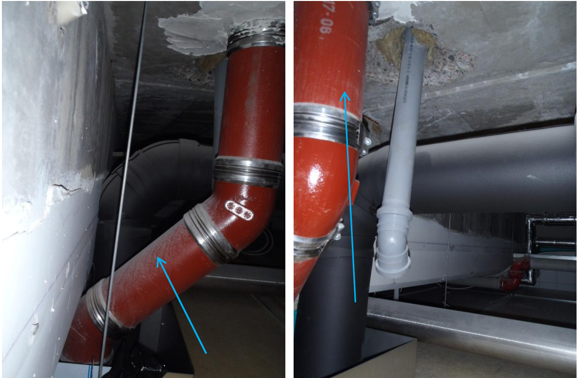
Kuvat 19 ja 20. Viemärin tuuletusputkessa näkyy veden valumajälkiä
