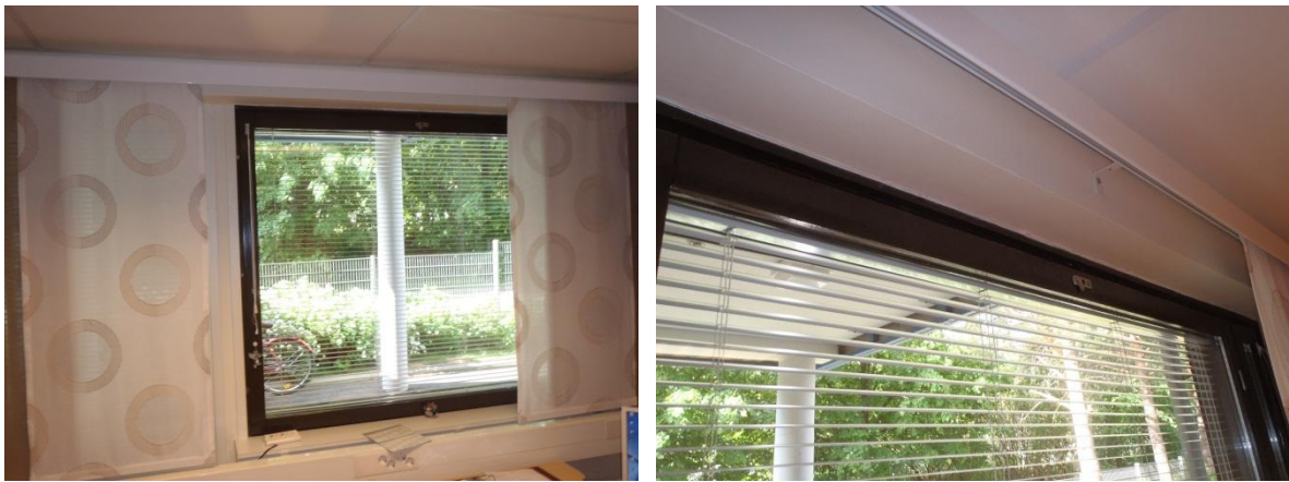
Kuvat 4 ja 5. Huoneen 101 ikkunan yläpuolelta on havaittu vesivuotoja
