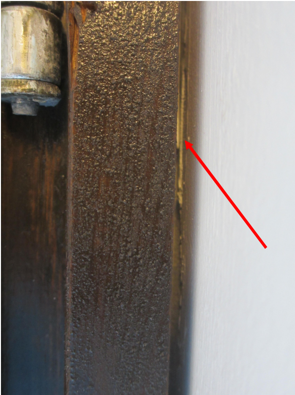
Kuva 1. Ikkunakarmin ja pielirakenteen välistä havaittiin voimakasta ilmavuotoa.
