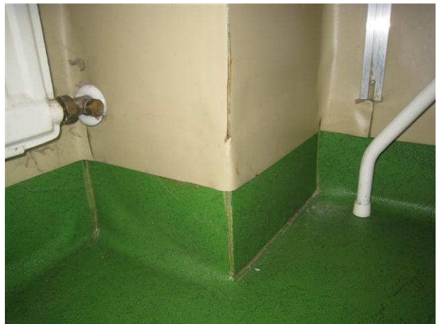
Kuva 30 Lasten wc-pesutiloissa on jo tullut vuoto- riskipaikkoja.
