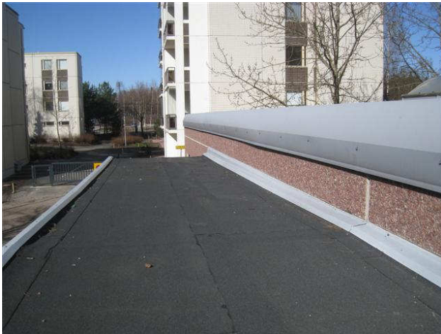
Kuva 27 Eteläisivun varastokatoksen vesikate on uusittu, mutta juurinosto on matala.
