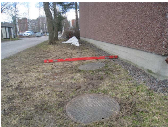
Kuva 5 Länsipäädyssä kallistukset ovat ok, passin luona on perusvesikaivo ja kulmalla sadev.viemärin tark.kaivo.
