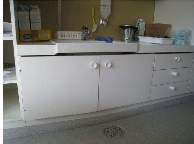
Kuva 32 Kulunut kaluste osastohuoneessa. Lattiamatto on uusittu.
