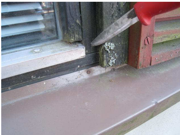
Kuva 17 Ikkunoiden alaosat ovat lahoja.
