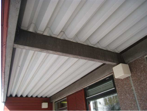
Kuva 13 Eteläsivun katoksen teräspalkit ovat jo hieman ruosteessa. Palkin päät tukeutuvat varastossa puupilareihin.
