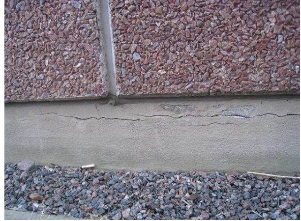
Kuva 8 Sokkelin vaakasuuntaista halkeilua ja maalipintaa on irti.
