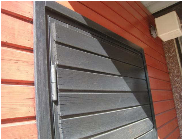
Kuva 15 Eteläsivun varaston ovipanelit ovat osin irti.
