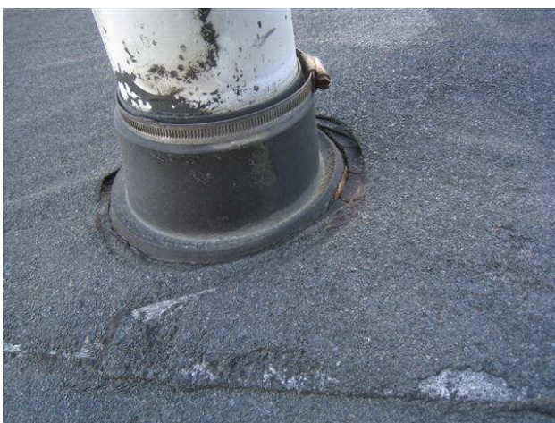
Kuva 23 Tuuletusviemäriin liittymä kiristämättä, paikallista kulumaa huovassa.
