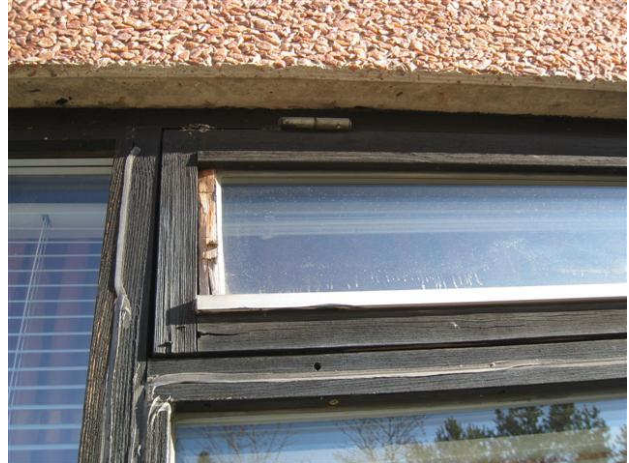
Kuva 20 Tuuletusikkunat ovat huonokuntoiset ja vaikea käyttää.
