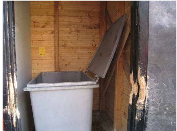
Kuva 16 Pohjoissivun varasto on otettu jätetilaksi, ovi on kulunut säiliösiirtelyn takia.
