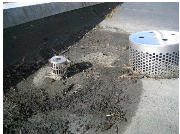
Kuva 22 Kattokaivojen huoltoa ei ole tehty.
