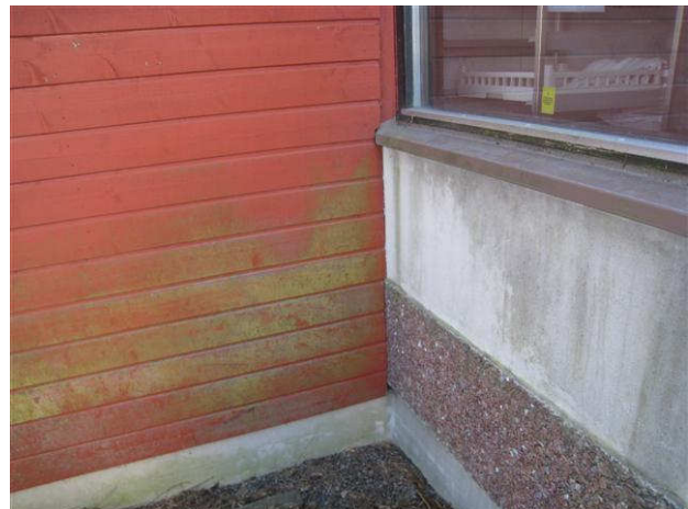
Kuva 12 Pohjoissivun varaston kasvustoa. Beto-niulkoseinän maalipinta on kulunut.
