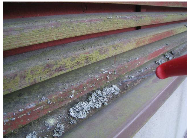
Kuva 18 Ikkunapielien ritilöiden alaosilla on lahoa.
