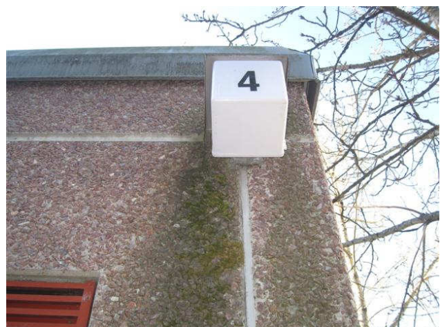
Kuva 24 Räystääspellit ovat paikoin vasten julkisivua, valaisimen kautta seinä kastuu.
