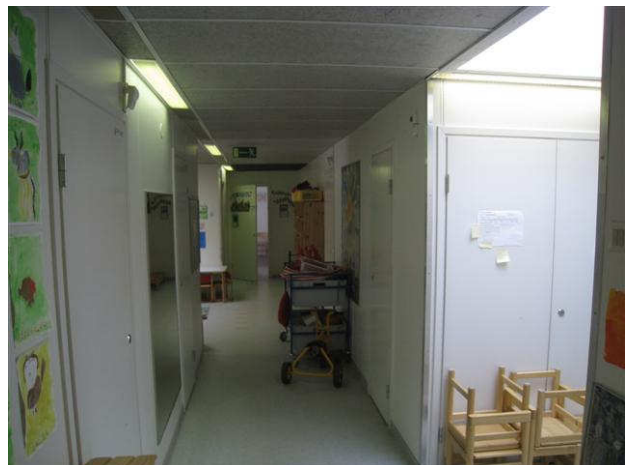
Kuva 36 Yleiskuva käytävälle, jossa on likaantuneita akustiikkavillalevyjä.
