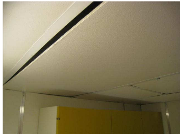
Kuva 34 Roikkuva alakaton lujalevy vaatehuoltotilassa.
