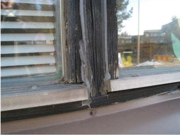
Kuva 19 Ikkunoiden silikonitiivistystä, puu halki ja tikkuinen, vesipeltiliittymä on huono.
