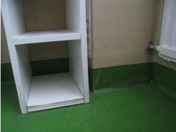
Kuva 31 Kulunut ja vaurioitunut kaluste.
