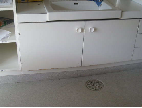
Kuva 21 Käsipesuallastason pinnoilla ja ovien alaosissa kosteusjälkiä/ vaurioita.
