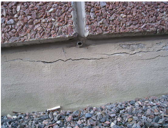
Kuva 5 Sokkelissa on halkeamia.
