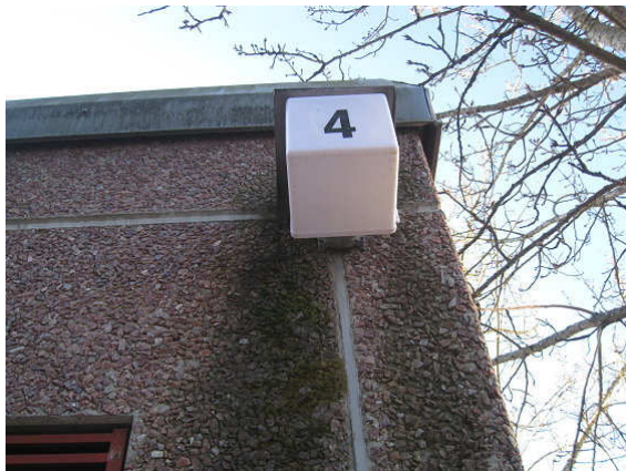
Kuva 8 Ulkovalon suojus ohjaa sadeveden julkisivulle lisäten kosteusrasitusta.
