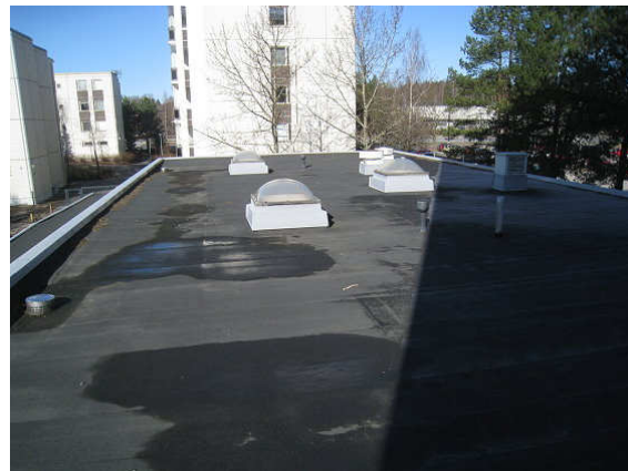
Kuva 12 Vesikaton kallistukset loivahkot. Paikoin sadevesi lammikoituu.
