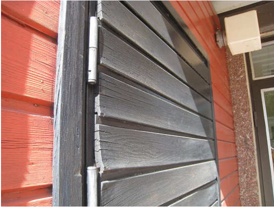
Kuva 27 Huonokuntoinen ulkovaraston ovi.
