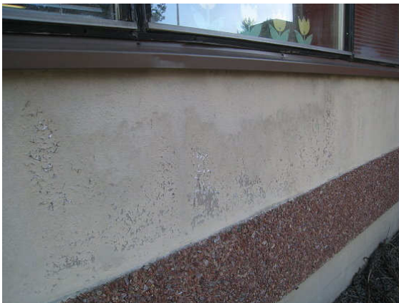
Kuva 7 Betonipinnan maali hilseilee.
