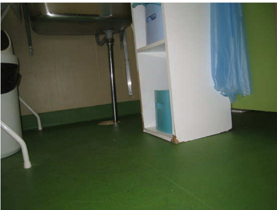
Kuva 19 Alaosastaan kosteusvaurioitunut hylly.
