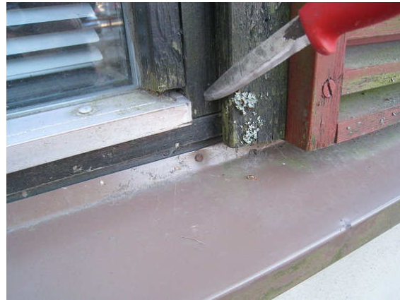
Kuva 24 Ikkunoiden ulkopuolisissa puupinnoissa lahoa.
