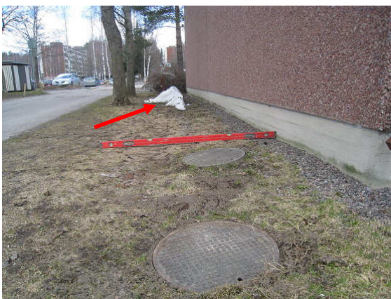
Kuva 1 Luoteiskulmalla maanpinnan muotoilussa puutteita.
