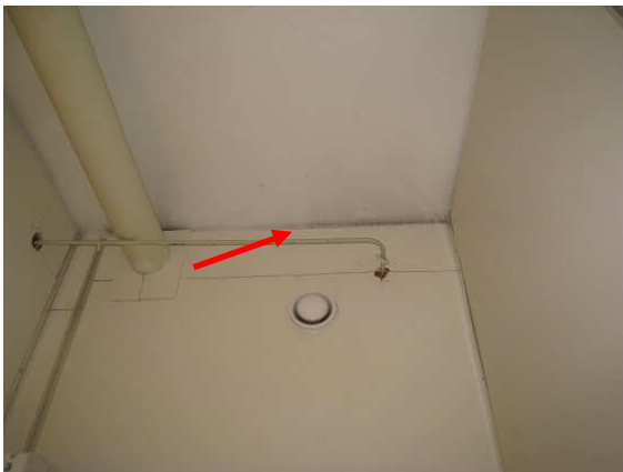
Kuva 11 Huonetilojen välillä ilmavuotoa.
