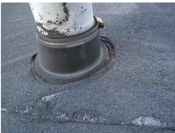
Kuva 13 Tuuletusviemärin kiristyspanta on löysällä.
