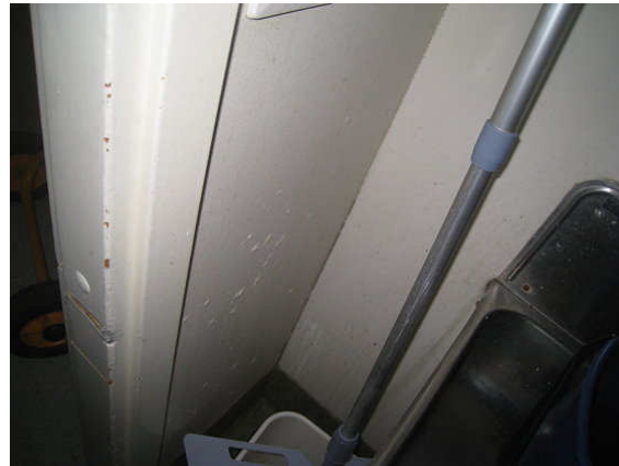
Kuva 10 Väliseinässä on veden aiheuttamia kupruja.
