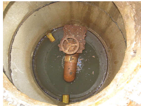
Kuva 6 Perusvesikaivo ja salaojien päät.
