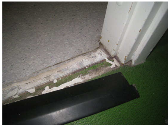
Kuva 20 Muovikynnys irronnut kiinnityksestä.
