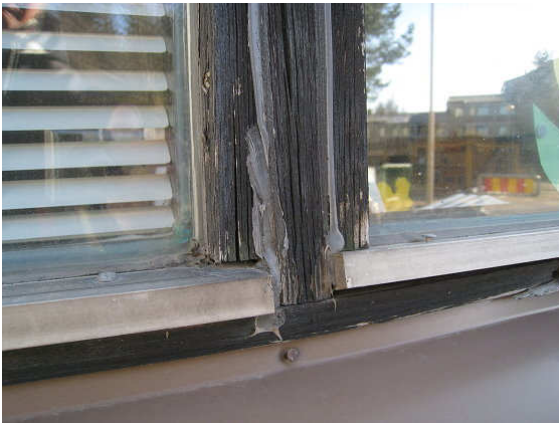
Kuva 25 Ikkunaa tiivistetty silikonilla. Vesipellin kiinnityksessä puutteita.
