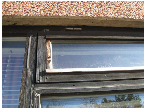
Kuva 26 Tuuletusikkunat ovat huonokuntoiset.
