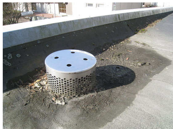
Kuva 14 Kattokaivojen roskasihteissä kasvijätettä.
