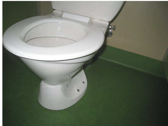
Kuva 18 WC-istuimien asennuksissa on puutteita.
