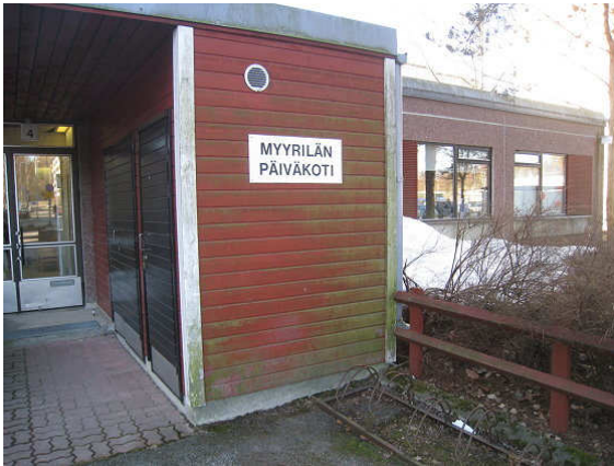
Kuva 9 Pohjoissivun ulkovaraston ulkokuorupaneelin pinnalla on sammalkasvustoa. Varastotiloissa maan haju.
