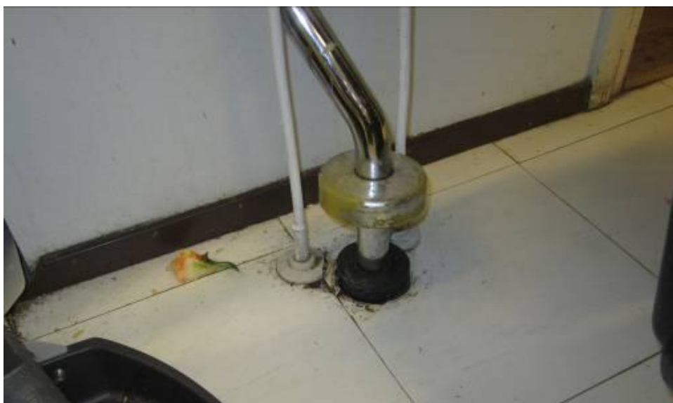
Kuva 3. Opetuskeittiön 104 lavuaarin poistoputken liitoksen kumitulppa on nousut jolloin sen epätiiveyden vuoksi viemärinhajua kulkeutuu opetuskeittiöön 104 (kumitulppa painettiin alas havainnon tekemisen jälkeen).
