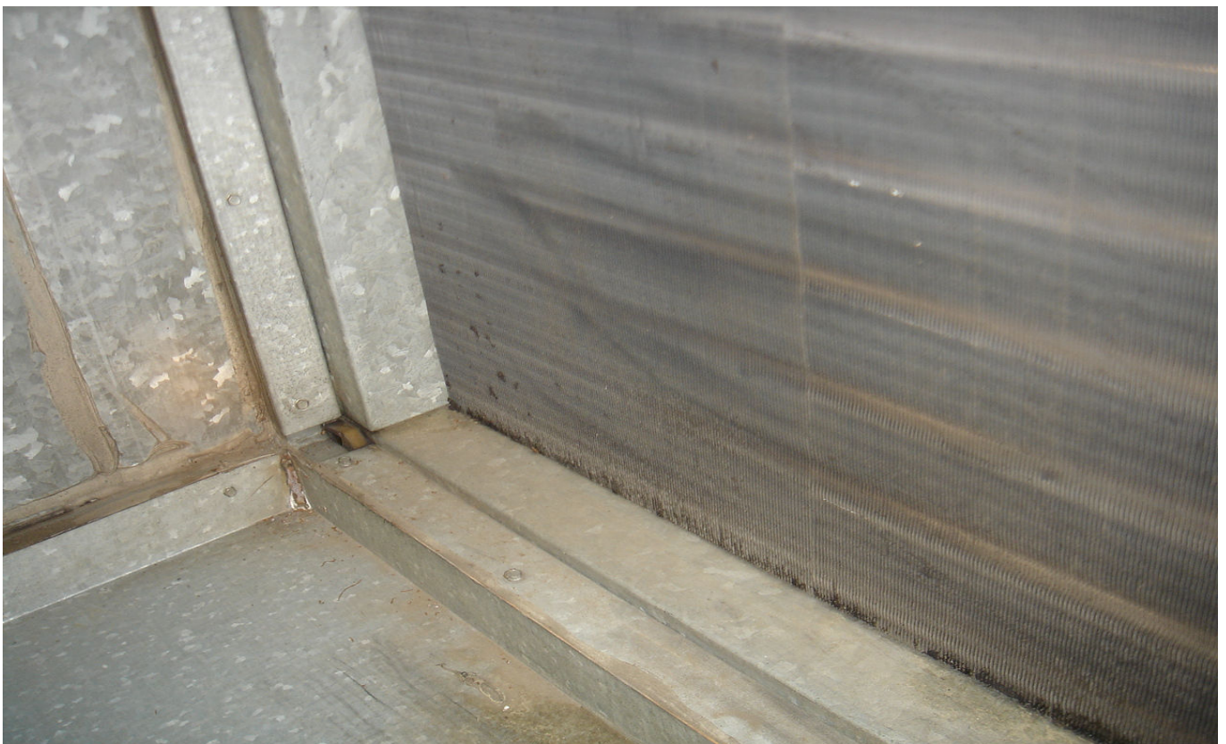
KUVA 6. Lämpöpatterissa on vielä hieman pölykertymää.
