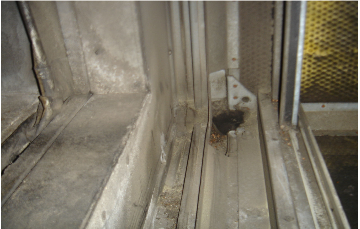
KUVA 5. Tuloilmakoneen kammioissa on vielä roskaa.
