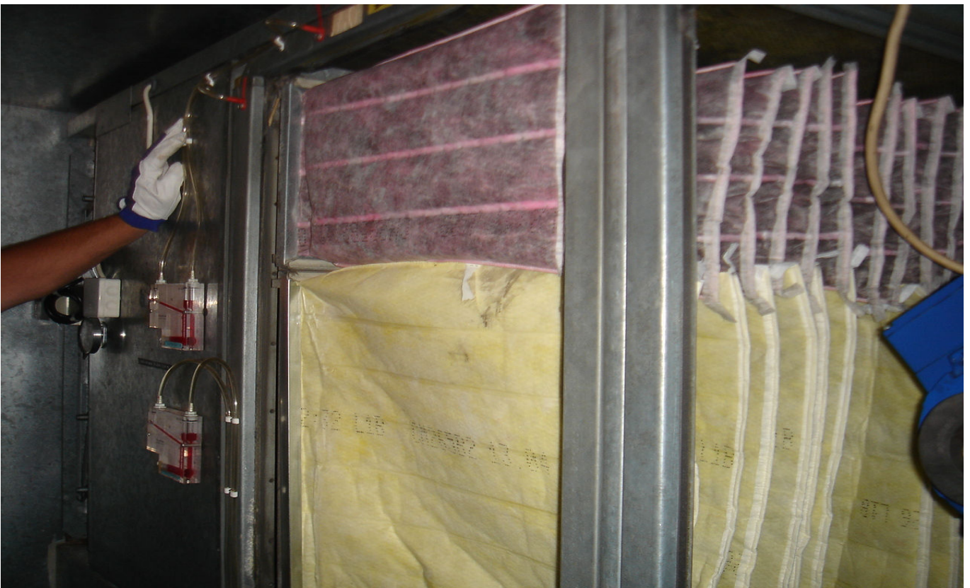
KUVA 8. Tuloilmasuodattimet ovat osin uusittuja ja osin vanhoja.
