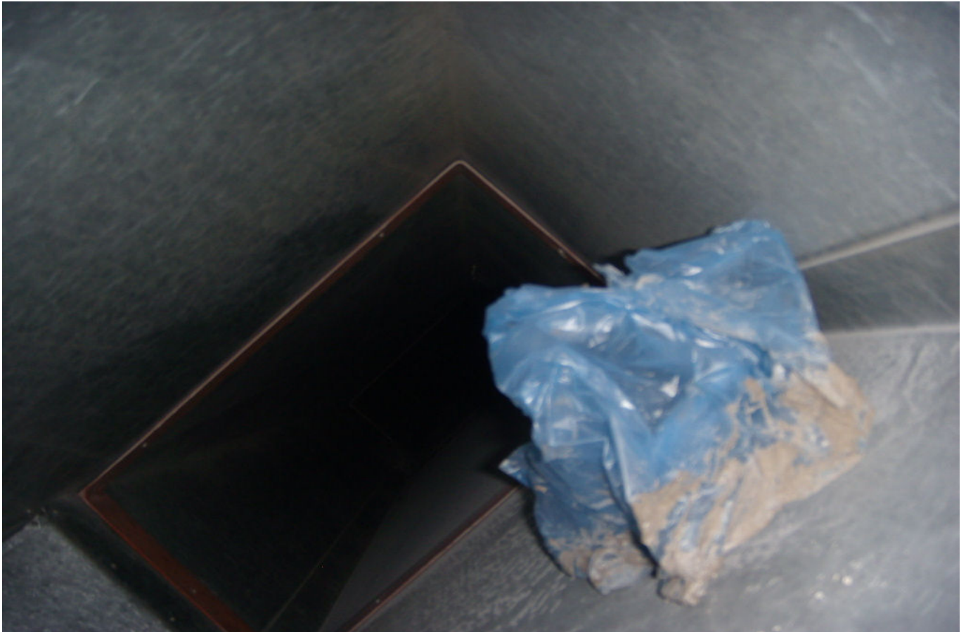
KUVA 19. Yleiskuva poistoilmakanavasta, jossa on roskaa.
