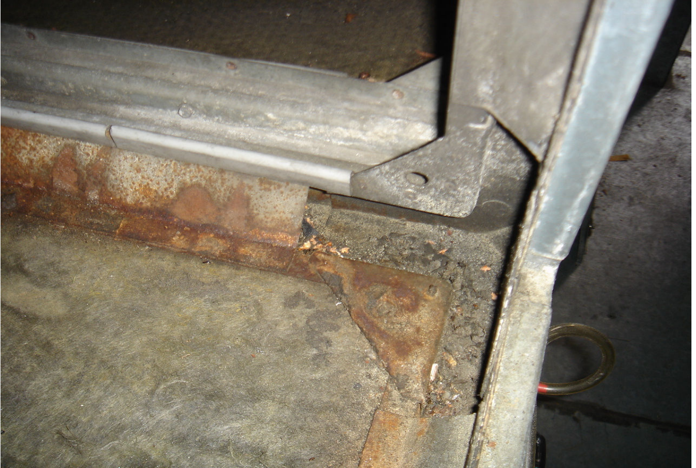
KUVA 9. Tuloilmakammiossa on vielä roskaa.
