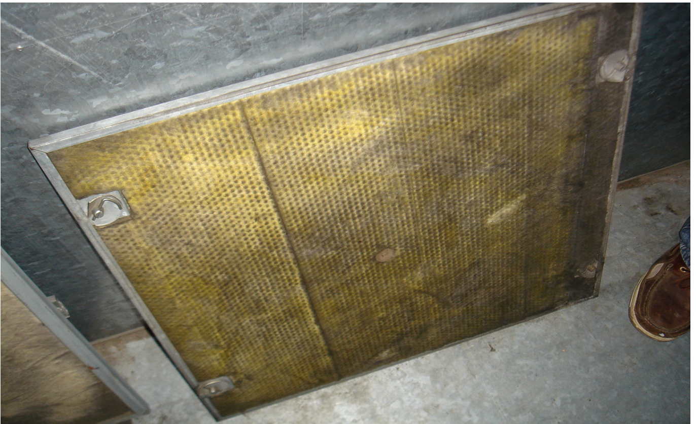
KUVA 4. Tuloilmakoneen kammiot on eristetty mineraalivillalla.
