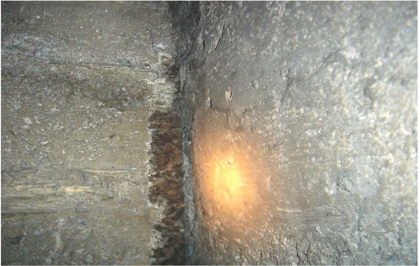
KUVA 1. Suodatin seinämän ja rakenteiden välissä on rakoja.
