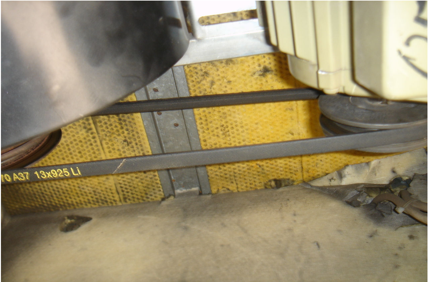
KUVA 15. Tuloilmakoneen kammiot on eristetty mineraalivillalla, joka on paikoin rikki.
