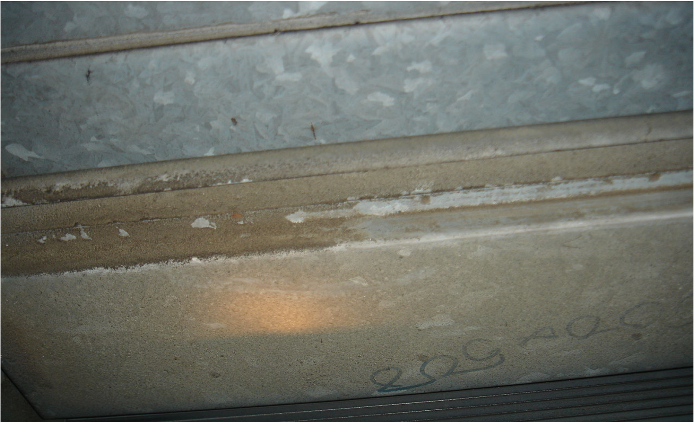
KUVA 7. LTO- kuutiossa ja säätöpelleissä on hieman pölyä.
