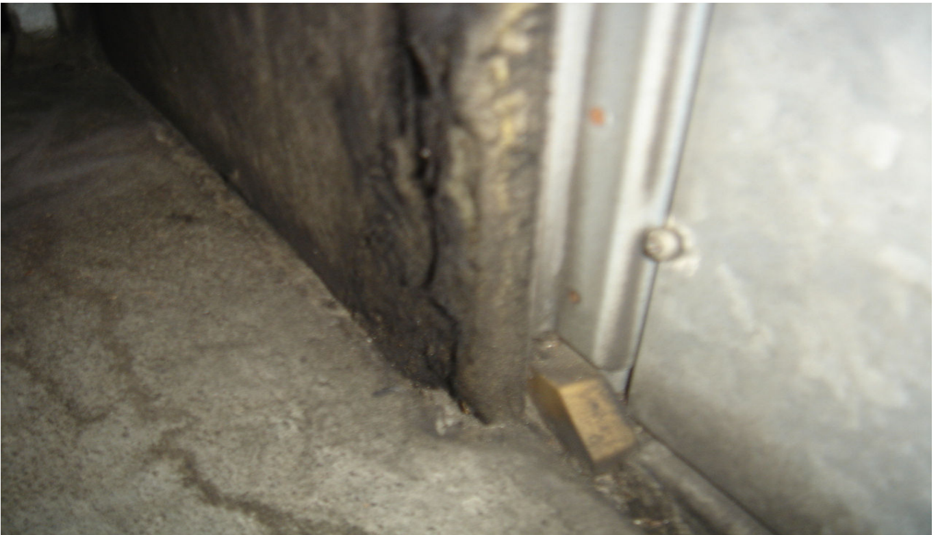
KUVA 10. Tuloilmakoneen kammiot on eristetty mineraalivillalla, joka on paikoin rikki.
