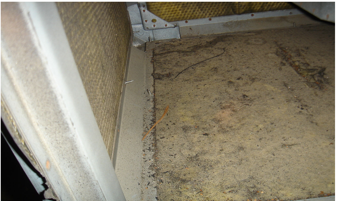
KUVA 12. Tuloilmakoneen kammioissa on melko paljon roskaa.
