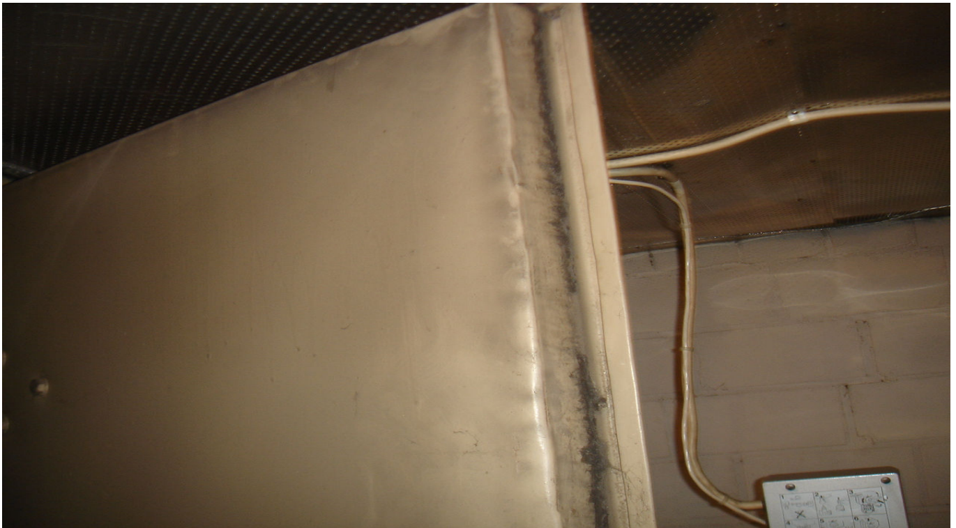
KUVA 2. Luukkujen tiivistys on huono.
