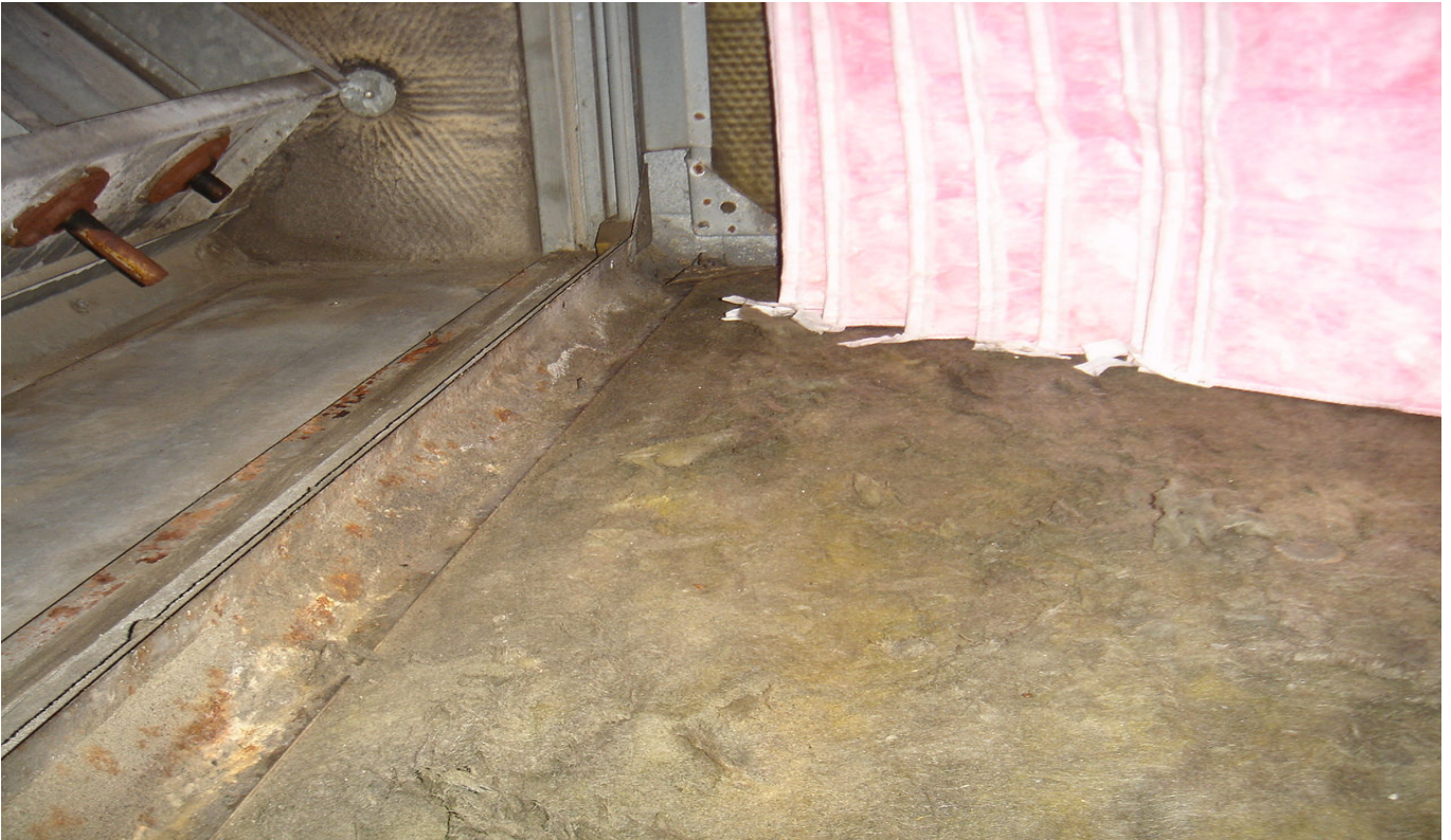
KUVA 13. Tuloilmakoneen kammiot on eristetty mineraalivillalla, joka on paikoin rikki.
