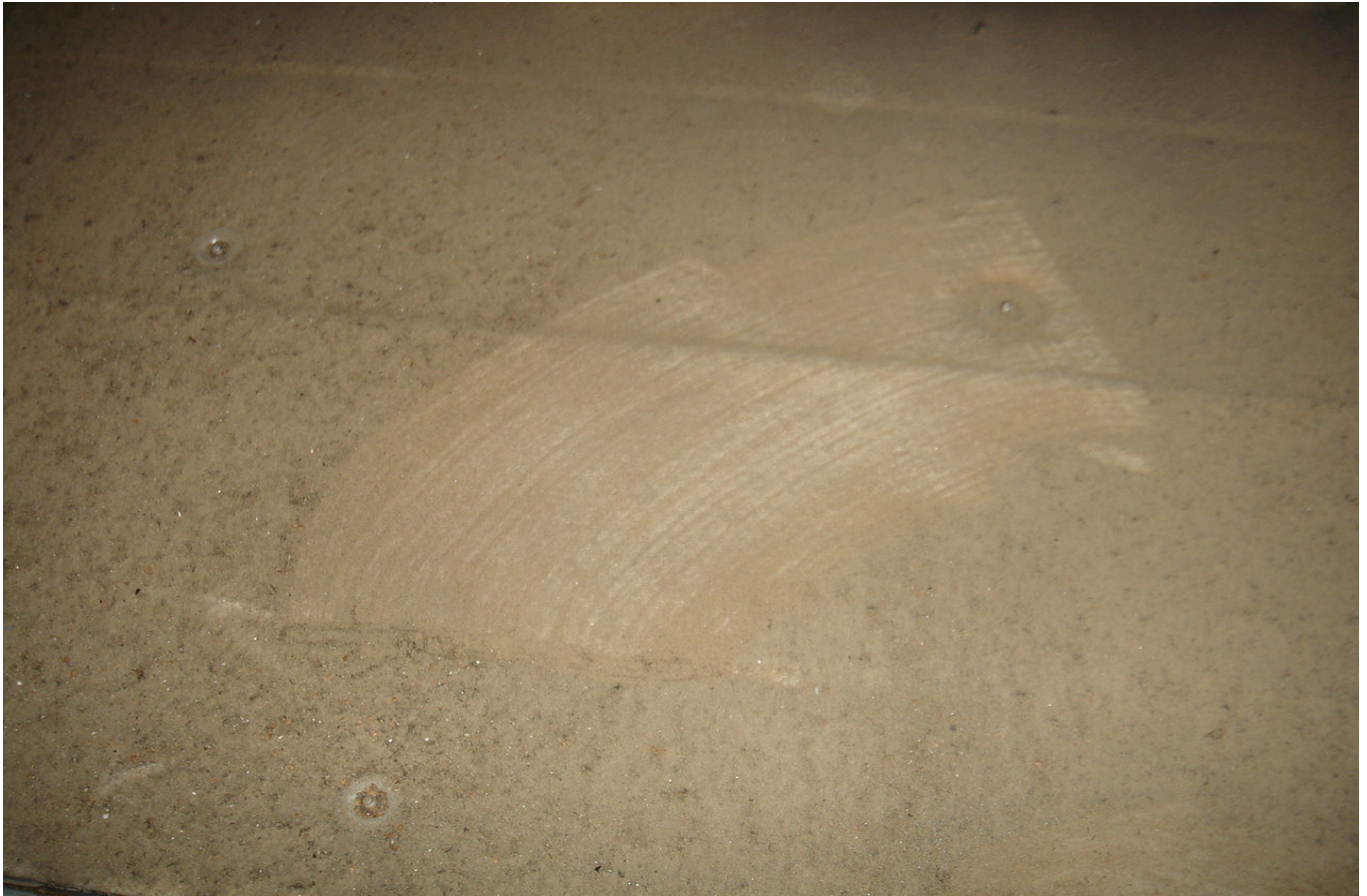
KUVA 11. Tuloilmakoneen kammioissa on melko paljon pölykertymää.
