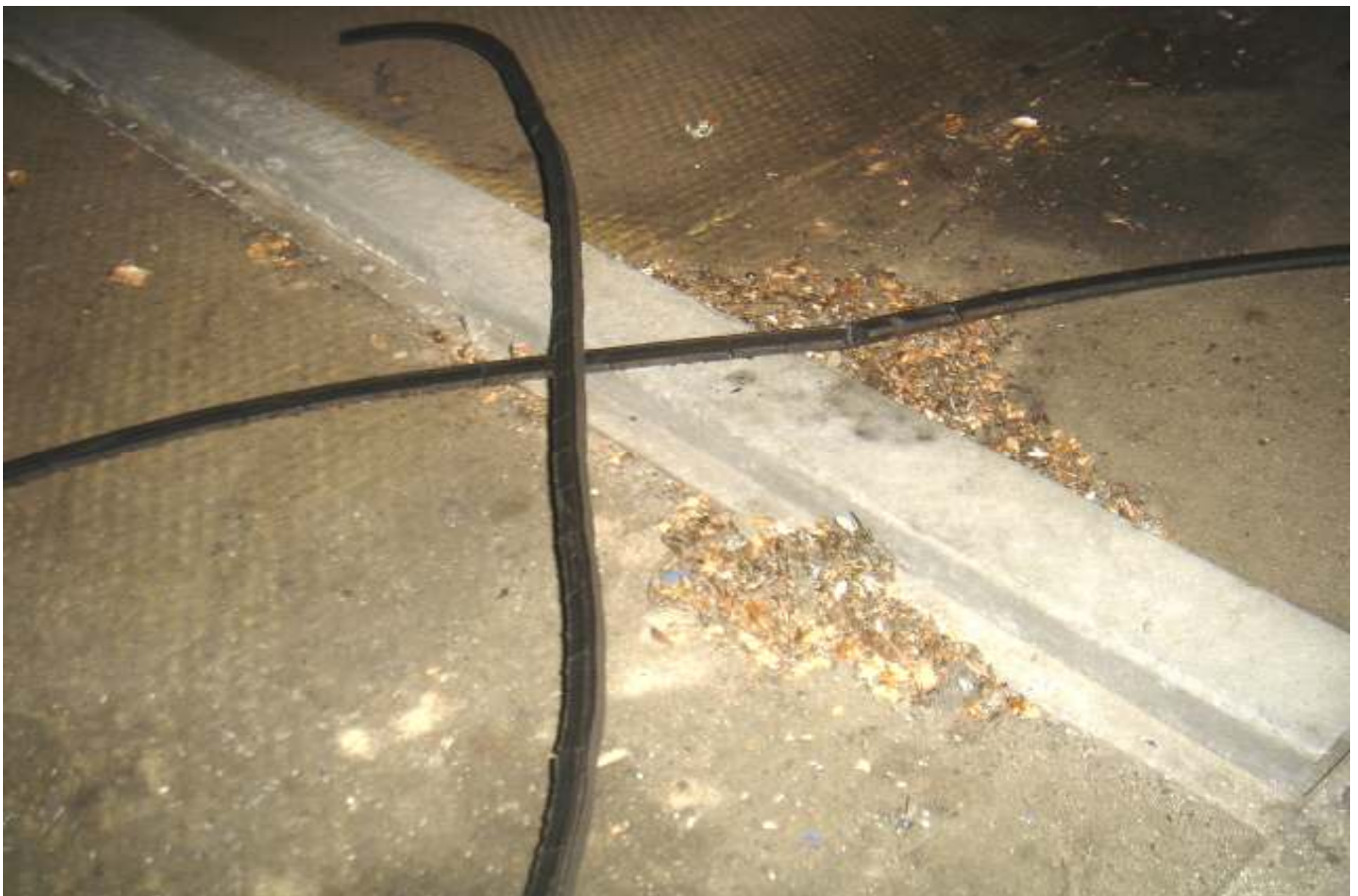
KUVA 10. Tuloilmakammiossa on melko paljon roskaa.
