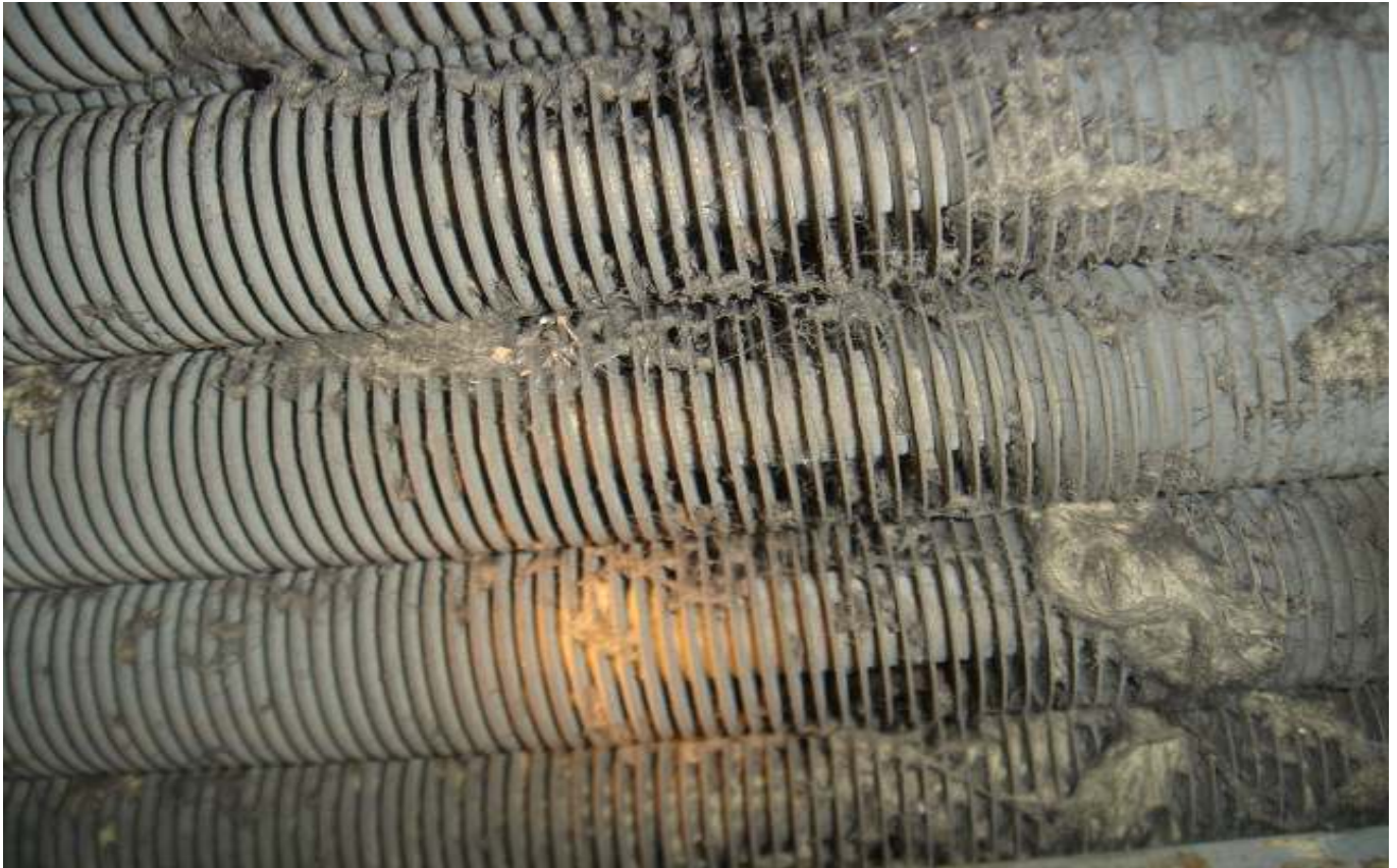
KUVA 3. Lämpöpatterissa on melko paljon pölykertymää.
