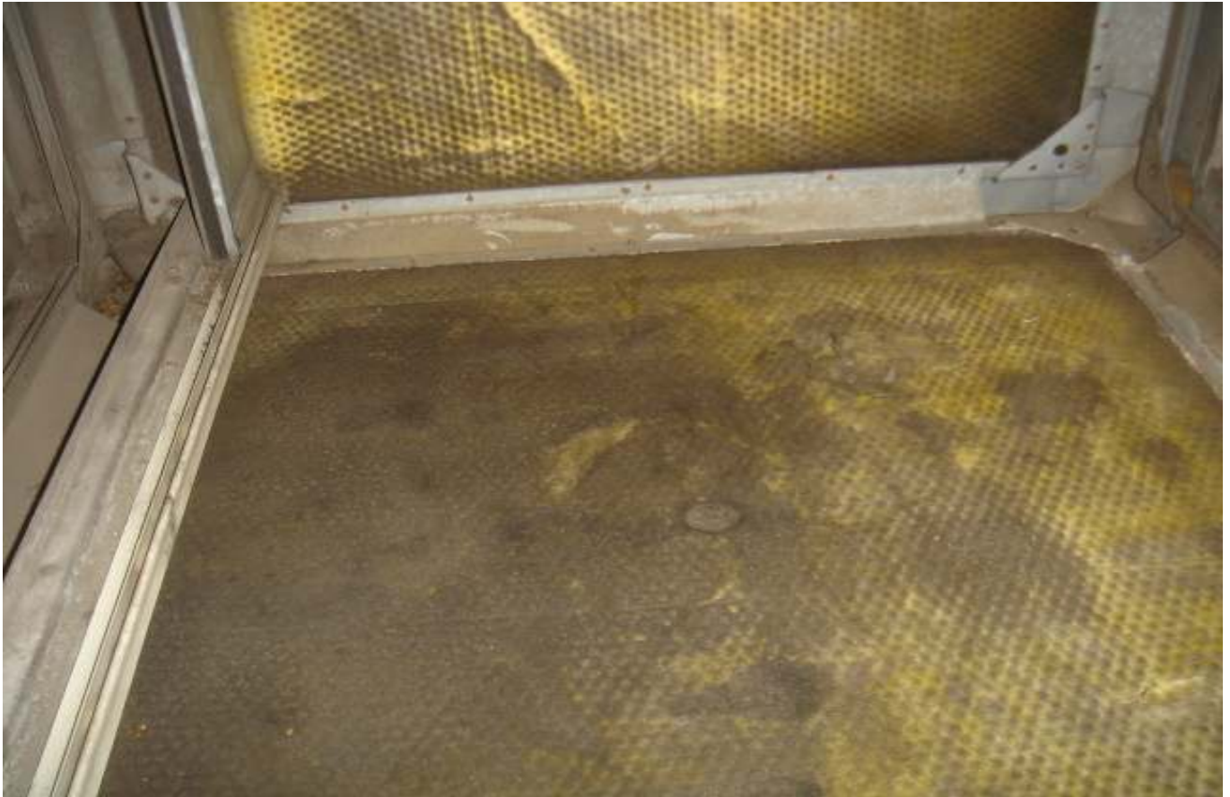
KUVA 7. Tuloilmakoneen kammiot on eristetty mineraalivillalla, joka on paikoin rikki.
