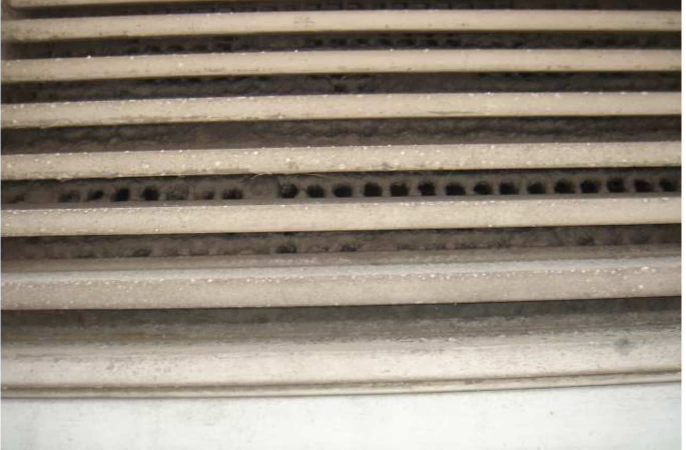
KUVA 21. Tuloilmakoneen raitisilmasäleikkö on melkein tukossa.
