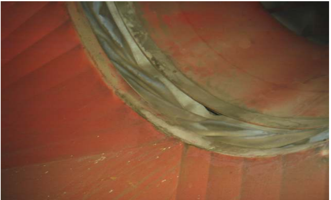
KUVA 4. Puhaltimen joustavat liittimet ovat rikki.
