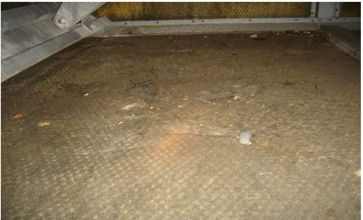
KUVA 12. Tuloilmakoneen kammiot on eristetty mineraalivillalla, joka on paikoin rikki.
