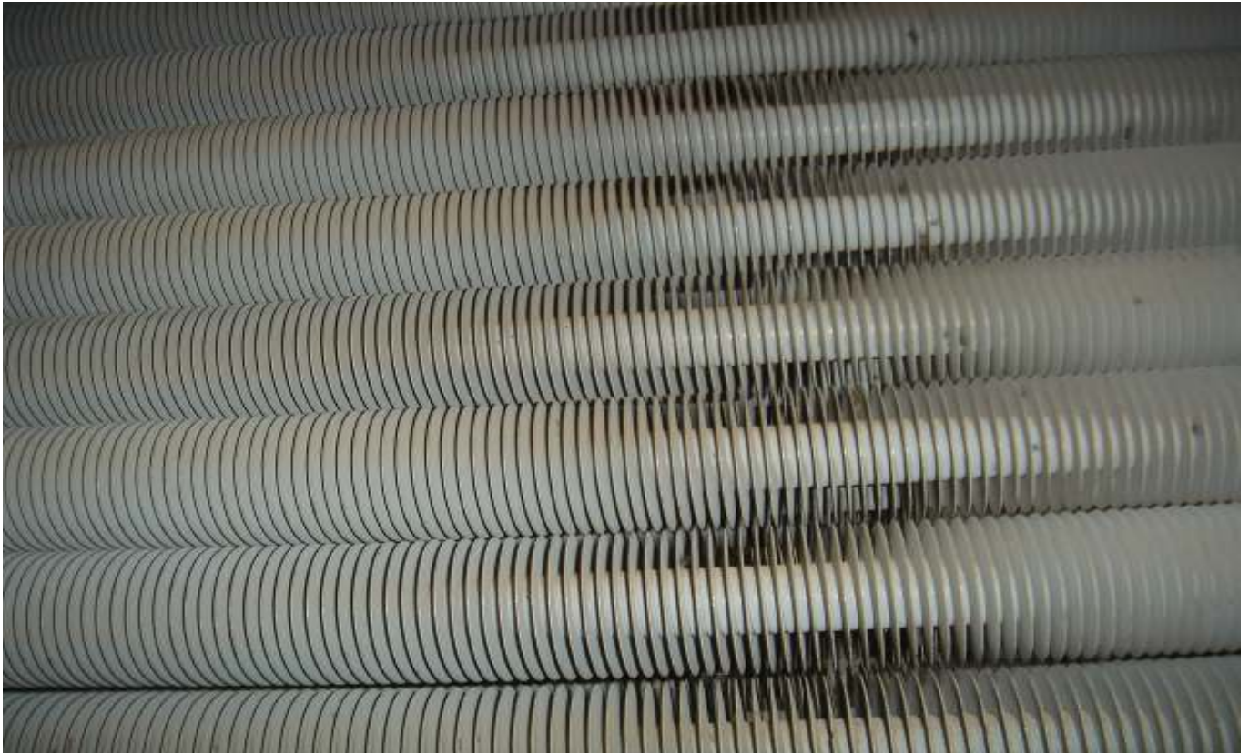
KUVA 15. Lämmityspatteri on pölyinen.
