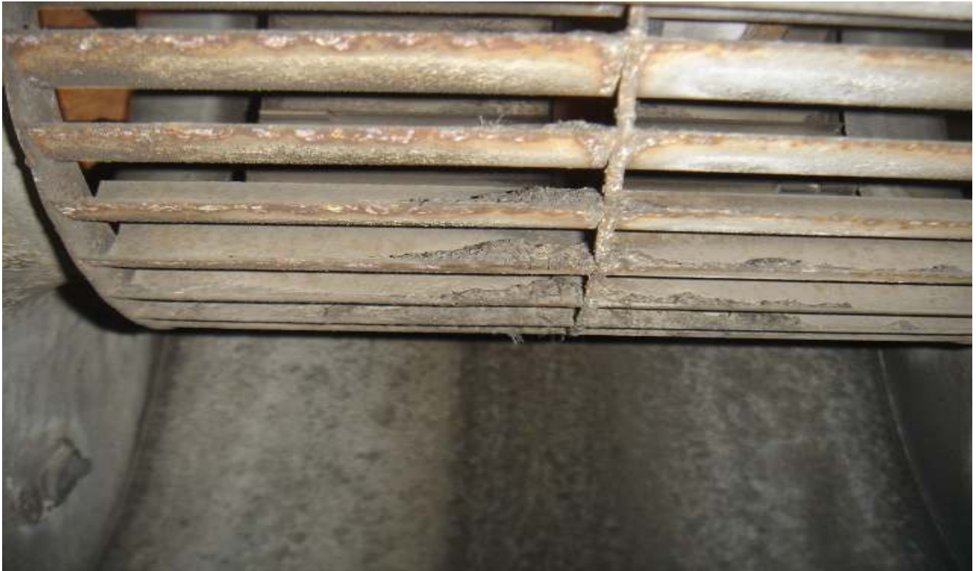
KUVA 9. Tuloilmapuhallin on melko likainen.
