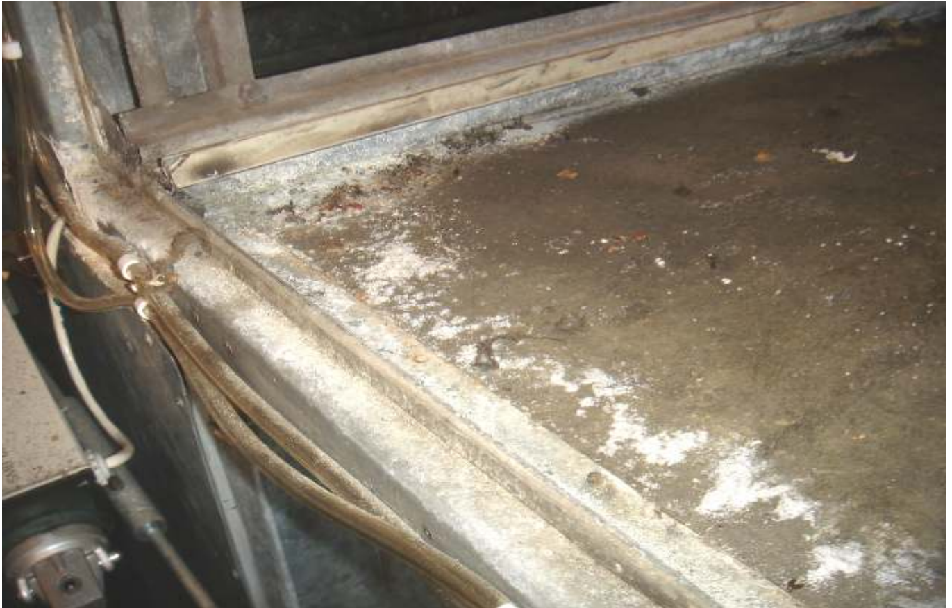
KUVA 11. Raitisilmakammiossa on runsaasti kosteuden jättämiä jälkiä.
