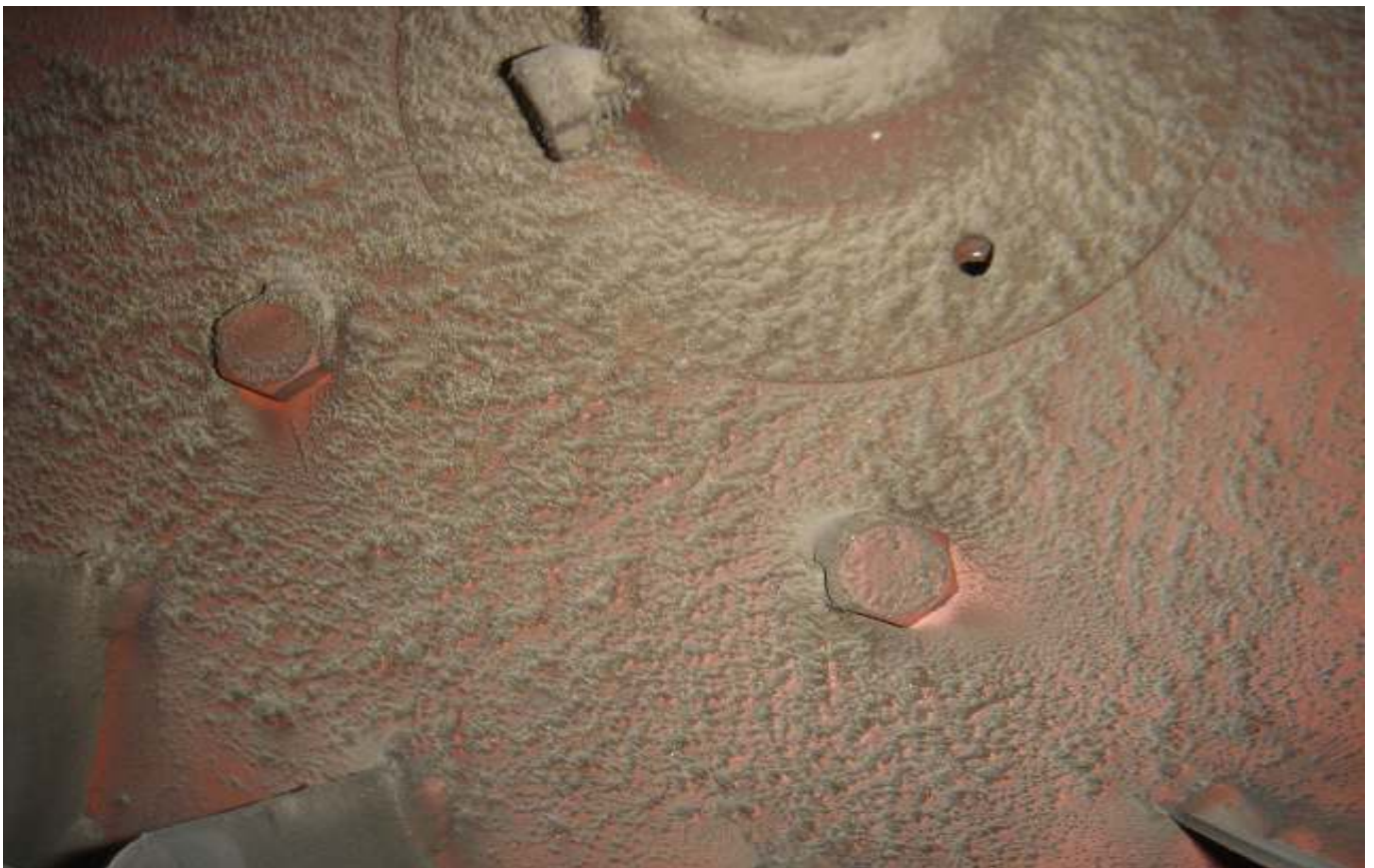
KUVA 16. Tuloilmapuhallin on pölyinen.
