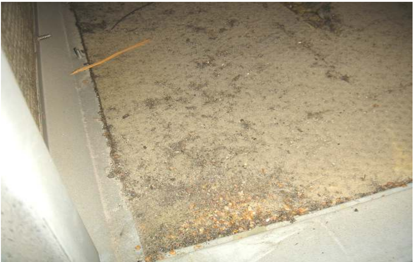
KUVA 18. Tuloilmakammioissa on pölyä ja roskaa.
