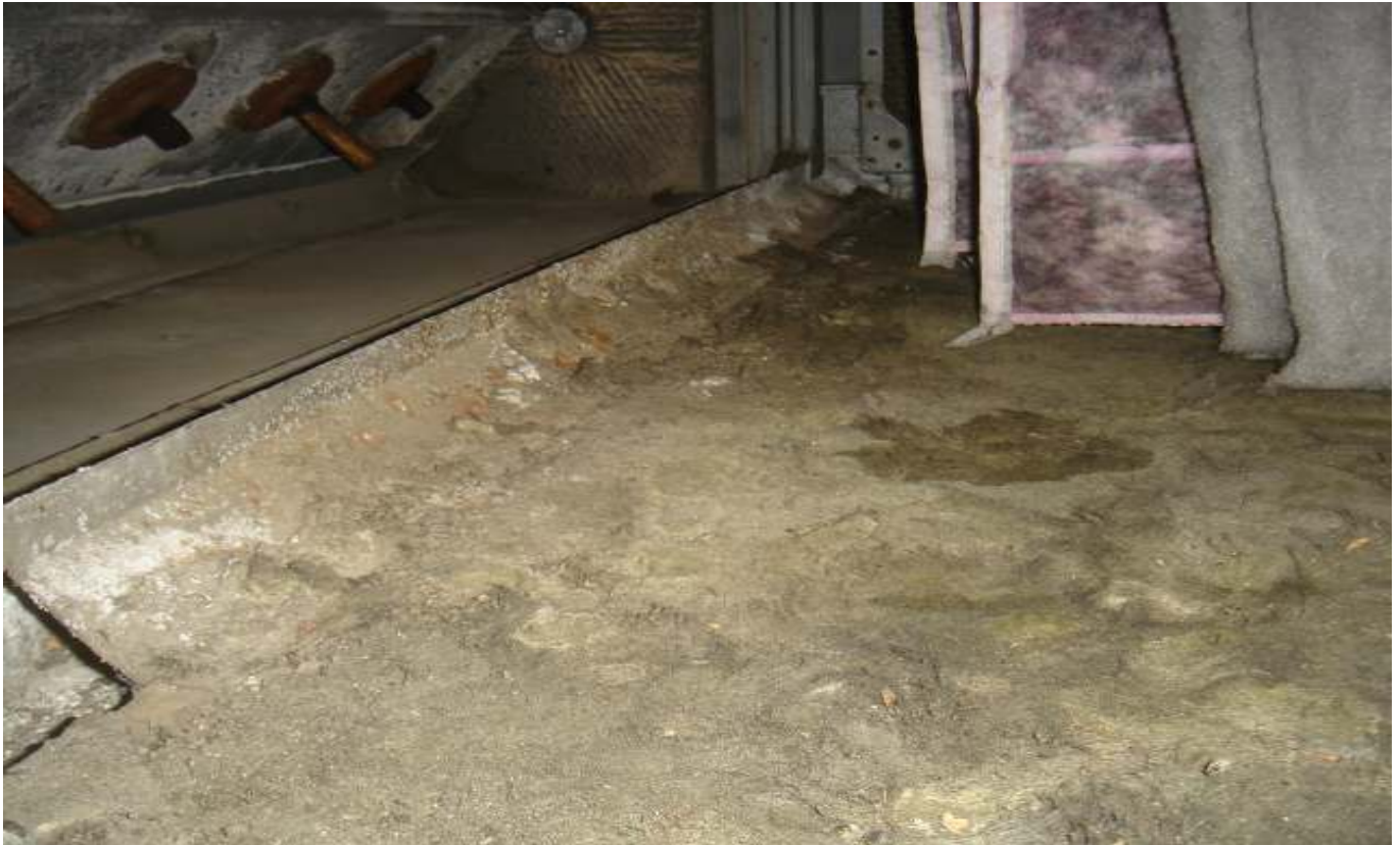
KUVA 17. Raitisilmakammiossa on runsaasti kosteuden jättämiä jälkiä.
