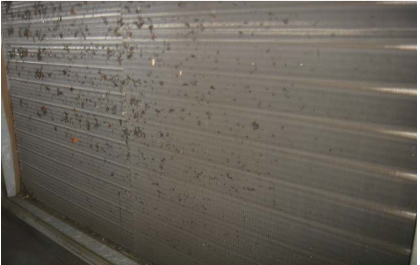
KUVA 13. Lämmityspatteri on roskainen.
