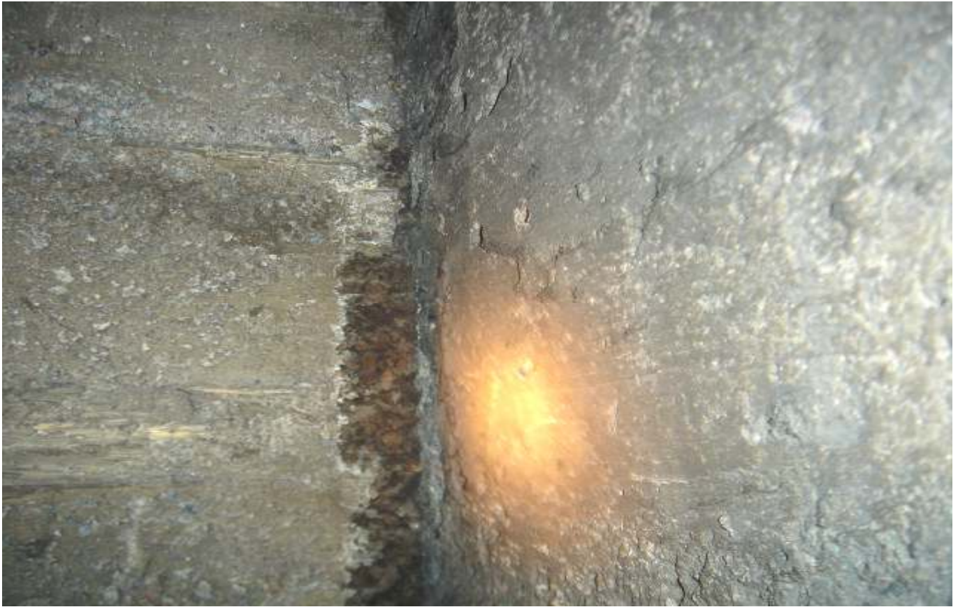
KUVA 1. Suodatin seinämän ja rakenteiden välissä on rakoja.
