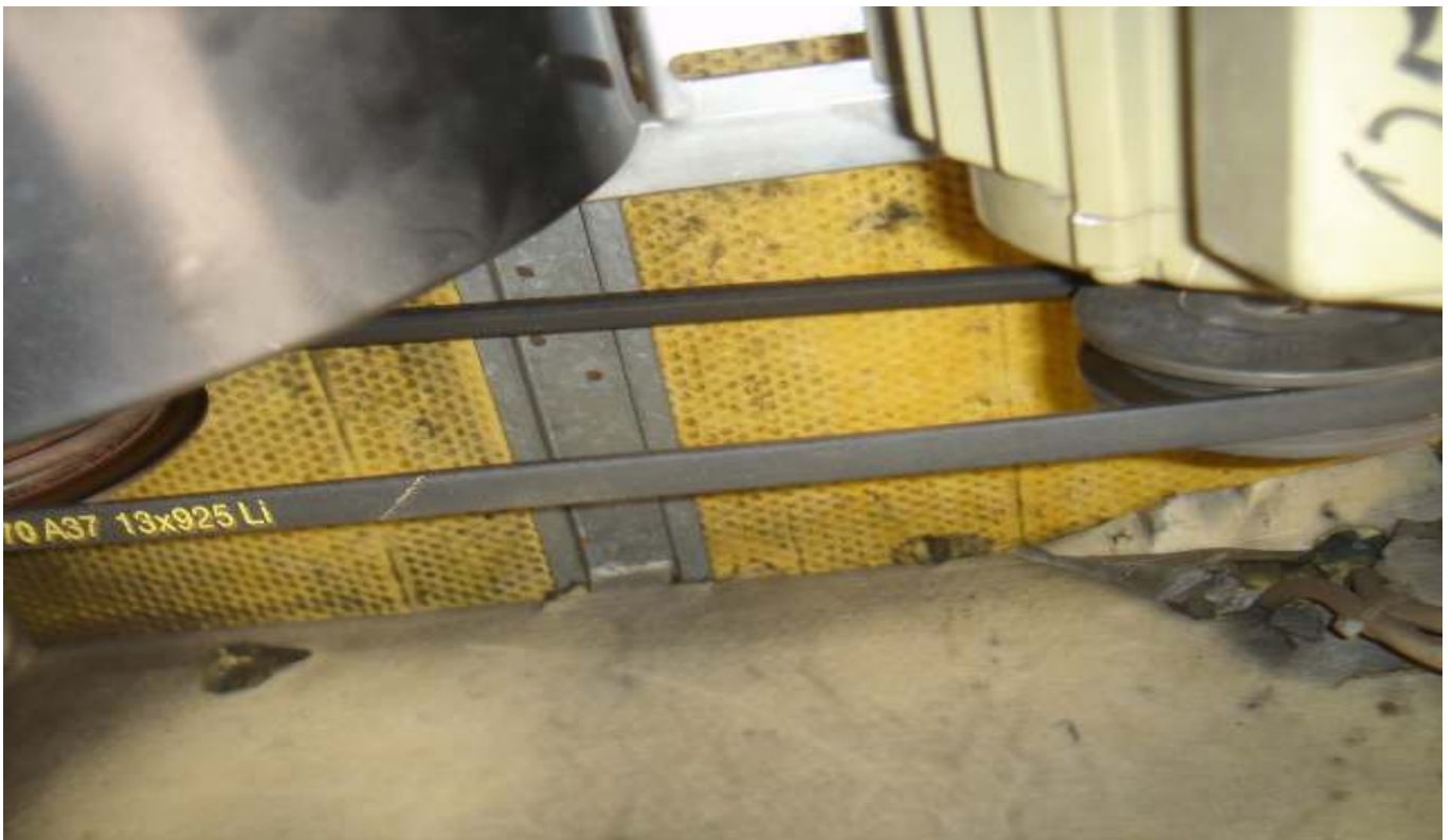
KUVA 14. Tuloilmakoneen kammiot on eristetty mineraalivillalla, joka on paikoin rikki.
