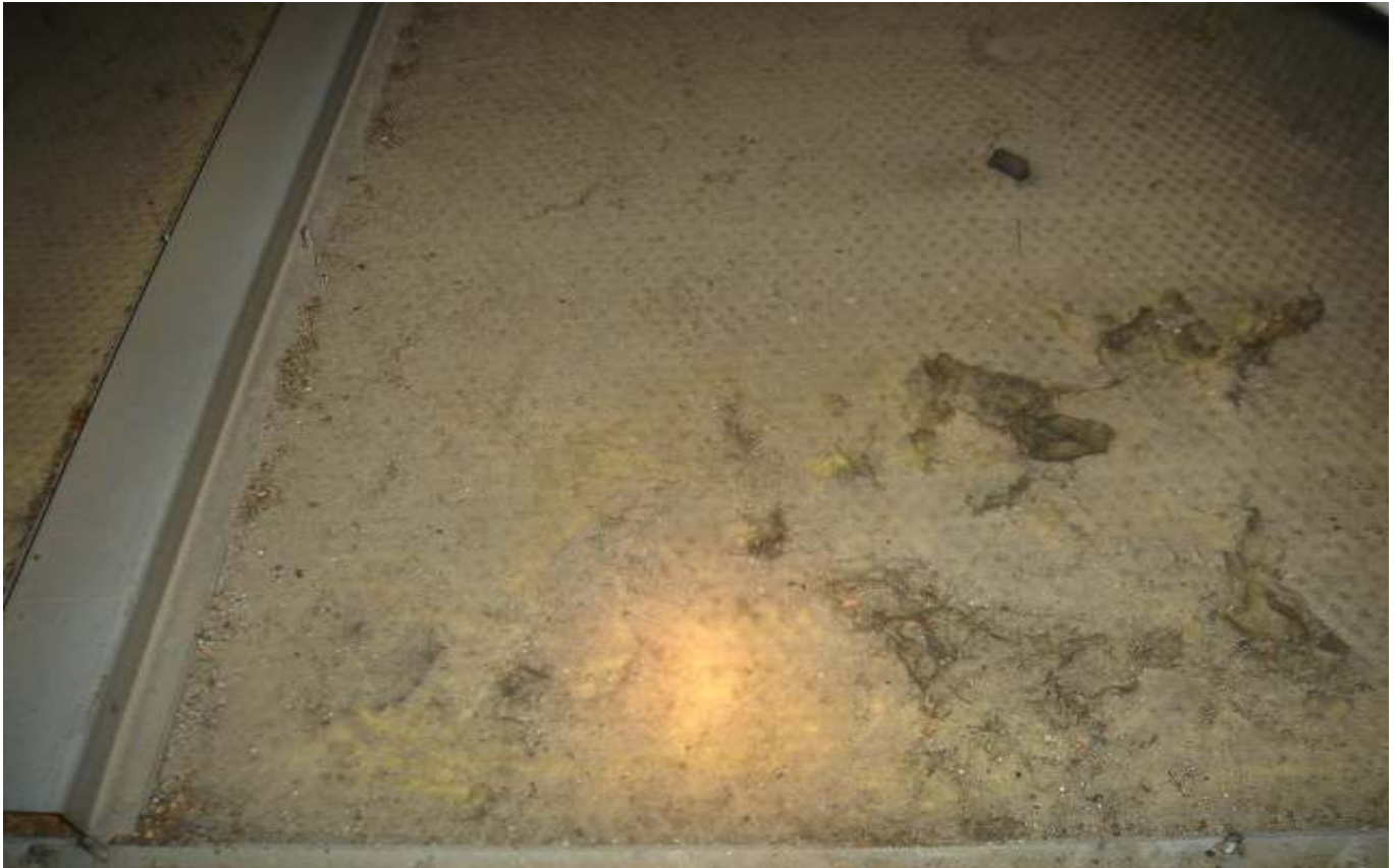
KUVA 19. Tuloilmakoneen kammiot on eristetty mineraalivillalla, joka on paikoin rikki.
