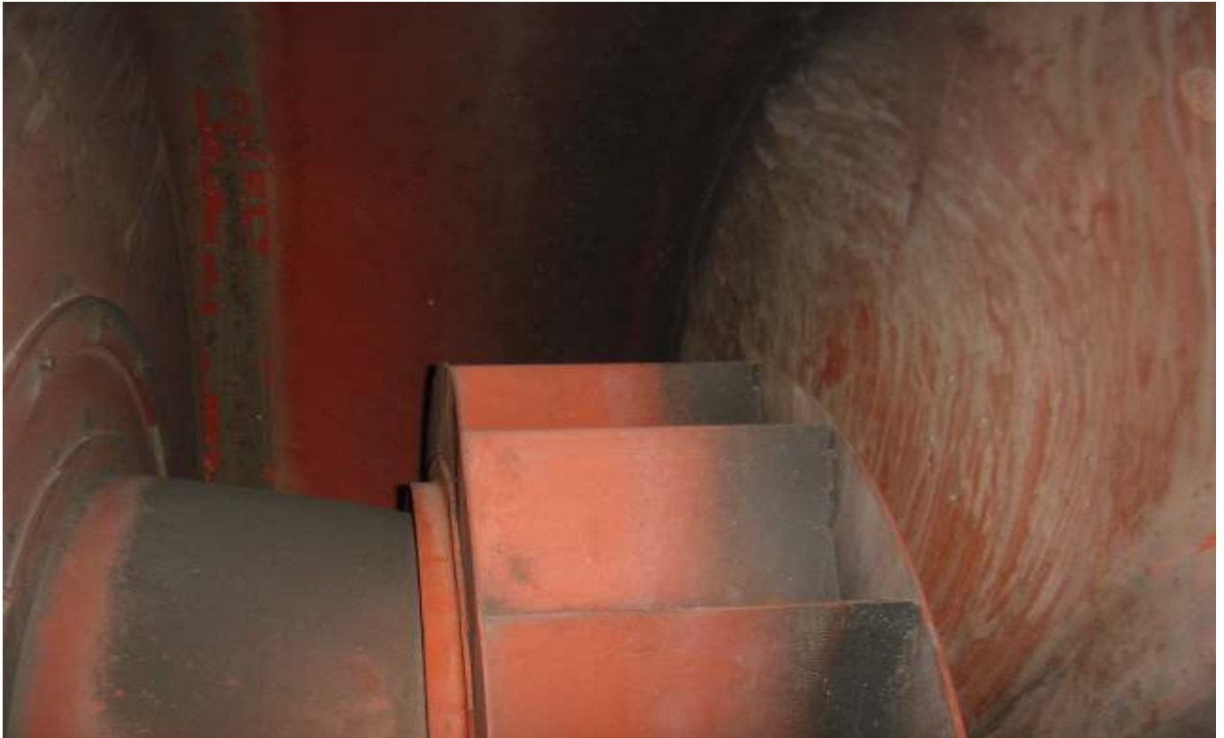
KUVA 5. Puhallin on nokinen ja pölyinen.
