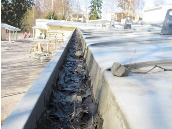
Kuva 25 Huoltamaton ränni, lumiesteet on kiinnitetty katteen läpi.
