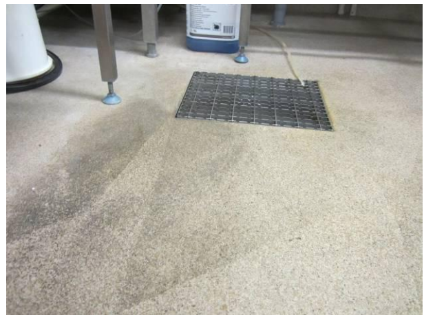
Kuva 34 Keittiön lattiapinnoite on tummunut.
