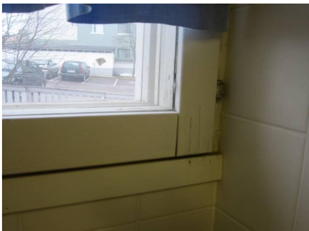
Kuva 21 Eteläpäädyn vesileikkihuoneen kosteusvaurioitunut yläikkuna.
