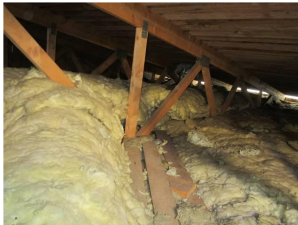
Kuva 27 Yläpohjaontelon kulkusilta. Kattotuulien tuennassa voi olla puutteita.
