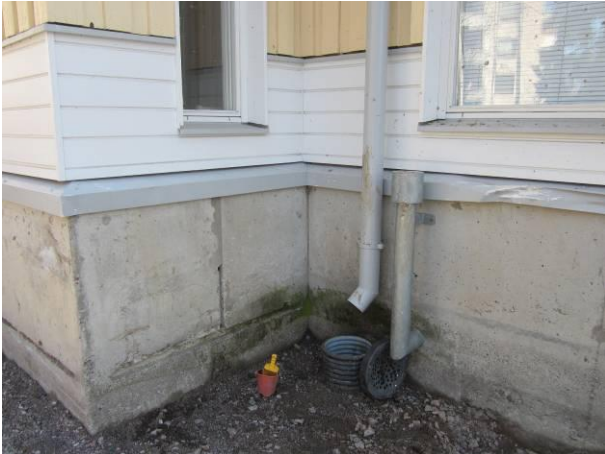
Kuva 13 Pohjoispäädyn alustatilan tuuletusputkia ja kastunut perusmuuri.
