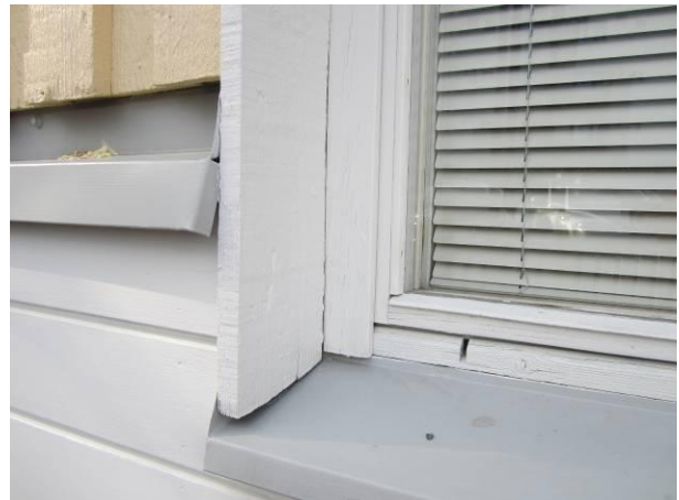
Kuva 18 Ikkunan sivupieli laudat ovat halkeilleet, ja ovat lähellä loivaa vesipeltiä. Ikkunoita on maalattu "kiinni" karmiin.
