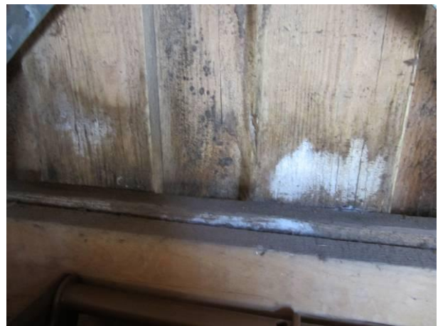
Kuva 10 Jätekatoksen laudoituksen sisäpinnan kosteusvaurioita.
