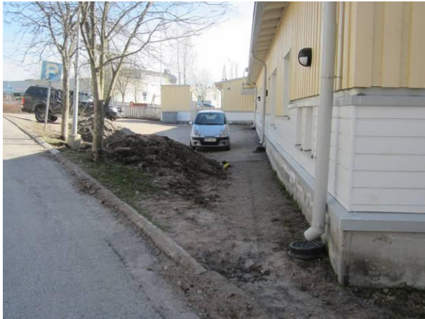
Kuva 1 Itäsivun koilliskulma pohjoispäädyssä, maanpinta viettää kohti rakennusta.
