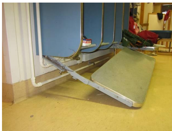
Kuva 42 Eteistilan rikkoutunut koroke/ istuintaso
