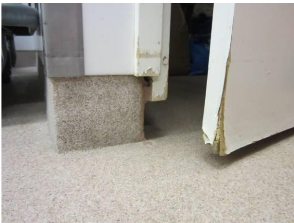
Kuva 33 Hyvin kulunut ovi keittiössä.
