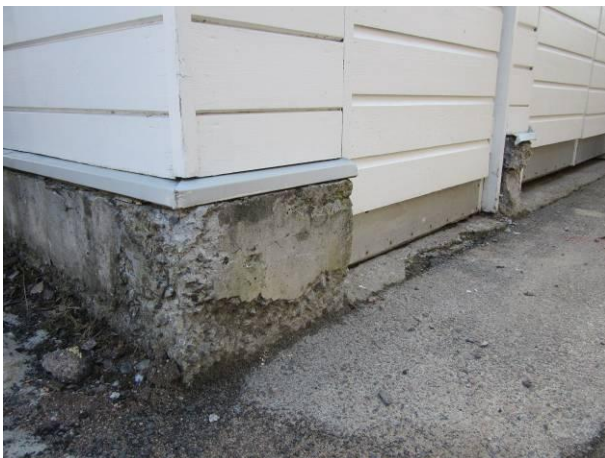
Kuva 9 Jätekatoksen rapautunut sokkeli.
