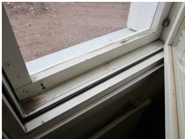
Kuva 20 Kulunut tuuletusikkuna, avausrajoittimen sokka puuttuu, ikkunasta voi pudota.
