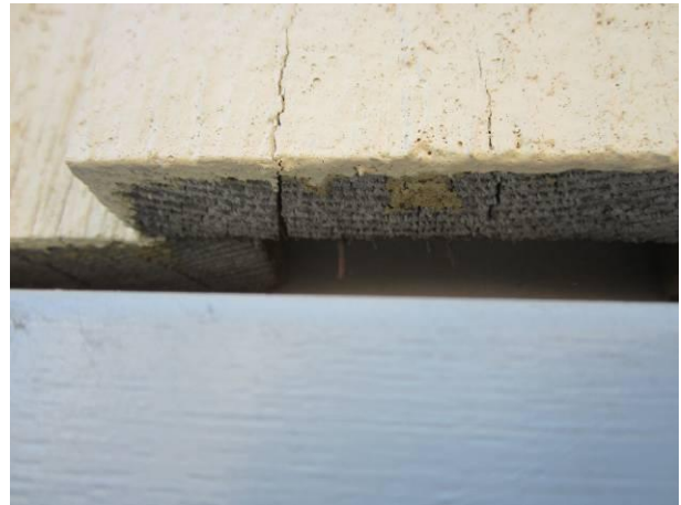
Kuva 16 Kunnostamaton osa, lautojen alapäästä viistämättä ja maalaamatta.
