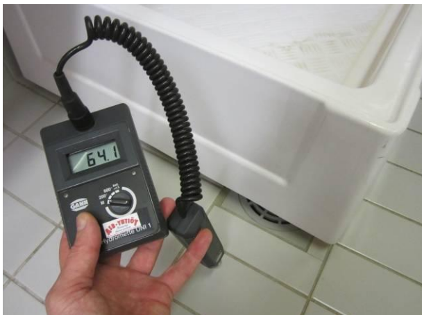
Kuva 37 Pintakosteusmittaus pesuhuone-Wc-tilassa 16, kuiva arvo.
