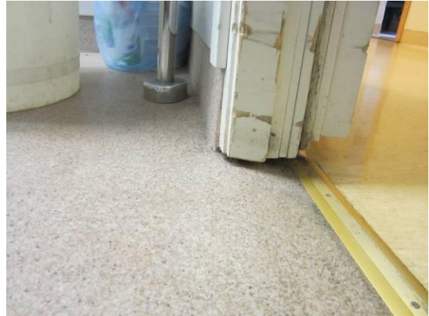
Kuva 32 Keittiön ovikynnystä ei ole, kulunut ovi.
